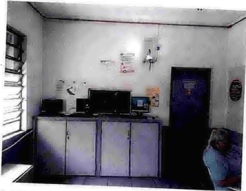
Foto 43 – Sala da reserva: apresenta problemas na pintura.
