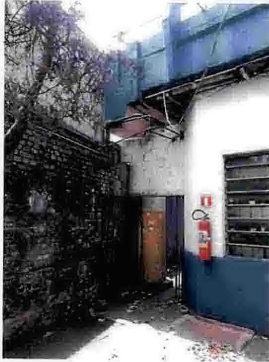
Foto 211 – Circulação – acesso às salas: apresenta problemas na pintura.
