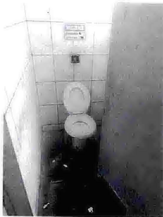
Fotos 347 – Sanitário da Oficina: a porta da cabine está danificada.
