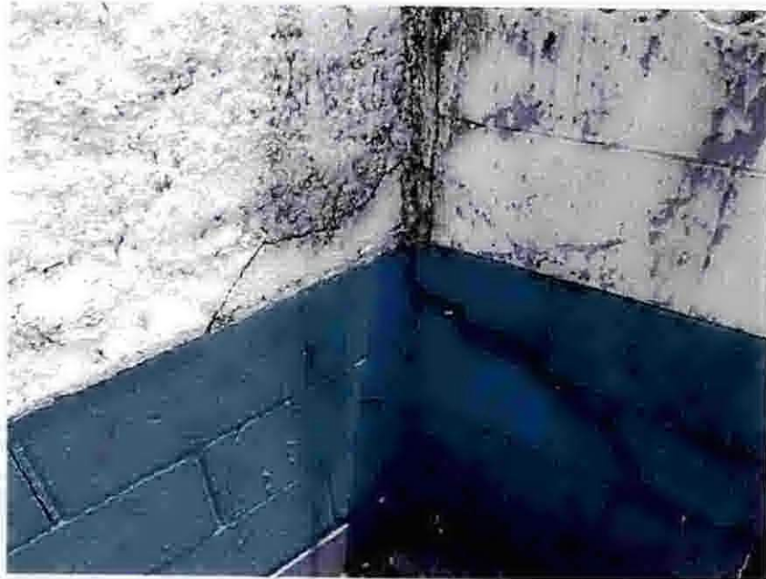
Foto 219 – Circulação – Escada de acesso ao pátio: apresenta problemas na pintura, trincas e rachaduras na alvenaria.
