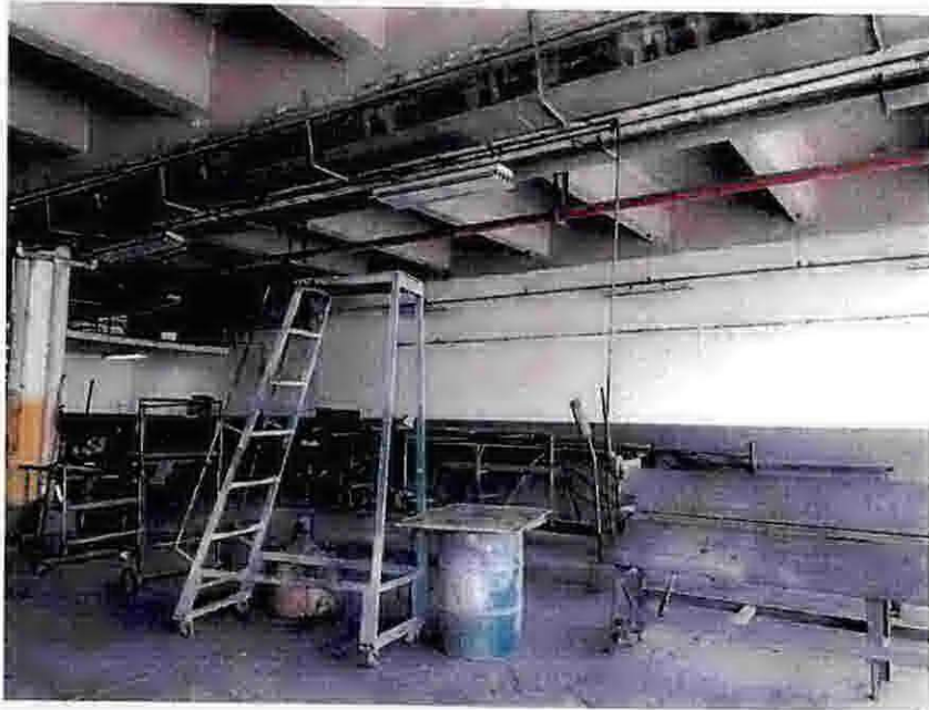
Fotos 323 – Oficina: apresenta problemas na pintura.
