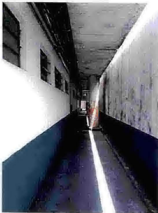
Foto 203 – Circulação – acesso às salas: apresenta problemas na pintura.
