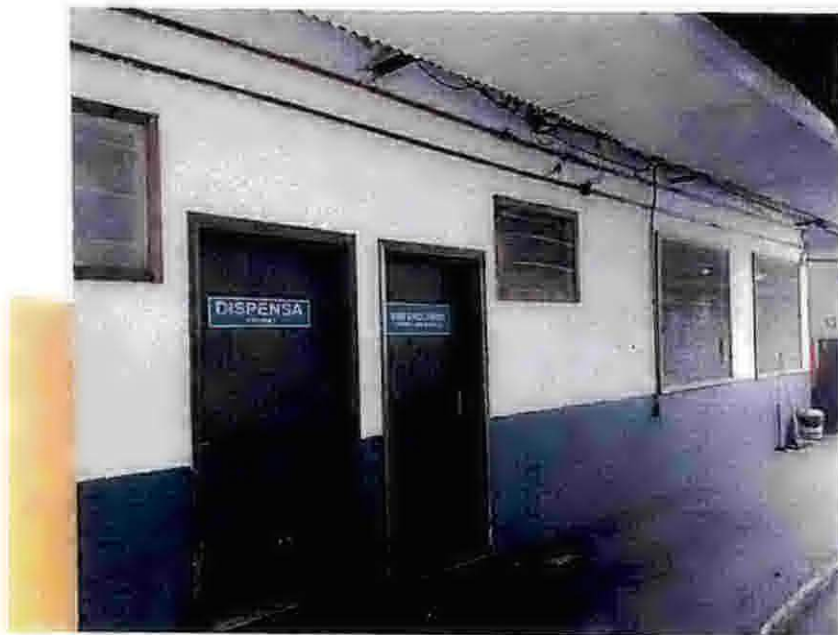
Foto 208 – Circulação – acesso às salas: apresenta problemas na pintura.
