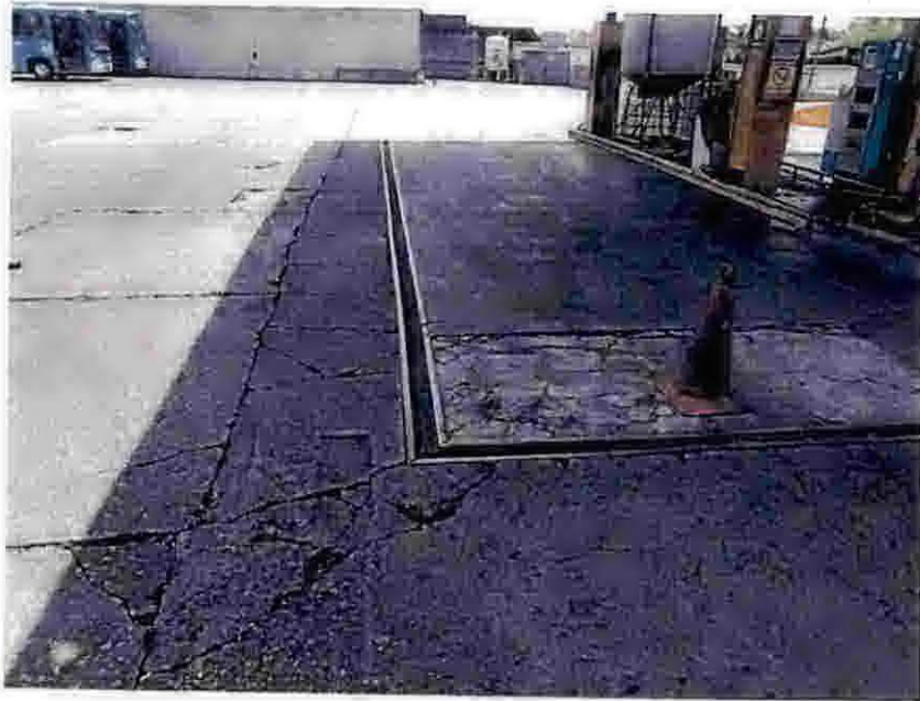
Foto 252 – Área de abastecimento: apresenta problemas no pavimento.
