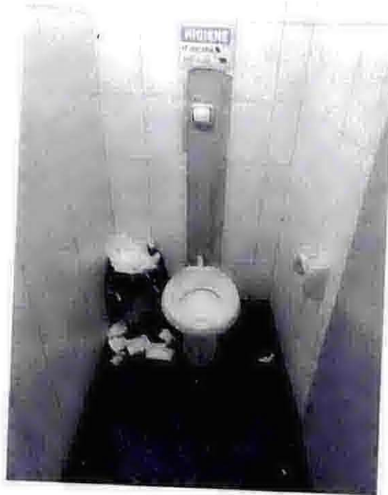
Foto 75 – Sanitário Masculino - Cabine 01: apresenta problemas no revestimento.
