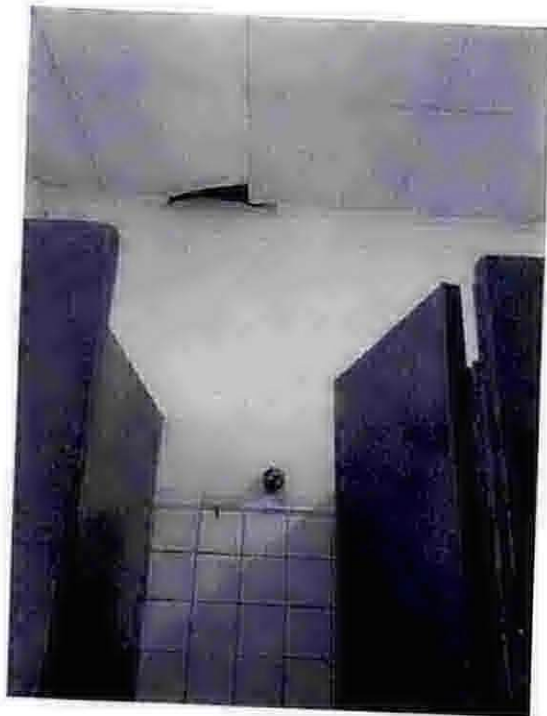
Foto 56 – Sanitário feminino: forro apresenta buraco.
