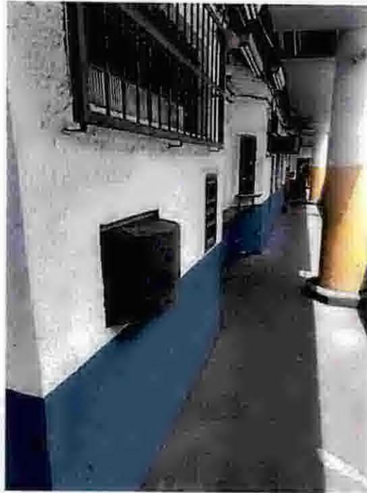
Foto 199 – Circulação – acesso às salas: apresenta problemas na pintura.
