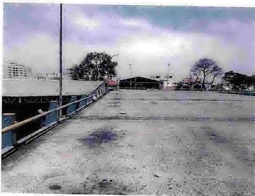
Foto 244 – Pátio elevado: apresenta problemas no pavimento.
