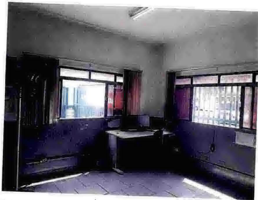
Foto 15 – Vista interna do Prédio do plantão e CCO: apresenta problemas na pintura.
