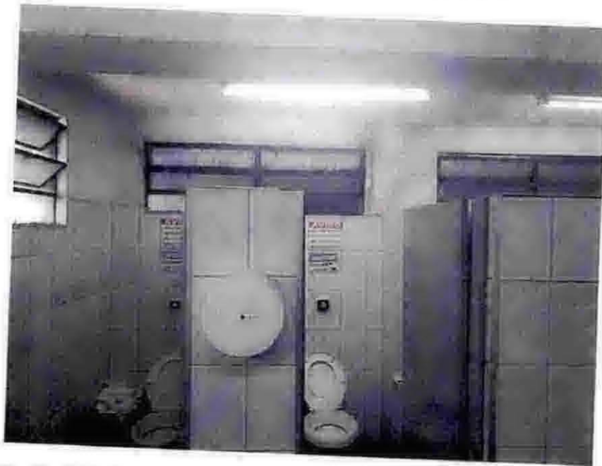
Foto 78 – Sanitário Masculino: apresenta problemas na pintura.
