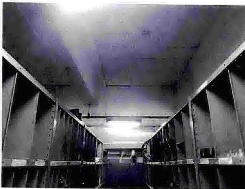
Fotos 311 – Almojarifado: apresenta problemas na pintura.
