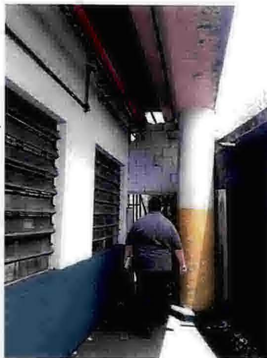
Foto 210 – Circulação – acesso às salas: apresenta problemas na pintura.
