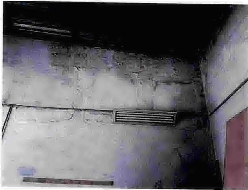
Foto 225 – Pátio – Depósito: apresenta problemas de infiltração e na pintura.
