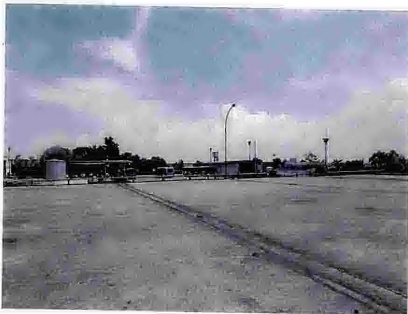
Foto 241 – Pátio elevado: apresenta problemas no pavimento.
