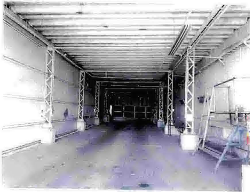
Foto 279 – Cabine de pintura.
