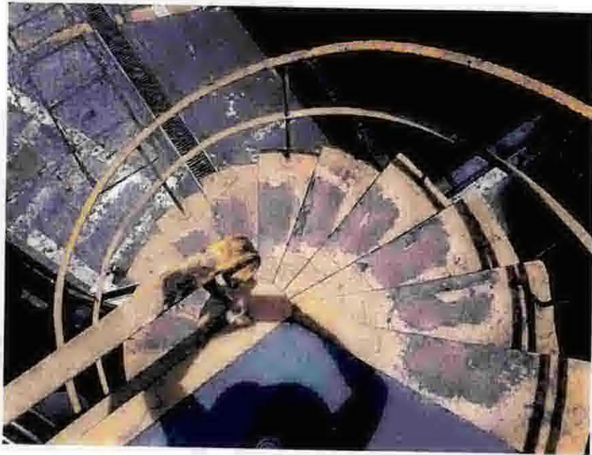
Foto 245 – Pátio elevado – Escada de acesso: apresenta problemas na pintura.
