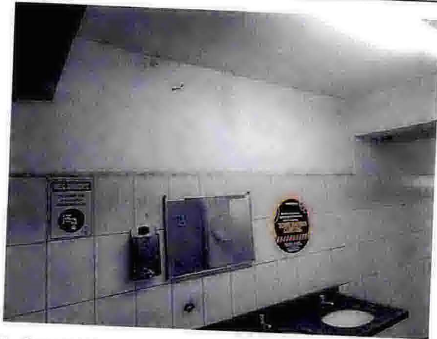
Foto 81 – Sanitário Masculino: apresenta problemas na pintura.
