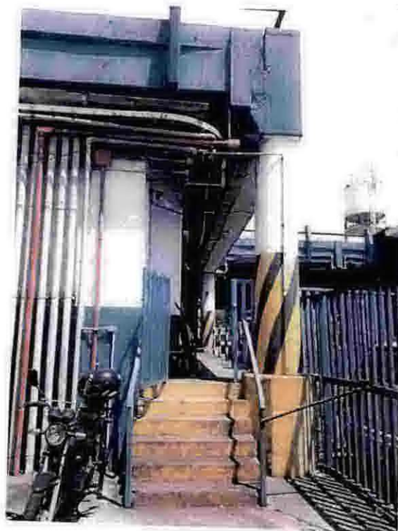
Foto 24 – Acesso a área da cabine primária: pintura desgastada.
