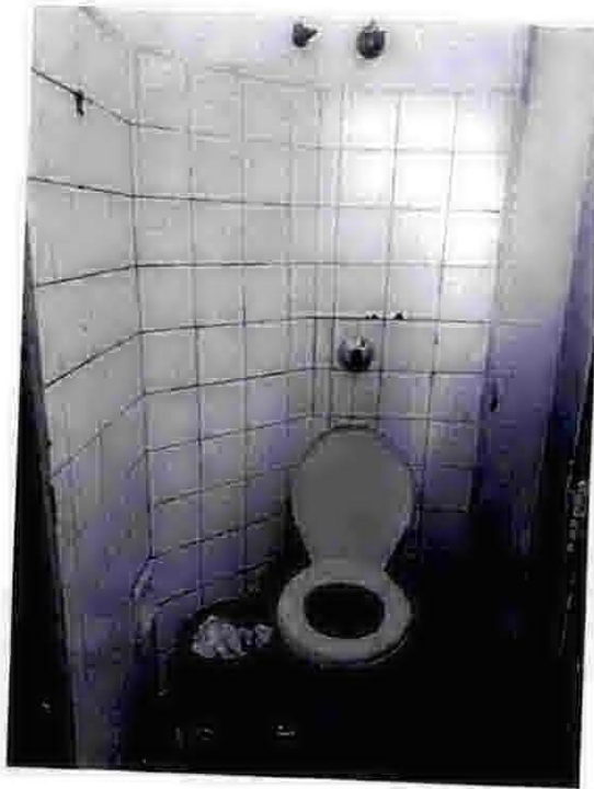
Foto 53 – Sanitário feminino - Cabine 01; presença de mancha nos azulejos indicando vazamento na válvula de descarga; azulejos sujos.
