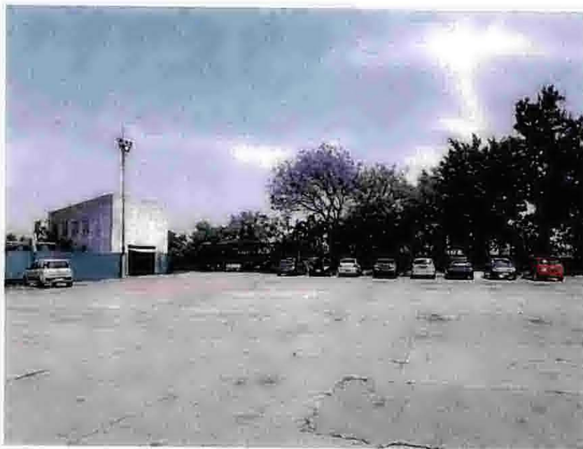
Foto 231 – Pátio: apresenta problemas no pavimento.
