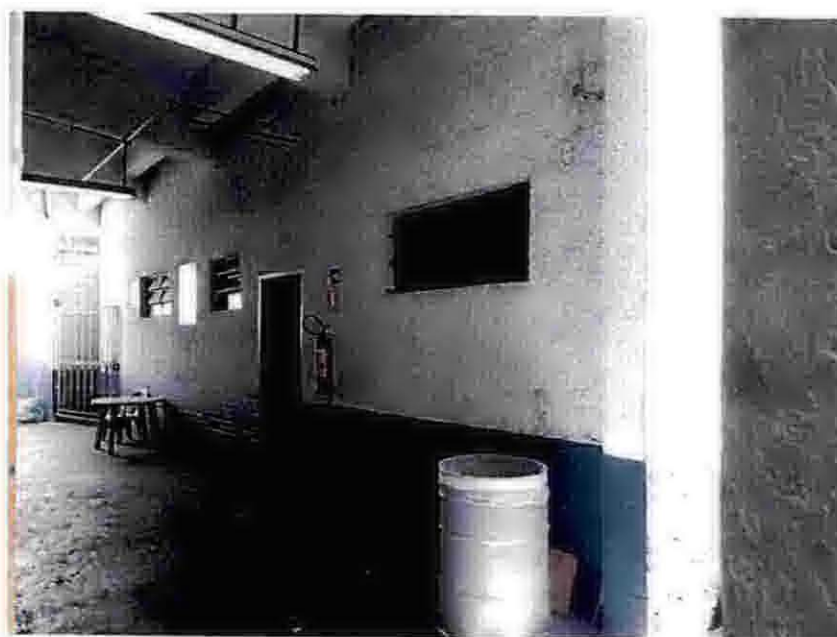
Foto 206 – Circulação – acesso às salas: apresenta problemas na pintura.
