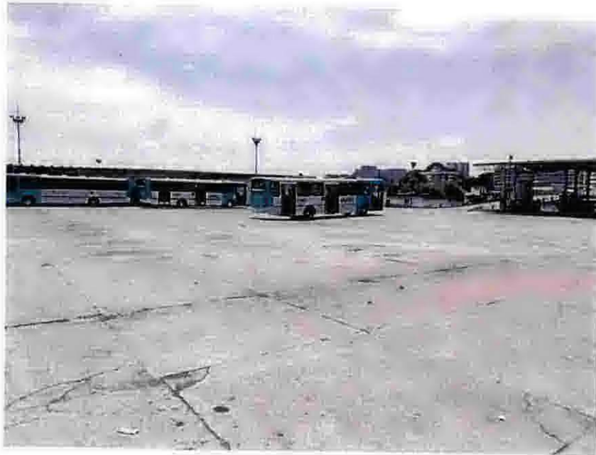
Foto 233 – Pátio: apresenta problemas no pavimento.
