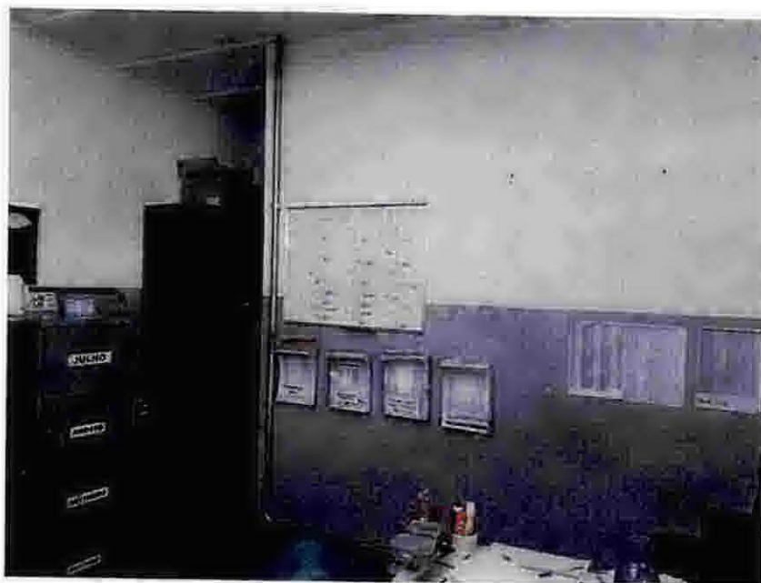
Fotos 316 – Controle de manutenção: apresenta problemas na pintura.
