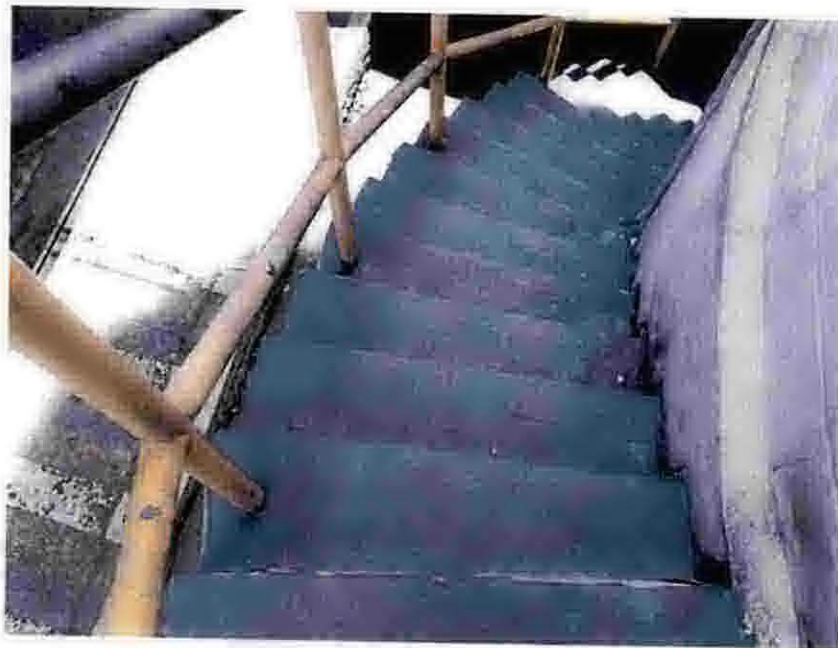
Foto 275 – Escada de acesso à casa de bombas: apresenta problemas na pintura.
