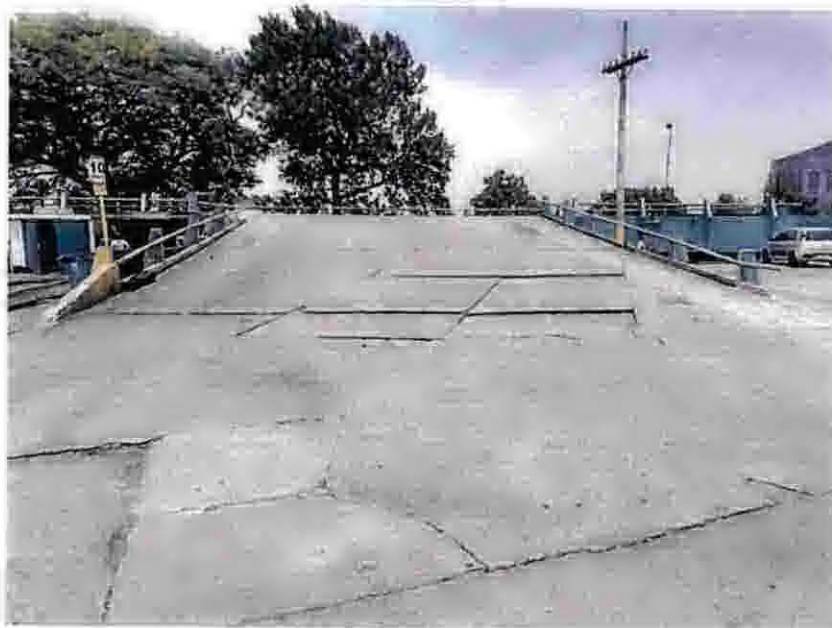
Foto 232 – Pátio – Rampa de acesso ao pátio elevado: apresenta problemas no pavimento.
