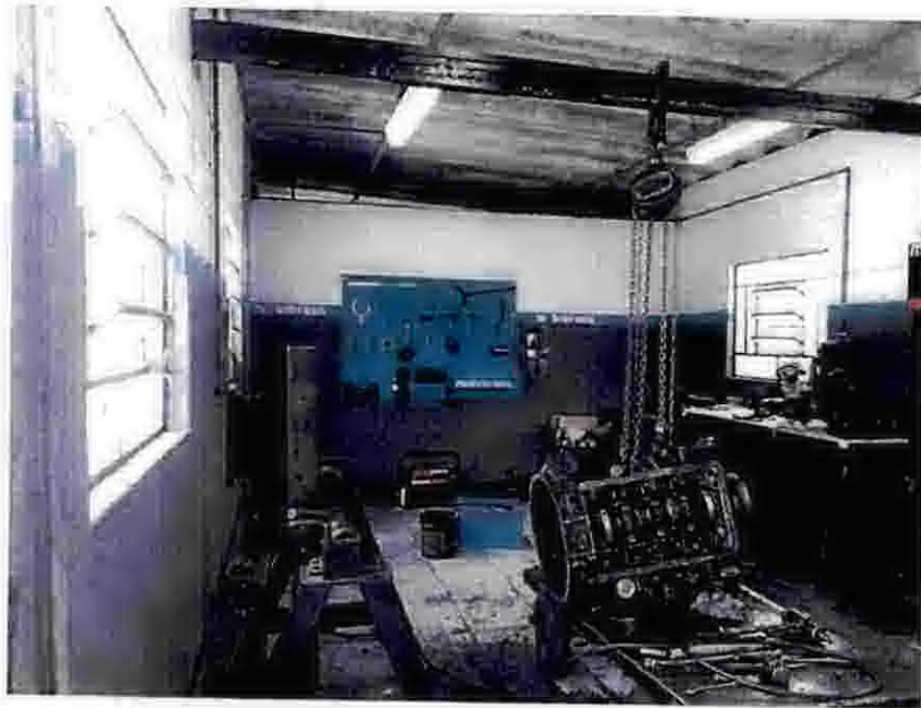
Fotos 339 – Área de Montagem de Câmbio: apresenta problemas na pintura.
