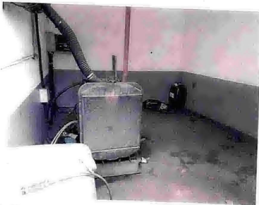
Foto 32 – Gerador: Segundo o Sr. Anderson, este equipamento está desativado. A sala apresenta problemas no piso e na pintura.
