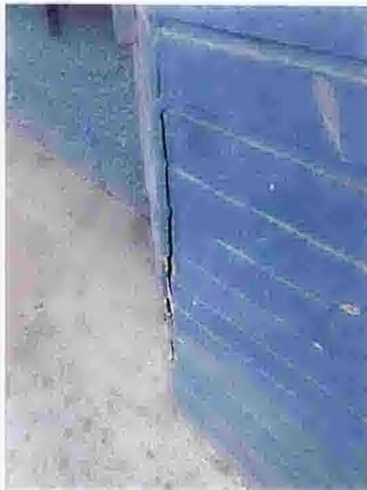
Foto 202 – Circulação: apresenta rachadura no revestimento da alvenaria.
