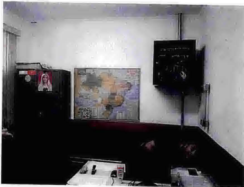
Fotos 300 – Sala Supervisor do Almoxarifado: apresenta problemas na pintura.
