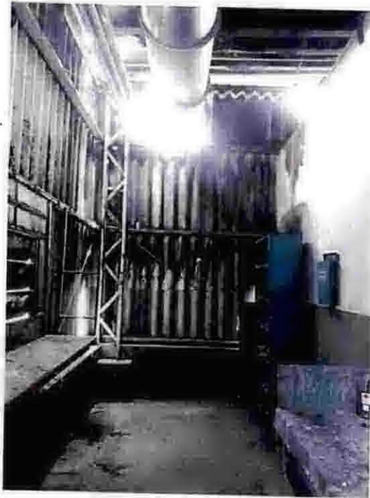
Foto 285 – Salas anexas a Cabine de pintura: apresenta problemas na pintura.
