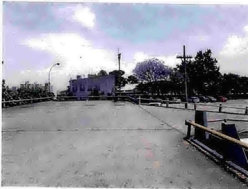
Foto 248 – Pátio elevado: apresenta problemas no pavimento.
