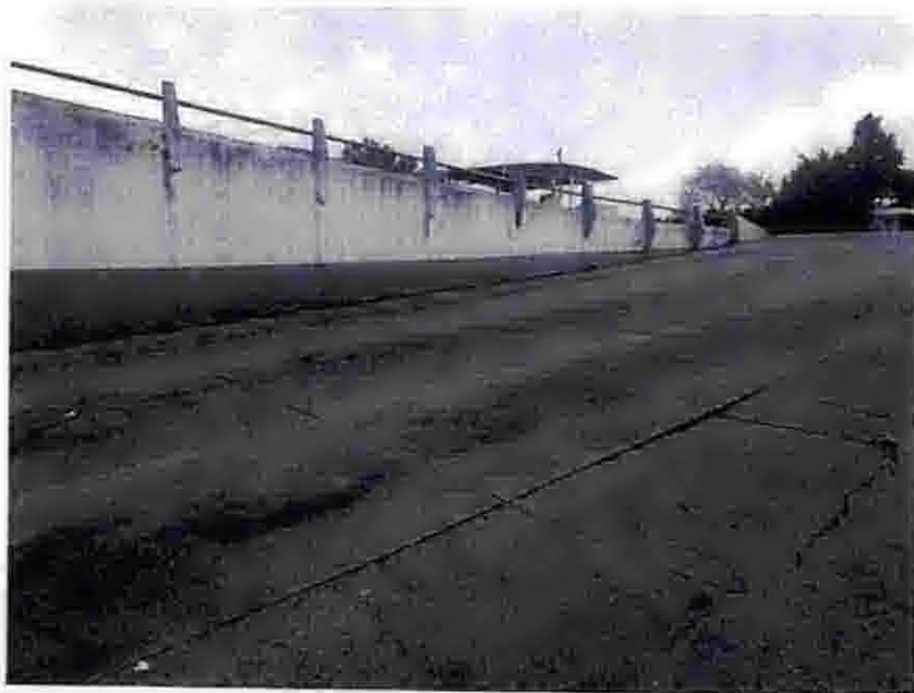
Foto 235 – Pátio – Rampa de acesso ao pátio elevado: apresenta problemas no pavimento.
