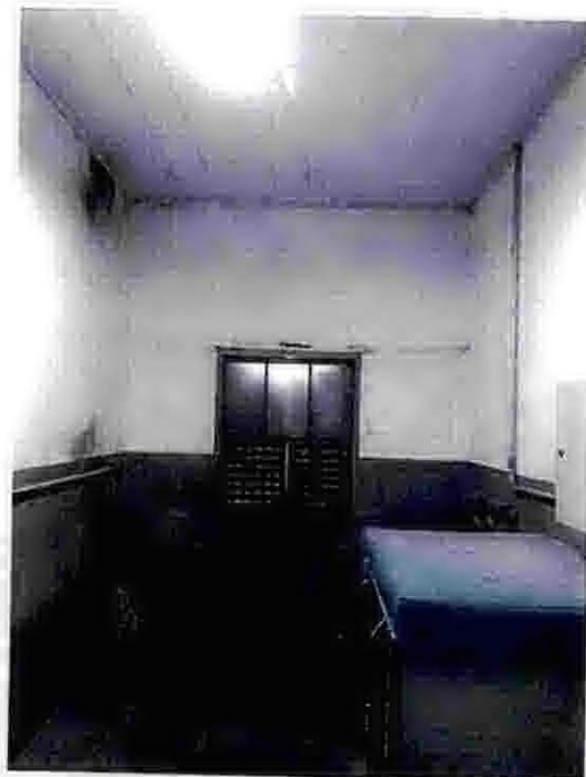
Foto 286 – Salas anexas a Cabine de pintura: apresenta problemas na pintura.
