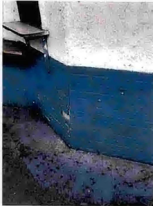
Foto 201 – Circulação: apresenta rachadura no revestimento da alvenaria e problemas na pintura.
