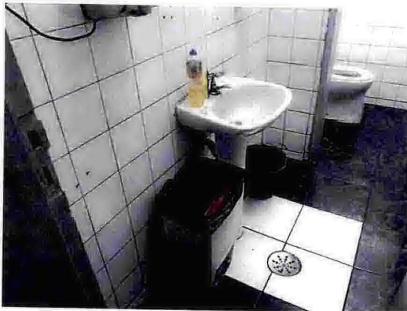
Fotos 318 – Sanitário anexo ao Controle de manutenção: apresenta furos no revestimento.
