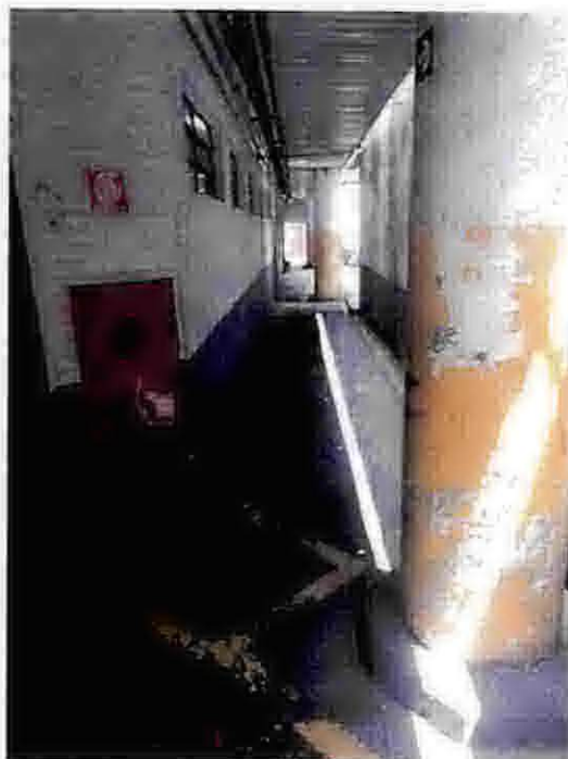
Foto 204 – Circulação – acesso às salas: apresenta problemas na pintura.
