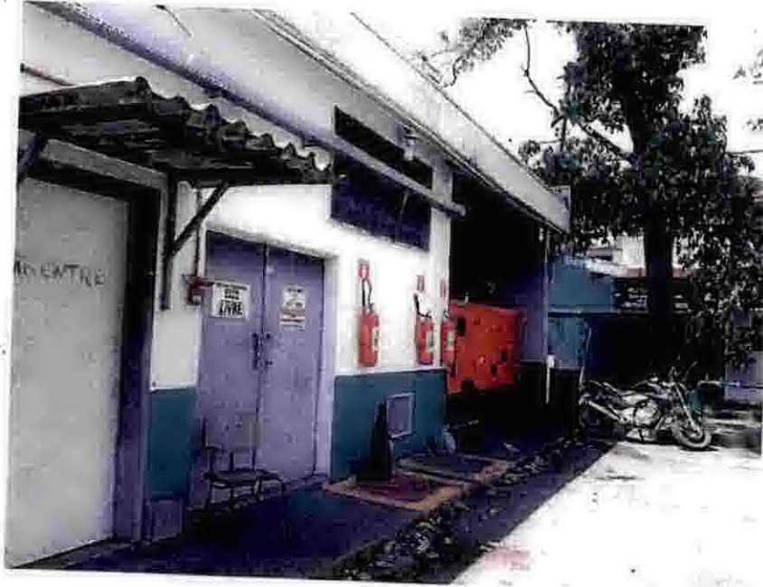
Foto 27 – Fachada da cabine primária e gerador: apresenta problemas na pintura.
