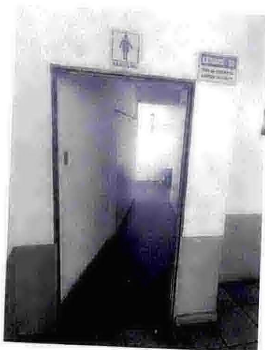
Foto 70 – Sanitário Masculino: apresenta problemas na pintura.
