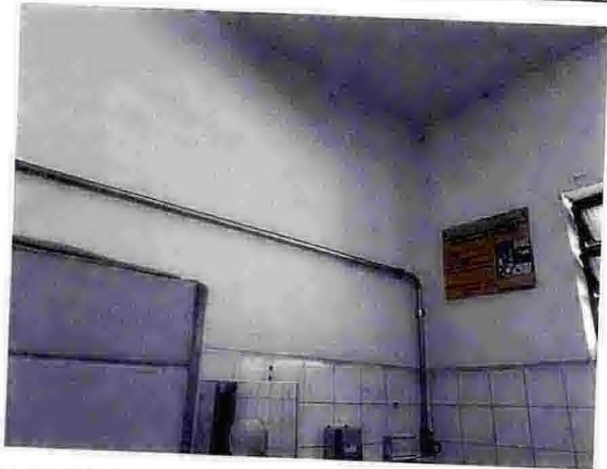
Foto 51 – Sanitário feminino: problemas na pintura.
