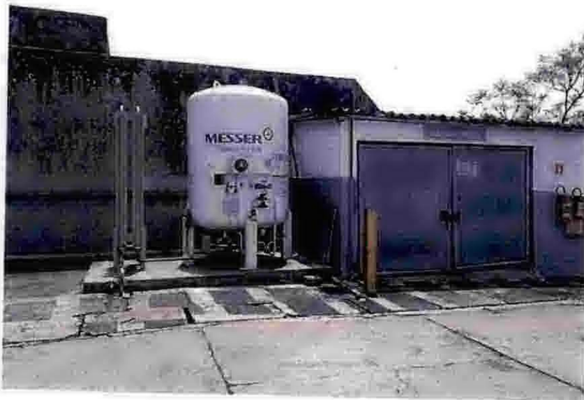
Fotos 290 – Sala da Manutenção Elétrica Predial.
