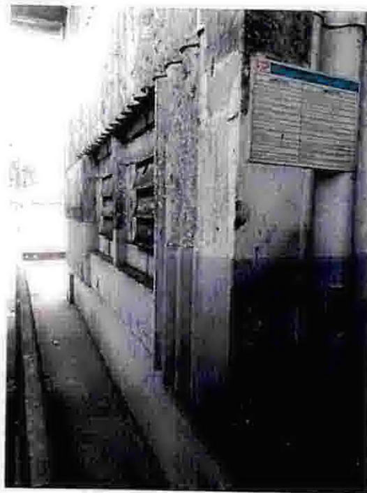
Foto 282 – Salas anexas a Cabine de pintura – Fachada lateral: apresenta muita sujeira, problemas na pintura e nas janelas.
