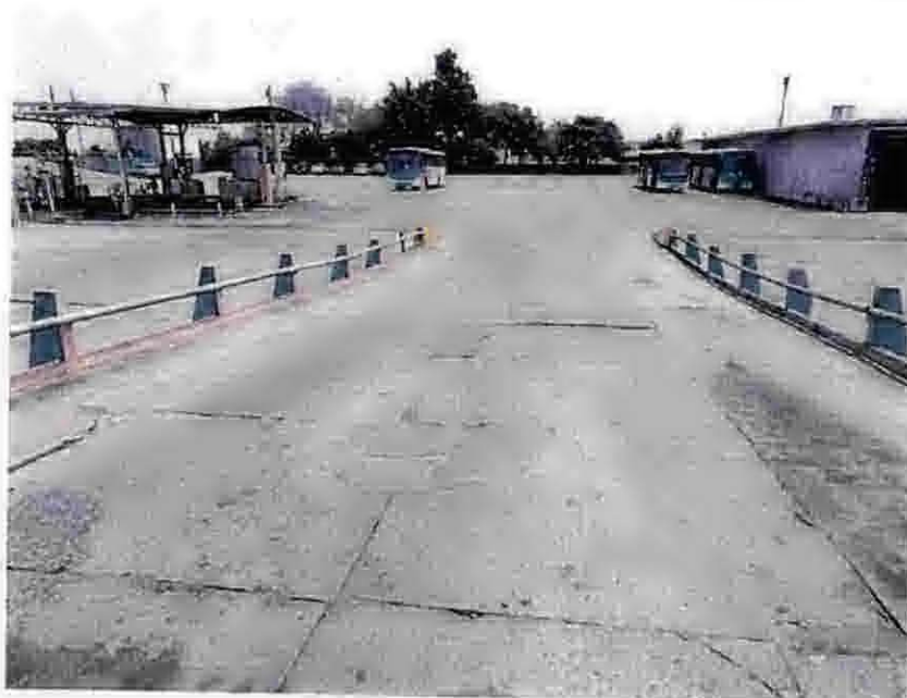
Foto 237 – Pátio – Rampa de acesso ao pátio elevado: apresenta problemas no pavimento.
