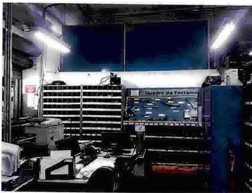
Fotos 312 – Almojarifado: apresenta problemas na pintura.
