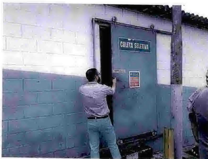
Fotos 294 – Sala de Coleta Seletiva: apresenta problemas na pintura.
