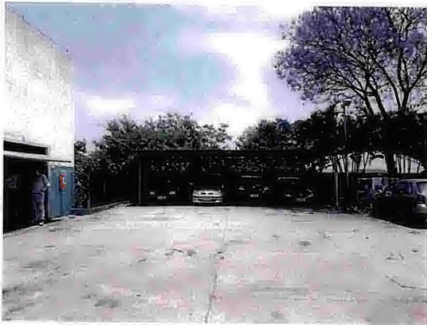
Foto 226 – Pátio – Estacionamento coberto: apresenta problemas no pavimento.
