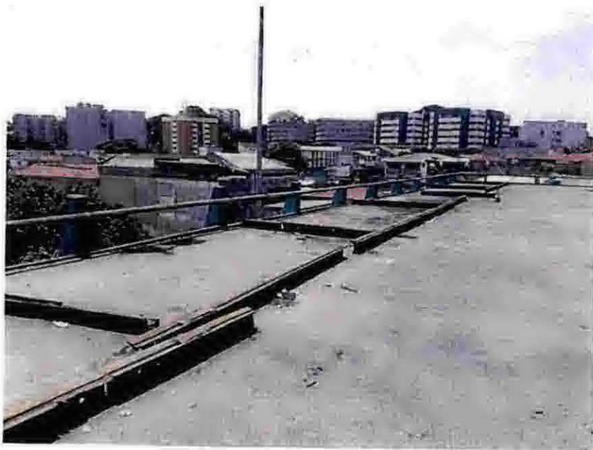
Foto 240 – Pátio elevado: apresenta problemas no pavimento.
