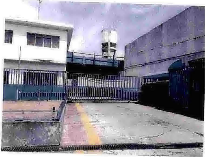
Foto 1 – Portão de acesso dos veículos: pavimento apresenta avarias; grelhas para coleta de águas pluviais danificadas e pintura do portão em estado ruim.
