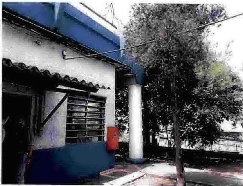
Foto 213 – Área externa: apresenta problemas na pintura.
