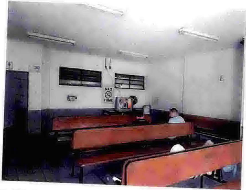
Foto 45 – Sala da reserva: apresenta problemas na pintura.
