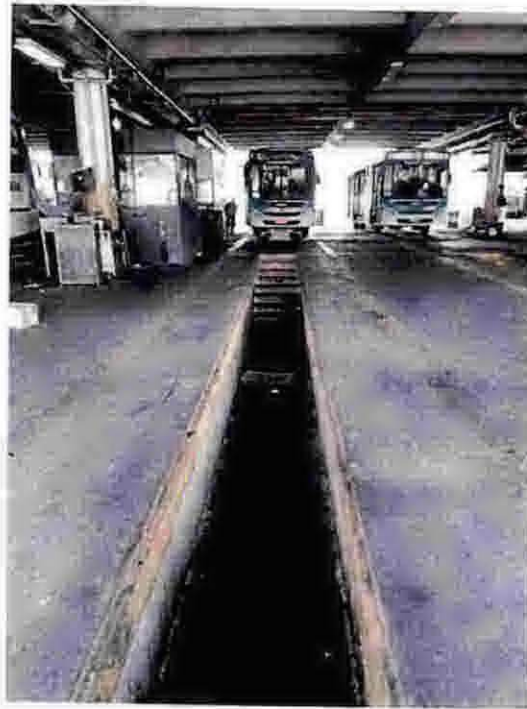
Fotos 327 – Oficina: apresenta problemas na pintura.
