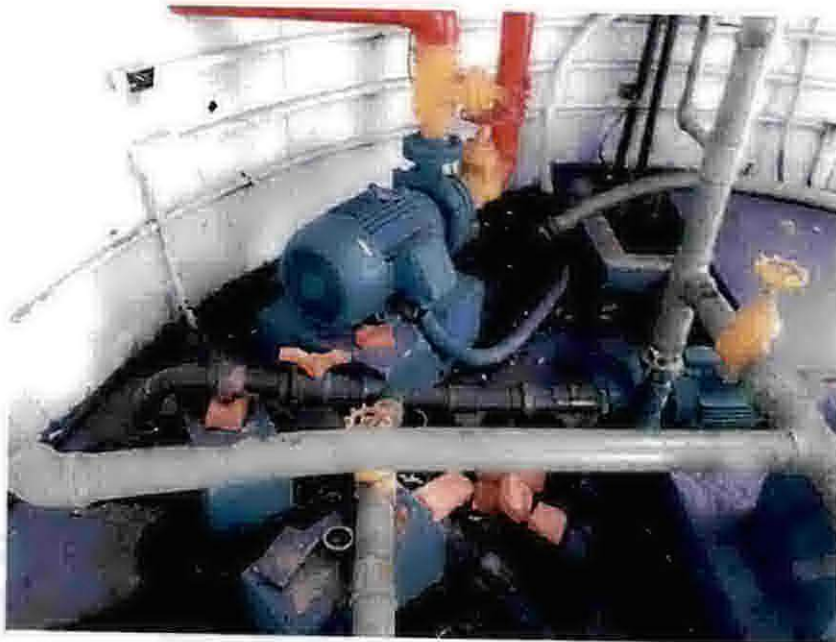
Foto 277 – Castelo D'água – bomba: piso apresenta problemas na pintura.
