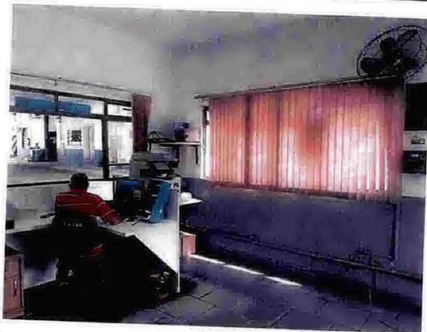
Foto 17 – Vista interna do Prédio do plantão e CCO: apresenta problemas na pintura e desgaste no piso.
