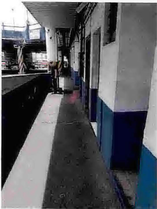
Foto 196 – Circulação – acesso às salas: apresenta problemas na pintura.
