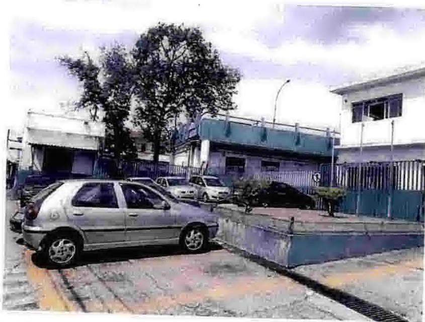
Foto 2 – Estacionamento externo: pavimento apresenta avarias; grelhas para coleta de águas pluviais danificadas e pintura das muretas em estado ruim.
