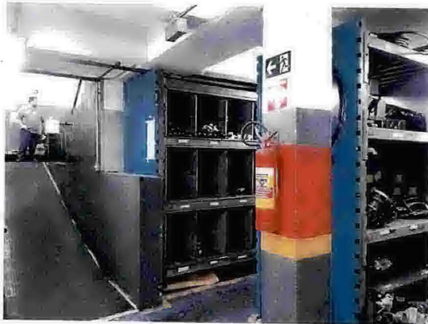
Fotos 308 – Almoarifado: apresenta problemas na pintura do piso.
