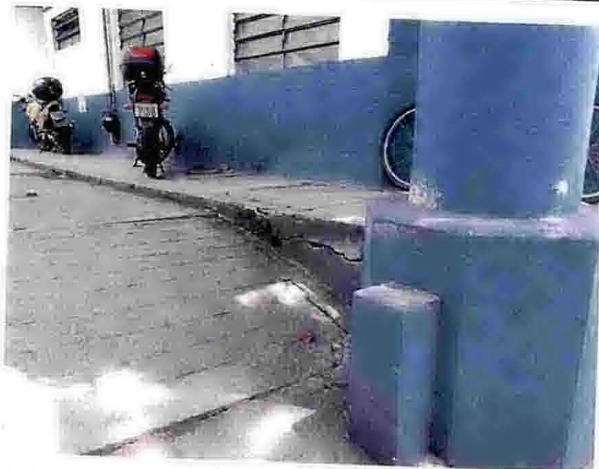
Foto 35 – Área próxima a cabine primária: o piso apresenta trincas e rachaduras.
