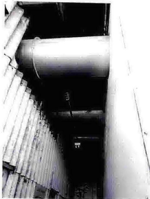
Foto 284 – Salas anexas a Cabine de pintura – Dutos dos filtros de ar.
