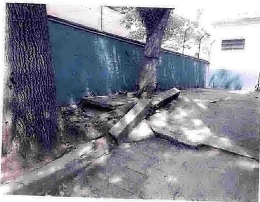
Foto 34 – Paisagismo próximo a cabine primária: o piso foi danificado pelas raízes da árvore.
