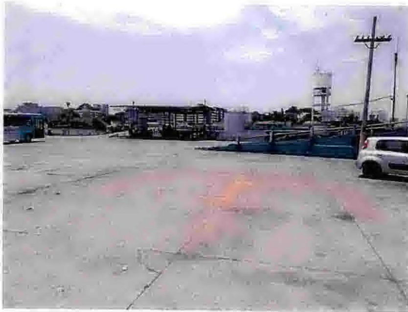
Foto 221 – Pátio: apresenta problemas no pavimento.
