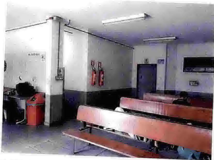
Foto 44 – Sala da reserva: apresenta problemas na pintura.
