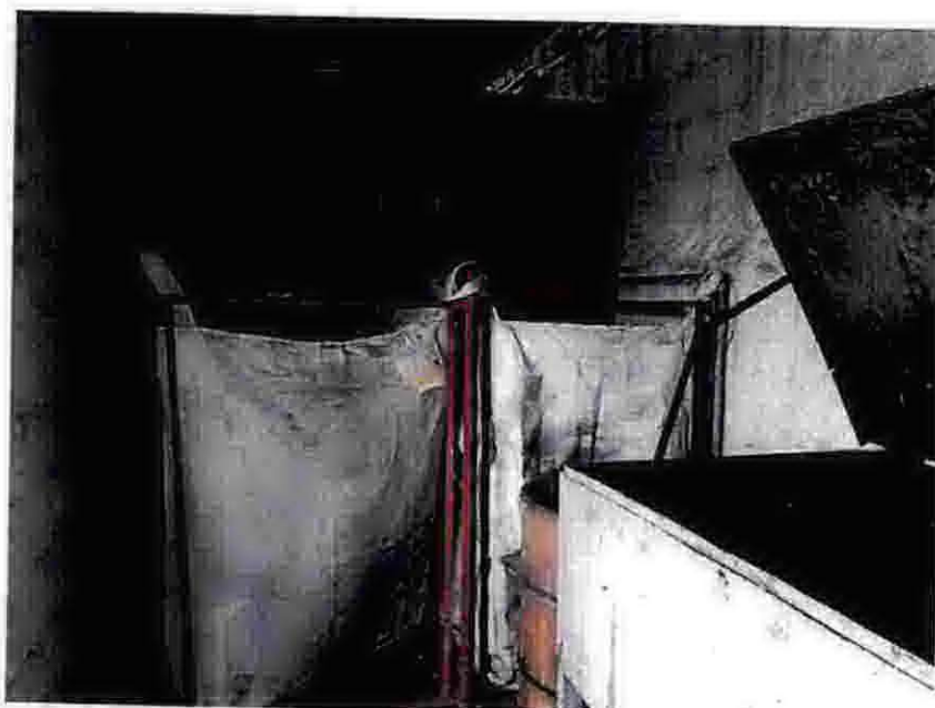
Fotos 296 – Sala de Coleta Seletiva: apresenta problemas na pintura.
