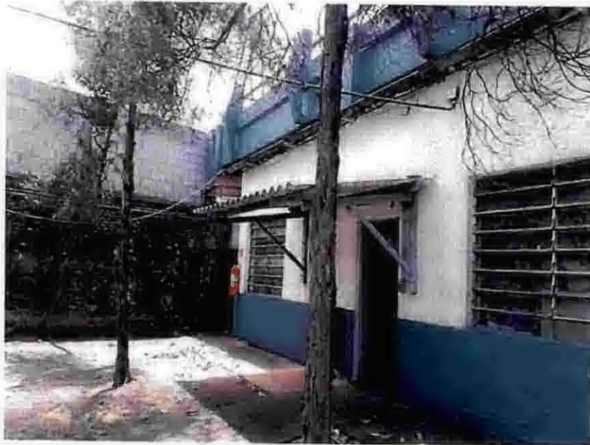
Foto 212 – Circulação – acesso às salas: apresenta problemas na pintura.
