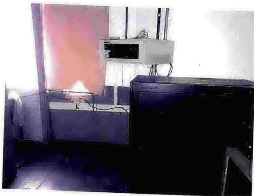
Foto 66 – Sala anexa à sala dos validadores e manutenção do AVL.
