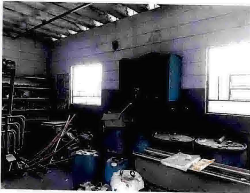
Fotos 343 – Área de Montagem de Motores: apresenta problemas na pintura.
