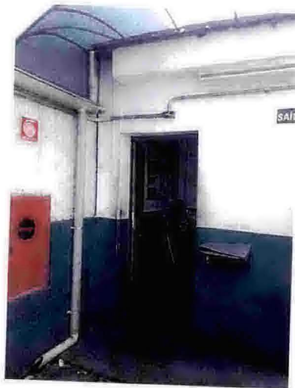
Foto 8 – Guarita apresenta problemas na pintura.
