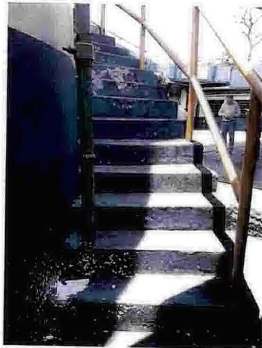
Foto 274 – Escada de acesso à casa de bombas: apresenta problemas na pintura.
