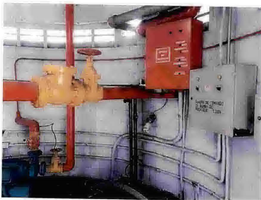
Foto 276 – Castelo D'água - Quadros de comando – bombas: as paredes apresentam problemas na pintura.
