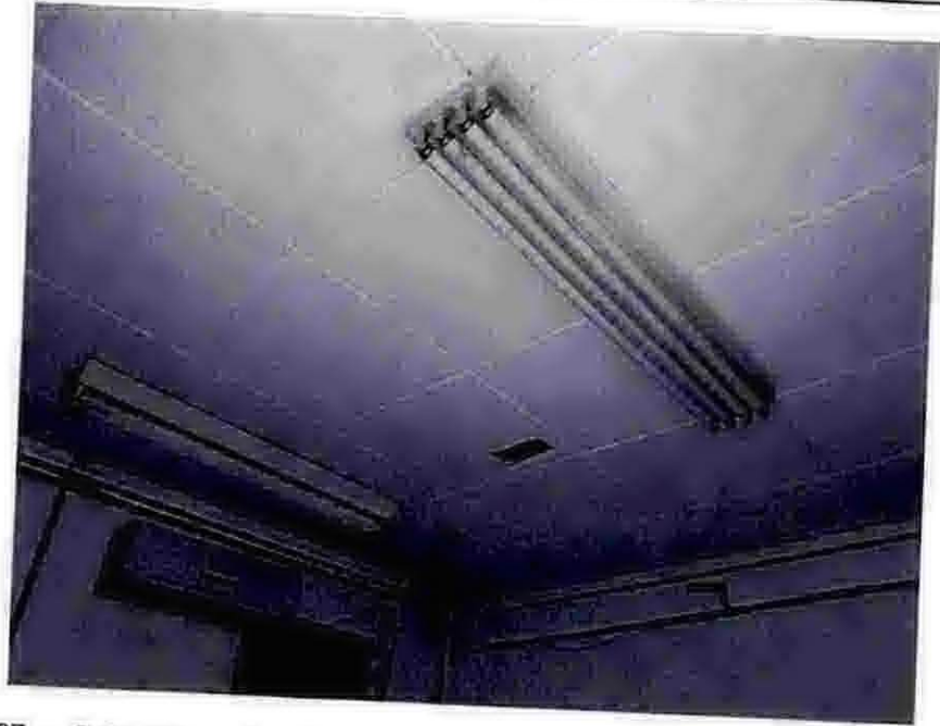
Foto 67 – Sala anexa à sala dos validadores e manutenção do AVL: apresenta buraco no forro de gesso.
