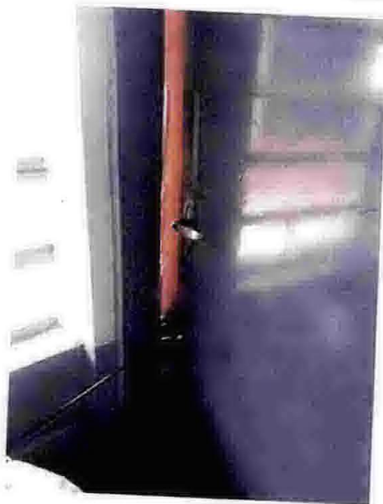
Foto 69 – Sala anexa à sala dos validadores e manutenção do AVL: porta impossibilitada de ser fechada devido a passagem de um cabo.
