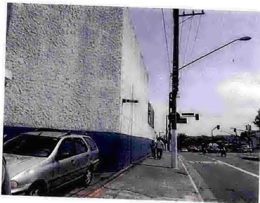
Foto 4 – Muro externo apresenta boas condições; pintura apresenta sinais de desgaste e sujeira.
