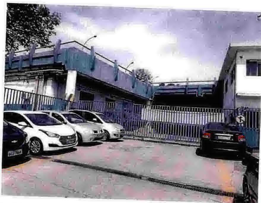
Foto 3 – Portão de saída dos veículos e estacionamento: grelhas para coleta de águas pluviais danificadas e pintura do portão em estado ruim.
