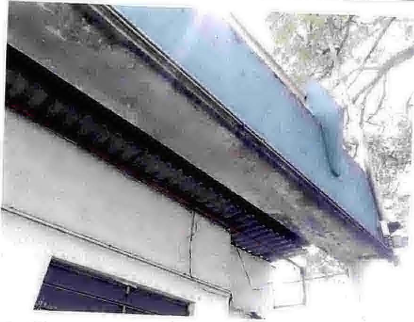
Foto 37 – Área próxima a cabine primária: borda do pátio de estacionamento apresenta problemas na pintura e umidade.
