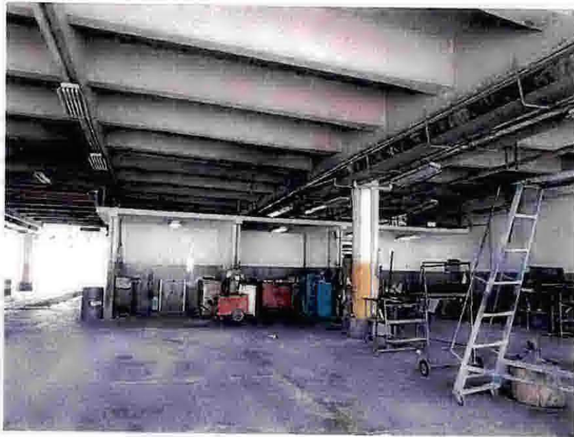
Fotos 324 – Oficina: apresenta problemas na pintura.
