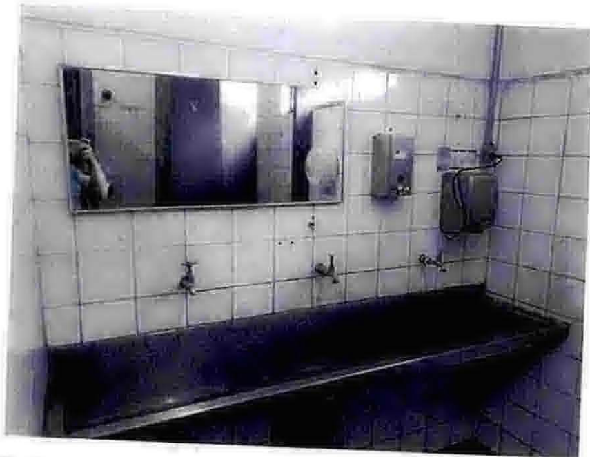
Foto 49 – Lavatório – sanitário feminino: problemas na pintura; azulejos danificados e furados.
