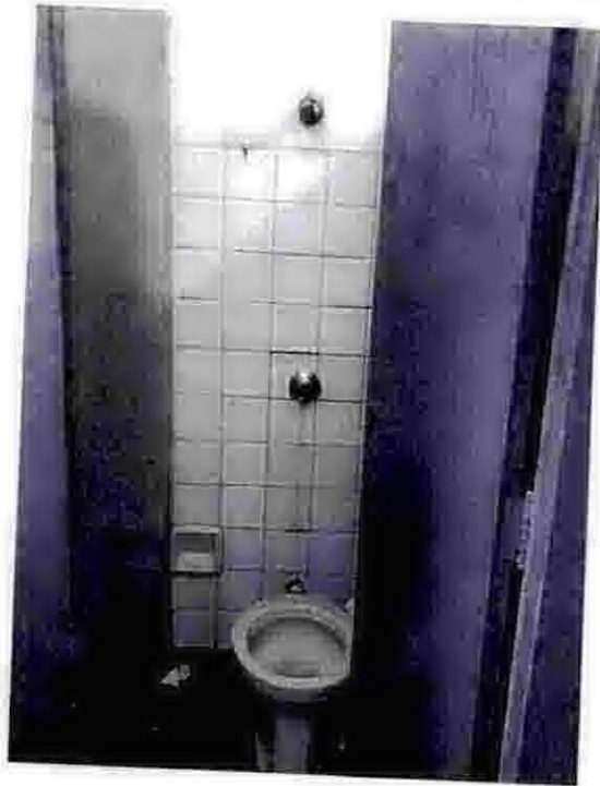
Foto 55 – Sanitário feminino – Cabine 02: presença de mancha nos azulejos indicando vazamento na válvula de descarga.
