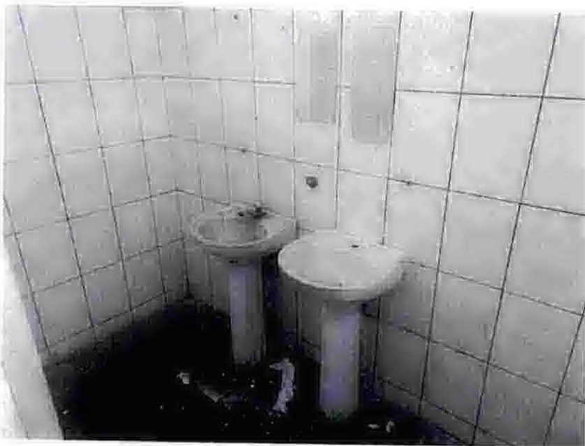
Fotos 346 – Sanitário da Oficina: apresenta furos no revestimento.
