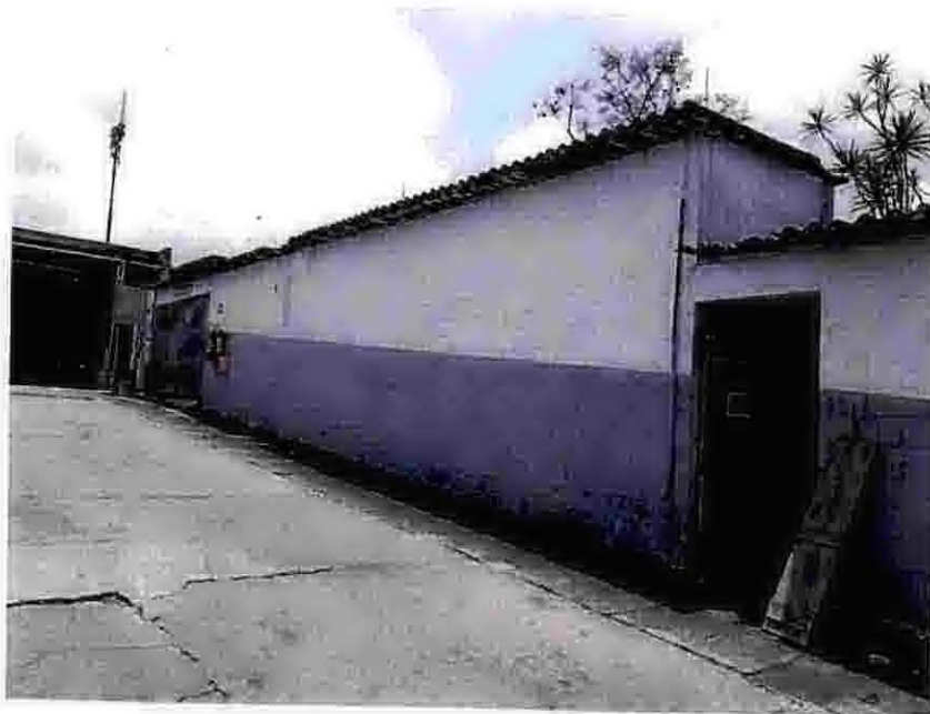
Fotos 291 – Sala da Manutenção Elétrica Predial e Setor de coleta de contaminados: apresenta problemas na pintura.
