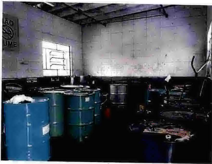
Fotos 345 – Depósito e Tanque de Óleo Lubrificante: apresenta problemas na pintura.
