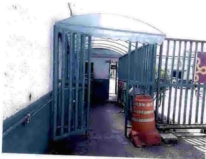
Foto 12 – Circulação junto a portaria: piso apresenta desgaste na pintura.
