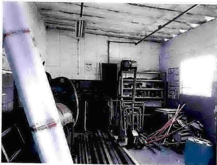
Fotos 342 – Área de Montagem de Motores: apresenta problemas na pintura.
