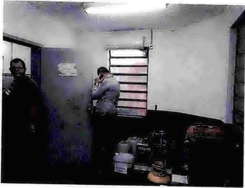
Fotos 301 – Sala Supervisor do Almojarifado: apresenta problemas na pintura.
