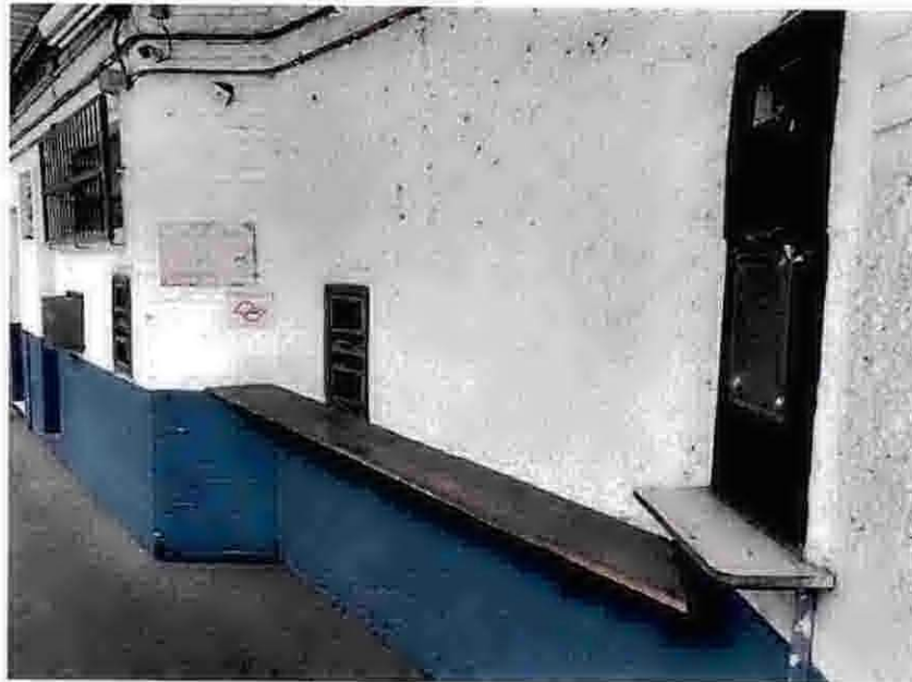
Foto 200 – Circulação – acesso às salas: apresenta problemas na pintura.
