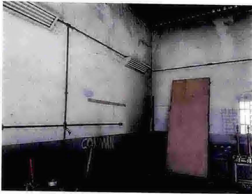
Foto 223 – Pátio – Depósito: apresenta problemas de infiltração e na pintura.
