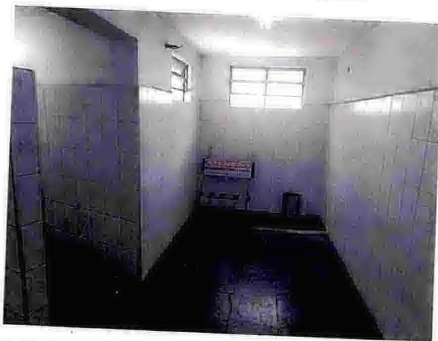
Foto 72 – Sanitário Masculino: apresenta problemas na pintura.
