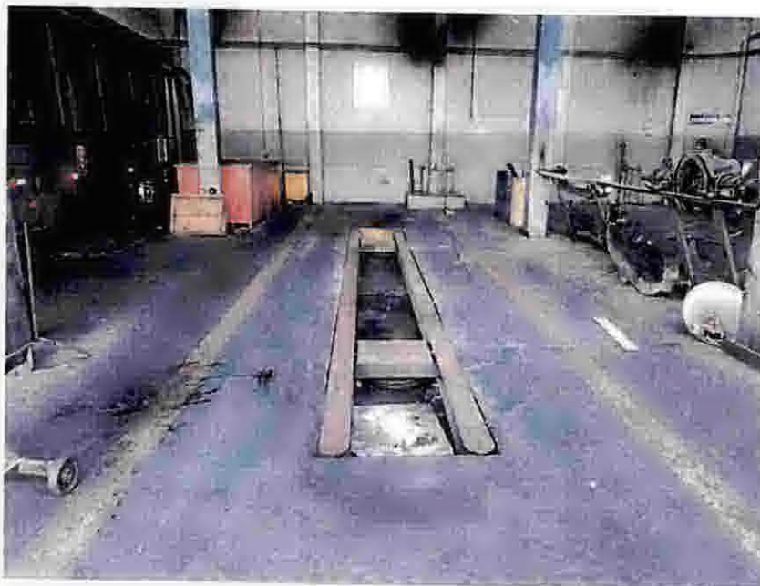
Fotos 331 – Área de Manutenção de AC e Motores: apresenta desgaste na pintura do piso.
