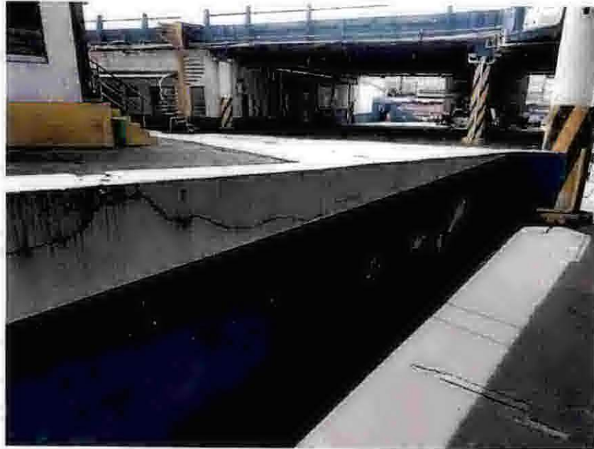
Foto 197 – Circulação – acesso às salas: apresenta trinca no muro e problemas na pintura.
