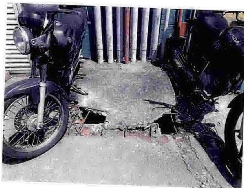
Foto 26 – Tampa da caixa de passagem de tubulação está danificada.
