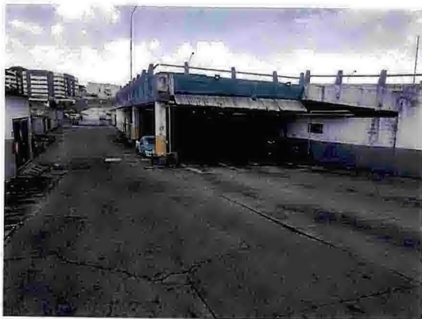
Foto 236 – Pátio – Rampa de acesso ao pátio: apresenta problemas no pavimento.
