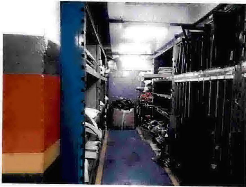
Fotos 307 – Almoarifado: apresenta problemas na pintura.
