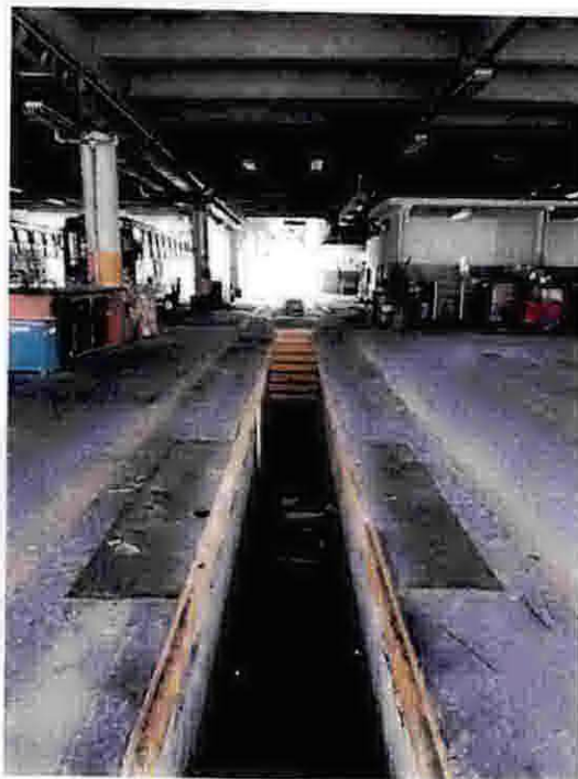
Fotos 325 – Oficina: apresenta problemas na pintura.
