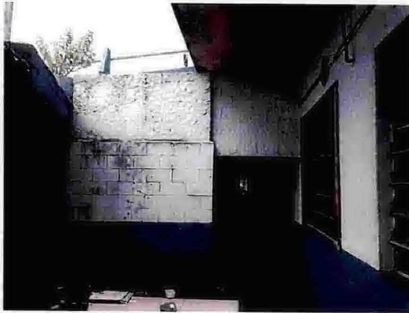
Foto 209 – Circulação – acesso às salas: apresenta problemas na pintura.
