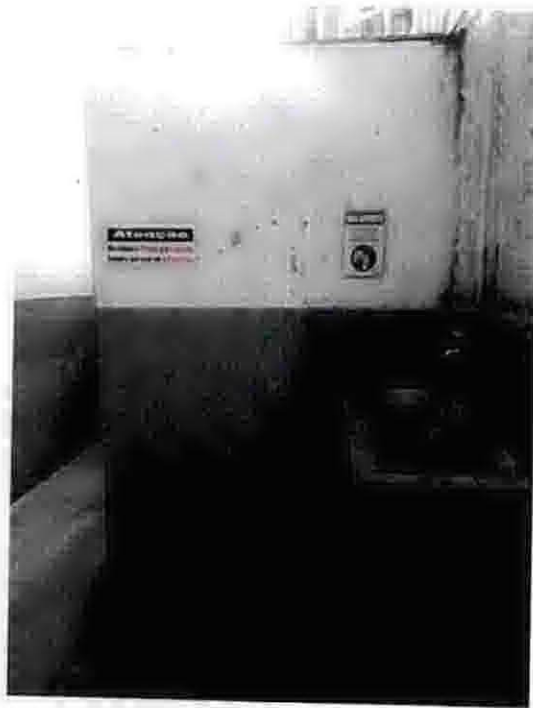
Foto 289 – Salas anexas a Cabine de pintura: apresenta problemas na pintura.
