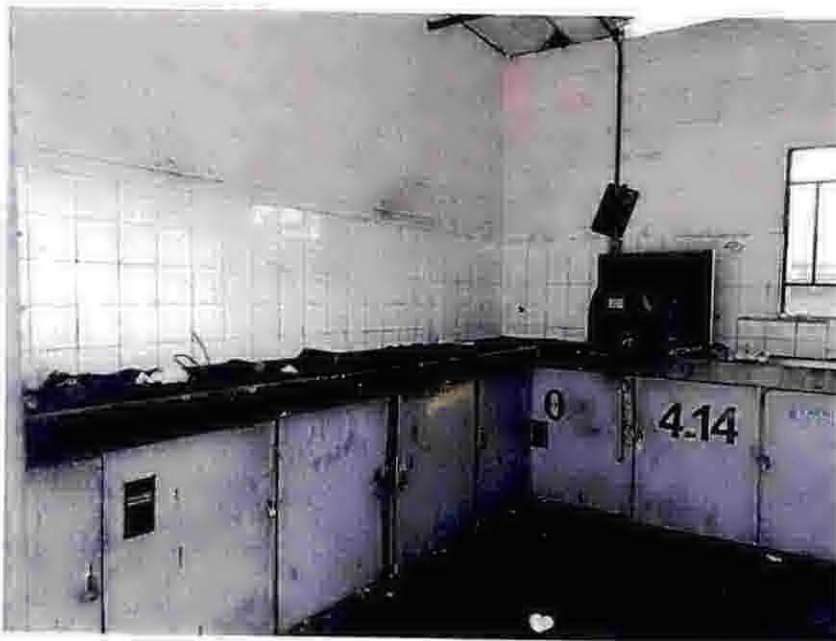
Fotos 340 – Área de Elétrica: apresenta problemas na pintura.
