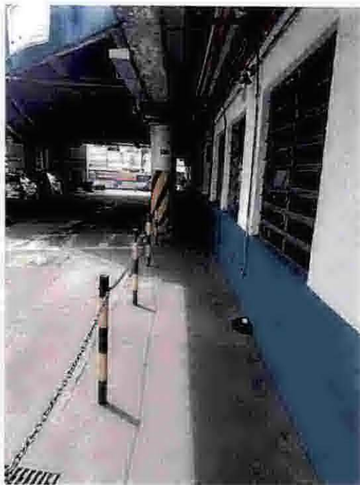
Foto 195 – Circulação – acesso às salas: apresenta problemas na pintura.
