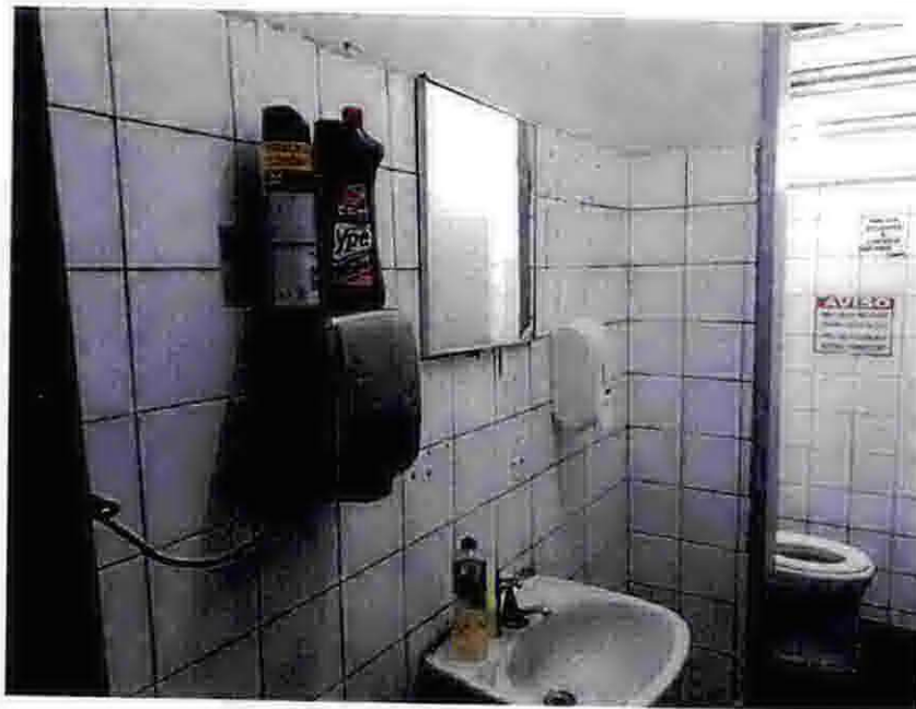
Fotos 319 – Sanitário anexo ao Controle de manutenção: apresenta furos no revestimento.
