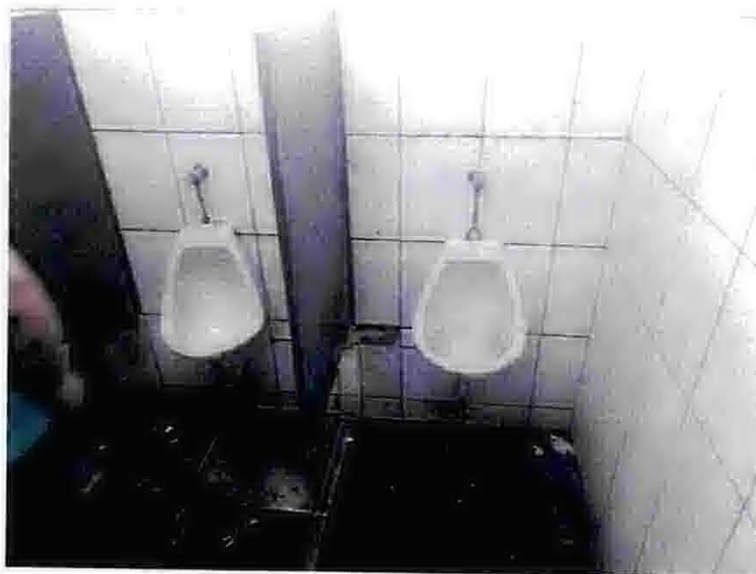
Fotos 348 – Sanitário da Oficina: apresenta problemas no revestimento cerâmico.
