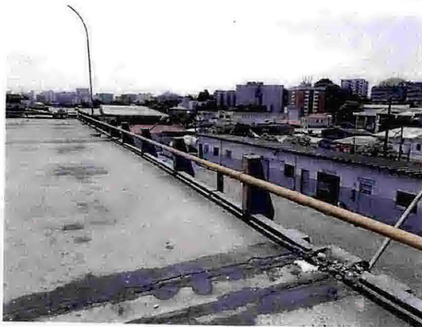
Foto 243 – Pátio elevado: apresenta problemas nas juntas do pavimento.
