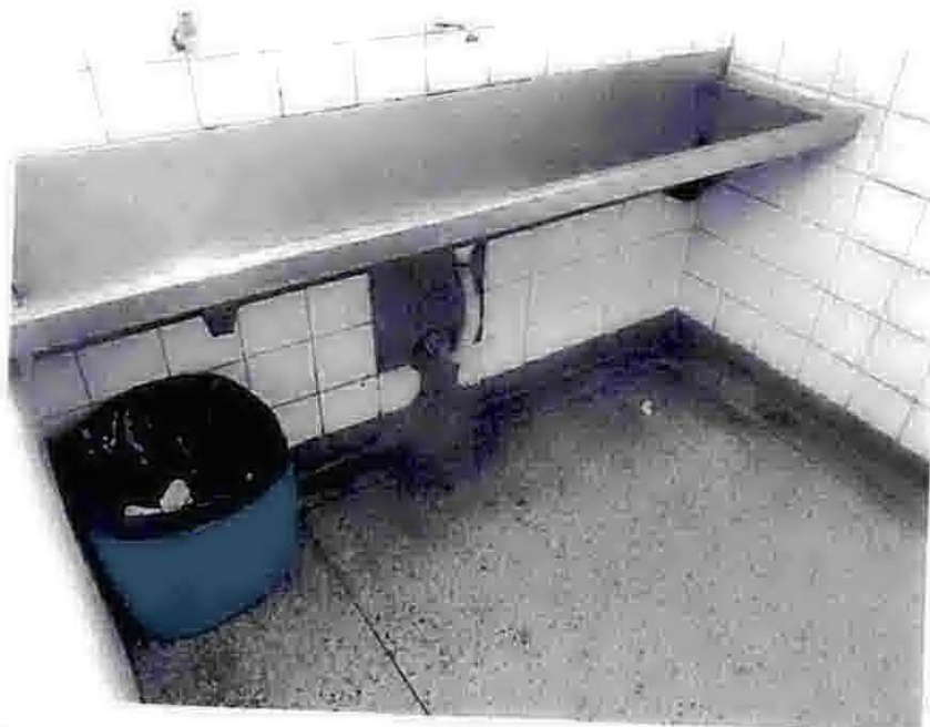
Foto 50 – Lavatório - sanitário feminino: parede sem acabamento, faltando revestimento.
