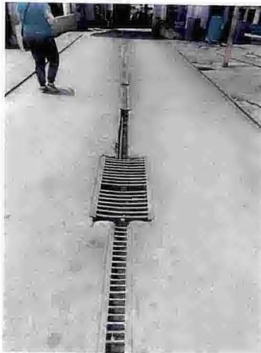
Foto 265 – Área de lavagem de veículos: grelha danificada.
