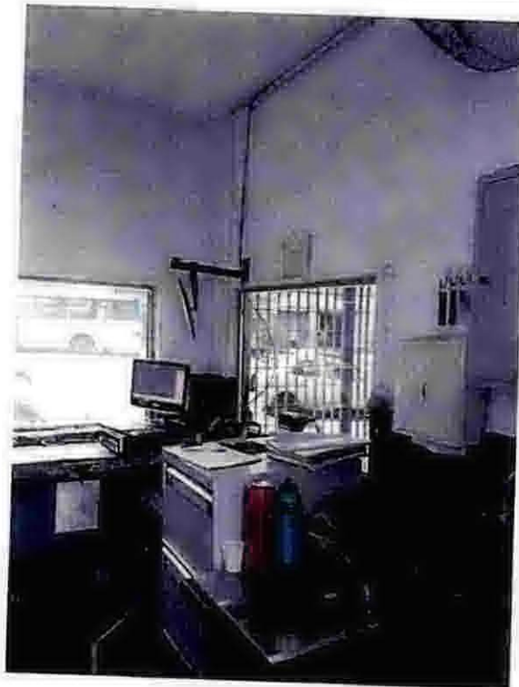
Fotos 9 e 10 – Vista interna da guarita: apresenta problemas na pintura.
