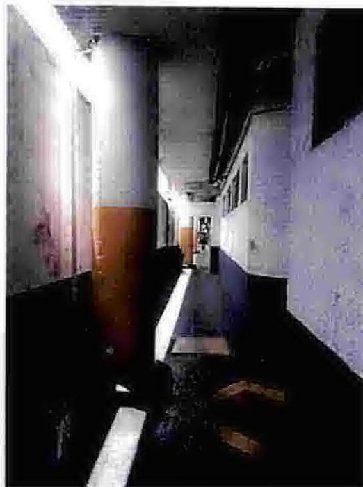
Foto 205 – Circulação – acesso às salas: apresenta problemas na pintura.
