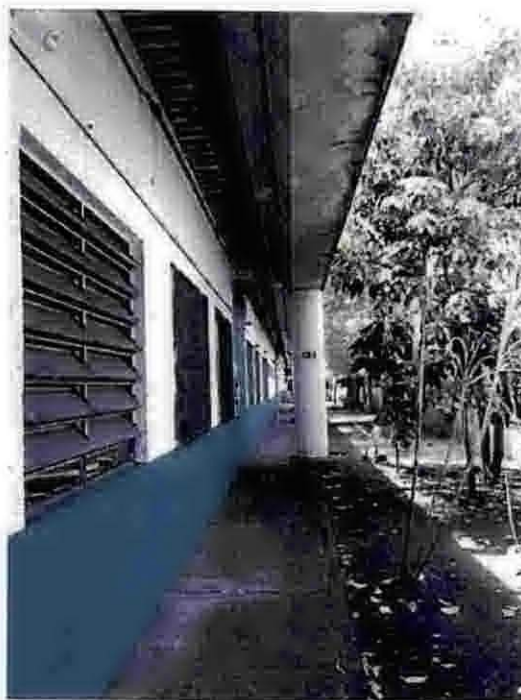
Foto 214 – Área Externa: apresenta problemas na pintura.
