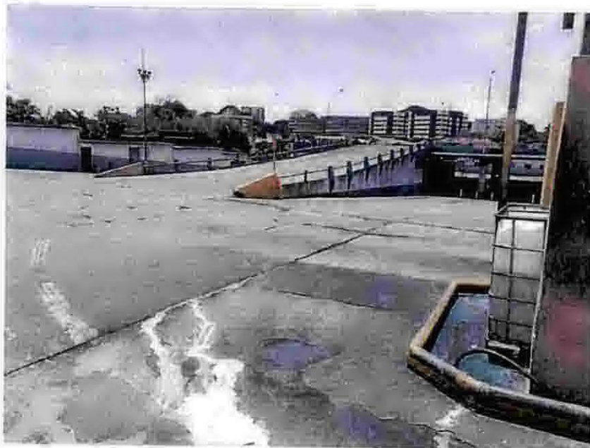
Foto 234 – Pátio – Rampa de acesso ao pátio elevado: apresenta problemas no pavimento.
