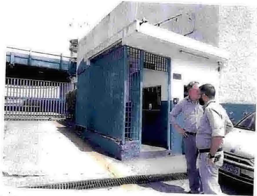
Foto 5 – Guarita apresenta fissuras na alvenaria e problemas na pintura.
