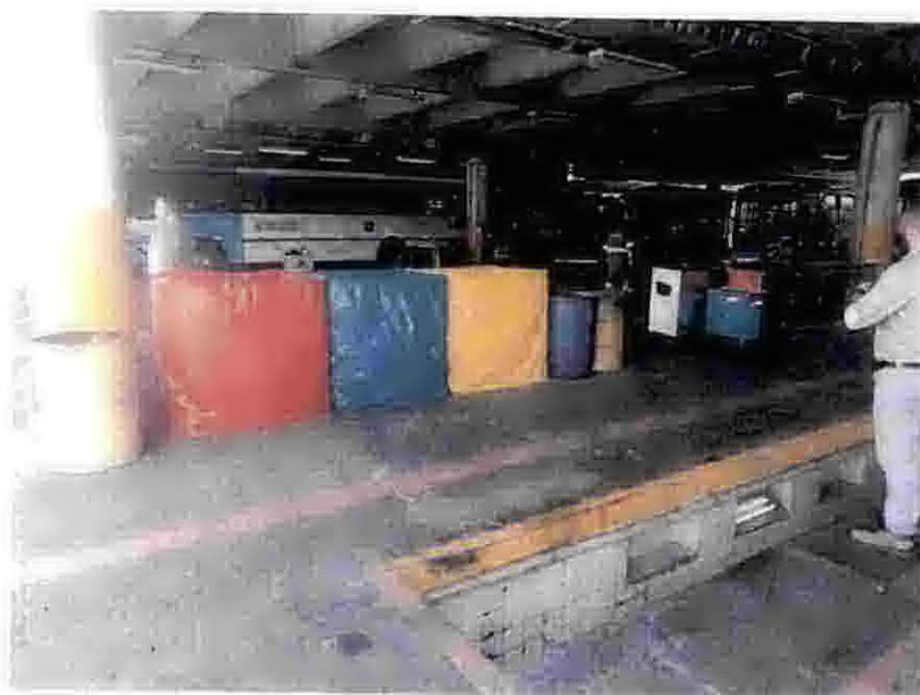
Fotos 326 – Oficina: apresenta problemas na pintura.
