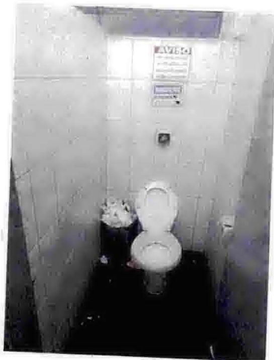
Foto 76 – Sanitário Masculino - Cabine 02.
