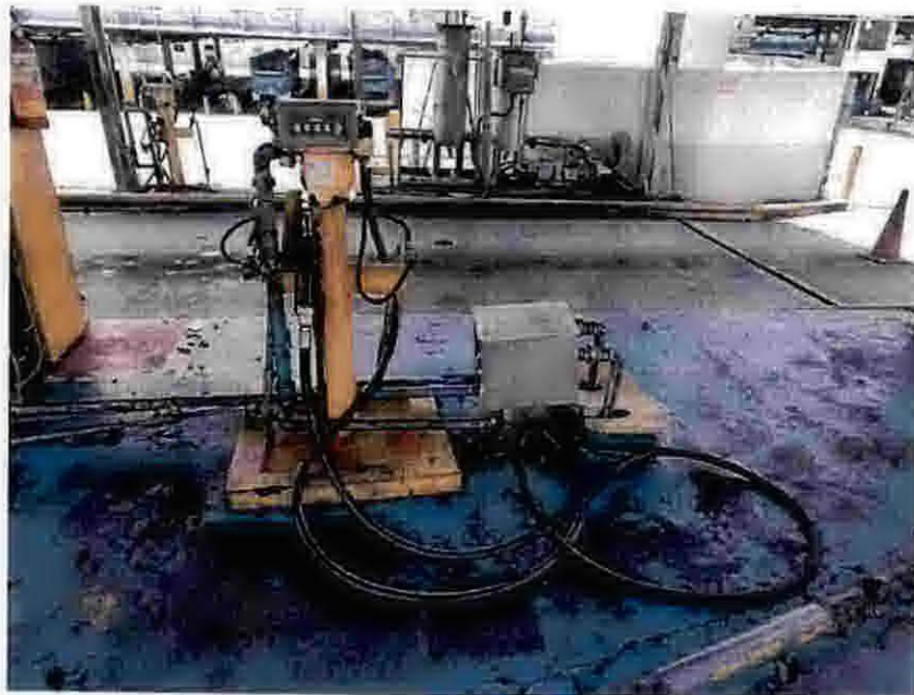
Foto 253 – Área de abastecimento: apresenta desgaste na pintura do piso.
