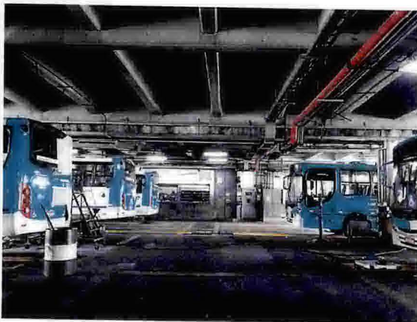
Fotos 329 – Oficina: apresenta problemas na pintura.
