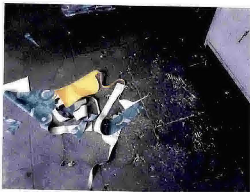
Fotos 352 – Tapeçaria: apresenta piso danificado.
