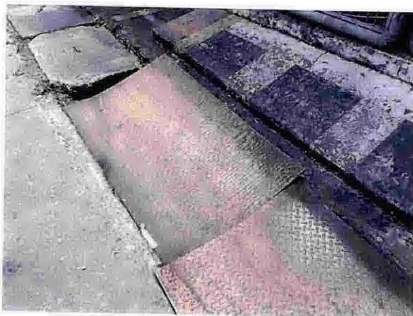
Fotos 298 – Depósito de Pneus: chapa metálica na entrada do depósito está solta.
