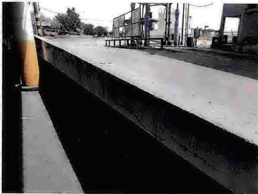
Foto 198 – Circulação – acesso às salas: apresenta trinca no muro e problemas na pintura.
