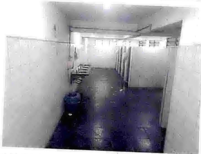
Foto 73 – Sanitário Masculino: apresenta problemas na pintura.
