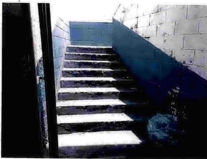
Foto 218 – Circulação – Escada de acesso ao pátio: apresenta problemas na pintura.
