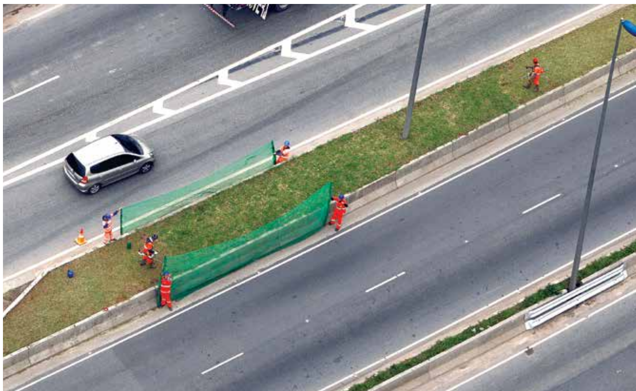
Acima e na outra página: mutirão da zeladoria para varrição, limpeza de bueiros, poda de árvores e tapa buracos no canteiro central da Marginal Tietê.
