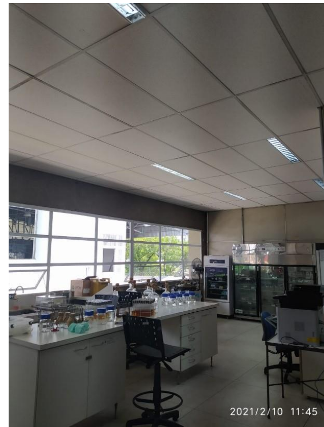
Reforma de laboratório – seção microbiologia (reforma elétrica, instalação de forros e luminárias, janelas instaladas aguardando acabamento)
