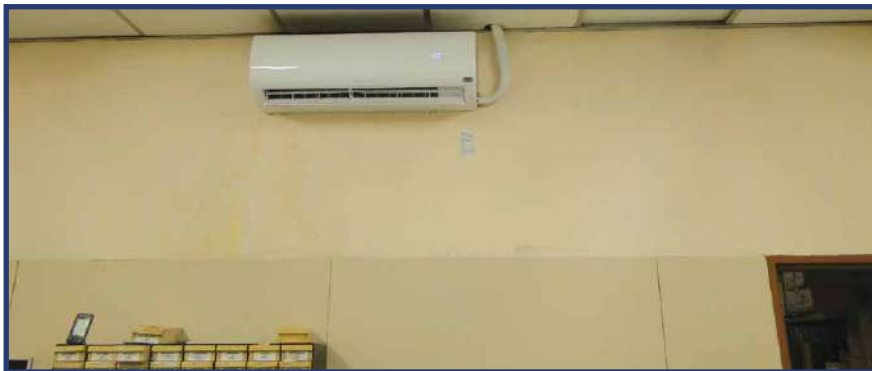
Um dos aparelhos instalados na Farmácia do Hospital
