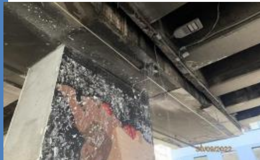
Junta de dilatação com percolação de água
