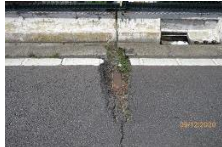
Junta de dilatação recoberta e com fissuras no pavimento flexível.
