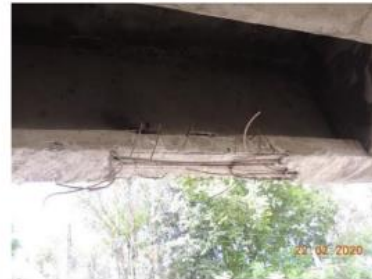
Concreto disgregado com rompimento de armadura principal na viga longitudinal VL8.
