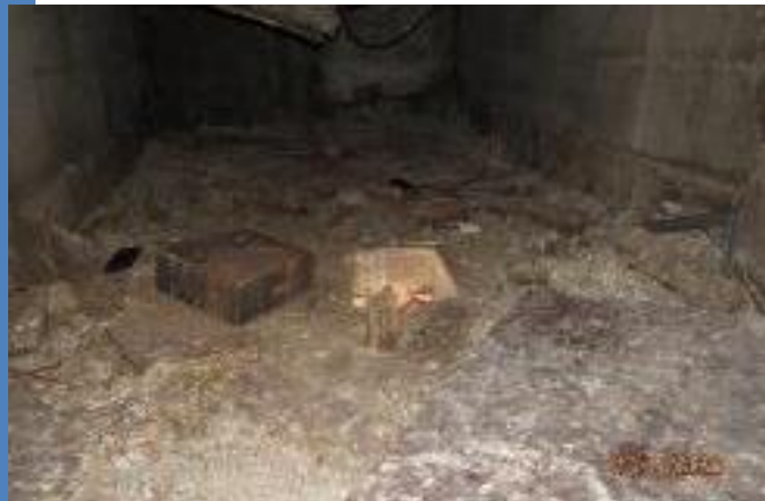
Vista interna dos caixões apresentando restos de fôrmas, pontas de aço e manchas de umidade.
