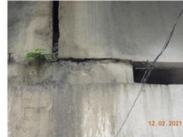
Aparelho de apoio esmagado na linha de apoio 7.
