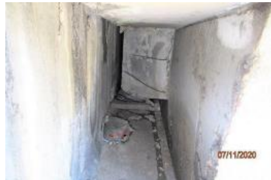
Aparelho de apoio em neoprene fretado esmagado sob viga longarina.
