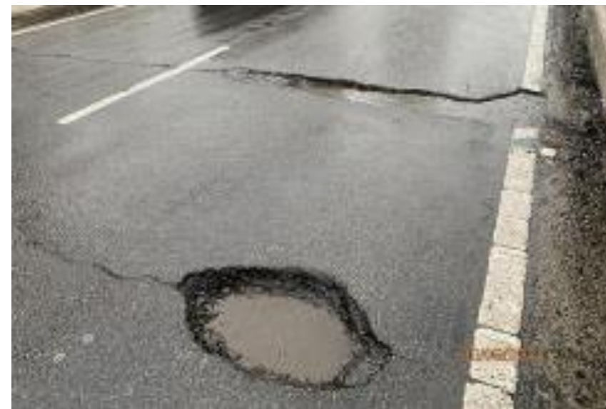
Buracos no pavimento flexível, próximos às juntas de dilatação após a ocorrência de fortes chuvas.
