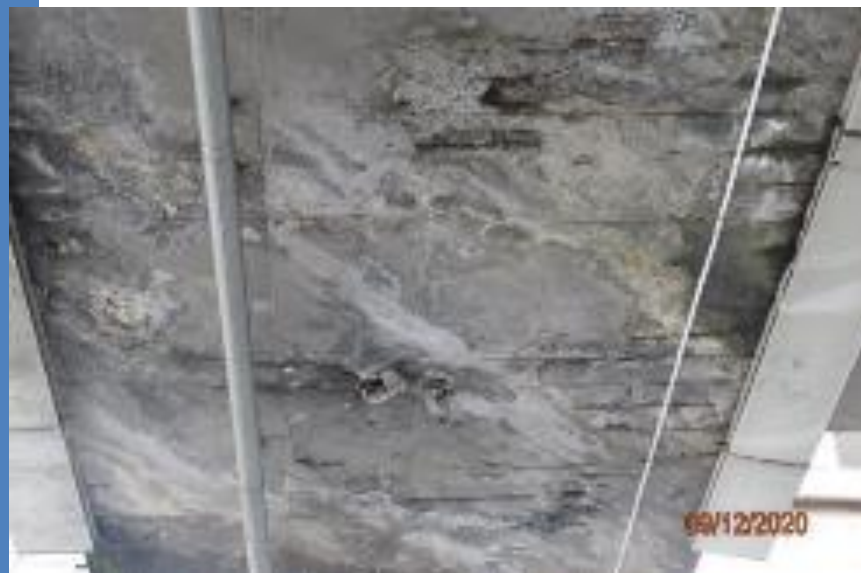
Fissuras aleatórias com eflorescência, concreto disgregado com armadura exposta e corroída, manchas de umidade e eflorescência na viga travessa.
