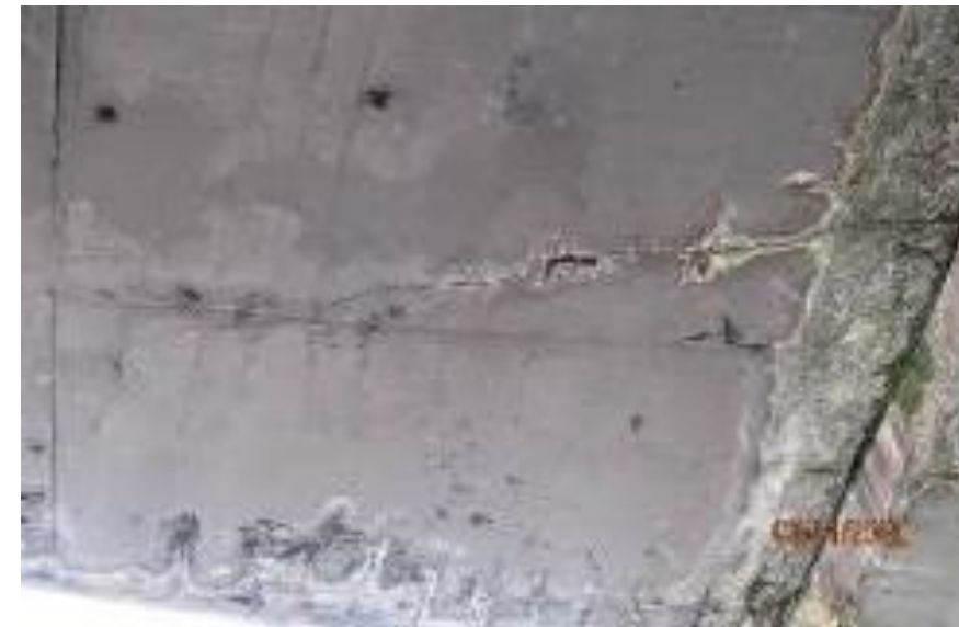
Fissuras diagonais com eflorescência e manchas de umidade e eflorescência na laje inferior.
