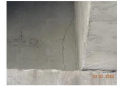
Fissura com abertura maior que 0,3mm na viga transversina do apoio 4.
