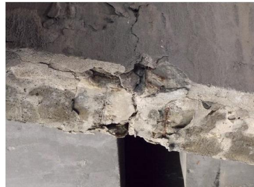
Danos causados na viga transversina após colisão com um caminhão.
