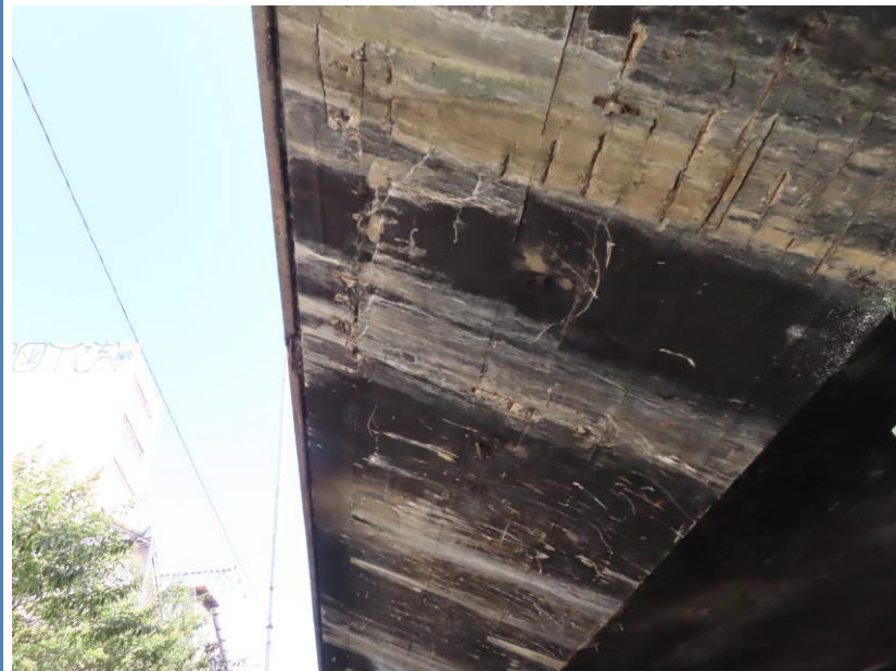
Concreto disgregado com armadura exposta e corroída em área que sofreu danos por incêndio.
