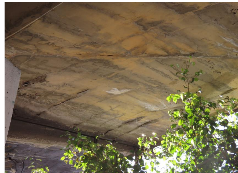
Fissuração do concreto e armaduras expostas na laje inferior.
