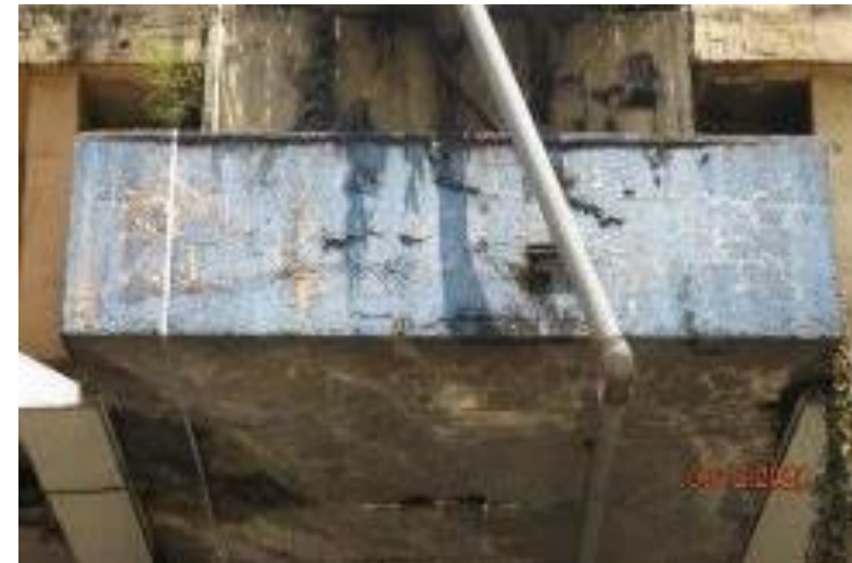
Quadro fissuratório na viga travessa.
