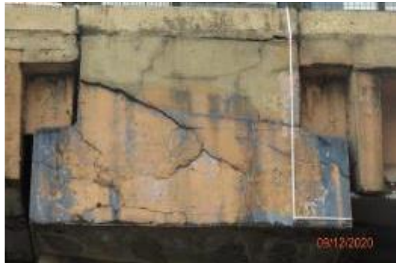
Ruptura do concreto na viga travessa.
