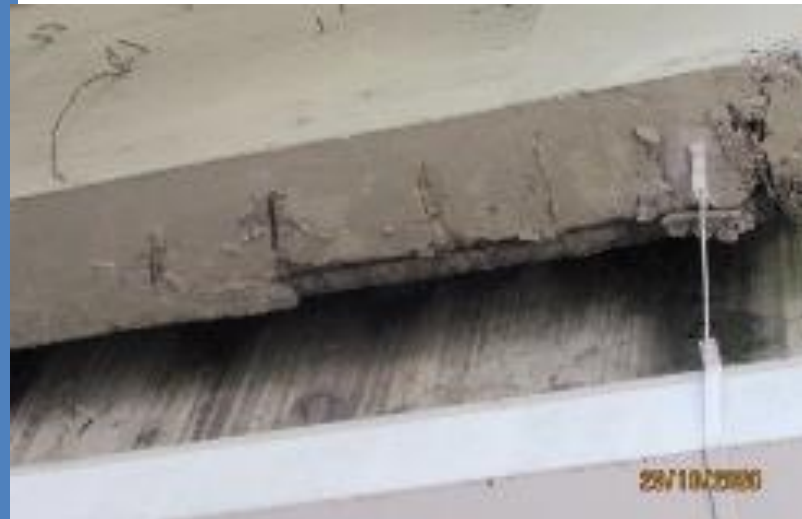
Concreto disgregado com armadura exposta e corroída na viga transversina.
