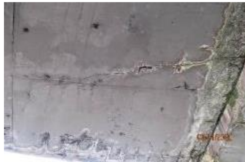
Fissuras diagonais com eflorescência e manchas de umidade e eflorescência na laje inferior.
