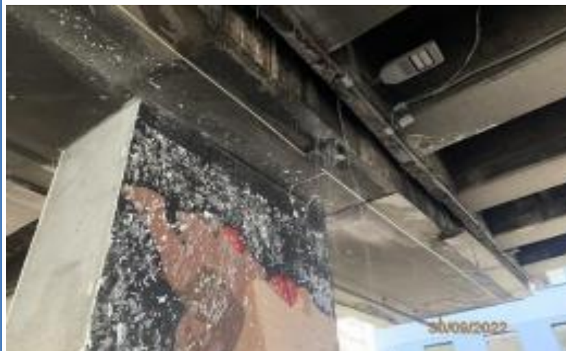
Junta de dilatação com percolação de água
