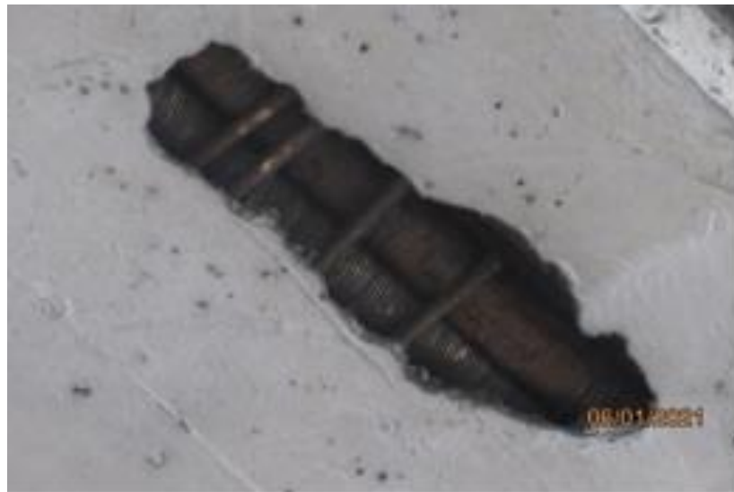
Concreto segregado com protensão exposta em viga longarina.
