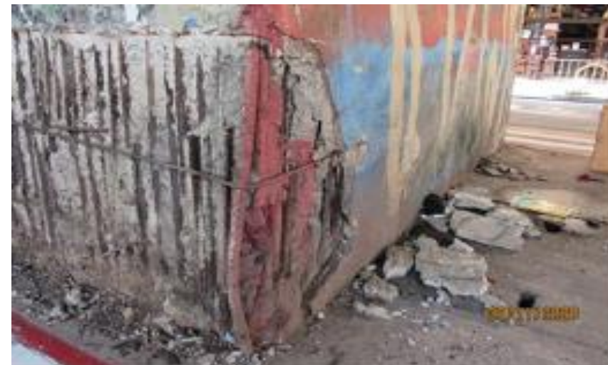
Concreto disgregado com armadura exposta e corroída na base do pilar.
