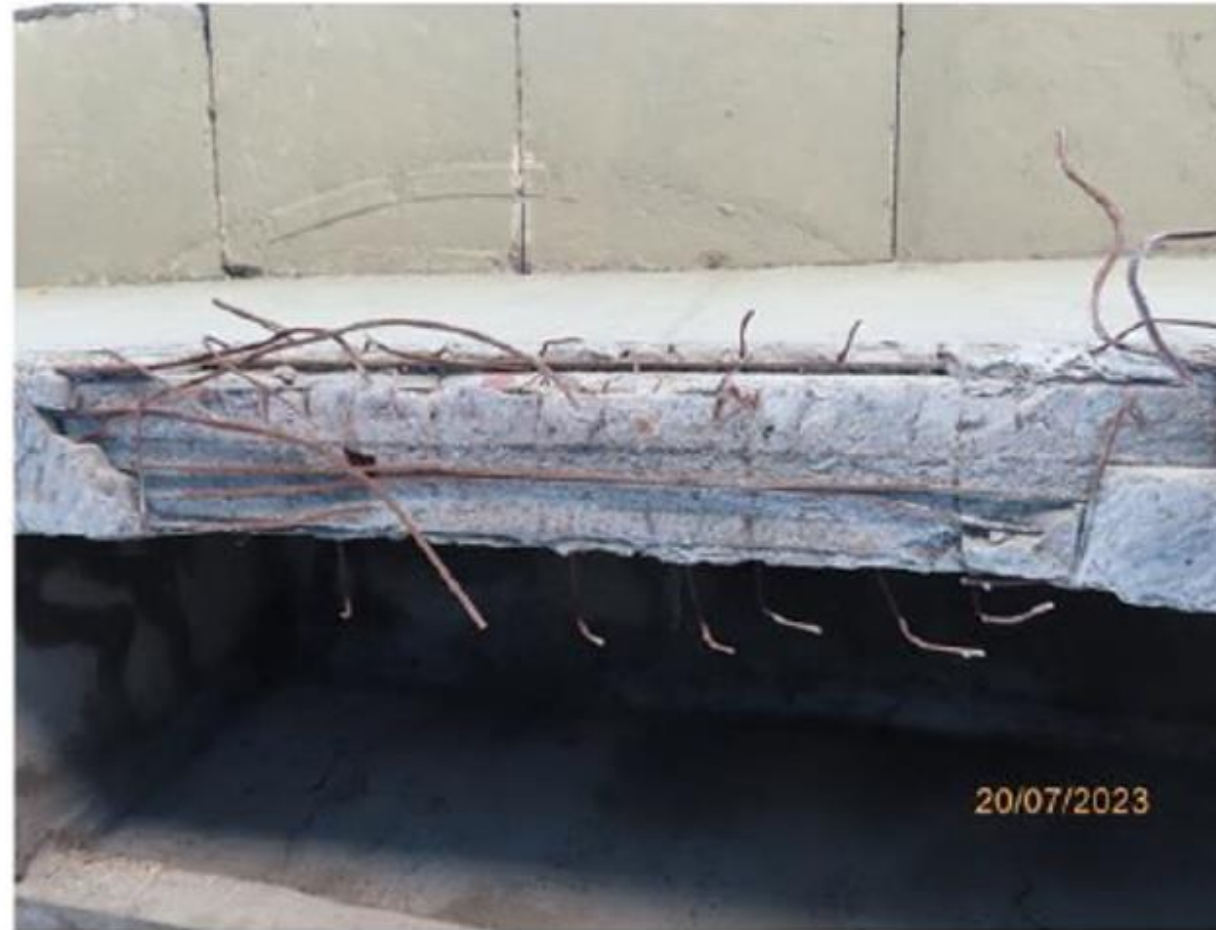
Viga Longarina com armaduras principais rompidas.
