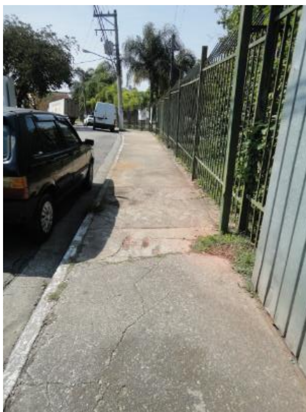
Figura 23: Entrada, Gradil e Muros. Avarias no gradil e passeio. Fonte: Urbia Gestão de Parques
