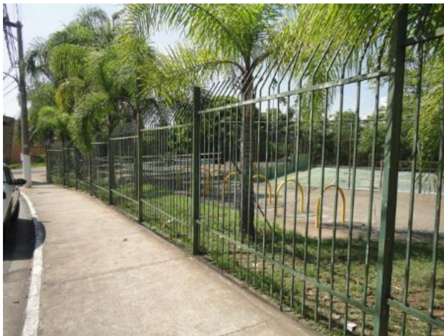
Figura 22: Entrada, Gradil e Muros. Avarias no gradil, pintura necessitando de manutenção. Fonte: Urbia Gestão de Parques
