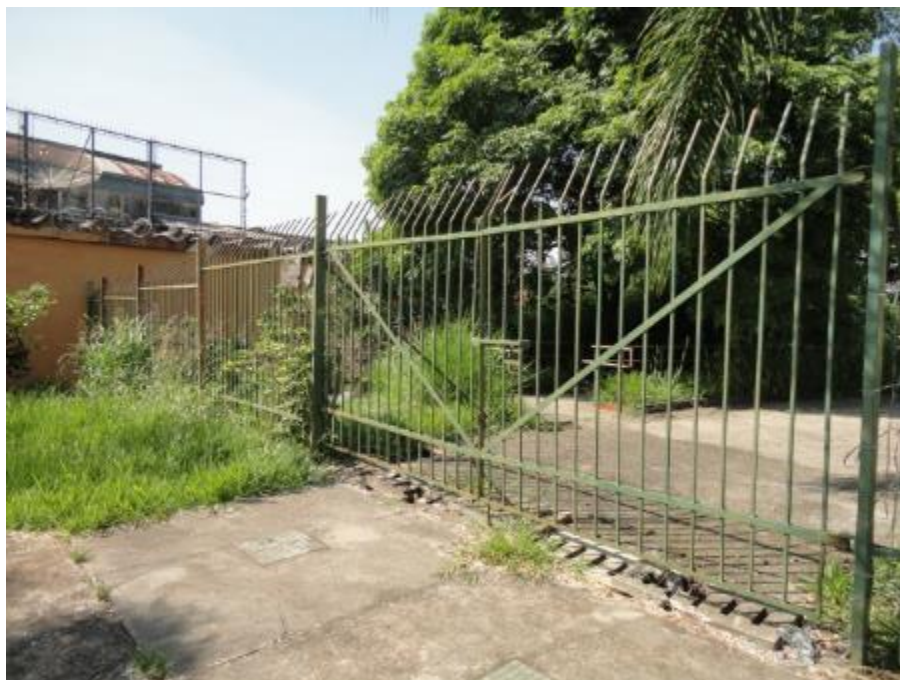
Figura 24: Entrada, Gradil e Muros. Avarias no gradil e passeio. Fonte: Urbia Gestão de Parques
