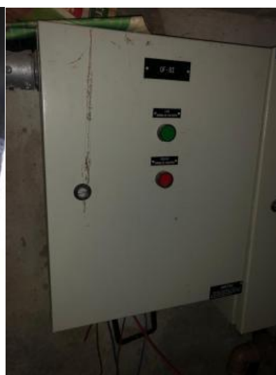
Imagem 43: painel da bomba de incêndio
