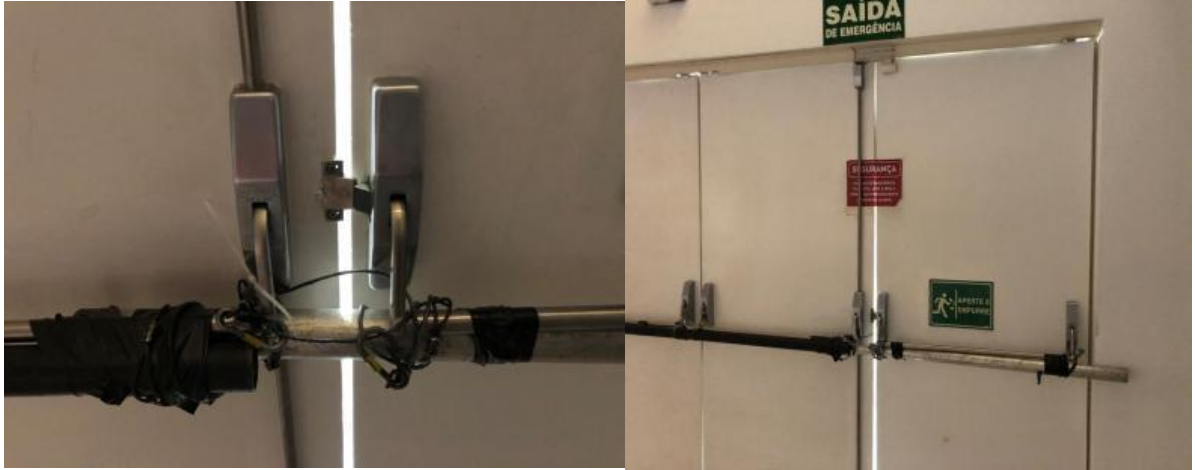
Imagens 96 e 97: Saída de emergência trancada.
