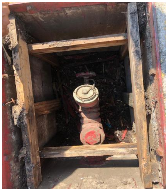
Imagem 10: Registro de recalque localizado na frente da oca no térreo.
