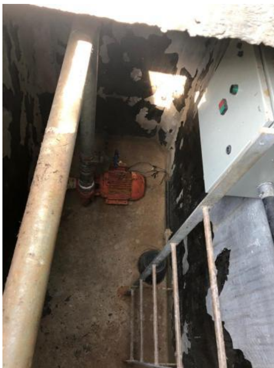
Imagem 53: Bomba e painel de incêndio
