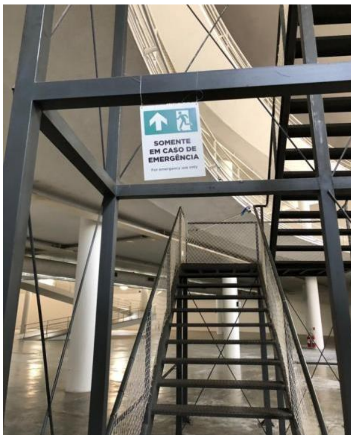
Imagem 13: A placa de indicação siga em frente não possui indicação do nome do fabricante ou CNPJ e não possui fotoluminescência.
