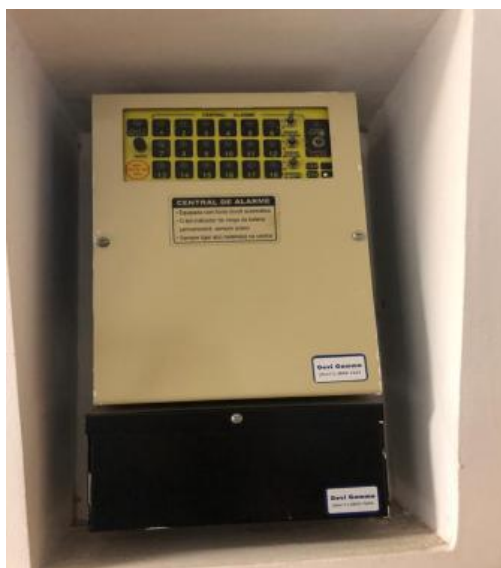
Imagem 64: Central de alarme de incêndio convencional.
