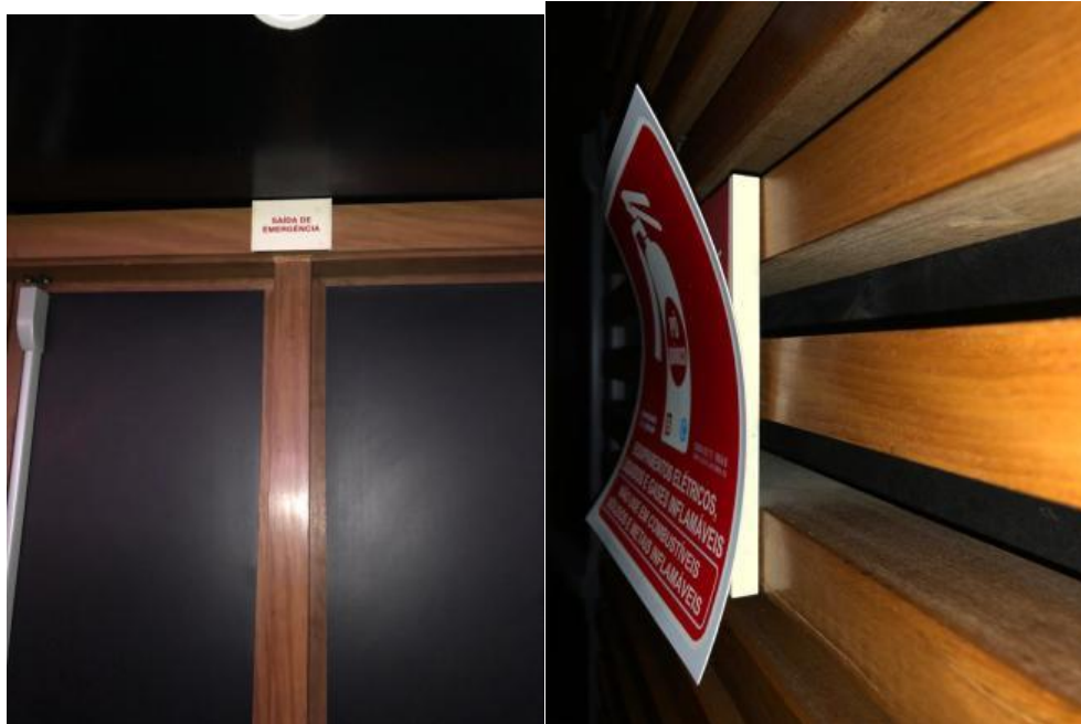
Imagem 54: Placa não fixada corretamente Imagem 55: Sinalização de saída de emergência irregular
