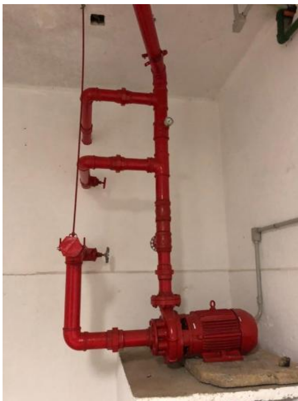
Imagem 34: Bomba principal do sistema de hidrantes.
