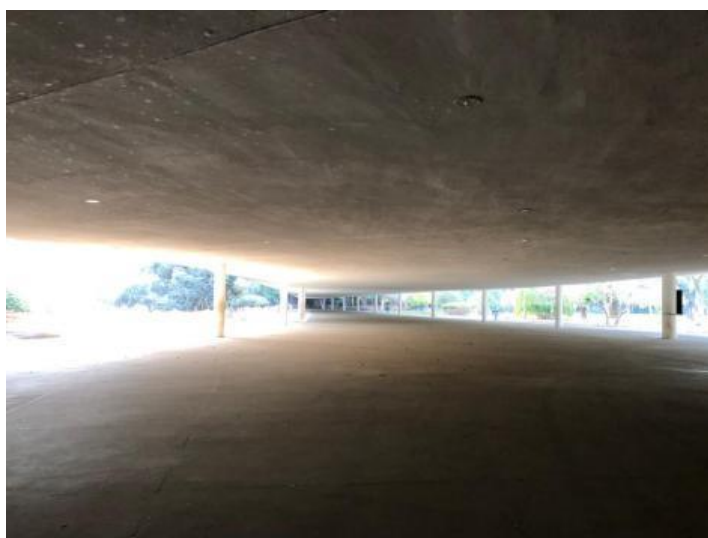
Imagem 67: Marquise não possui nenhum sistema / equipamento de segurança contra incêndio.
