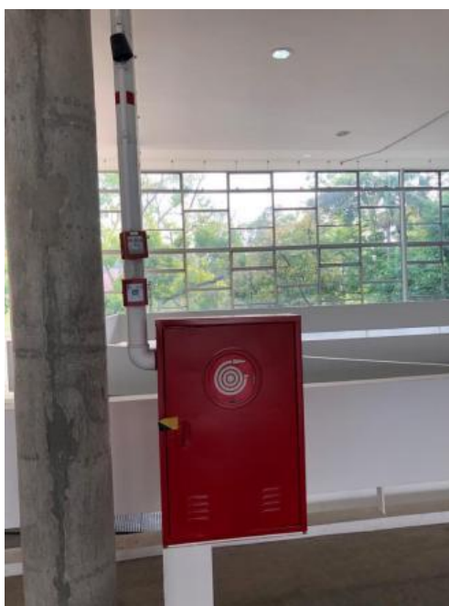
Imagem 38: Acionador manual está instalado a 1,60m do piso acabado.
