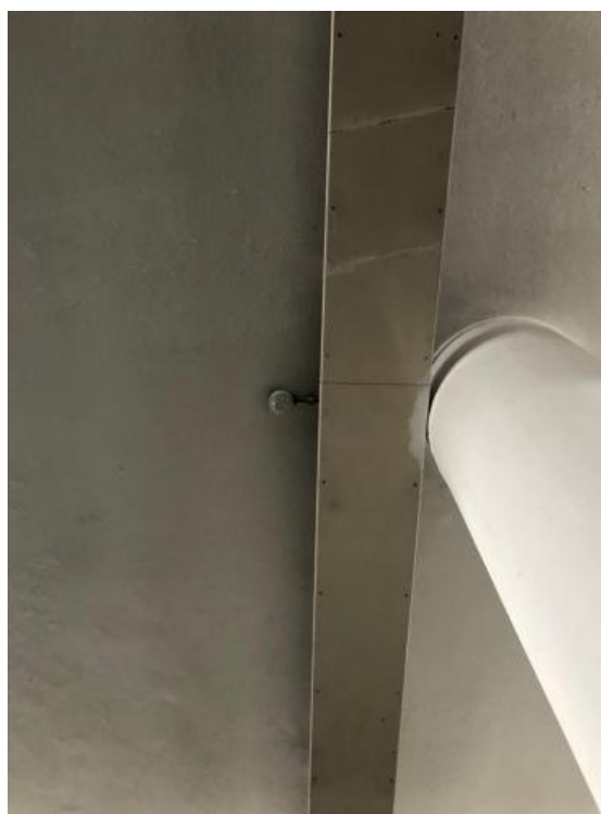
Imagem 02: Detector de fumaça obstruído.
