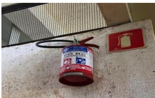
Imagem 51: extintor em área de difícil acesso no térreo próximo a central de GLP.
