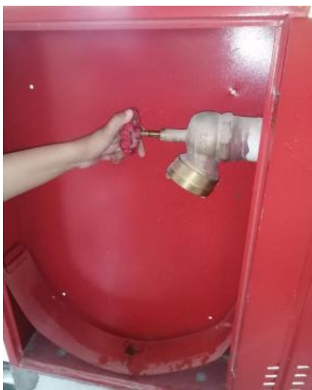
Imagem 33: Válvula Globo Angular aberta, sem água no sistema de hidrantes.
