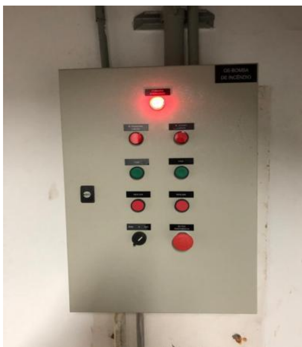
Imagem 20: Painel das bombas de incêndio em funcionamento.
