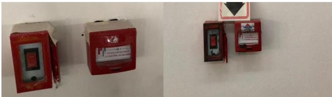
Imagem 18 e 19: Acionador manual e Botoeira liga e desliga da bomba de incêndio colados com fita crepe.
