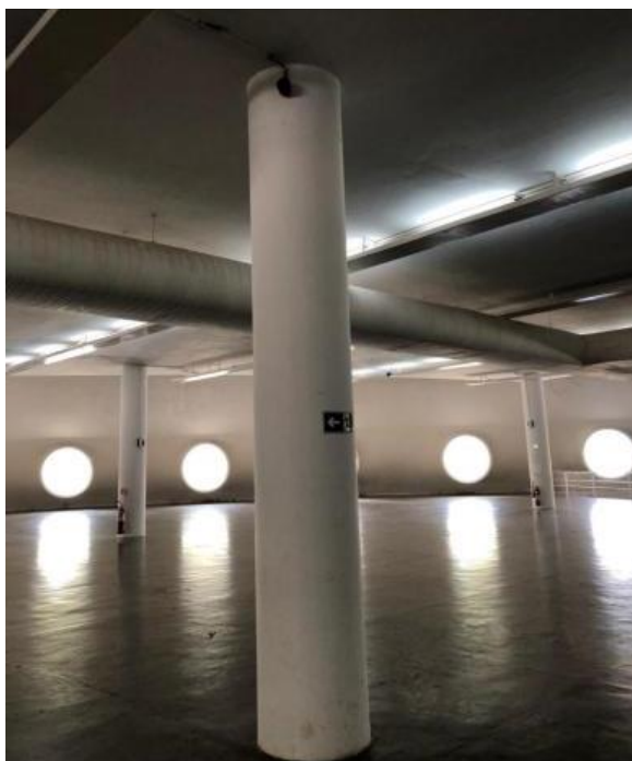
Imagem 03: Sinalizador audiovisual instalado a 3,80m do piso acabado.
