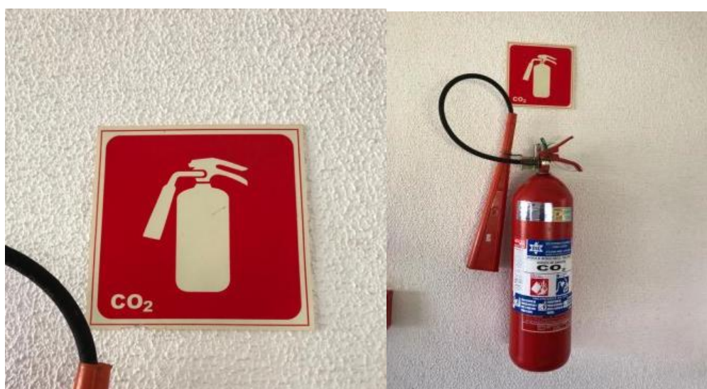
Imagem 48 e 49: a esquerdo extintor instalado com placa irregular, a direita a placa de sinalização em questão sem CNPJ ou identificação do fabricante.
