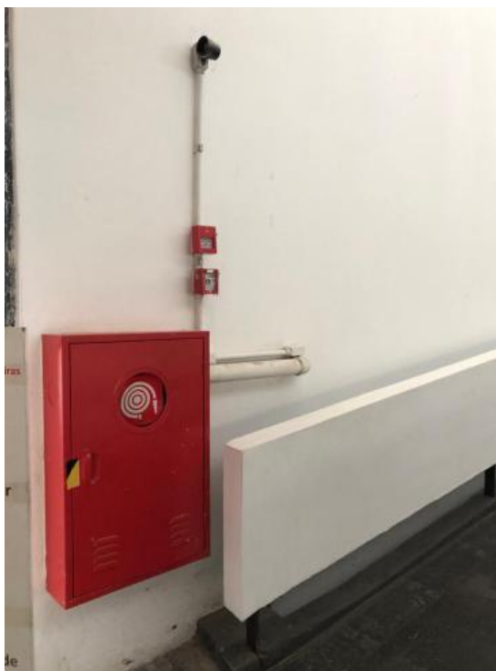
Imagem 41: Hidrante no término de rampa de passagem/acesso.
