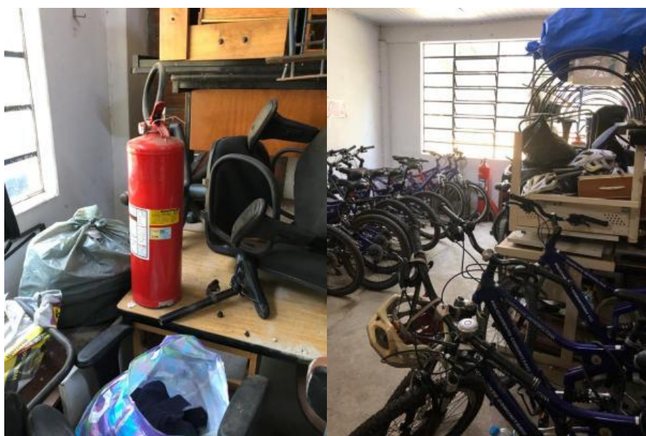
Imagem 83 e 84: Extintores obstruídos, vencidos e não estão instalados.
