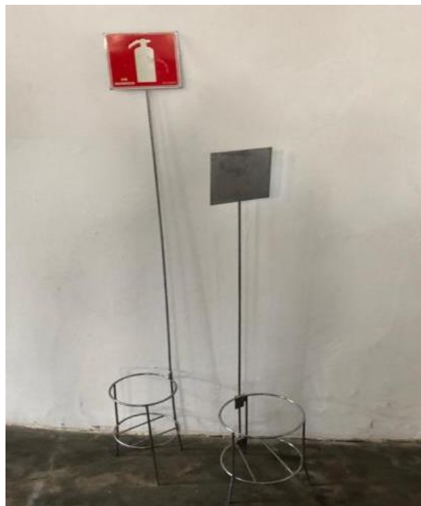
Imagem 23: Suportes de extintores sem extintores.
