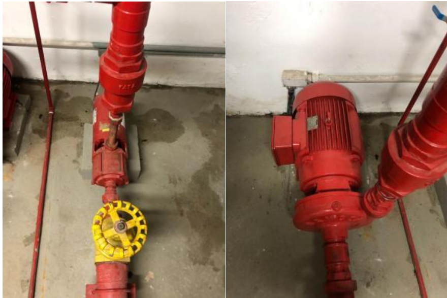
Imagem 21 e 22: A esquerda bomba principal e a direita bomba jockey.
