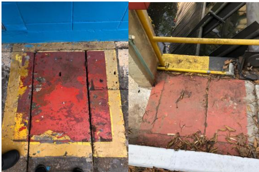
Imagem 68 e 69: Pintura de solo deteriorada.
