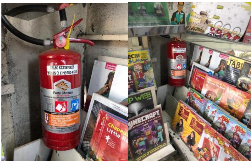
Imagem 85 e 86: Extintor de PQS despressurizado e obstruído.
