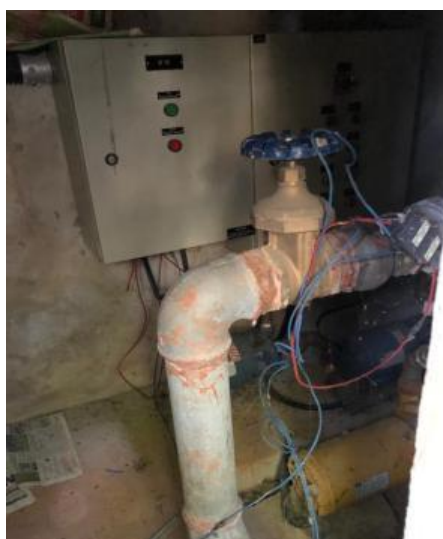
Imagem 42: Bomba e painel de incêndio
