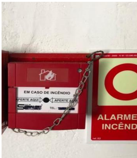
Imagem 12: Acionador manual e placa do acionador na altura incorreta.
