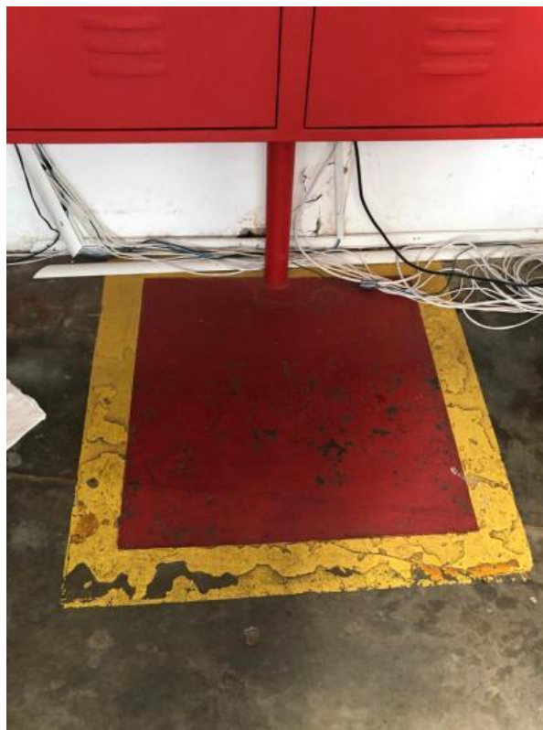
Imagem 05: pintura de solo defasada.
