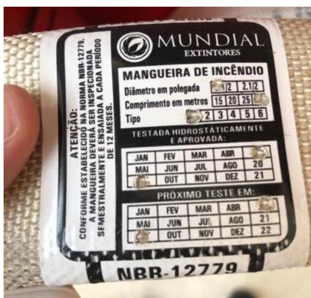
Imagem 04: Marcação de mangueira do hidrante vencida e do tipo 1.
