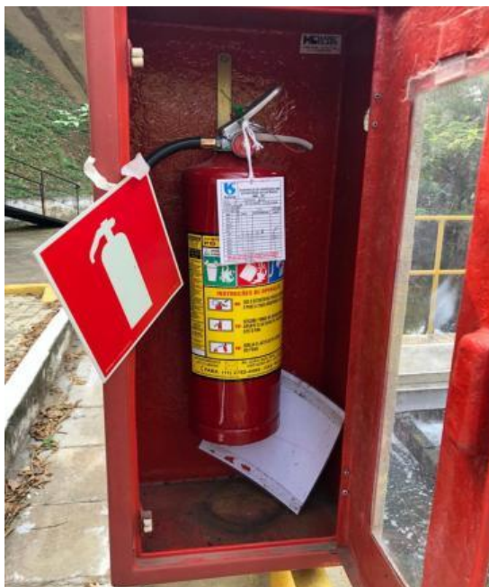
Imagem 71: Placa de extintor fotoluminescente fixada incorretamente.
