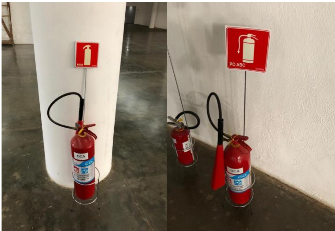
Imagem 16: à esquerda Extintor de CO2 com placa de Pó ABC, a direita Extintor de CO2 com placa de Água, altura de instalação da placa não atende o previsto pela IT 20/2019
