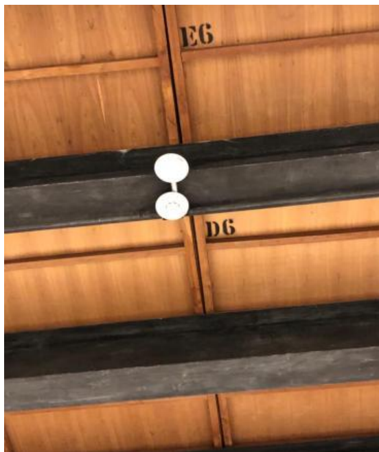
Imagem 101: Detector de temperatura ao lado do detector de fumaça e instalado na viga.
