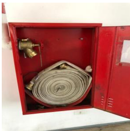
Imagem 40: Abrigo de hidrante com mangueira de 30m, Tipo 1, 1.1/2" vencida.
