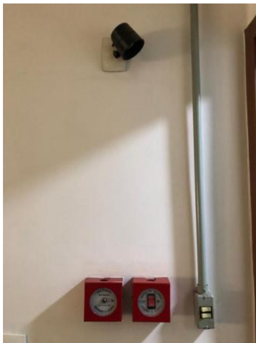
Imagem 65: Acionador manual e sirene sem placa de sinalização fotoluminescente.
