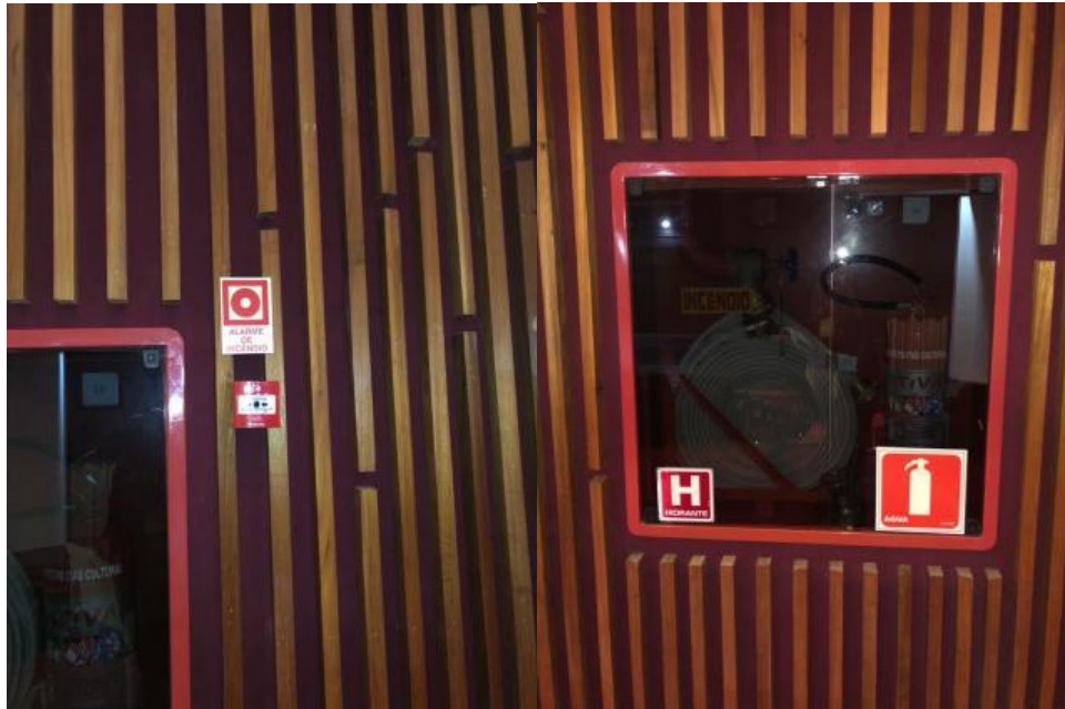
Imagem 89 e 90: Placas de sinalização de equipamentos instaladas em altura divergente com a IT 20/2019.
