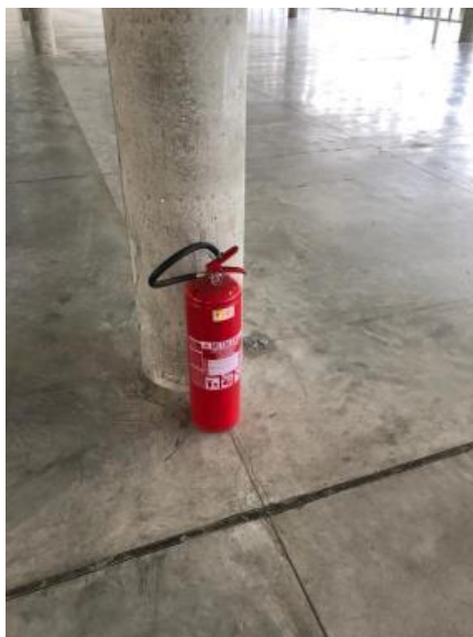
Imagem 39: Extintor de água sem suporte e sem placa de sinalização.
