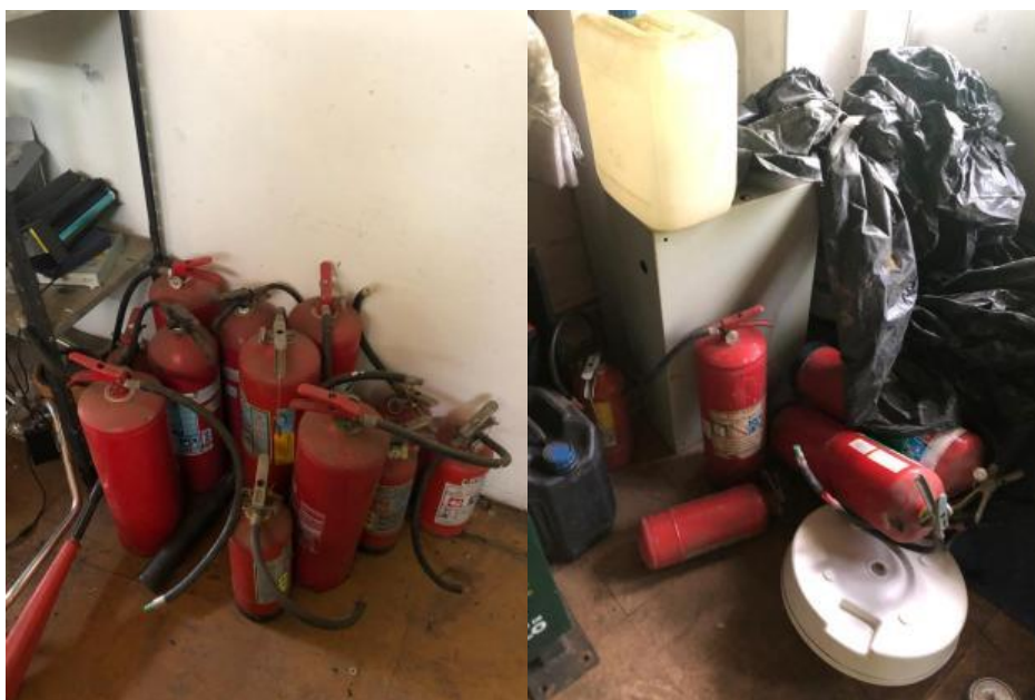
Imagem 87 e 88: Extintores vencidos, despressurizado e obstruídos.
