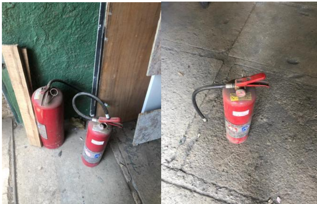
Imagem 81 e 82: Extintores vencidos e deteriorados.
