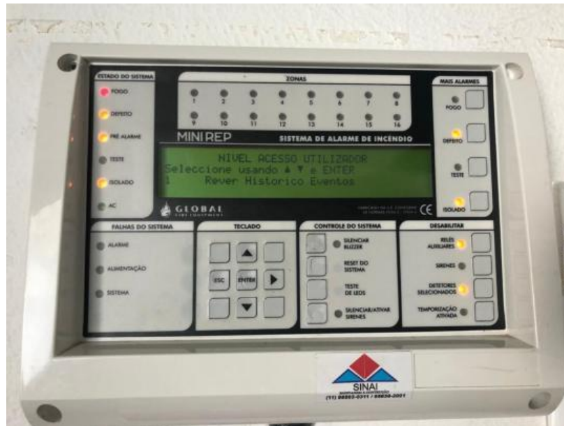
Imagem 01: Central de detecção e alarme de incêndio apresentando falhas.
