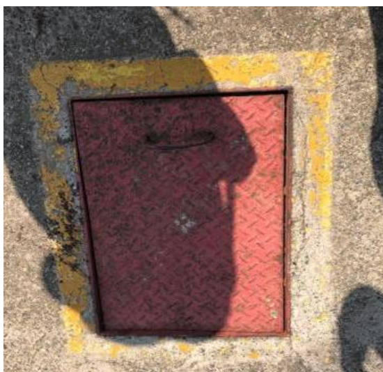
Imagem 08: Registro de recalque com demarcação deteriorada.
