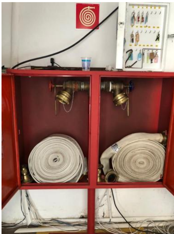
Imagem 07: Hidrante obstruído por cabos elétricos.
