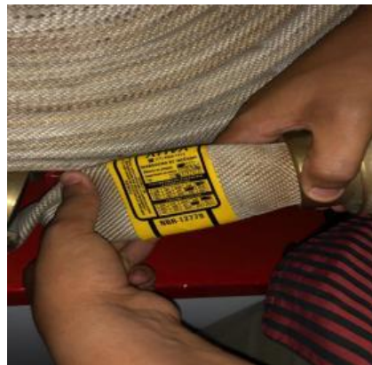
Imagens 98: Mangueira de hidrante vencida.
