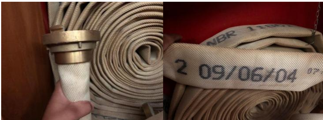
Imagem 59 e 60: a esquerda: mangueira de hidrante vencida e a direita mangueira sem o selo/identificação de teste hidrostático.
