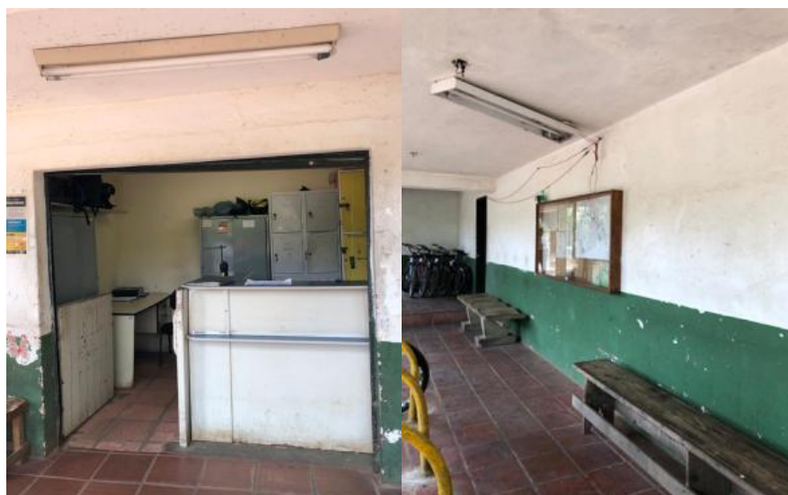
Imagem 77 e 78: Vigilância do parque portaria 5 sem proteção e com fiação de elétrica exposta.
