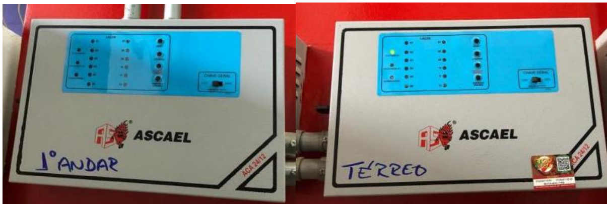
Imagem 35 e 36: Centrais de alarme de incêndio convencional do fabricante Ascael
