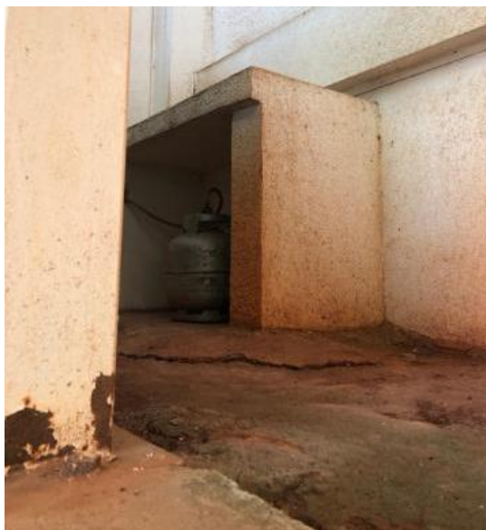
Imagem 52: Botijão P13kg na edificação.
