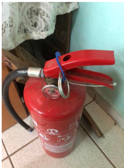
Figura 3: Extintor de PQS vencido e no chão
