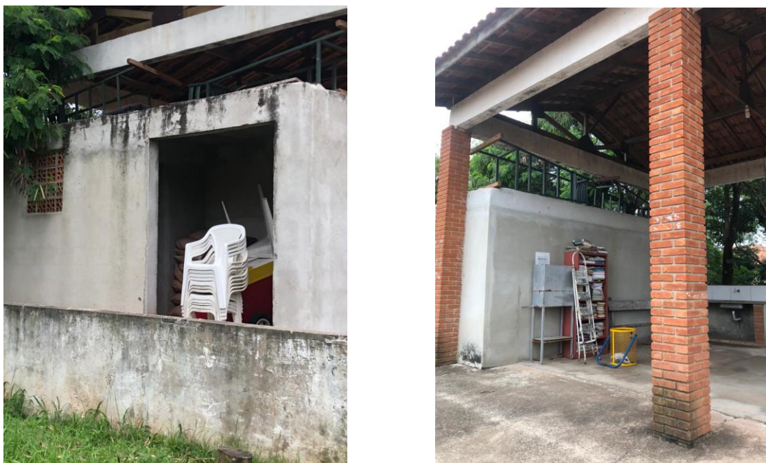
Figura 8: depósito sem equipamento de proteção contra incêndio
