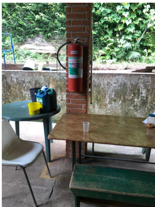
Figura 2: Extintor de água vencido e obstruído
