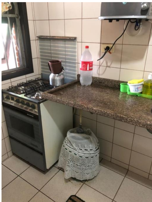
Figura 5: Cilindro de GLP 13kg sendo utilizado no interior da edificação
