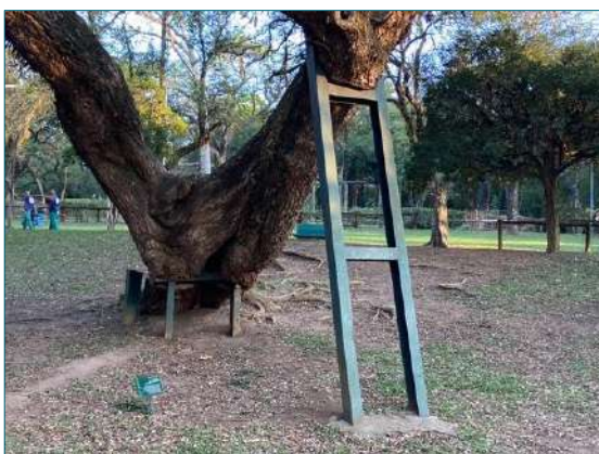
Aspecto de árvore “veterana”, ancorada por estrutura metálica, cuja eficiência deverá ser avaliada
