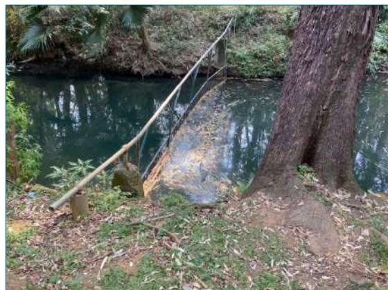
Ecobarreira no Córrego do Sapateiro, com condições insatisfatórias de manutenção
