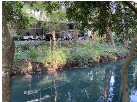
Trecho do Córrego do Sapateiro, cujas margens apresentam processos erosivos (solapamento dos barrancos)
