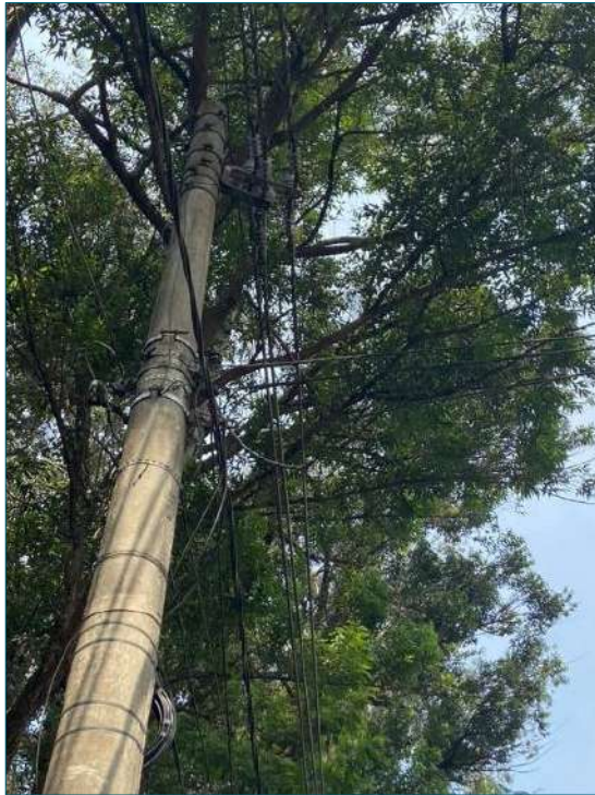
Detalhe da interferência da vegetação na rede elétrica, cujo manejo deverá ser efetuado por equipe devidamente credenciada
