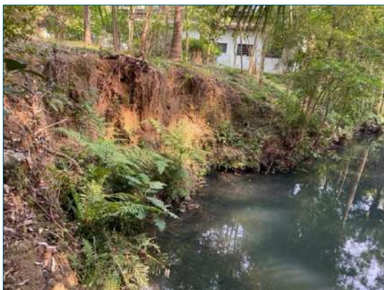
Detalhe de talude não conforme que contribui para o carregamento de sedimentos no Córrego do Sapateiro
