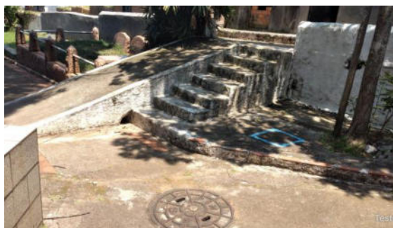
Foto 9.1.7.5-3 - Bueiros do sistema subterrâneo de águas pluviais
