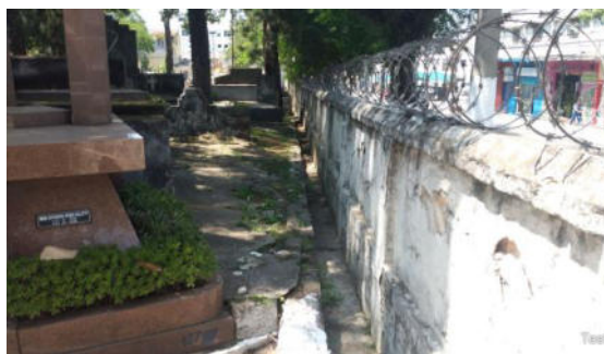
Foto 9.1.7.5-4: Canaleta para escoamento de água, no muro limítrofe com a rua Carlos Gomes
