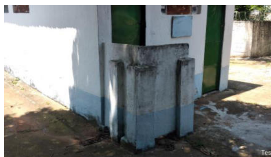
Foto 9.1.7.5-10: Sistema de drenagem de águas pluviais próximo aos antigos sanitários (Quadra 13).
