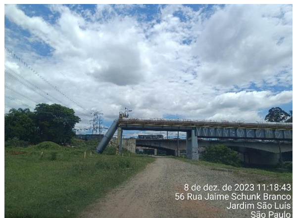
Foto 12.3.3-6 – Área de Servidão e dutos da Petrobrás - distrito de Socorro
