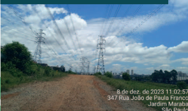
Torres de energia elétrica – distrito de Socorro
