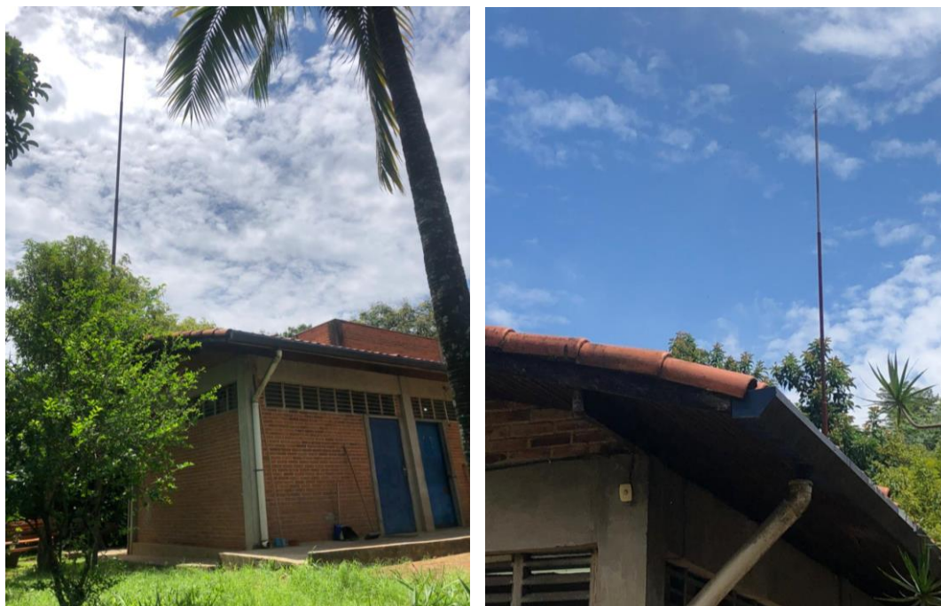
Figura 13: SPDA no prédio administrativo
