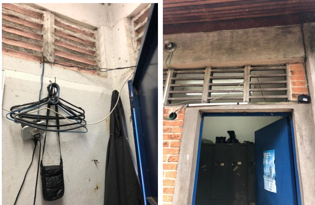
Figura 6: Fiação de elétrica exposta
