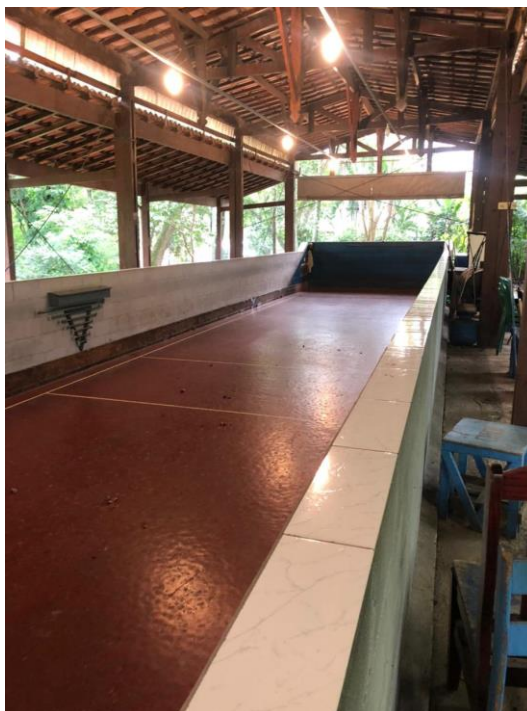
Figura 7: Quadra de bocha sem equipamento de proteção contra incêndio
