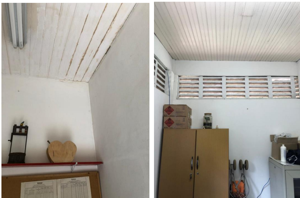
Figura 3: Materiais sem proteção por extintores
