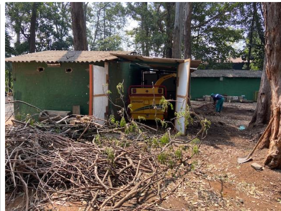
Figura 41. Triturador instalado no Parque Ibirapuera. 70
