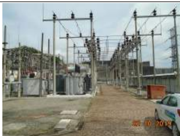
Foto 04: Vista da Subestação ETD Rio Bonito.
