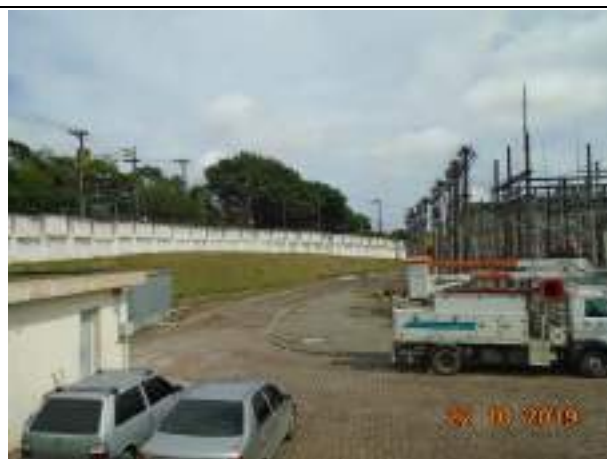
Foto 02: Vista da Subestação ETD Rio Bonito a partir da entrada no sentido Noroeste.
