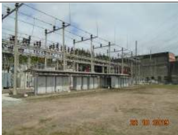
Foto 07: Vista da Subestação ETD Rio Bonito. Transformador – TR4 à esquerda da imagem. Foto tirada no sentido Oeste.
