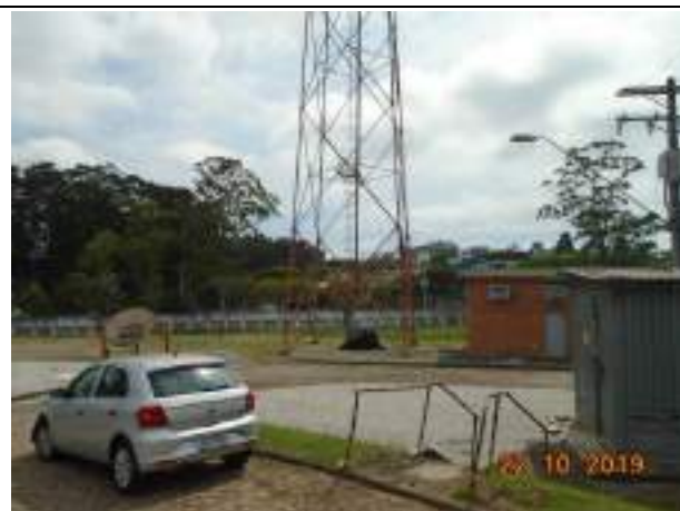
Foto 03: Vista da Subestação ETD Rio Bonito a partir da entrada no sentido Leste.
