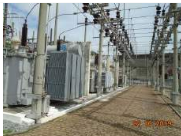
Foto 05: Vista da Subestação ETD Rio Bonito. Transformador – TR4 em primeiro plano.
