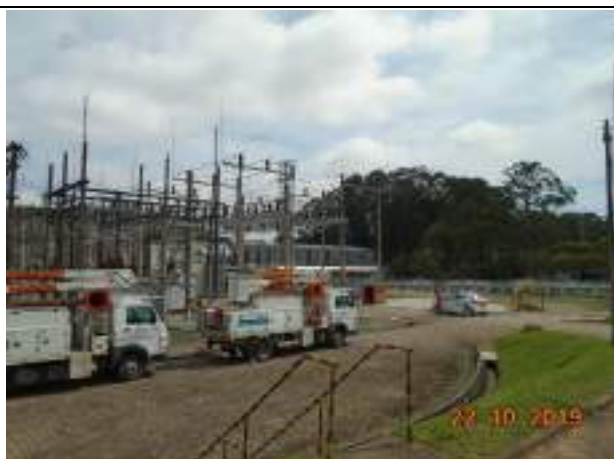
Foto 01: Vista da Subestação ETD Rio Bonito a partir da entrada no sentido Norte.
