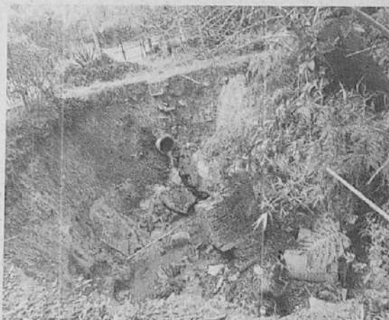
Foto da erosão em julho de 2019.
