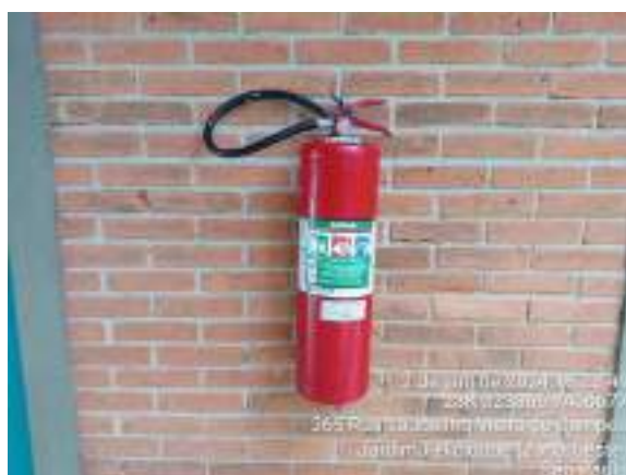
Figura 305 Extintor de Água - Banheiros públicos
