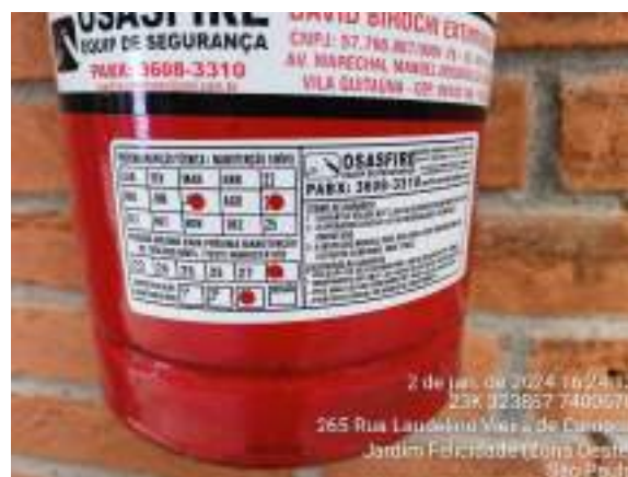
Figura 308 Validade do Extintor de Pó BC - Administração
