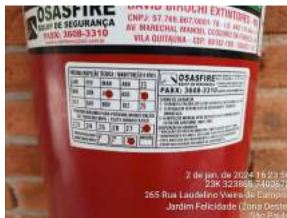
Figura 306 Validade do Extintor de Água - Banheiros públicos
