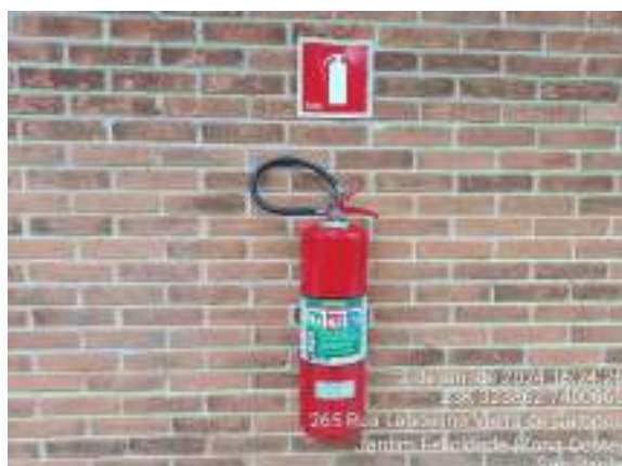
Figura 309 Extintor de Água - Depósito
