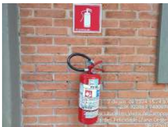
Figura 307 Extintor de Pó BC - Administração
