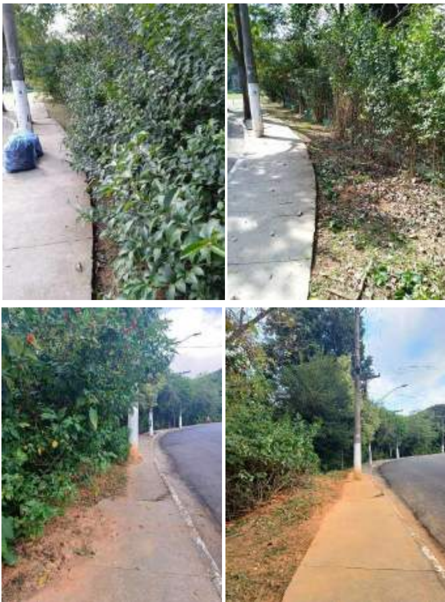
FIGURA 59 – PODAS DE LIMPEZA E MANUTENÇÃO EXTERNA EM ÁREA DE CALÇADA NA RUA PADRE GUIDO DEL TORO – ANTES E DEPOIS
