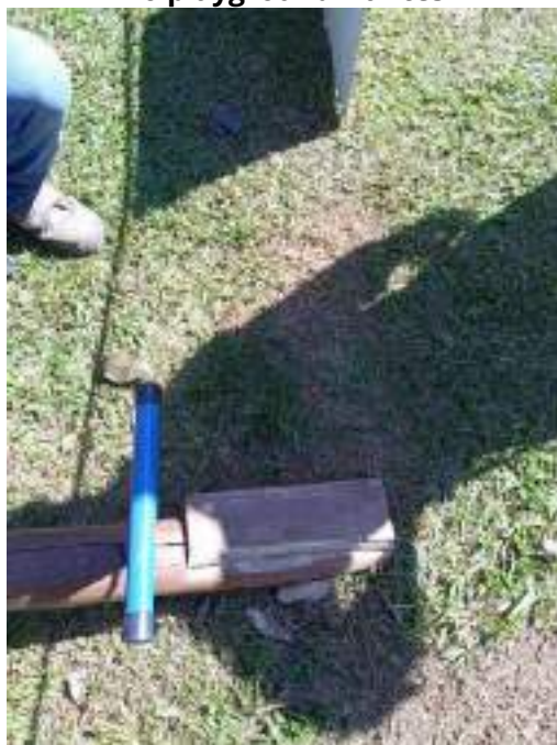
Figura 140:Reparo do banco da gangorra no playground - antes
