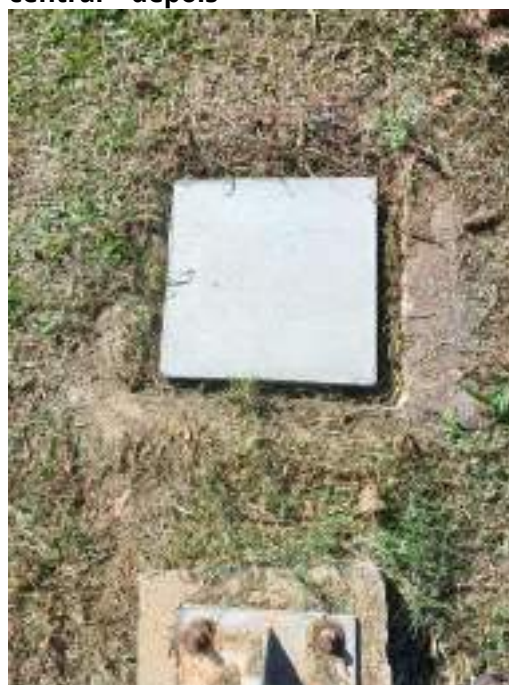
Figura 143:Substituição de tampa de alvenaria para caixa elétrica na praça central - depois
