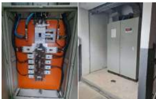
Figura 93 - Manutenção em painel da Cabine Primária do Pacubra.
