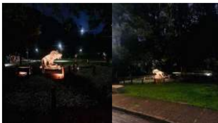
Figura 94 - Instalação de iluminação na praça do leão.
