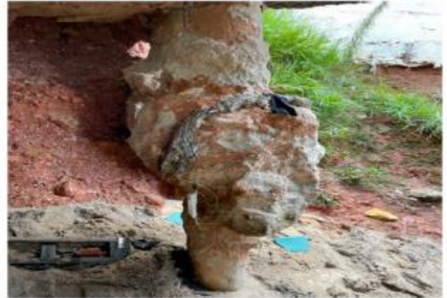
Pilares expostos com presenças de trincas
