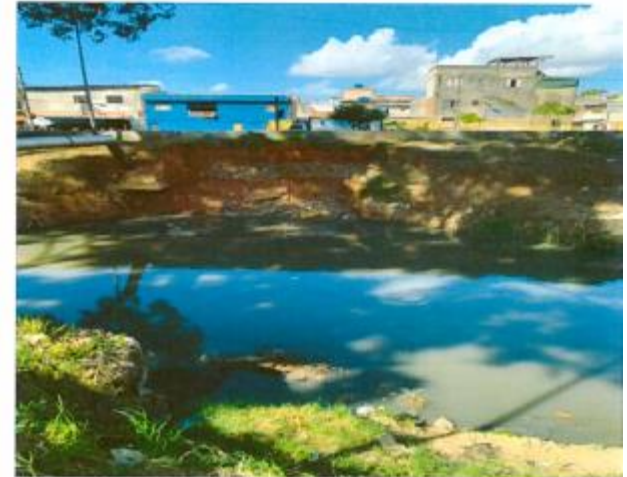
EROSÃO MARGENS, AV. JACÚ-PÊSSEGO
