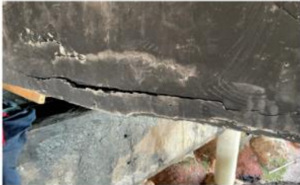
Presença de fissura na viga da ponte
