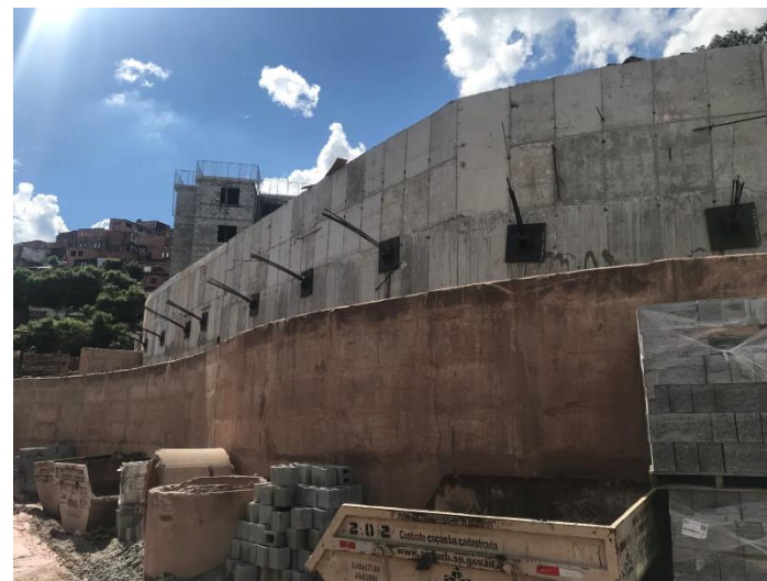
Cond. 6B – Tirantes protendidos do muro de contenção
