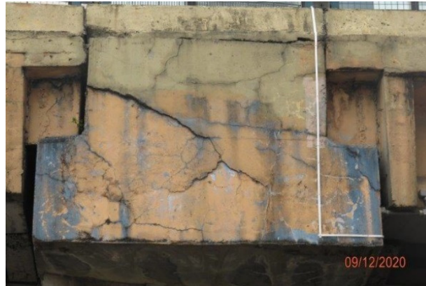
Ruptura do concreto na viga travessa TR29 – face Direita, apoio AP29
