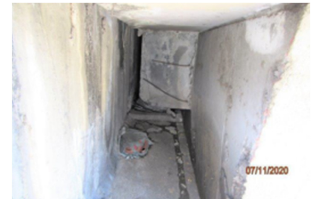
Aparelho de apoio em neoprene fretado sob a viga longitudinal VL8, vão 28 – apoio AP29, esmagado.
