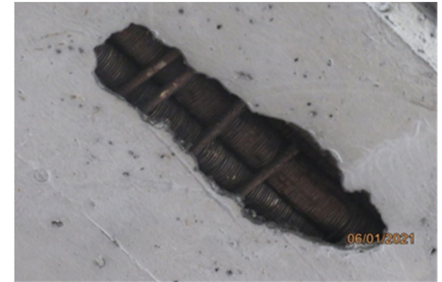
Concreto segregado com protensão exposta em viga longitudinal.
