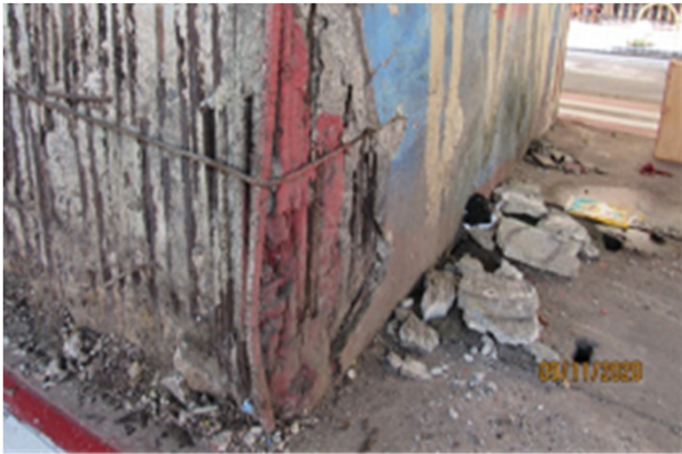
Concreto disgregado com armadura exposta e corroída no Pilar – P48
