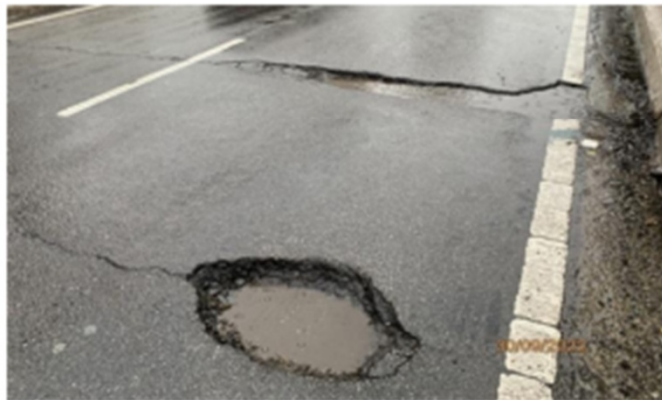
Tratamento inadequado das Juntas
