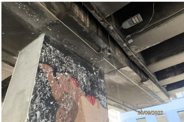
Junta de dilatação - JD73 com percolação de água
