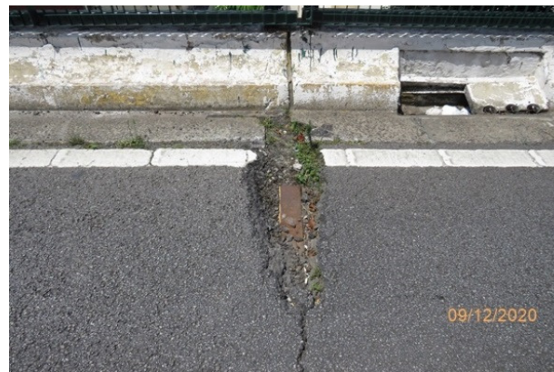
Junta de dilatação recoberta e com fissuras no pavimento flexível- JD82 sobre o apoio AP41
