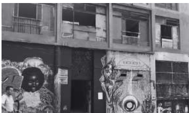
Edifícios em estado de deterioridade
