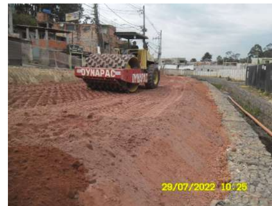
Aterro e compactação de base de parque Linear – Jd Tancredo - Foto: jul/22
