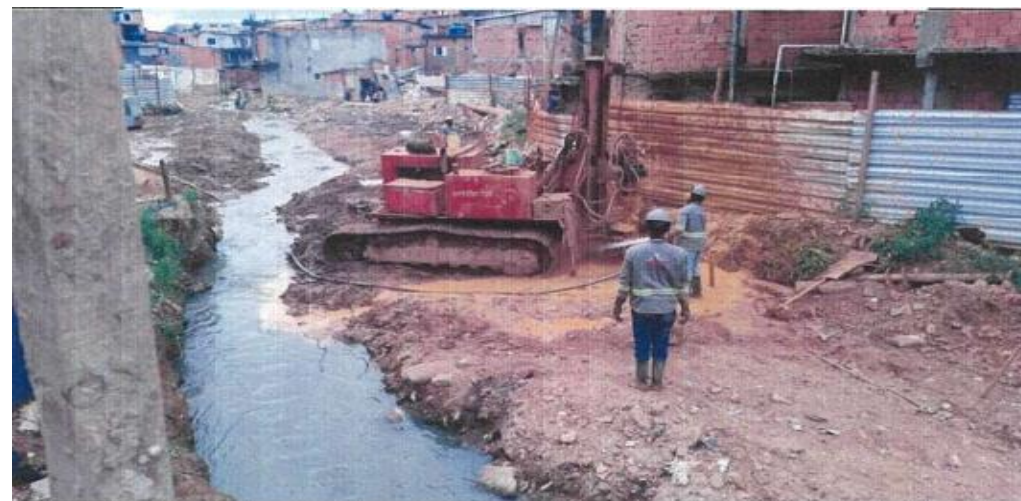
Fase 4 - Execução de Estaca Tipo Raiz, 400mm, com Perfuração em Solo – 130T - Fotos: jun./23.
