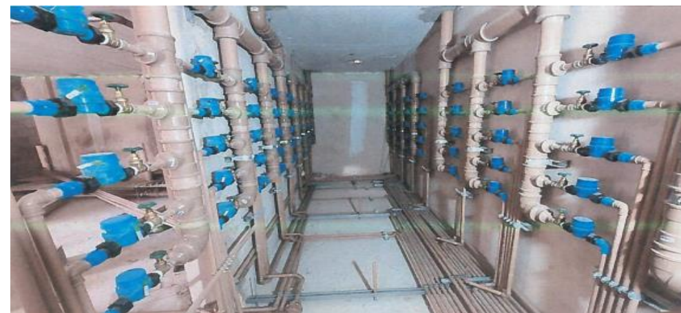
Torre B - Hidrômetros – Fotos: jun./23.
