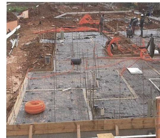
Instalações elétricas - Fotos: jun/23
