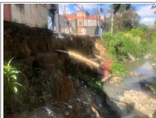
Vista do avanco da área erodida sobre as edificações da rua Francisco de Holanda
