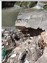
Avançado processo erosivo junto à cabeceira do pontilhão
