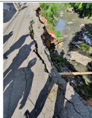
Comprometimento de mais de 70% do pavimento da rua
