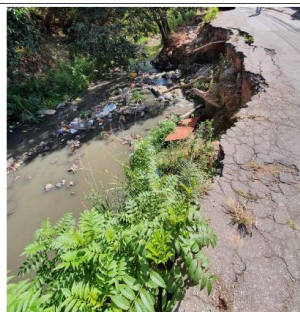
Comprometimento do Pavimento da Rua Francisco de Holanda
