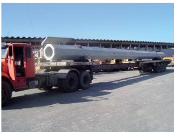
Transportadas até o canteiro de obras por caminhões, as estacas devem ser descarregadas por meio de guincho ou de corda
