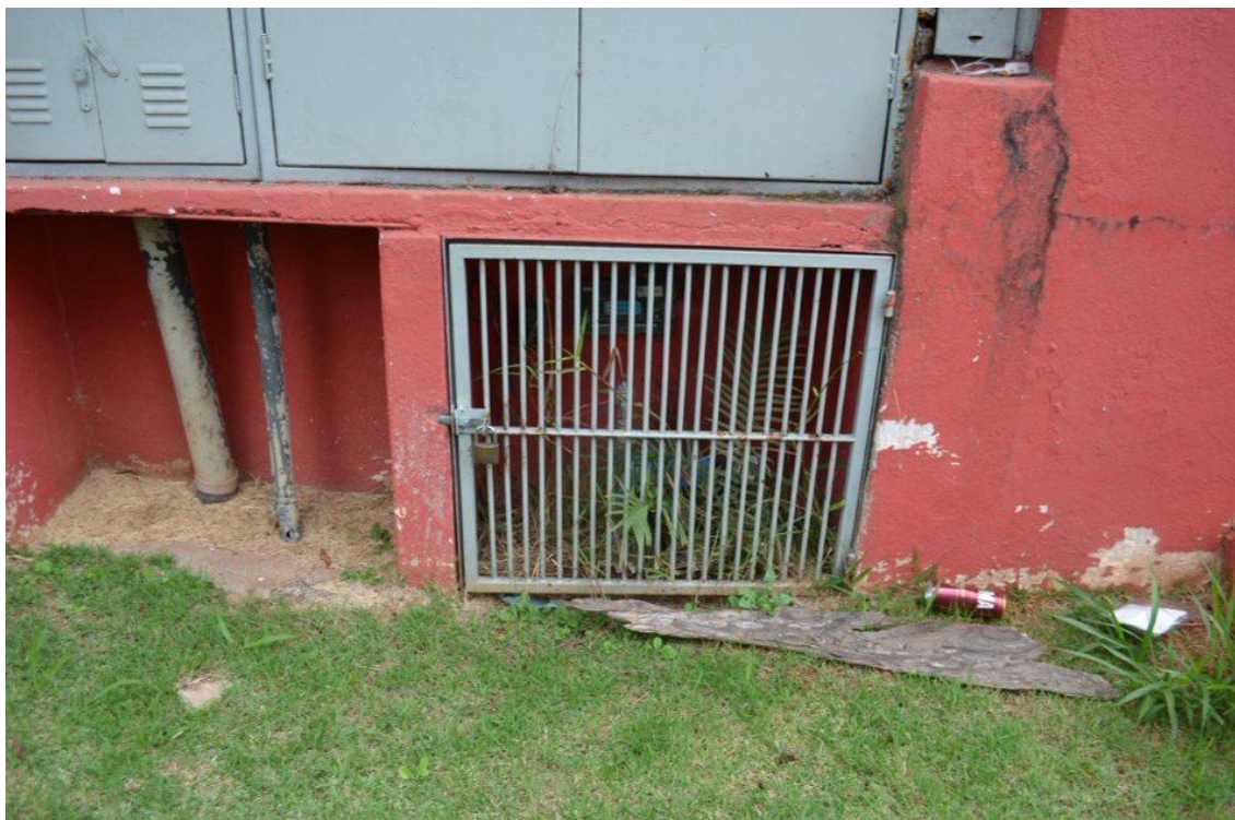
Figura 5– Medidor d'água existente e entrada de luz
