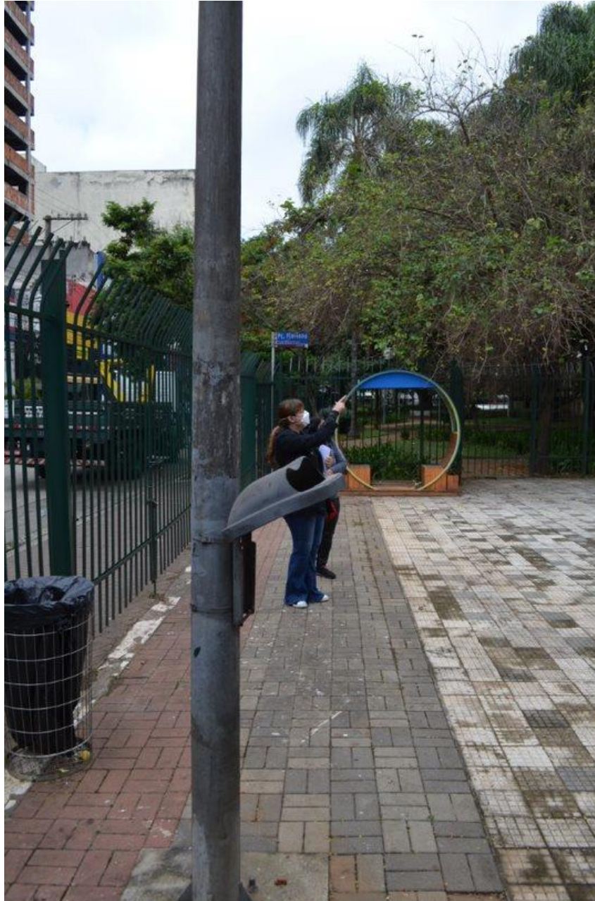
Figura 4 – Poste elétrico existente
