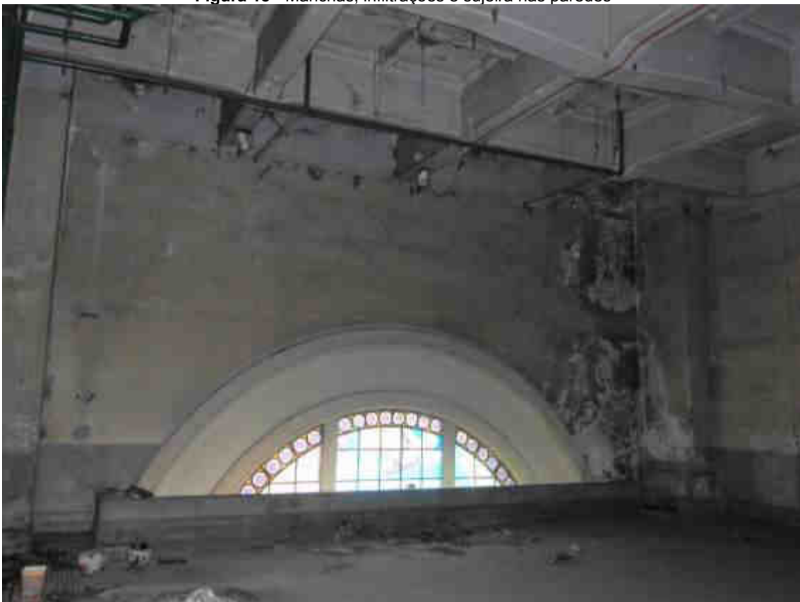
Figura 18 - Manchas, infiltrações e sujeira nas paredes
