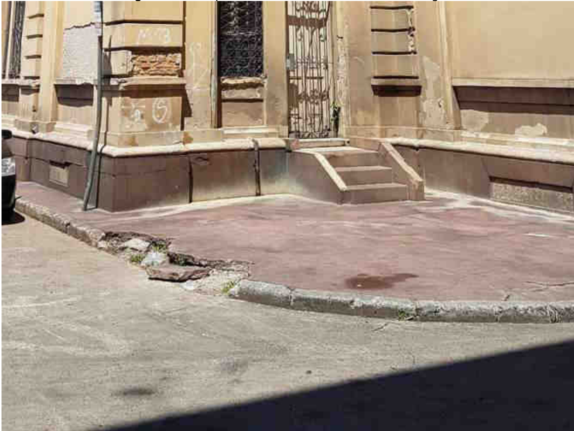
Figura 8 - Piso apresentando trincas e descolamento da guia
