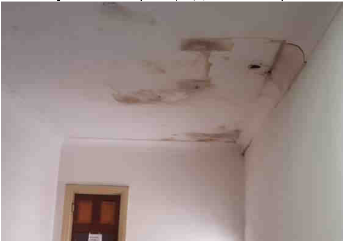
Figura 59 - Forro de edificação anexa (estuque) com manchas e infiltrações
