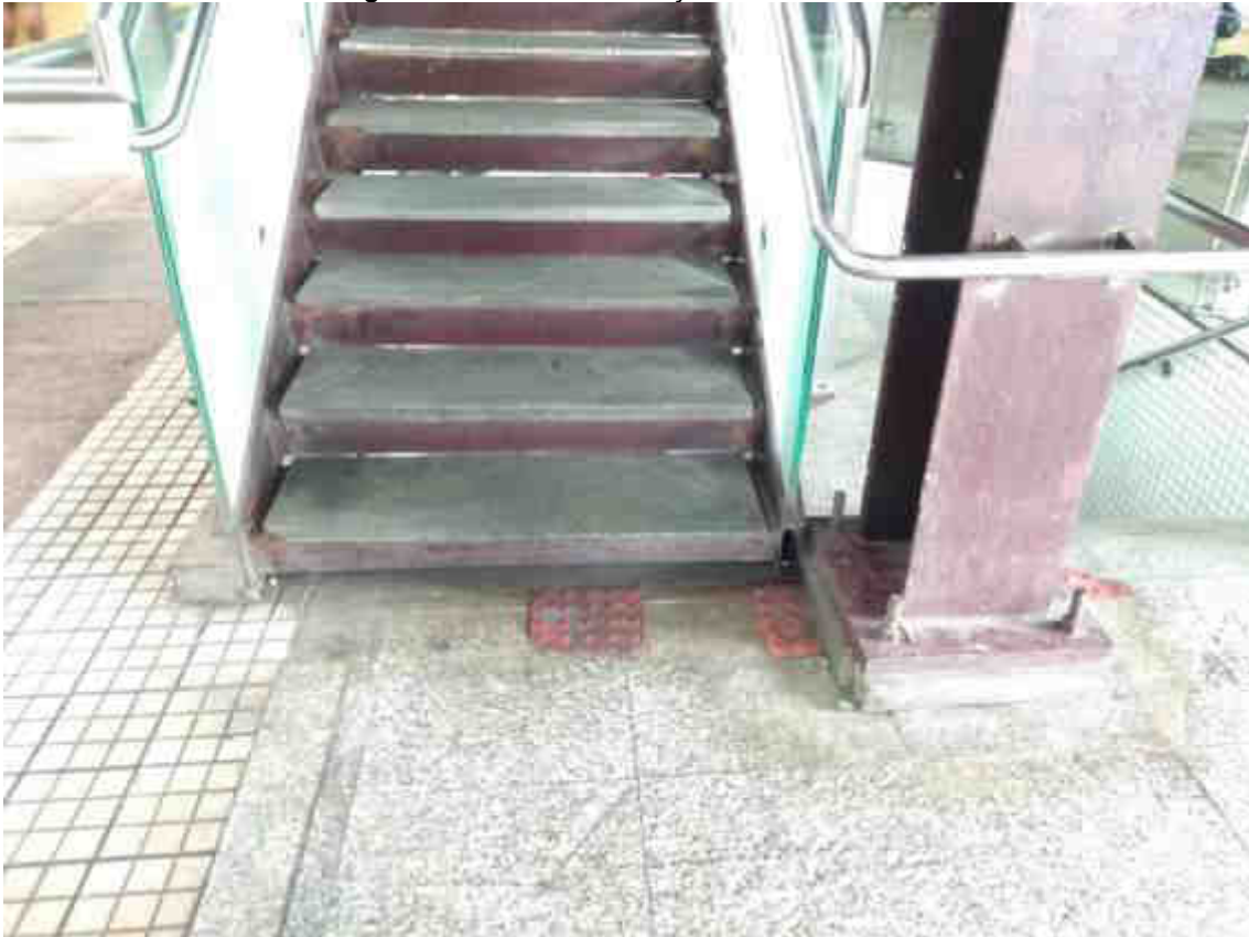
Figura 57 - Falta de sinalização tátil nas escadas
