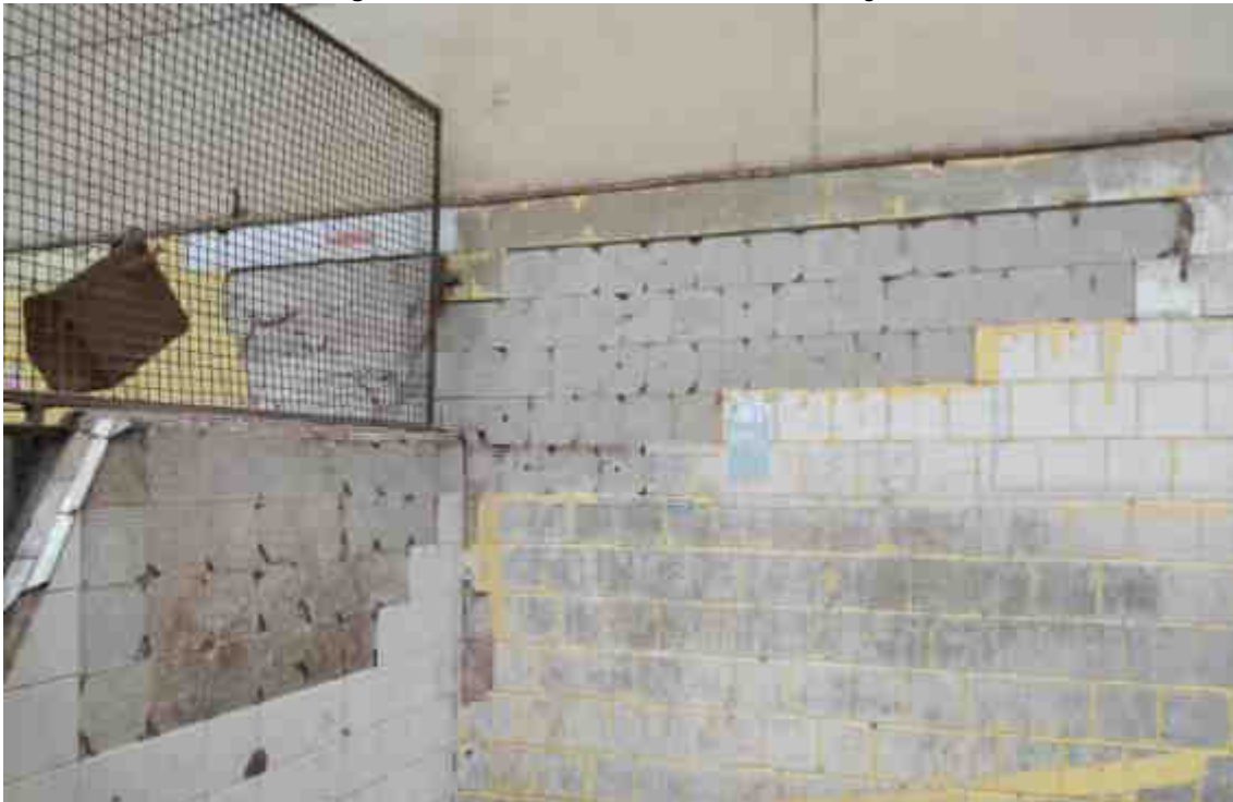
Figura 34 - Descolamento do revestimento original
