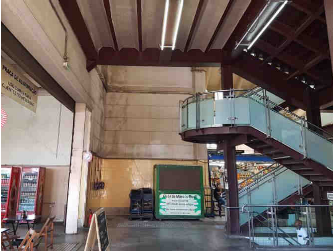
Figura 33 - Parede interna com manchas e infiltração
