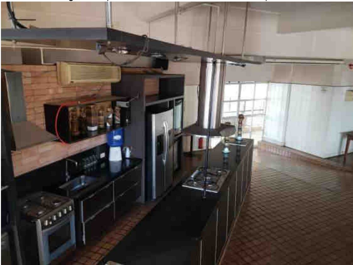
Figura 87 - Aparelho de ar condicionado na área de eventos privados
