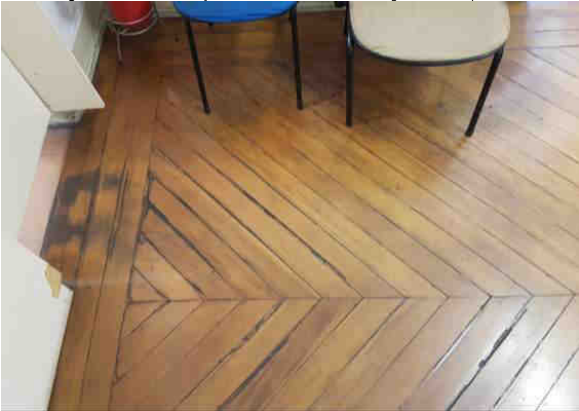
Figura 49 - Piso da edificação anexa com madeiramento desgastado e comprometido
