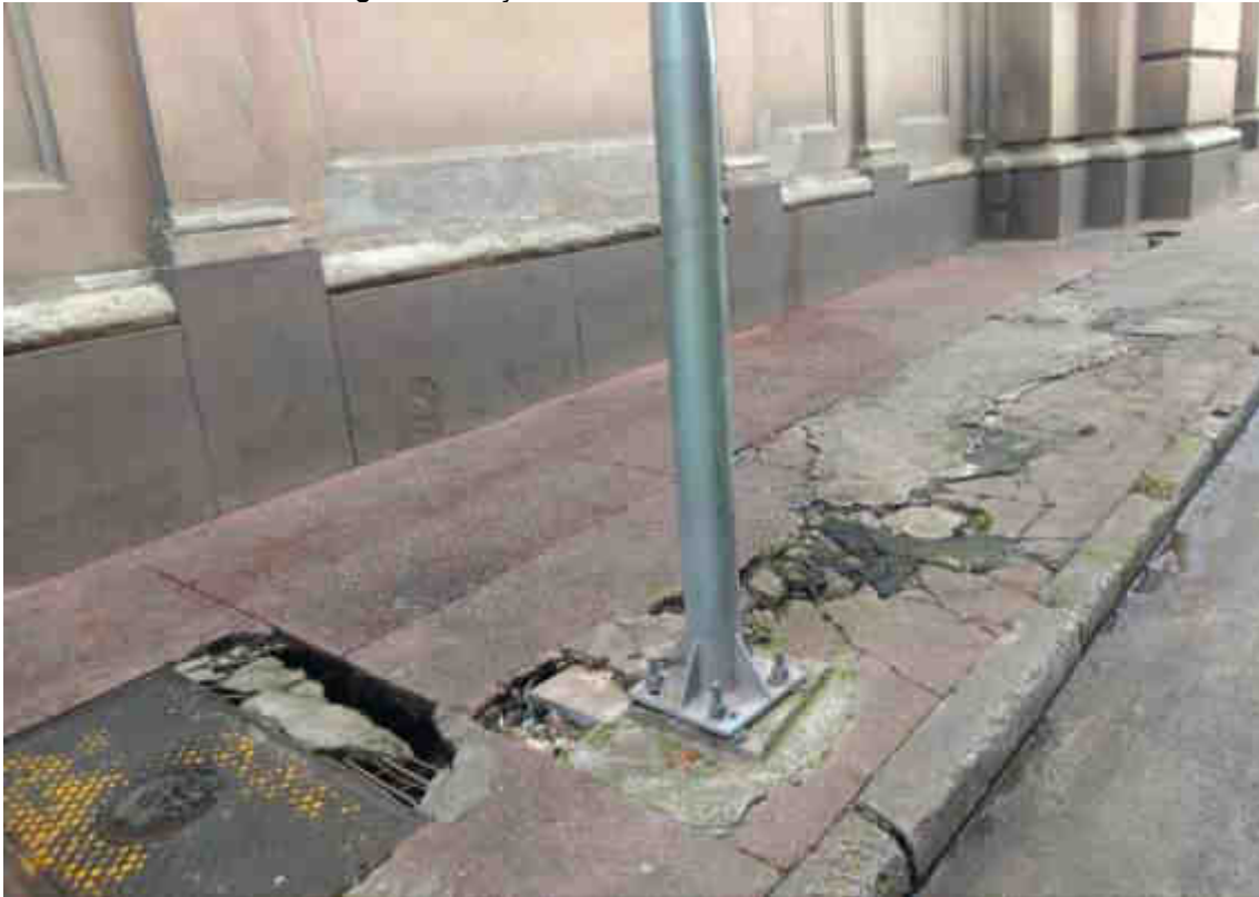
Figura 6 - Calçada com remendos no revestimento
