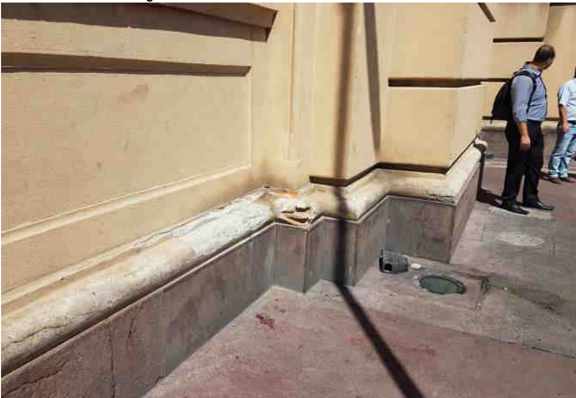
Figura 22 - Fachada com deslocamento do revestimento
