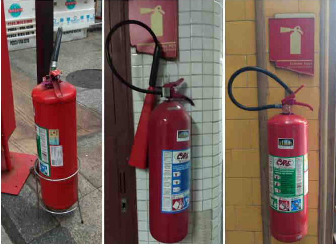
Figura 91, 92 e 93 – Extintores existentes
