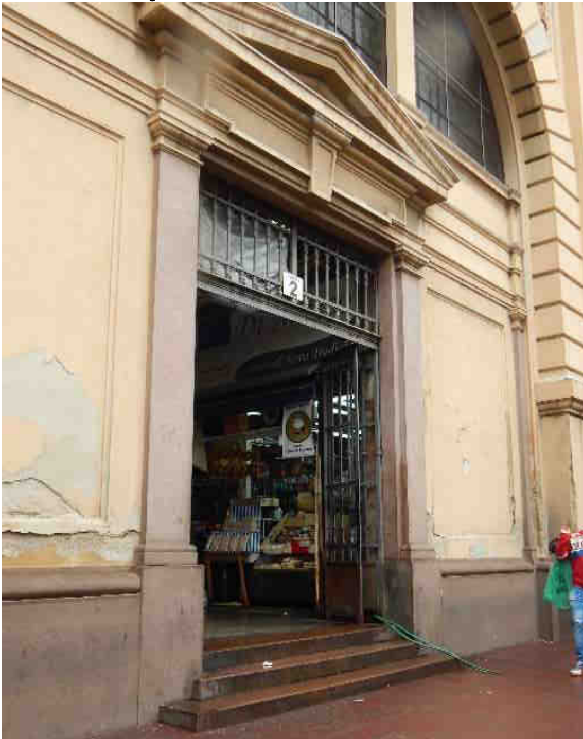
Figura 25 - Fachada com deslocamento do revestimento
