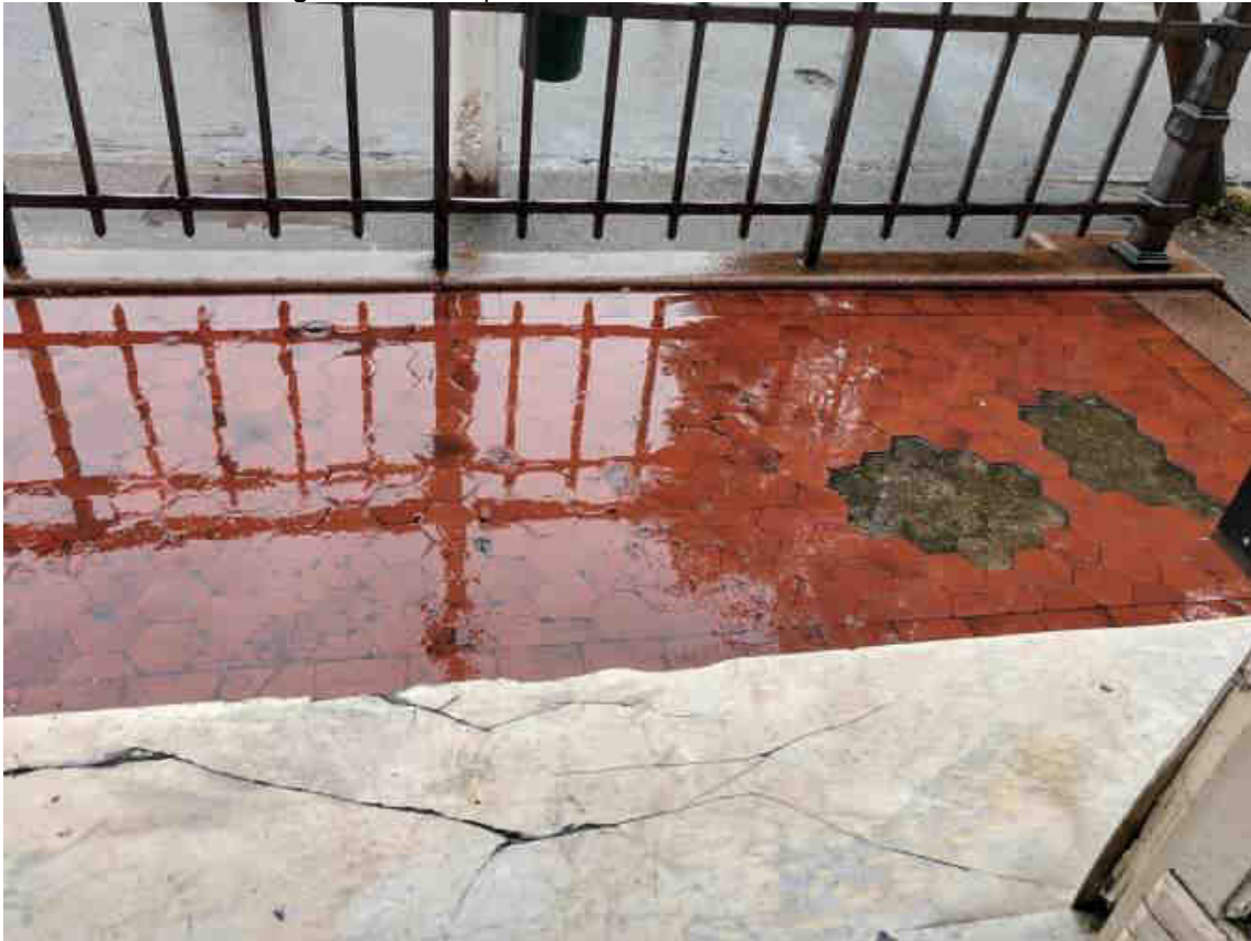
Figura 47 - Piso apresentando trincas e falta de revestimento
