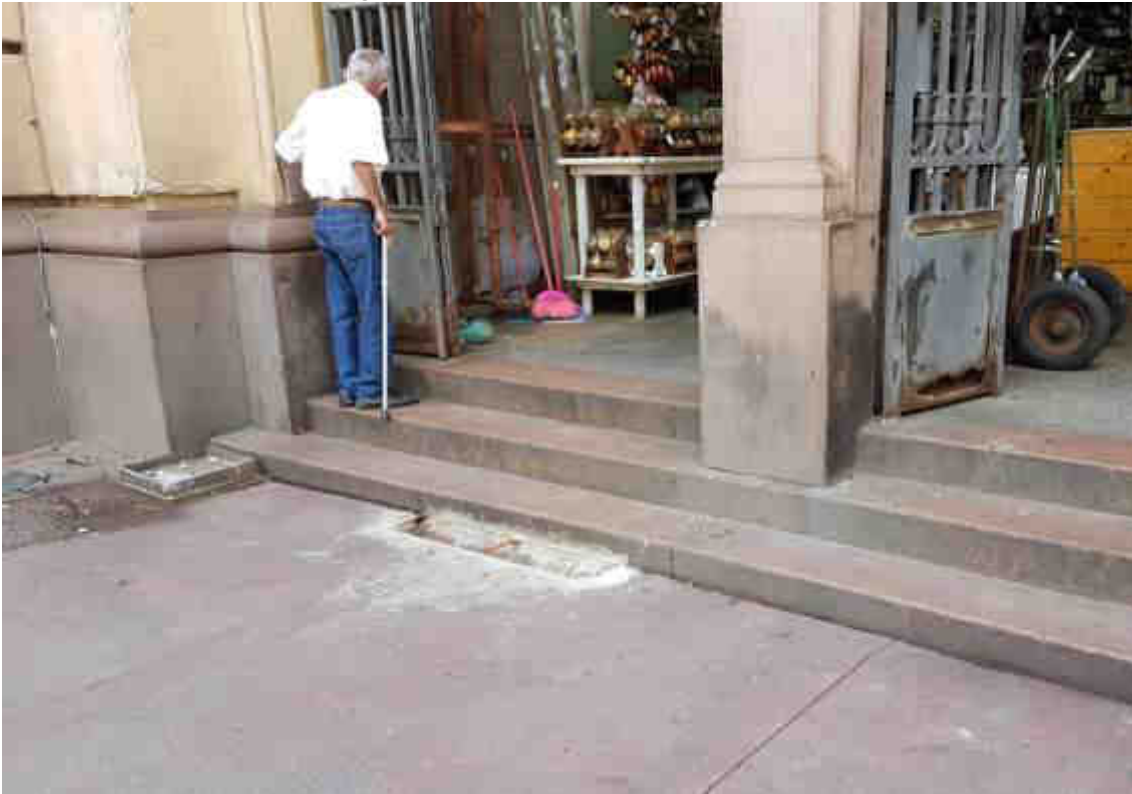
Figura 65 - Corrosão dos portões metálicos
