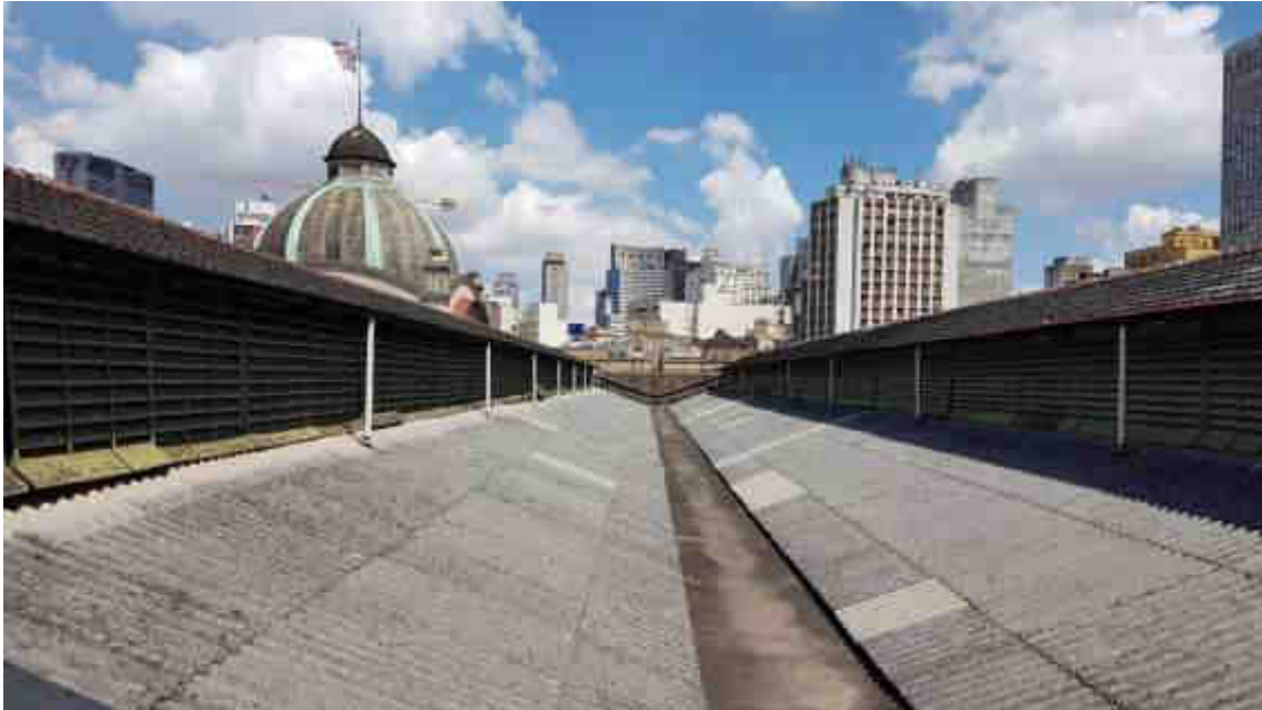
Figura 29 - Brises com deslocamento do revestimento e telhas em fibrocimento
