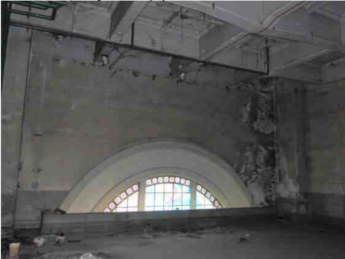
Figura 13 - Infiltração junto a elementos estruturais
