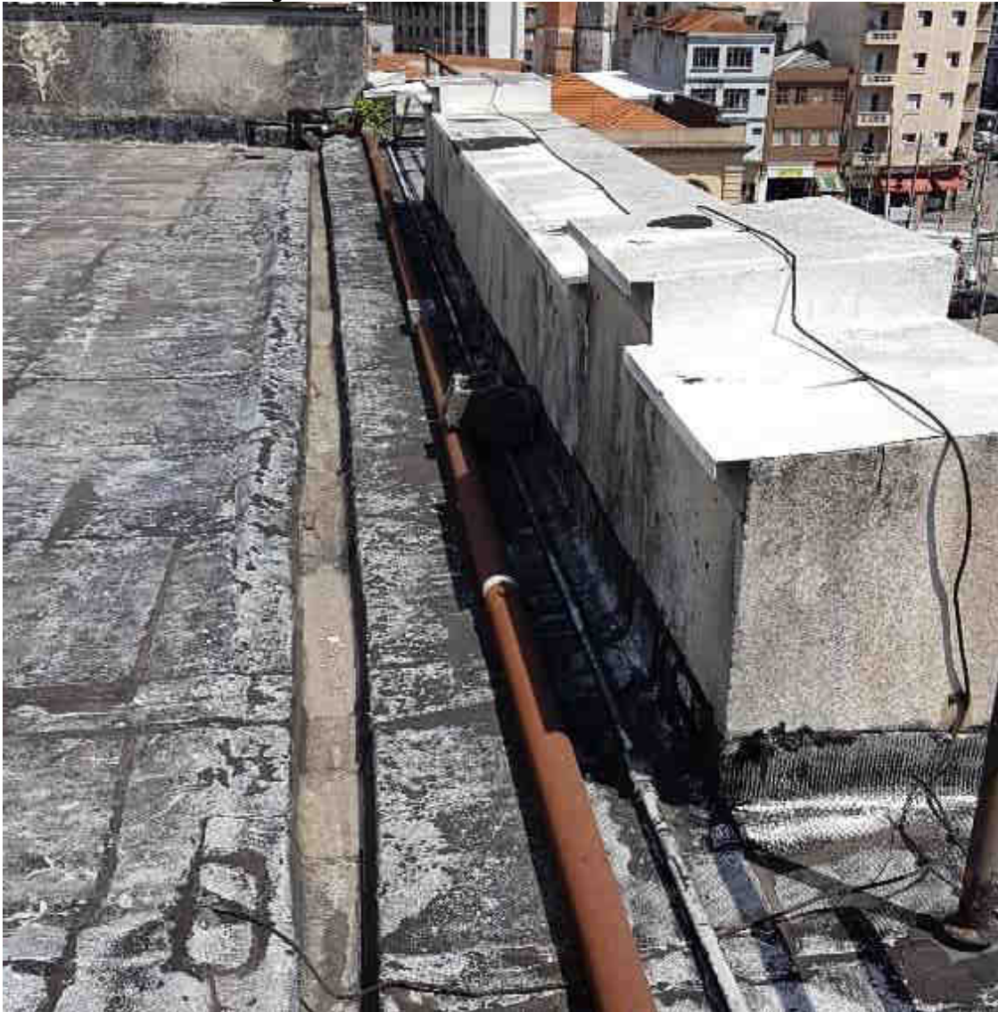
Figura 102 - Cordoalhas soltas do sistema de SPDA
