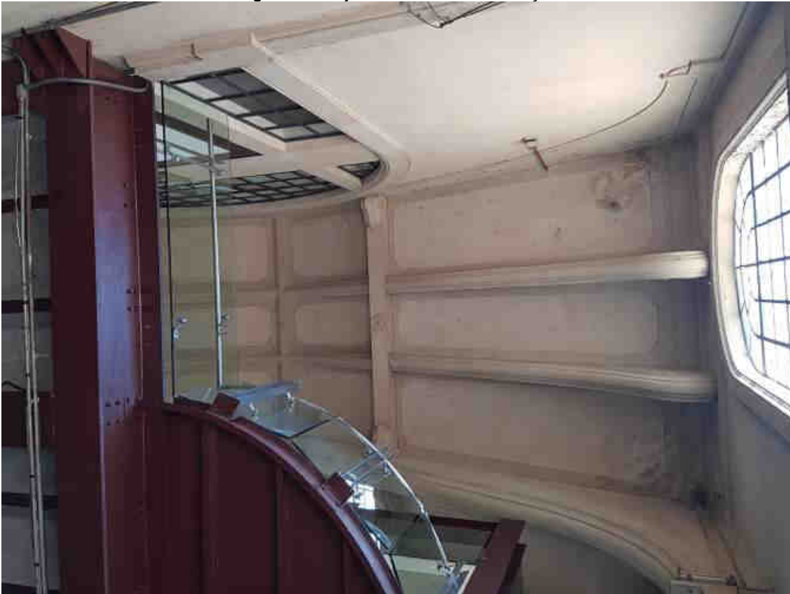
Figura 36 - Laje com manchas e infiltração
