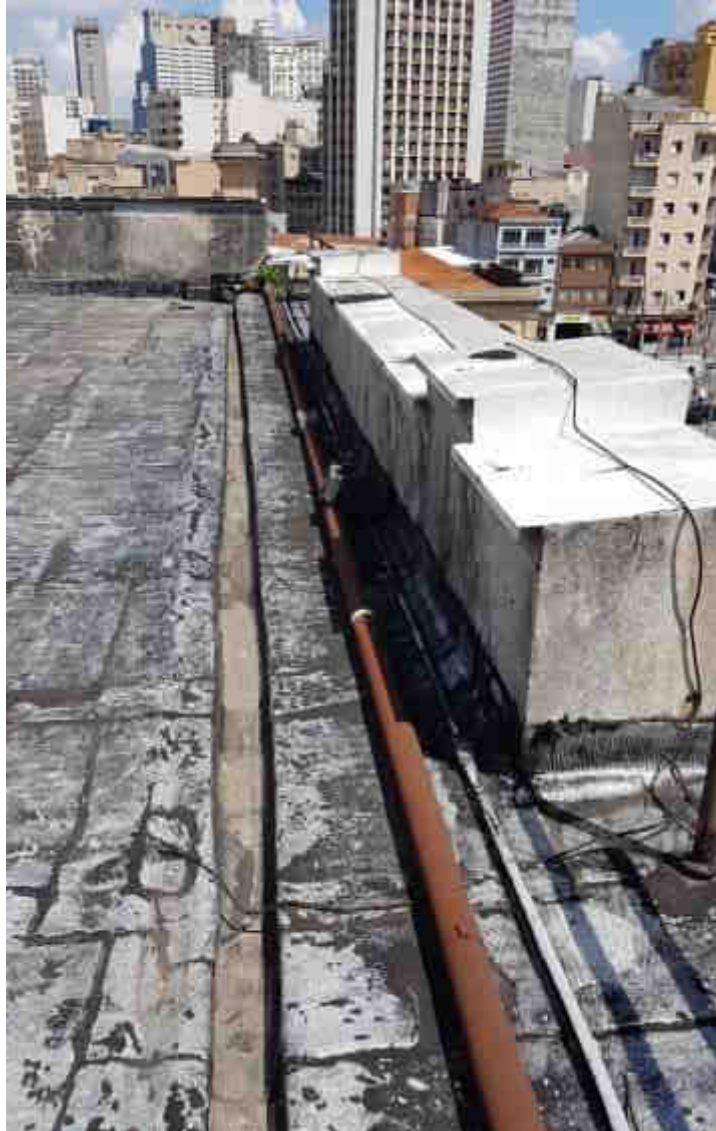
Figura 19 - Ressecamento e/ou craqueamento do sistema impermeabilizante
