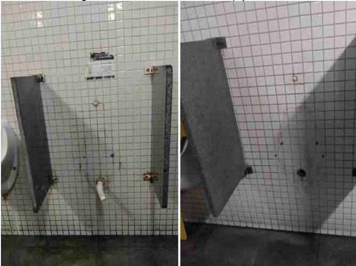
Figura 105 e 106 – Banheiros no subsolo com peças faltantes
