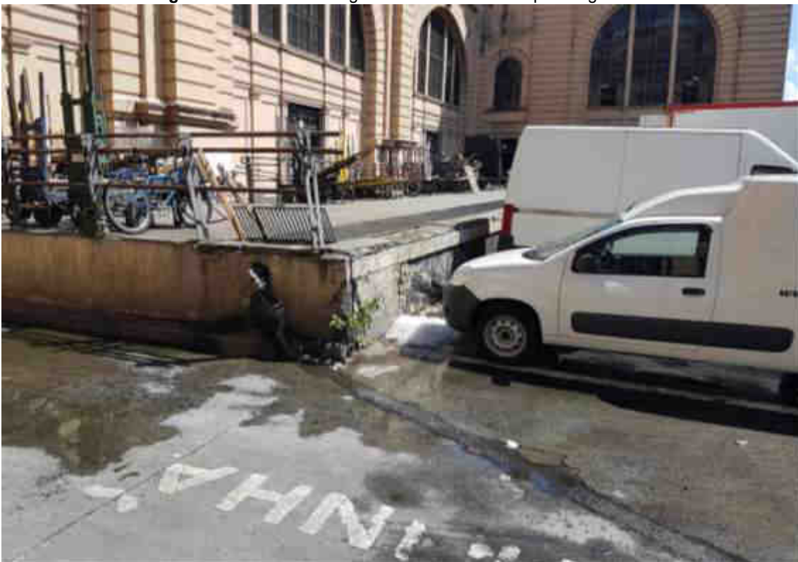
Figura 3 - Área de descarga de caminhões com e piso degradado
