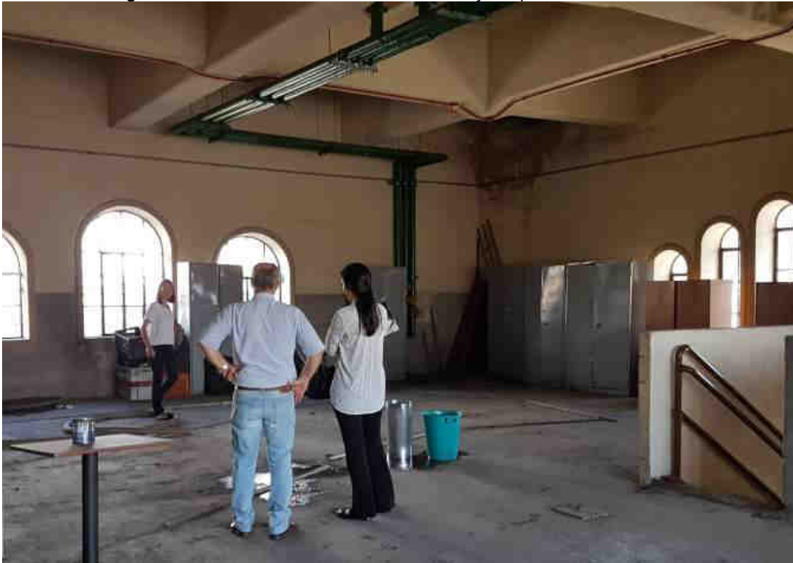
Figura 39 - Parede interna com manchas, infiltração e piso sem revestimento
