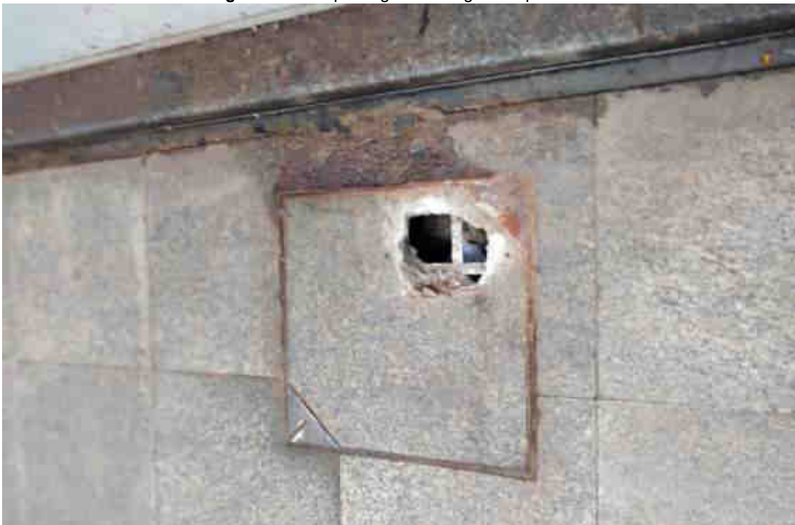
Figura 46 - Tampa da galeria em granito quebrada
