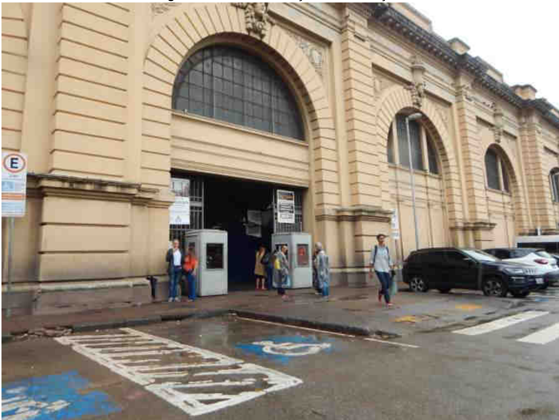
Figura 1 - Fachada e situação atual da calçada
