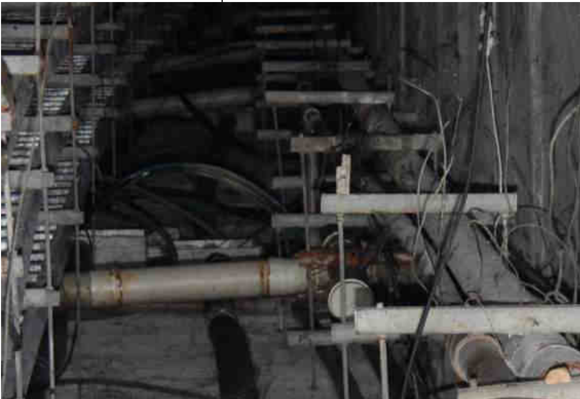
Figura 70 - Tubulações de esgoto, água fria e incêndio dentro da galeria em aduela pré-fabricada de concreto do subsolo
