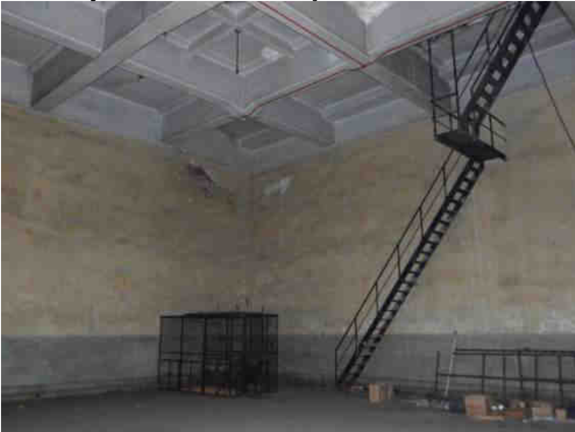
Figura 127 - Escada de acesso à caixa d'água com dimensões fora de norma
