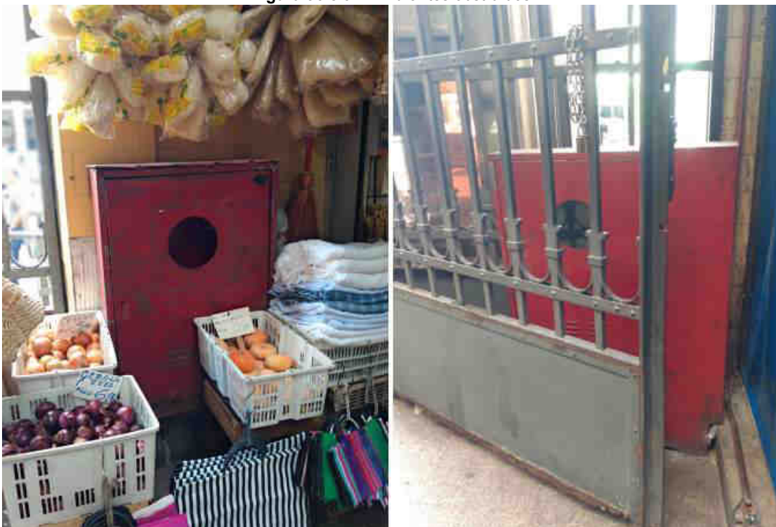
Figura 96 e 97 – Hidrantes obstruídos
