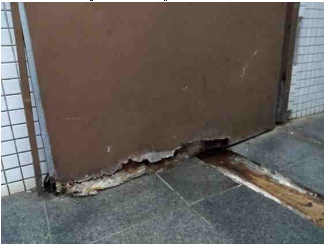
Figura 98 - Porta corta- fogo do subsolo deteriorada
