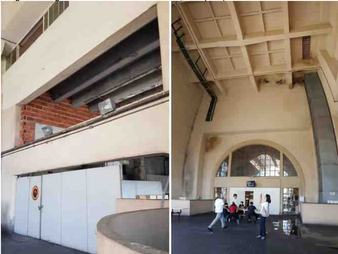
Figura 40 e Figura 41 - Parede interna com manchas, infiltração e piso e alvenaria sem revestimento
