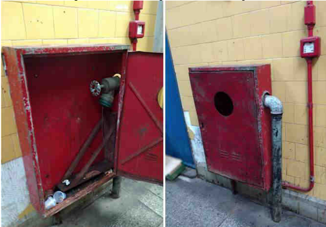
Figura 94 e 95 - Hidrante antigo e deteriorado, sem mangueira
