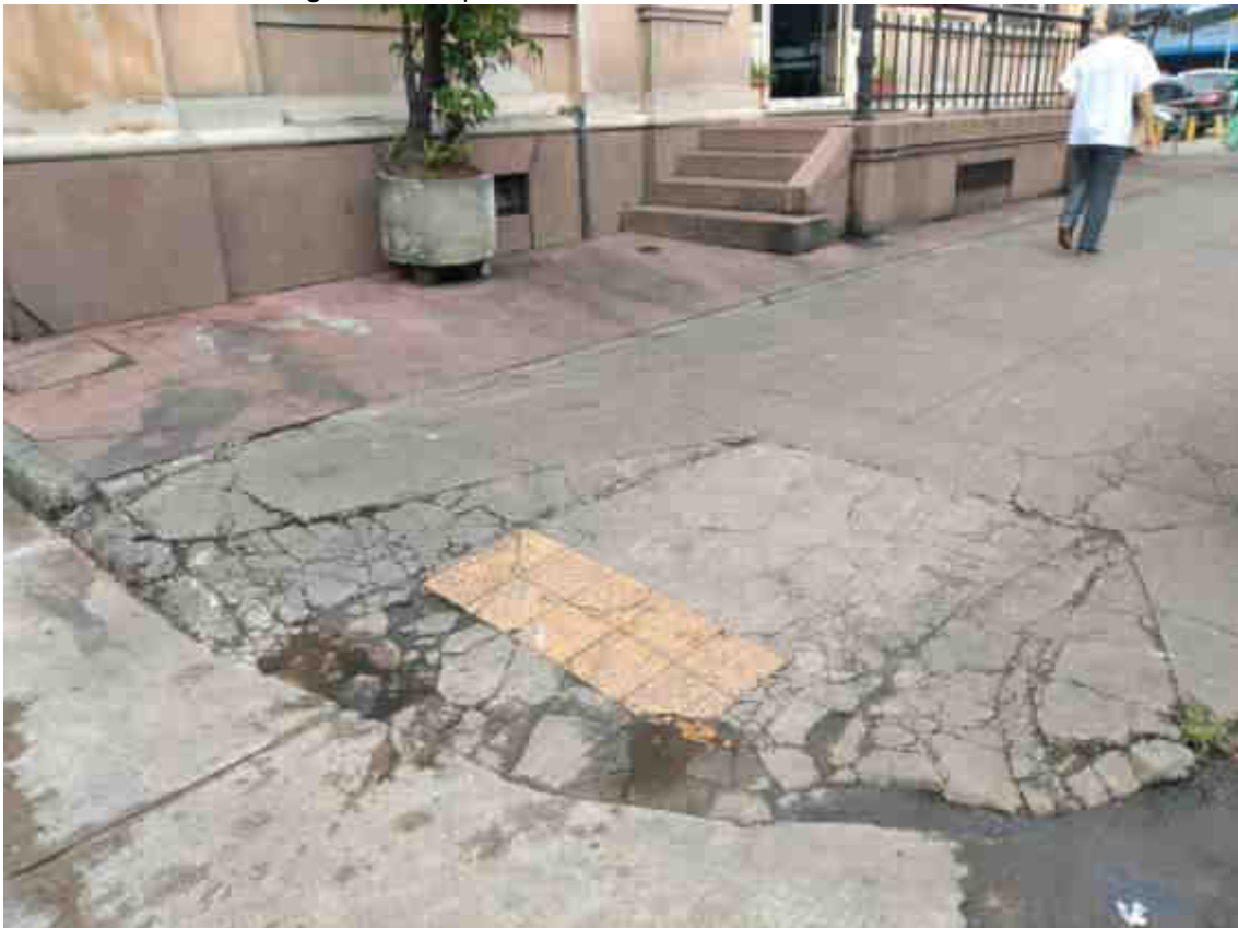
Figura 5 - Rampa de acessibilidade com concreto trincado
