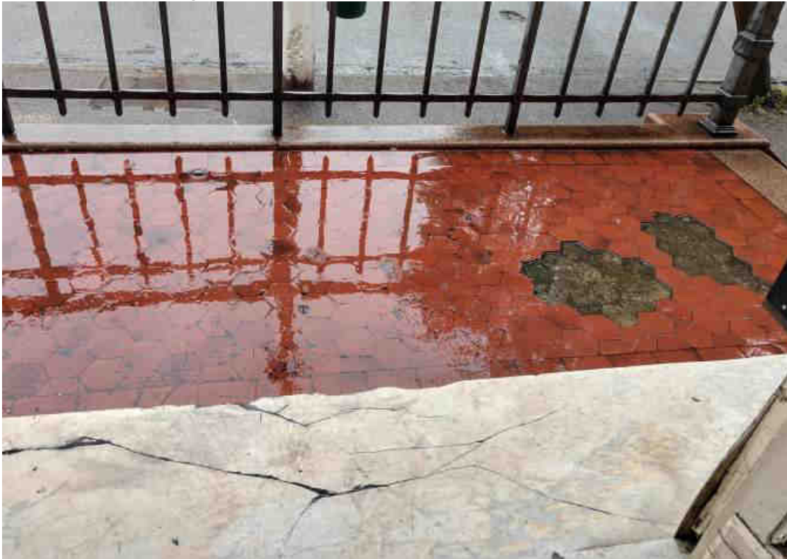
Figura 4 - Piso apresentando trincas e falta de revestimento
