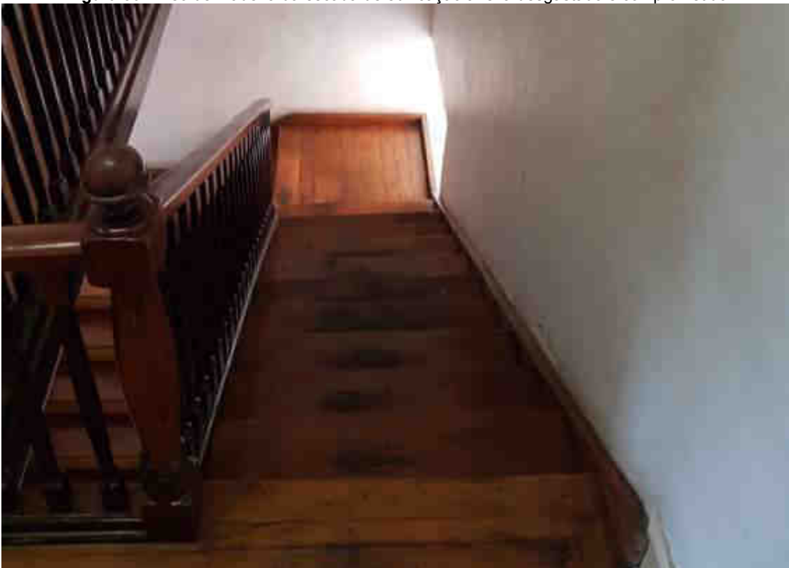
Figura 50 - Piso de madeira da escada de edificação anexa desgastado e comprometido
