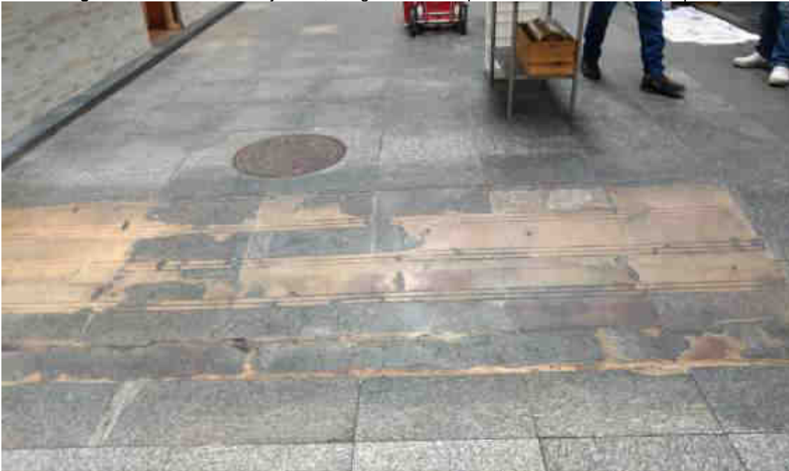
Figura 53 – Granito com sujidades, desgastado e rampa com revestimento inapropriado
