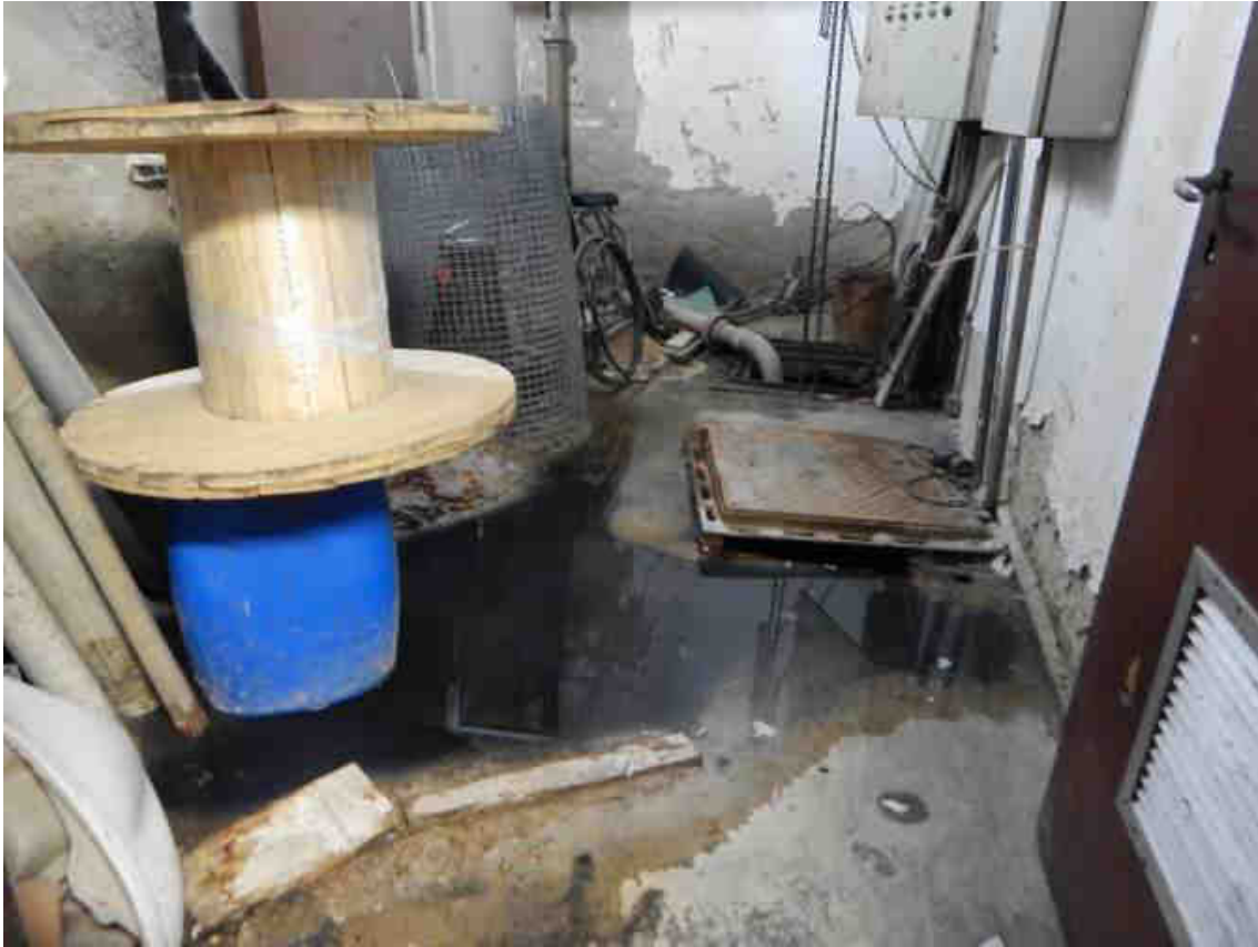
Figura 67 - Sala de bombeamento de esgoto com infiltrações e transbordamento
