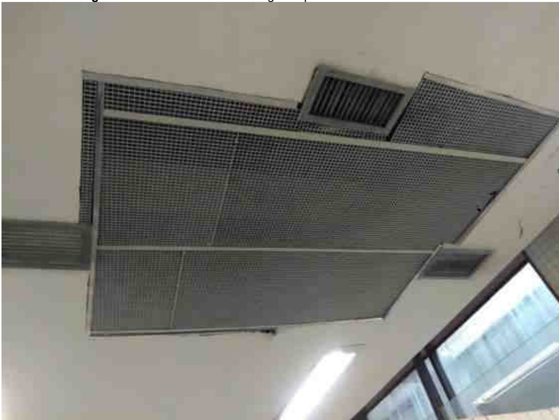
Figura 61 - Forro com remendo de grelha plástica nos banheiros do subsolo
