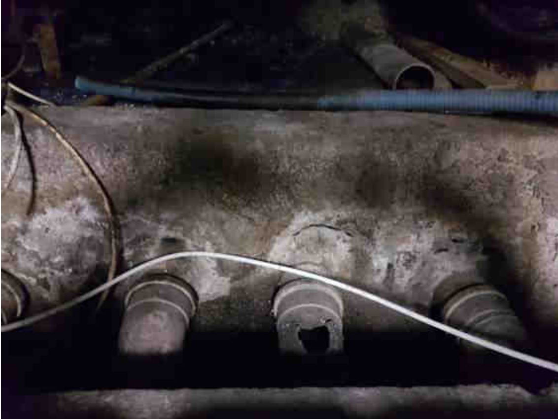
Figura 69 - Tubulações danificadas dentro da galeria em aduela pré-fabricada de concreto do subsolo
