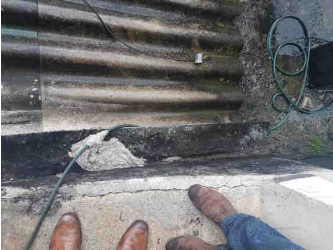
Figura 103 - Cordoalhas soltas e haste quebrada do sistema de SPDA
