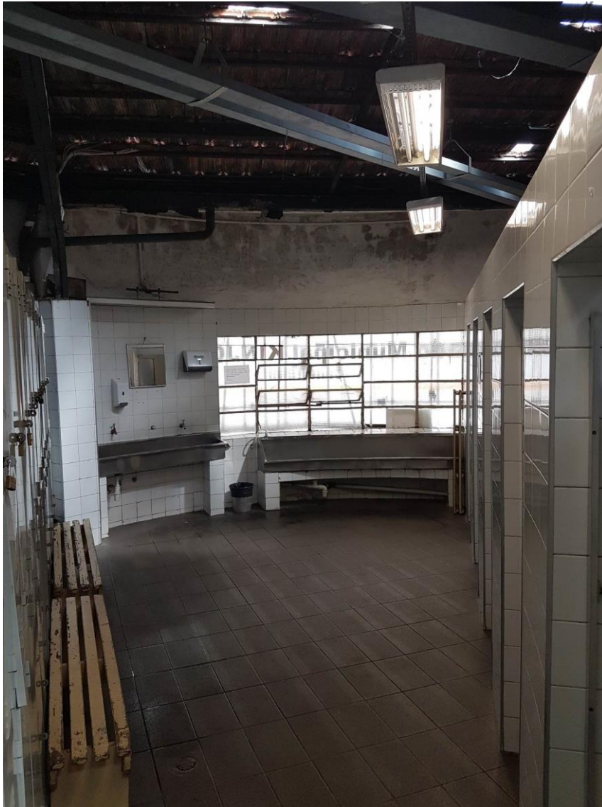
Figura 7 - Manchas de umidade na viga de concreto da estrutura da edificação do mezanino
