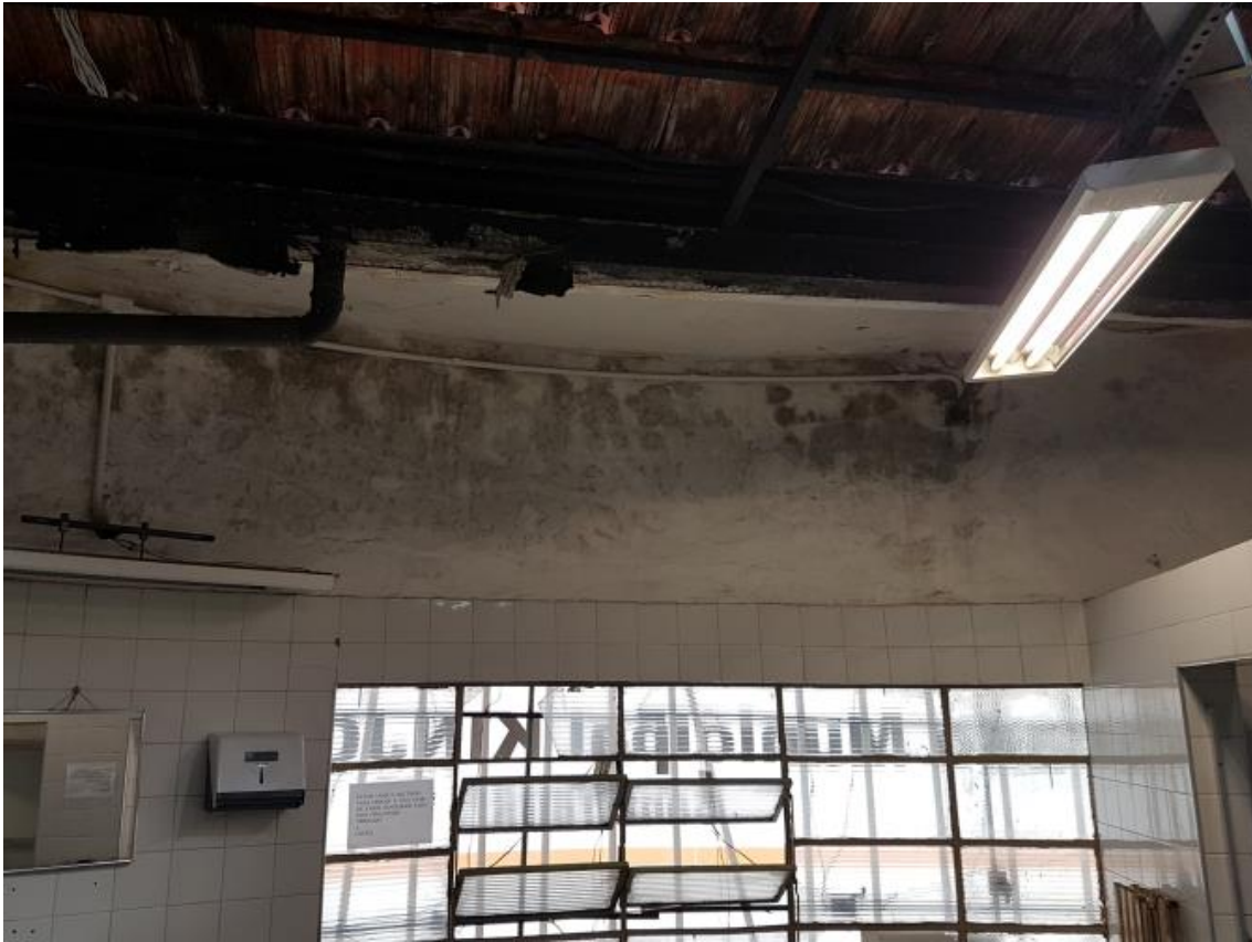
Figura 8 - Manchas de umidade na viga de concreto da estrutura da edificação do mezanino
