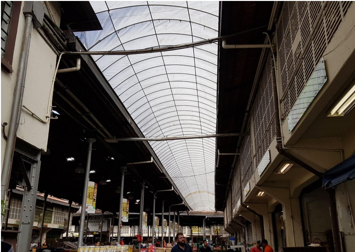
Figura 44 - Cobertura de policarbonato gerando desconforto térmico
