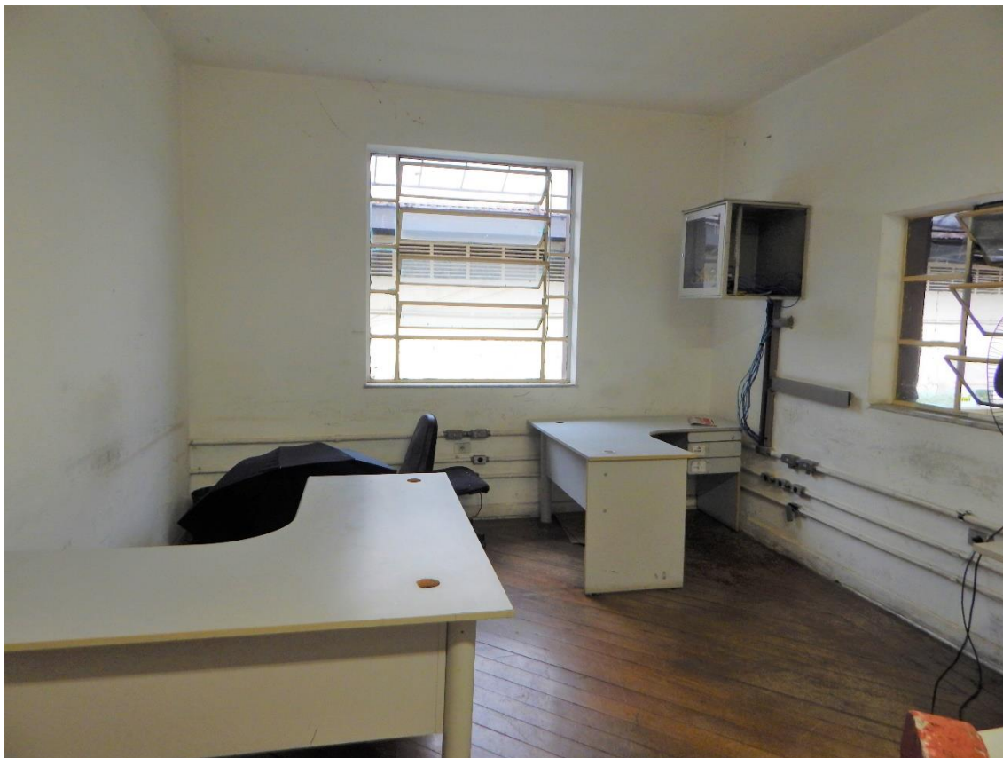
Figura 41 - Cabos expostos, instalação precária do servidor
