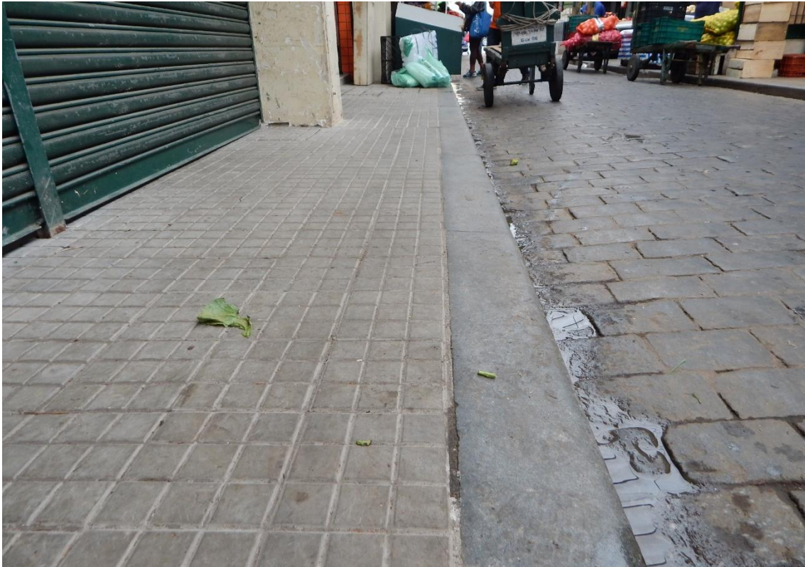
Figura 24 - Ladrilho hidráulico padrão existente apenas em alguns dos boxes
