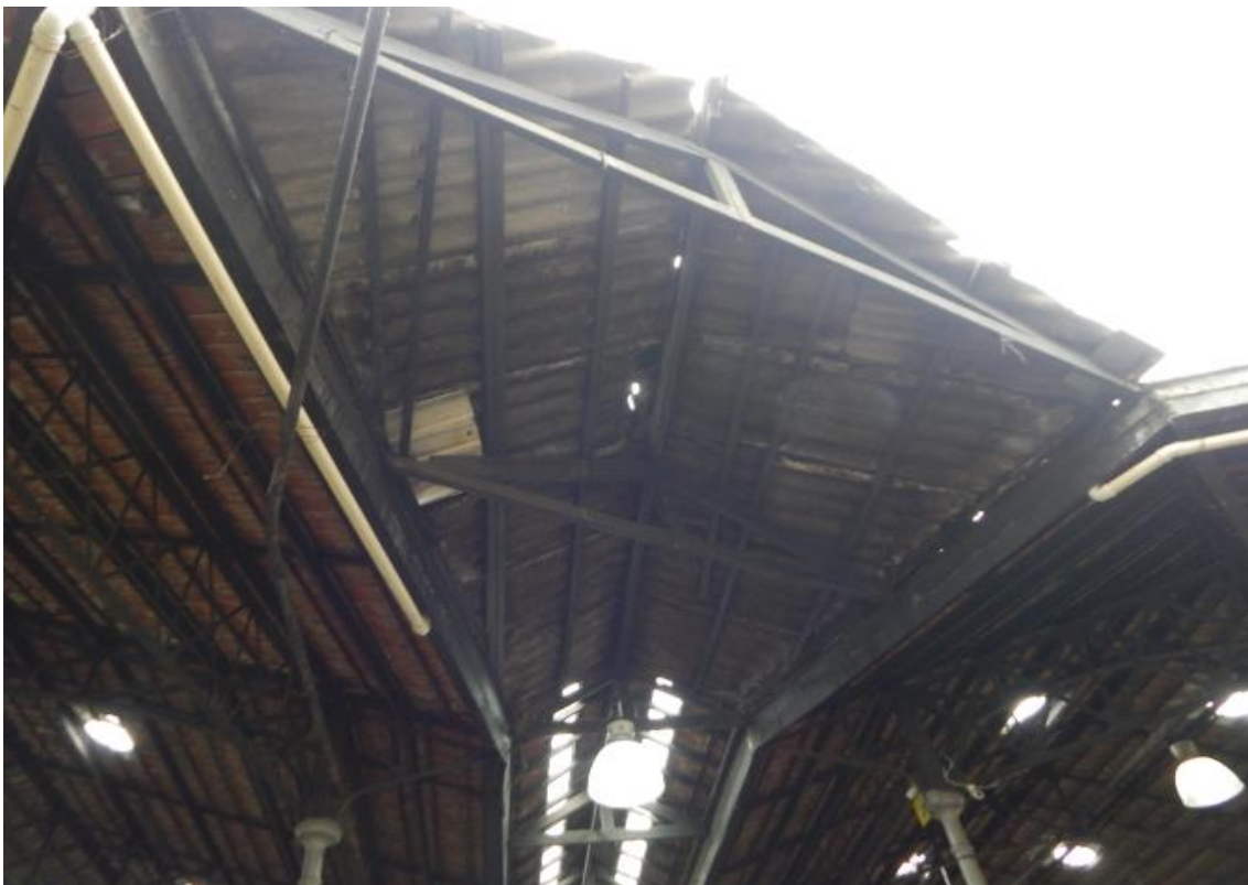
Figura 16 - Tesoura de madeira e telha de fibrocimento (desacordo com o projeto do telhado original)
