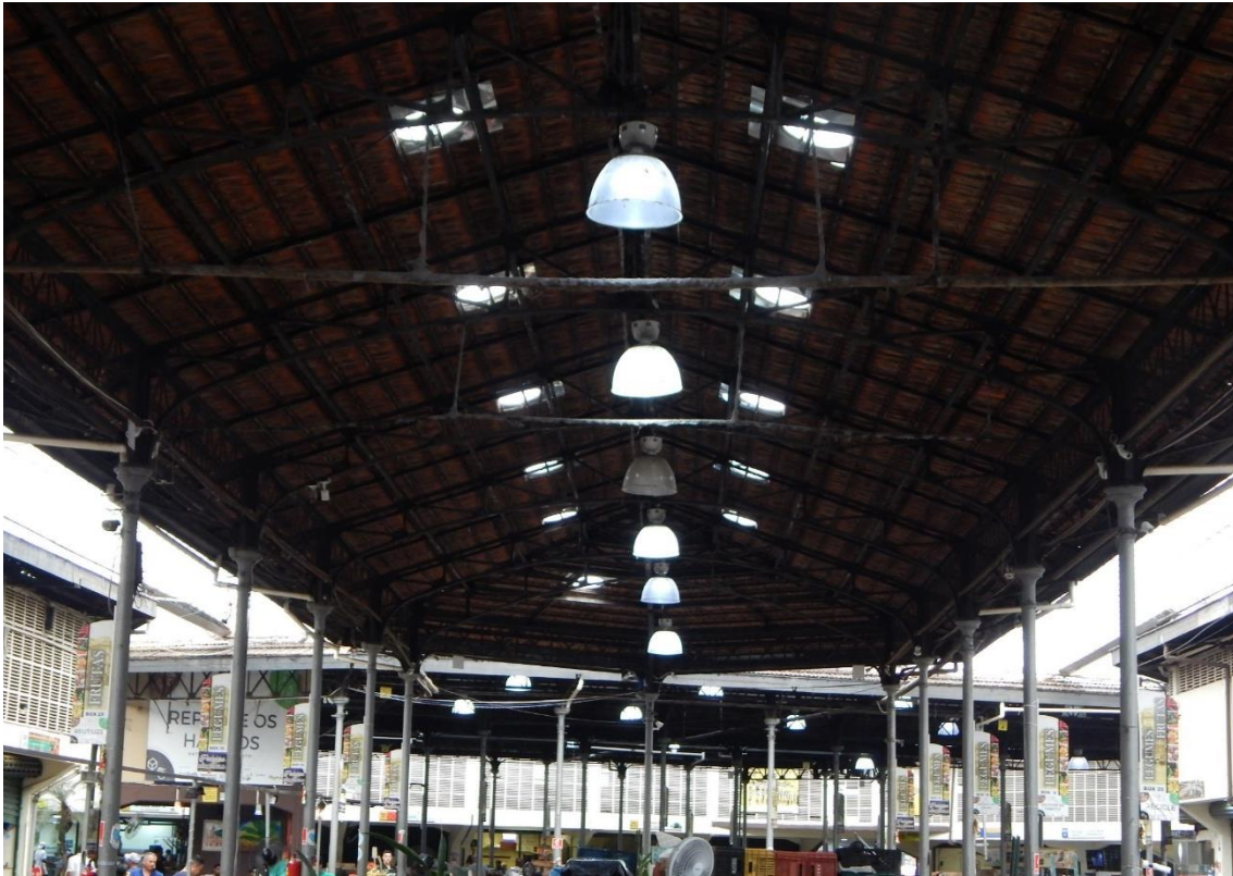
Figura 52 - Exaustores com ventilação natural instalados na cobertura, insuficientes para regular a temperatura do mercado
