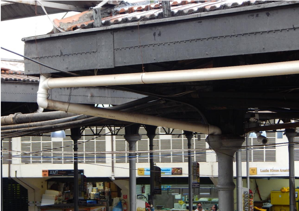
Figura 31 - Locação indevida, conflito com demais instalações
