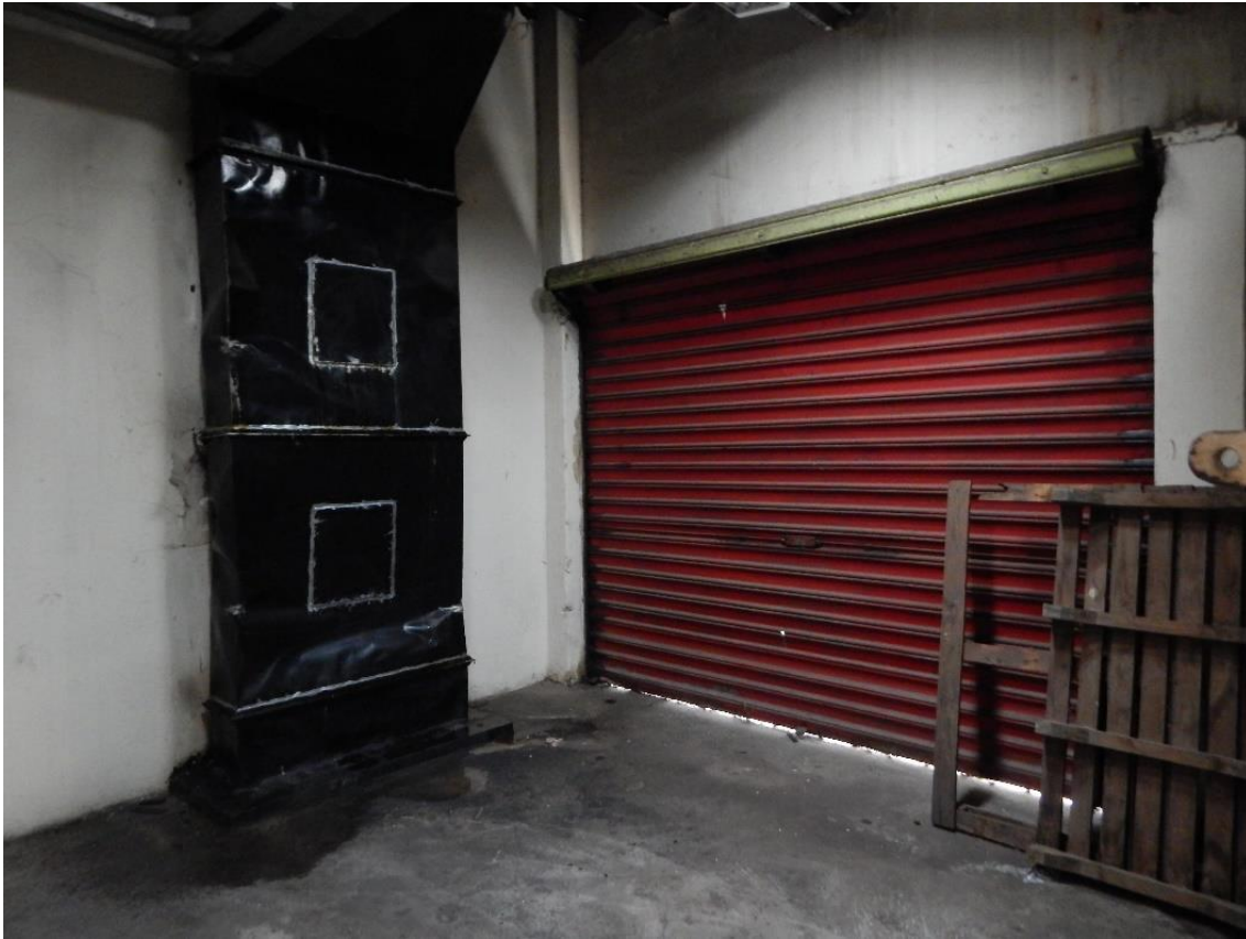
Figura 46 - Duto de exaustão de boxe de alimentação atravessando laje do mezanino
