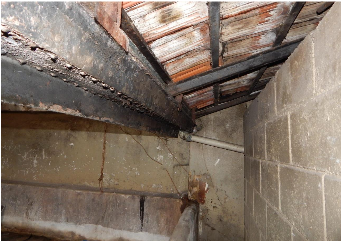
Figura 10 - Umidade nas telhas e alvenarias
