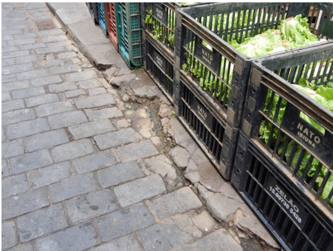
Figura 21 - Arruamento interno degradado
