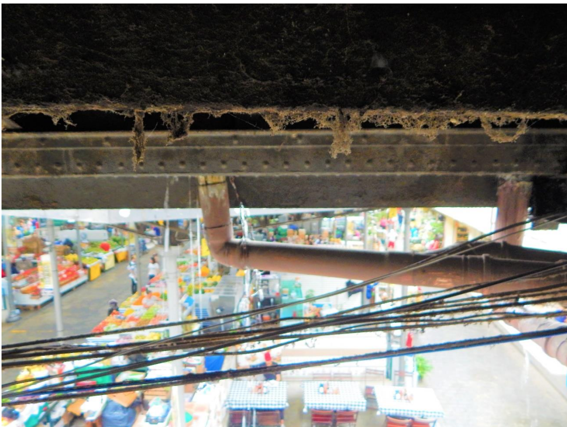
Figura 32 - Extravasamento de calhas
