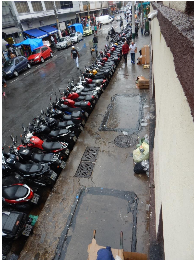
Figura 1 - Revestimento externo das calçadas com trincas e lixo acumulado
