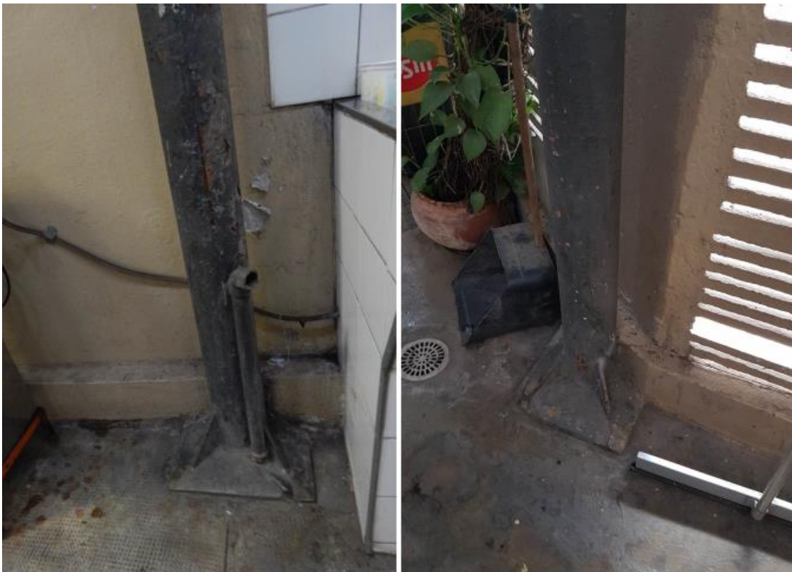
Figura 5 A e 5 B - Corrosão em pilares metálicos
