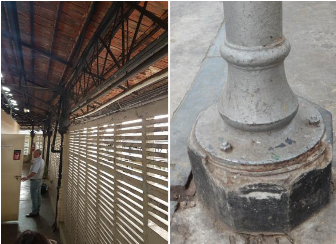
Figura 6 A e 6 B - Alinhamento vertical da alvenaria invadindo a área dos pilares e desgaste da estrutura da base dos pilares
