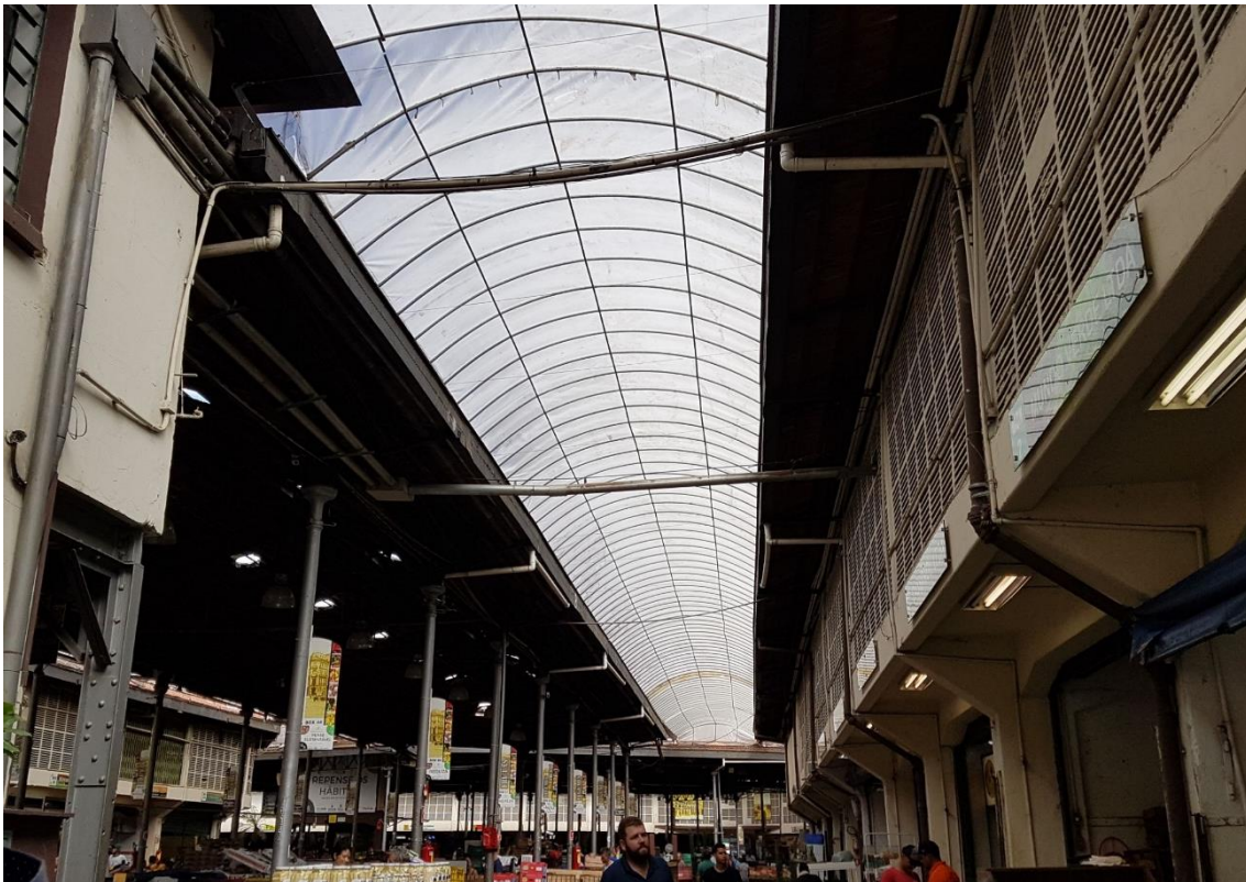
Figura 51 - Cobertura de policarbonato gerando calor excessivo
