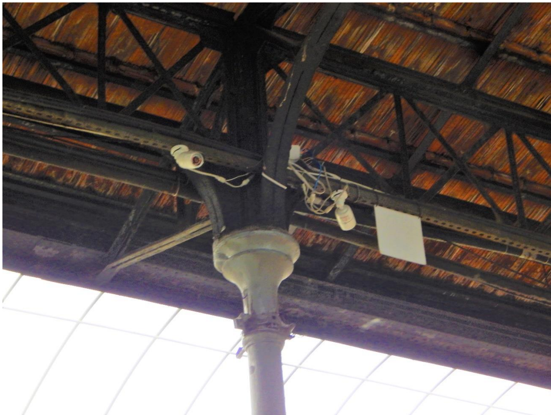
Figura 39 - Cabos expostos, instalação precária do sistema
