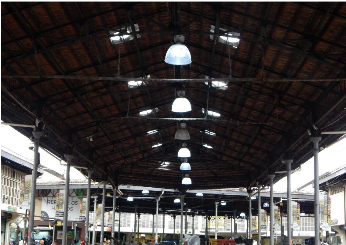
Figura 45 - Exaustor eólico instalado nas telhas, insuficientes para regular a temperatura do mercado
