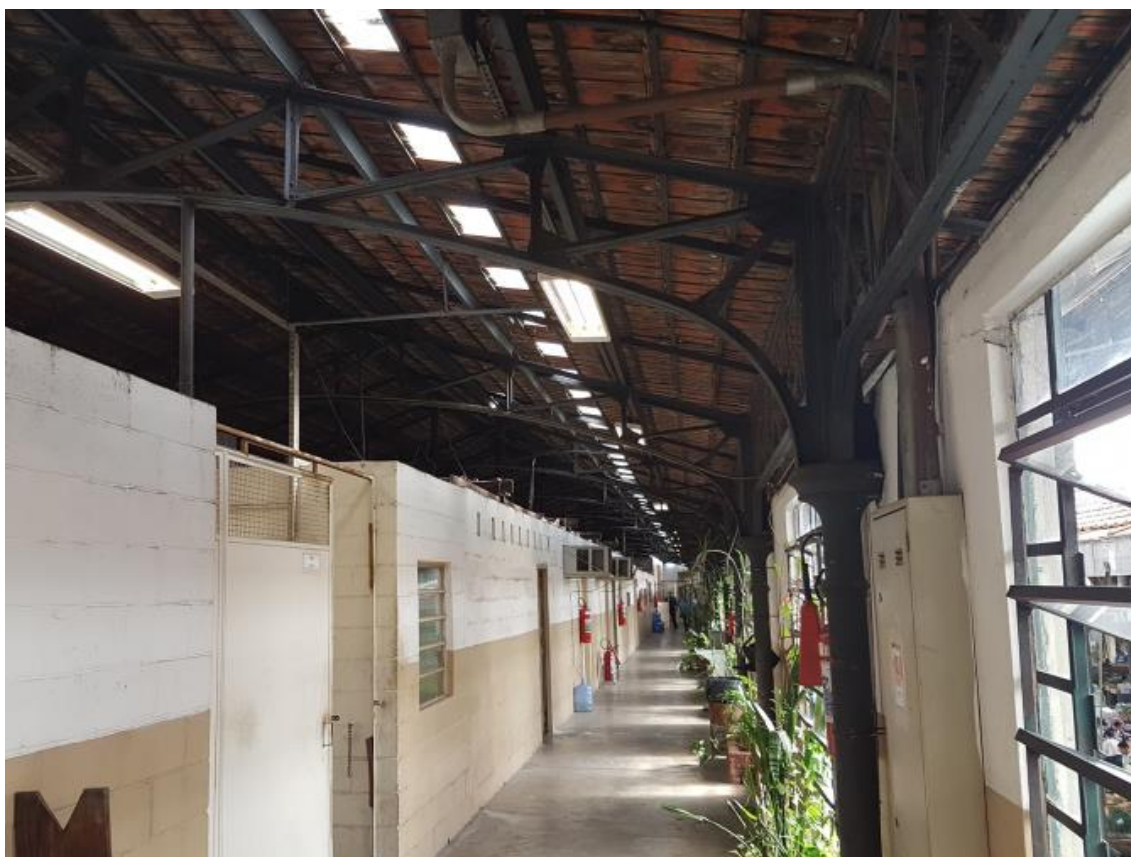
Figura 2 - Oxidação na estrutura metálica da cobertura
