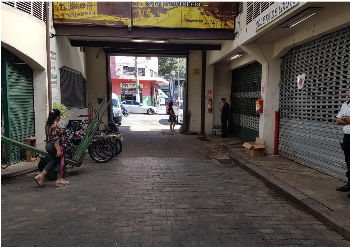
Figura 9 - Falta de caimento para o bueiro
