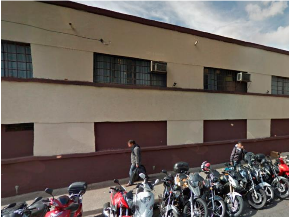
Figura 14 - Caixas de ar condicionado aparente na fachada
