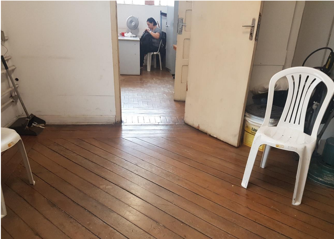
Figura 22 - Piso de madeira degradado
