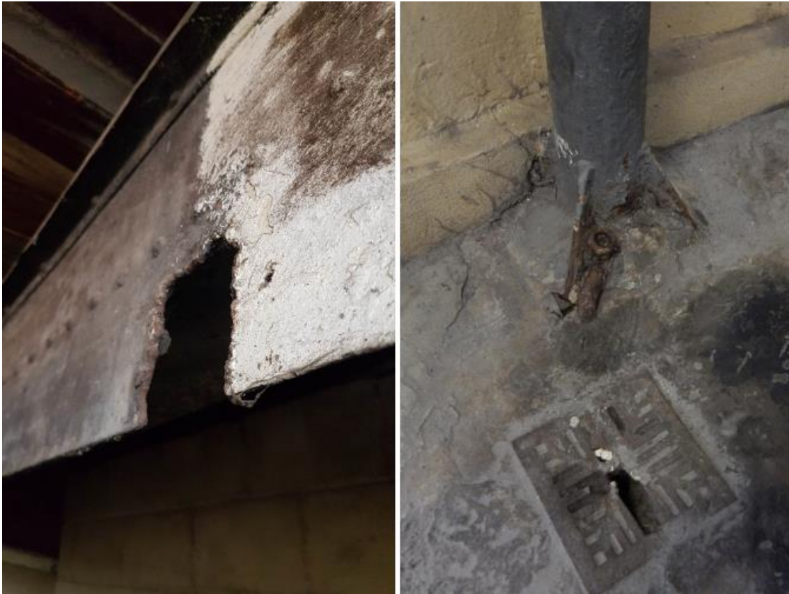
Figura 4 A e 4 B - Corrosão da testeira e da base pilar metálico
