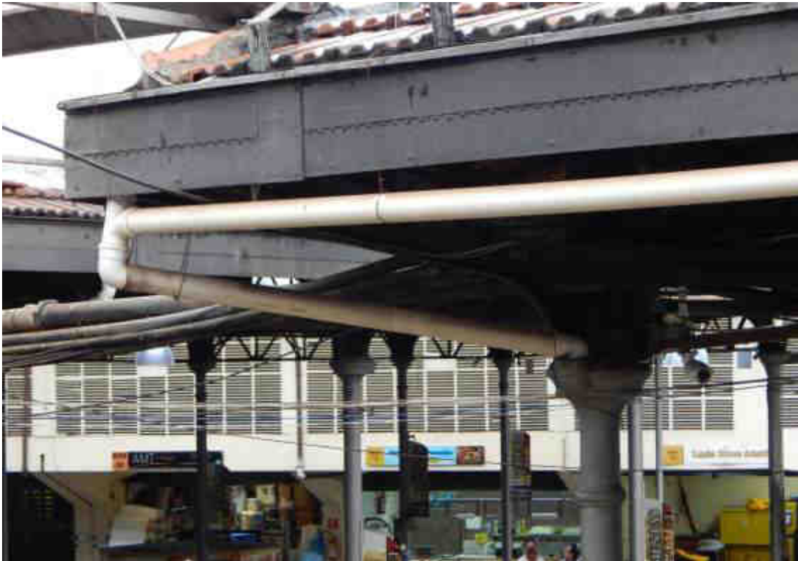
Figura 31 - Locação indevida, conflito com demais instalações
