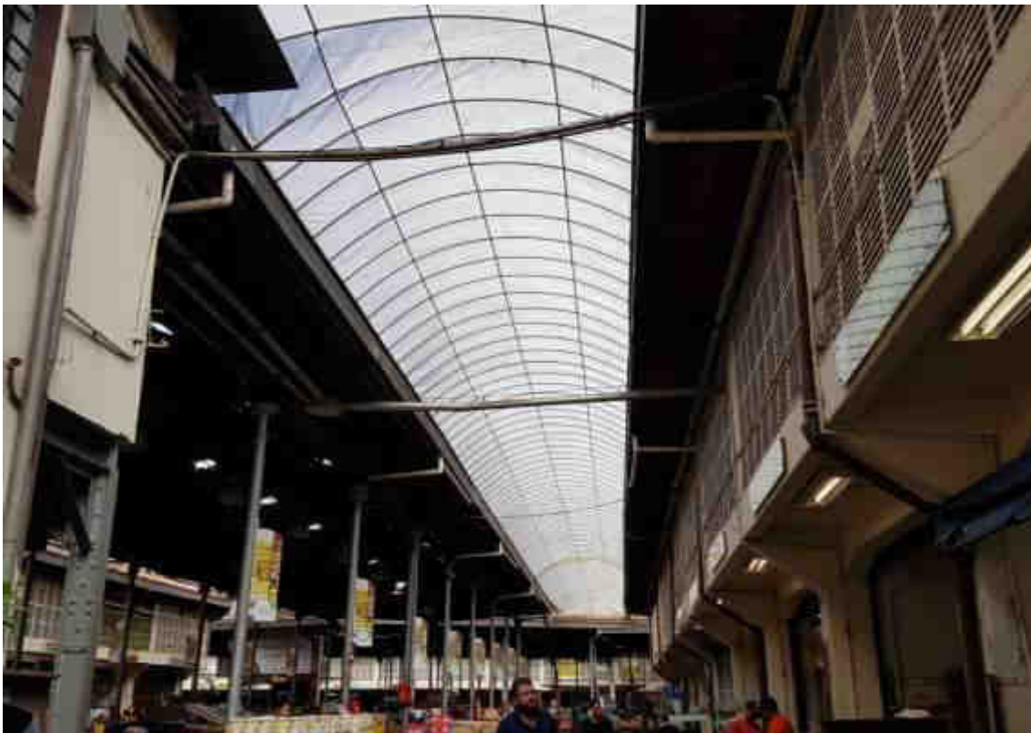
Figura 51 - Cobertura de policarbonato gerando calor excessivo
