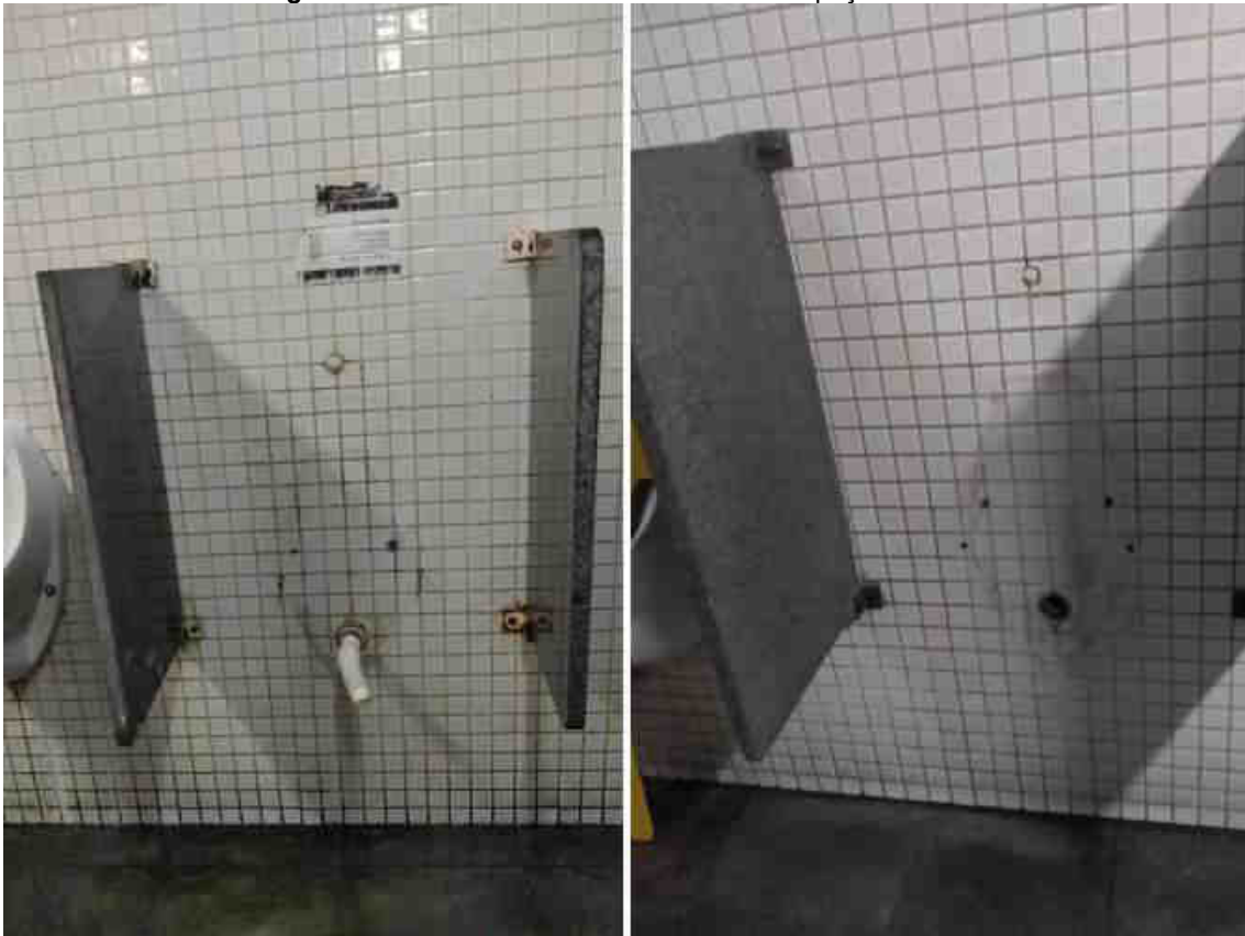
Figura 105 e 106 – Banheiros no subsolo com peças faltantes
