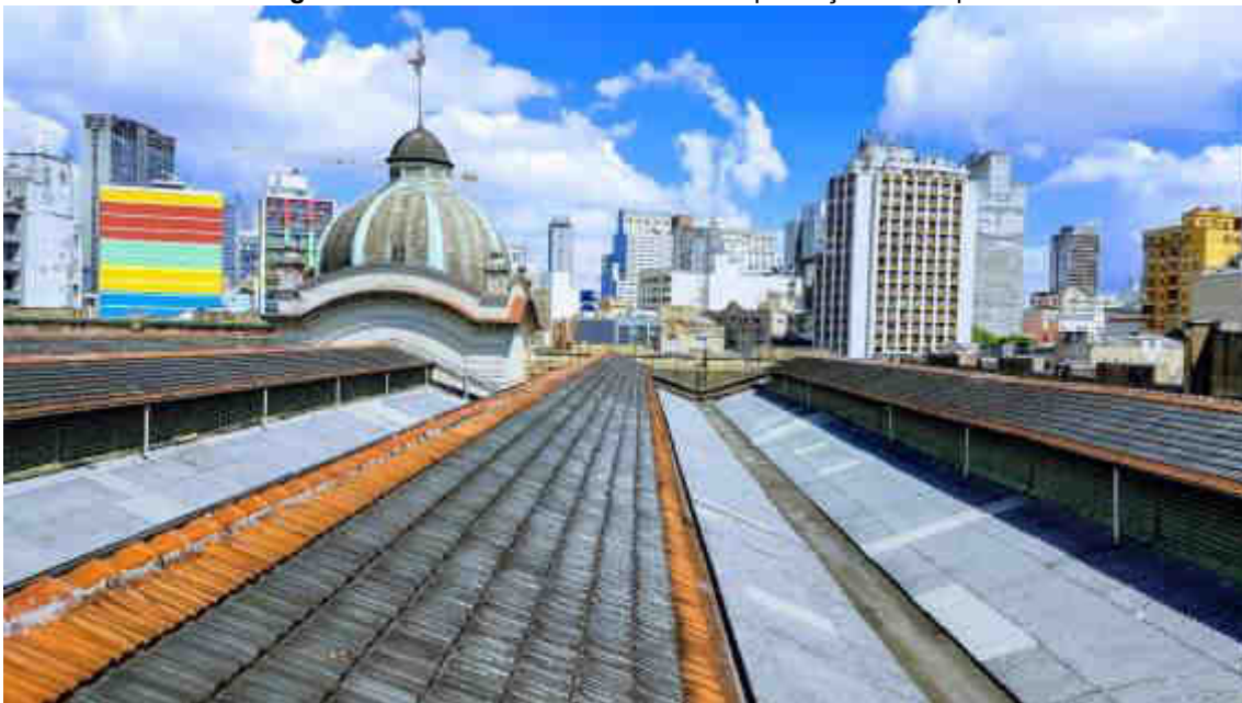
Figura 30 - Telhas de vidros escurcidas pela ação do tempo
