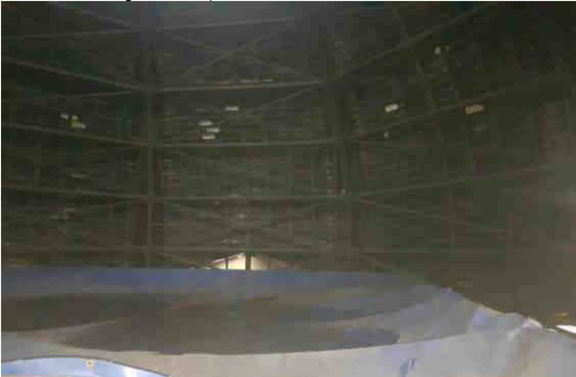
Figura 73 - Lona plástica sobre o reservatório de uma das torres
