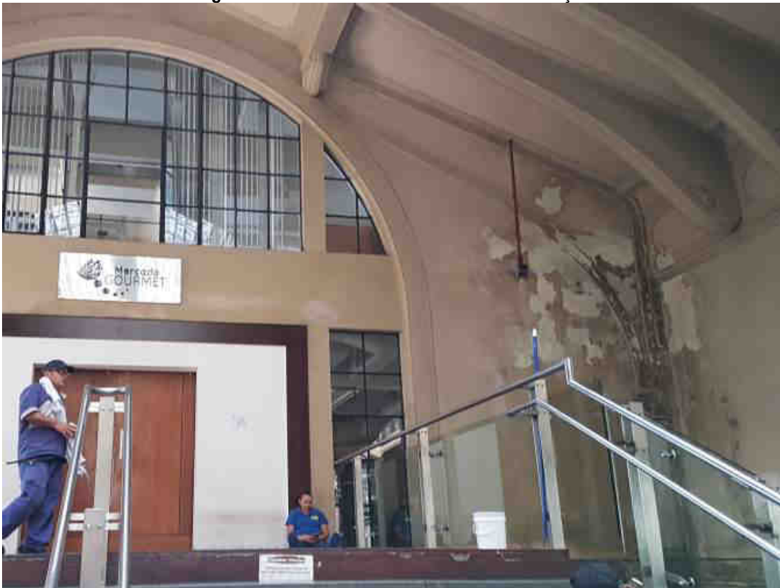
Figura 37 - Parede interna com manchas e infiltração
