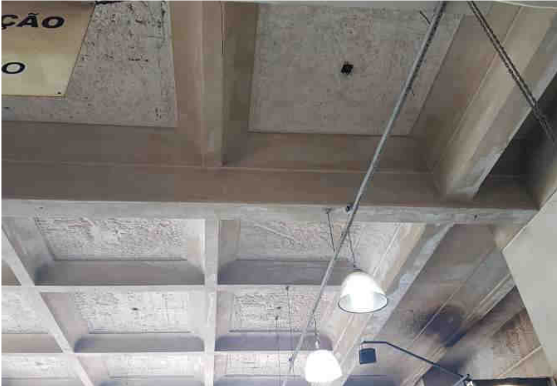
Figura 9 - Laje com armadura exposta e sujeira
