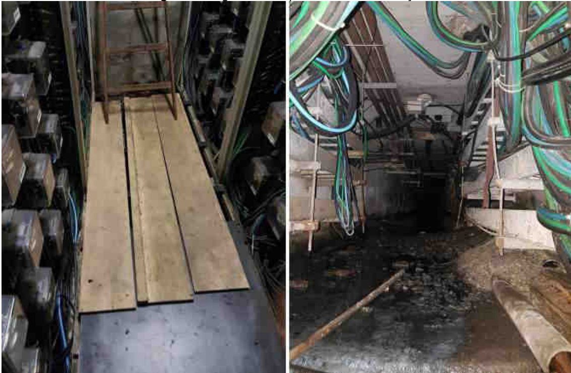
Figura 75 - Centro de medição com piso elevado improvisado por conta de vazamento permanente. Figura 76 - Água escorre para o centro de medição
