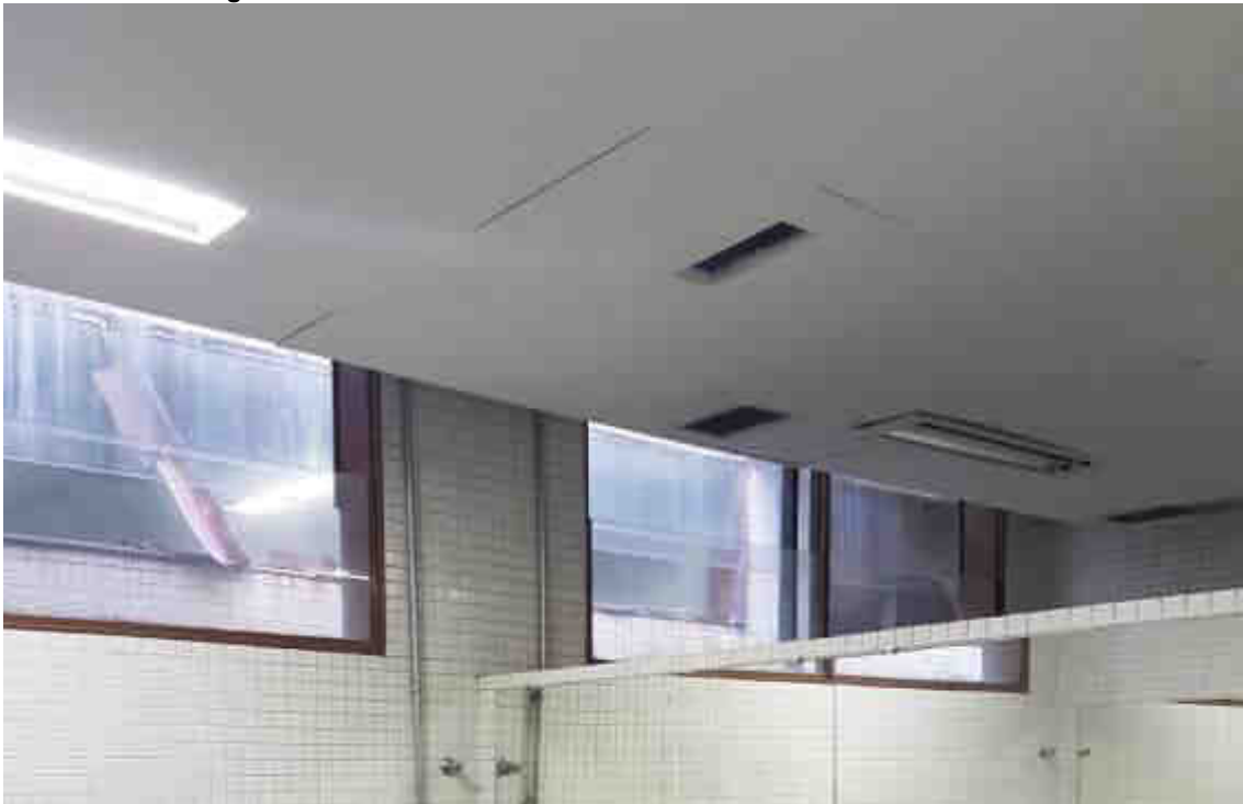
Figura 60 - Forro com descolamento e frestas nos banheiros do subsolo
