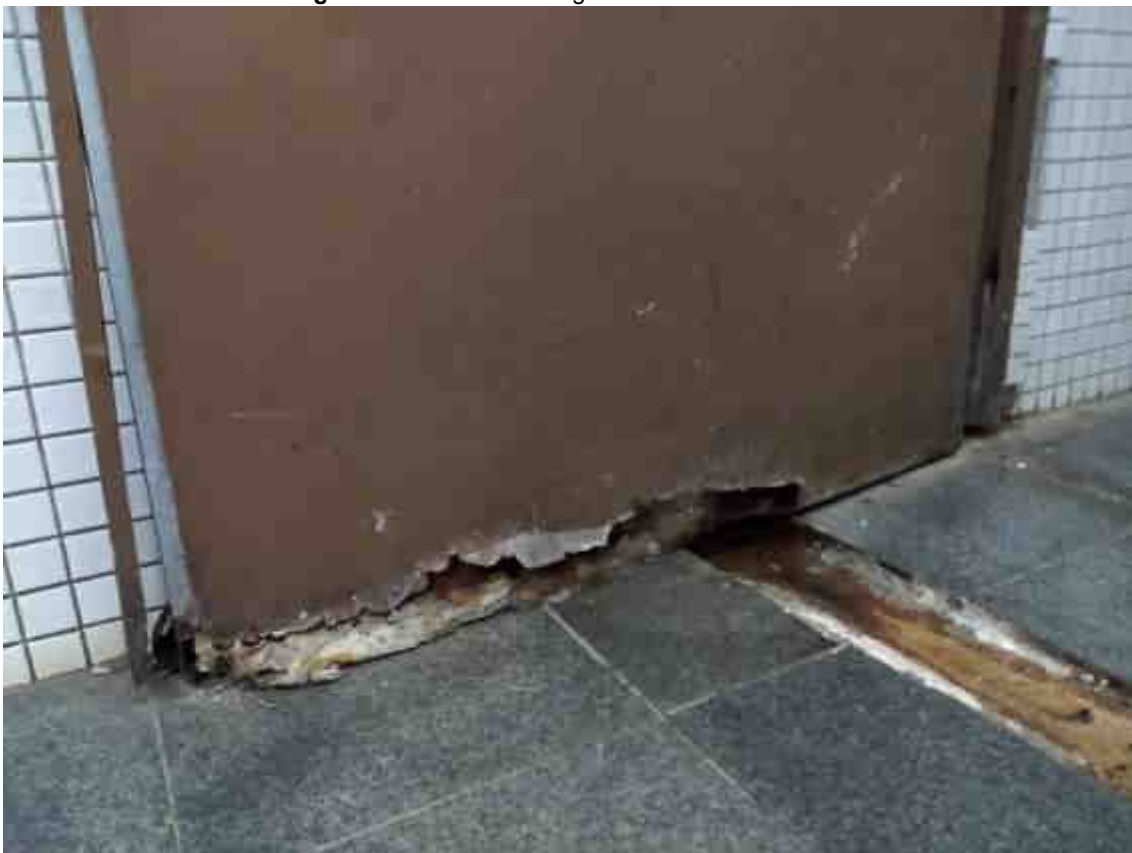
Figura 98 - Porta corta- fogo do subsolo deteriorada
