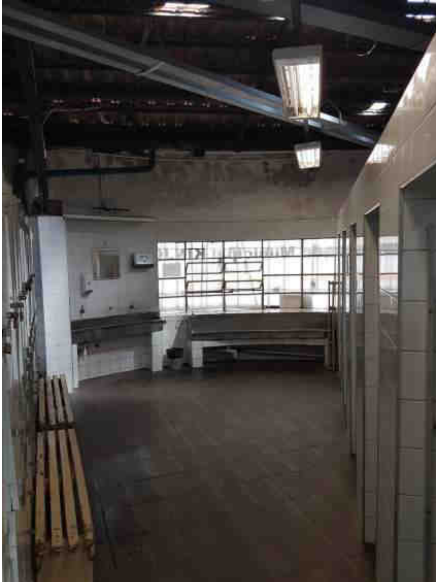
Figura 7 - Manchas de umidade na viga de concreto da estrutura da edificação do mezanino
