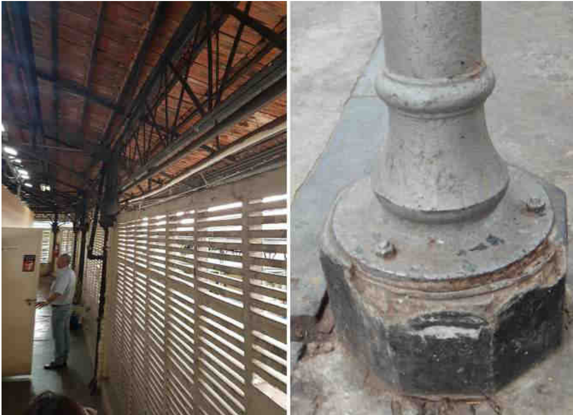
Figura 6 A e 6 B - Alinhamento vertical da alvenaria invadindo a área dos pilares e desgaste da estrutura da base dos pilares
