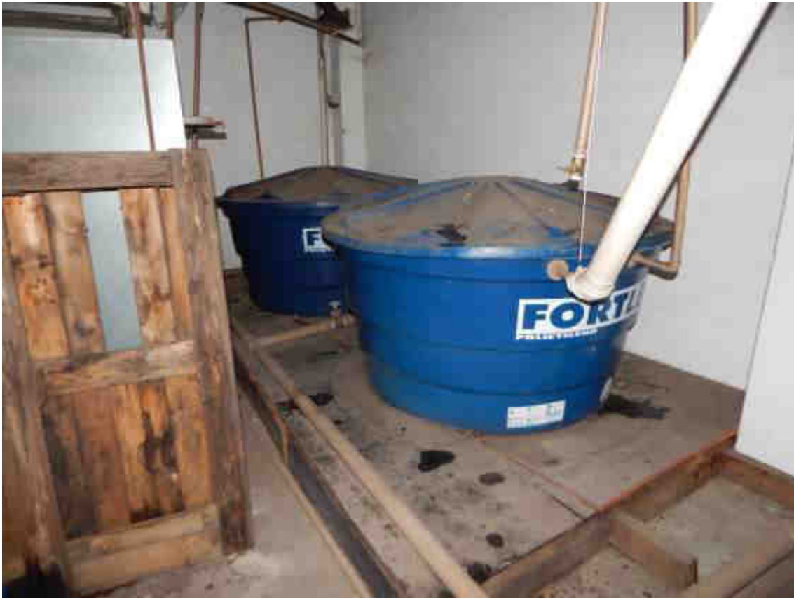
Figura 35 - Caixas d'água dos sanitários
