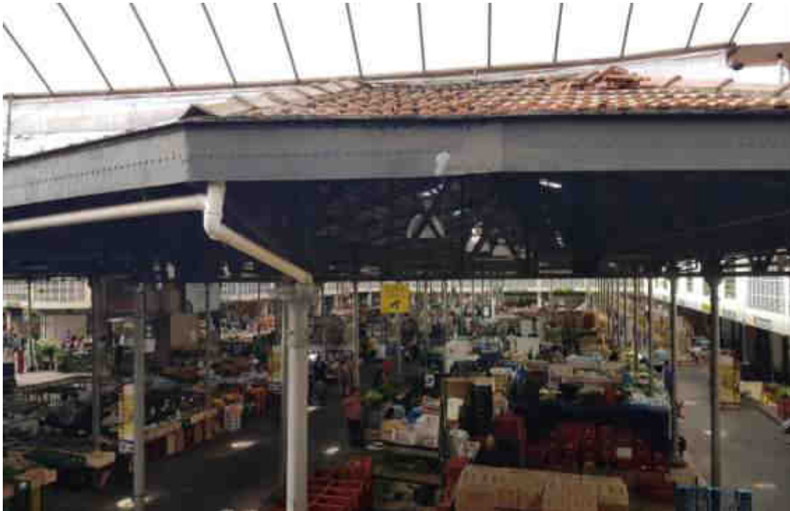
Figura 17 - Tubulação de água pluvial (destoando do conjunto arquitetônico), cobertura em policarbonato (desacordo com o projeto do telhado original)
