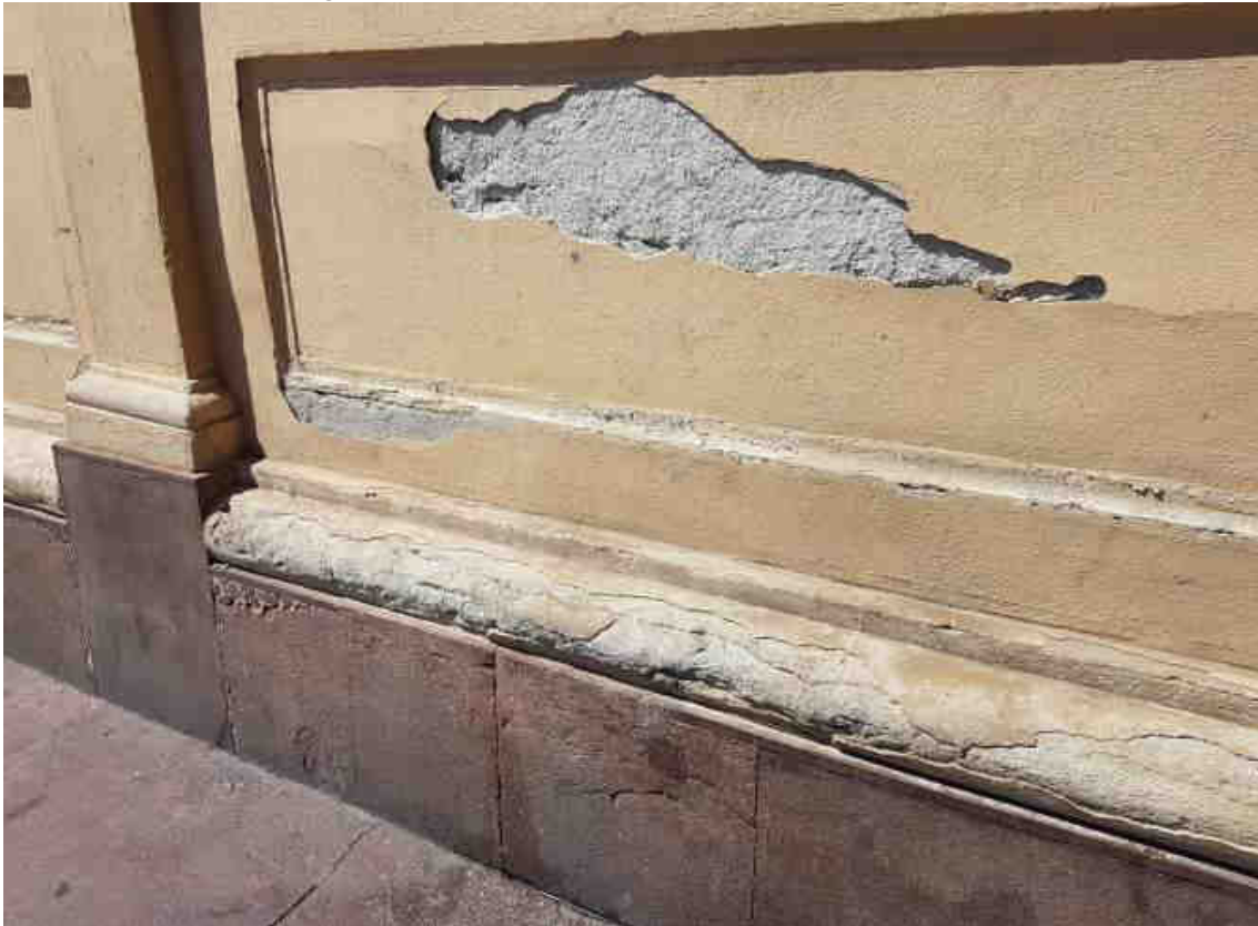
Figura 23 - Fachada com deslocamento do revestimento
