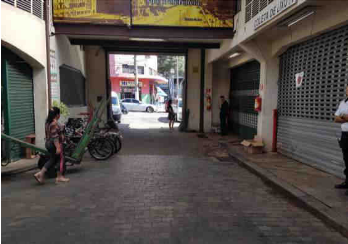
Figura 9 - Falta de caimento para o bueiro
