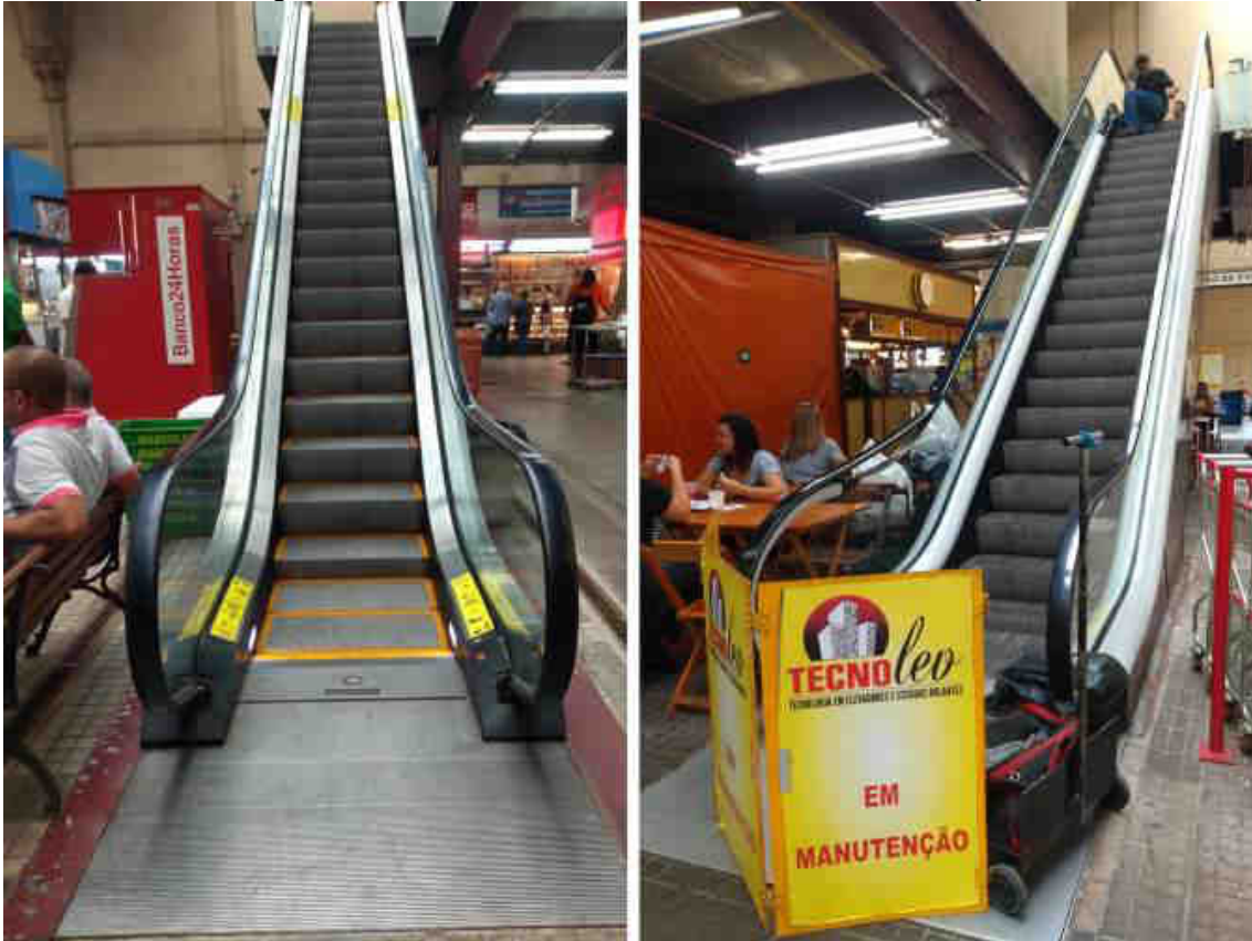
Figura 85 - Escada rolante acesso ao mezanino Figura 86 - Escada rolante acesso ao mezanino em manutenção
