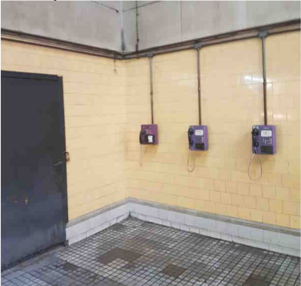
Figura 56 - Ladrilho hidráulico com remendos de outros tons diferentes
