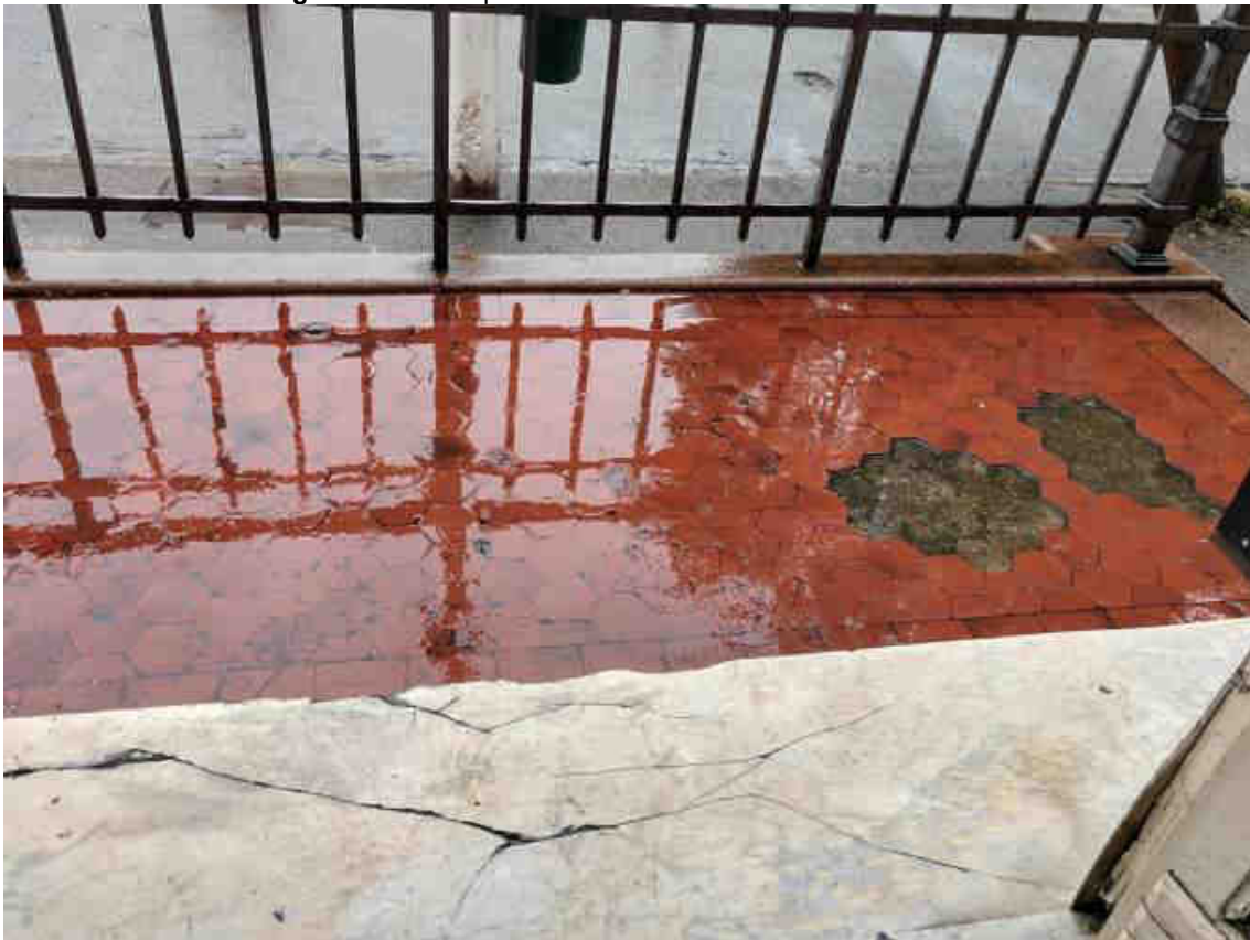
Figura 47 - Piso apresentando trincas e falta de revestimento
