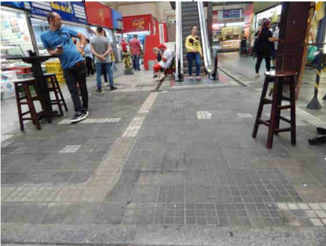
Figura 54 - Ladrilho hidráulico com sujidades e remendos
