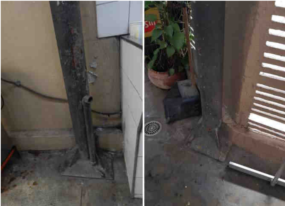
Figura 5 A e 5 B - Corrosão em pilares metálicos
