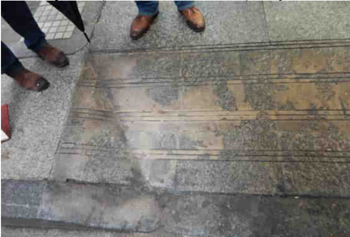
Figura 55 - Rampa de acessibilidade com material antiderrapante desgastado
