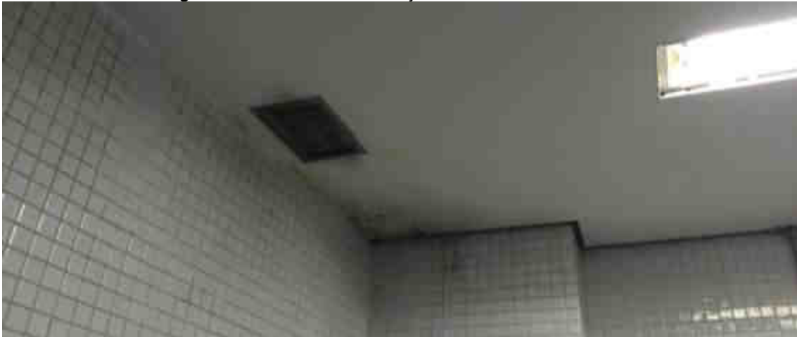
Figura 62 - Forro com bolor e sujeira nos banheiros do subsolo
