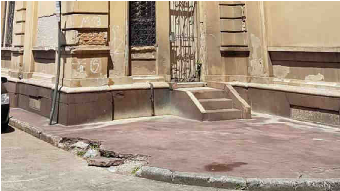
Figura 24 - Mancha na alvenaria, deslocamento do revestimento
