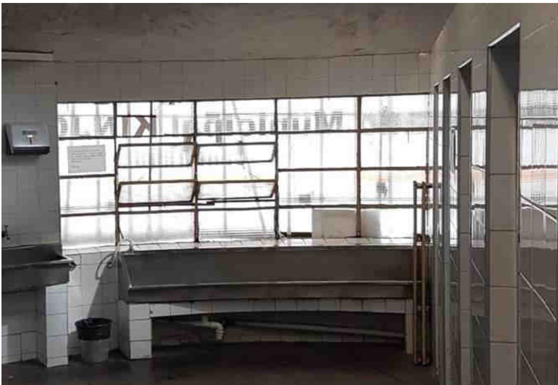
Figura 28 - Caixilho com corrosão e vidros faltantes do mezanino
