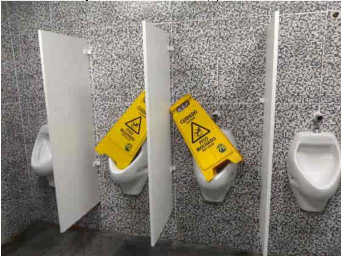
Figura 109 - Banheiros no subsolo com peças fora de uso
