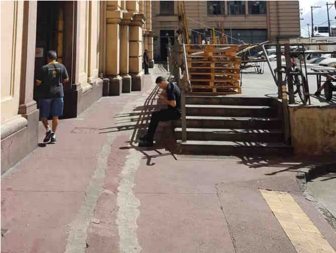
Figura 2 - Calçada com remendos no revestimento
