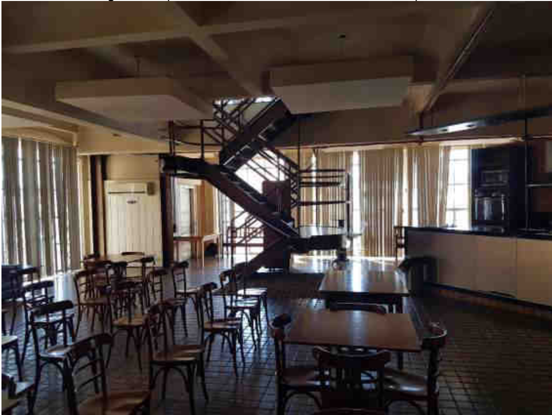
Figura 88 - Aparelho de ar condicionado na área de eventos privados
