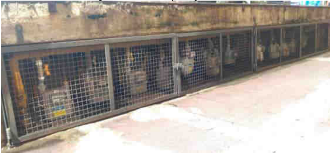
Figura 82 - Área de medição de gás canalizado
