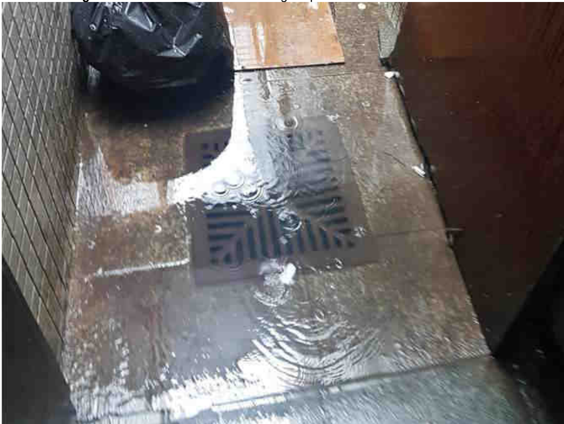
Figura 71 - Ralo sem escoamento de águas pluviais – Corredor técnico subsolo
