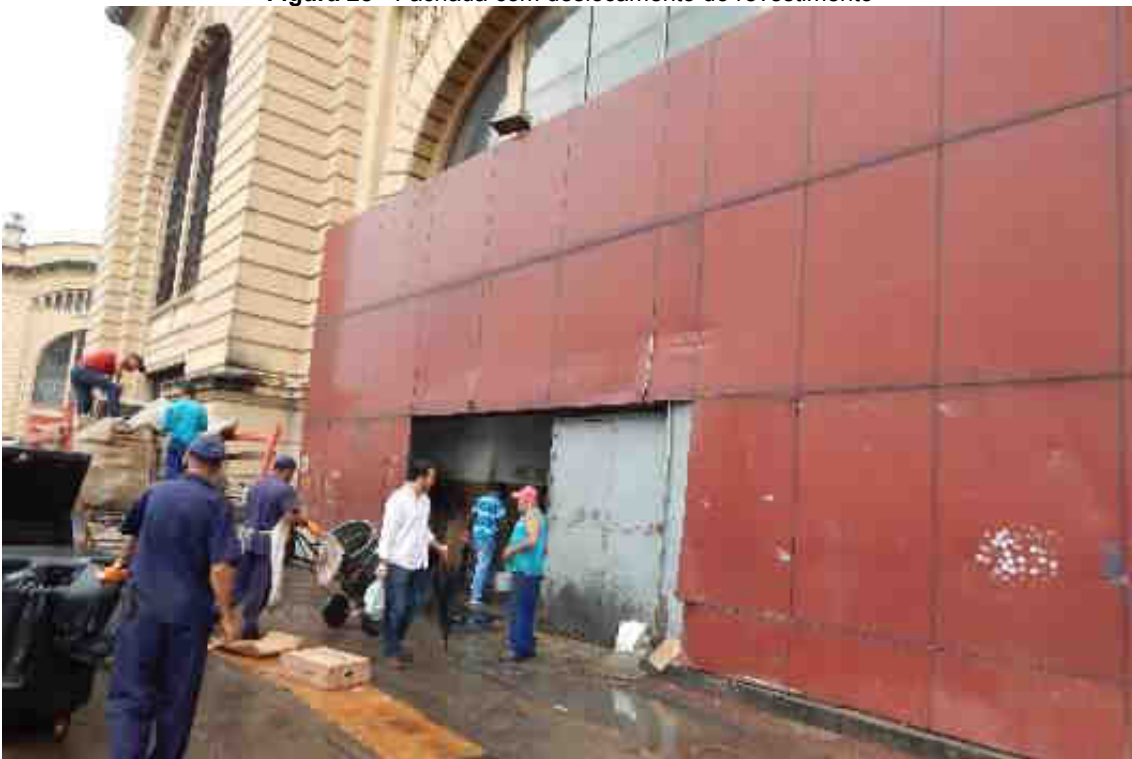
Figura 28 - Fachada com deslocamento do revestimento
