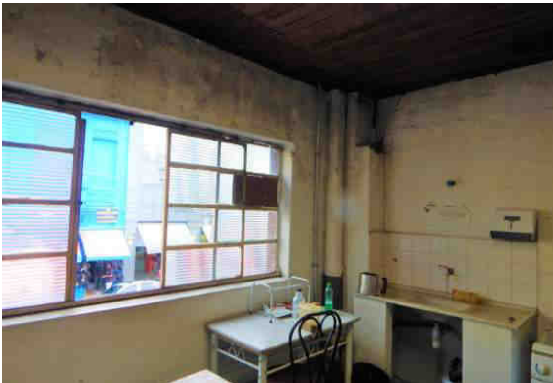
Figura 29 - Caixilho com corrosão e vidros faltantes do mezanino
