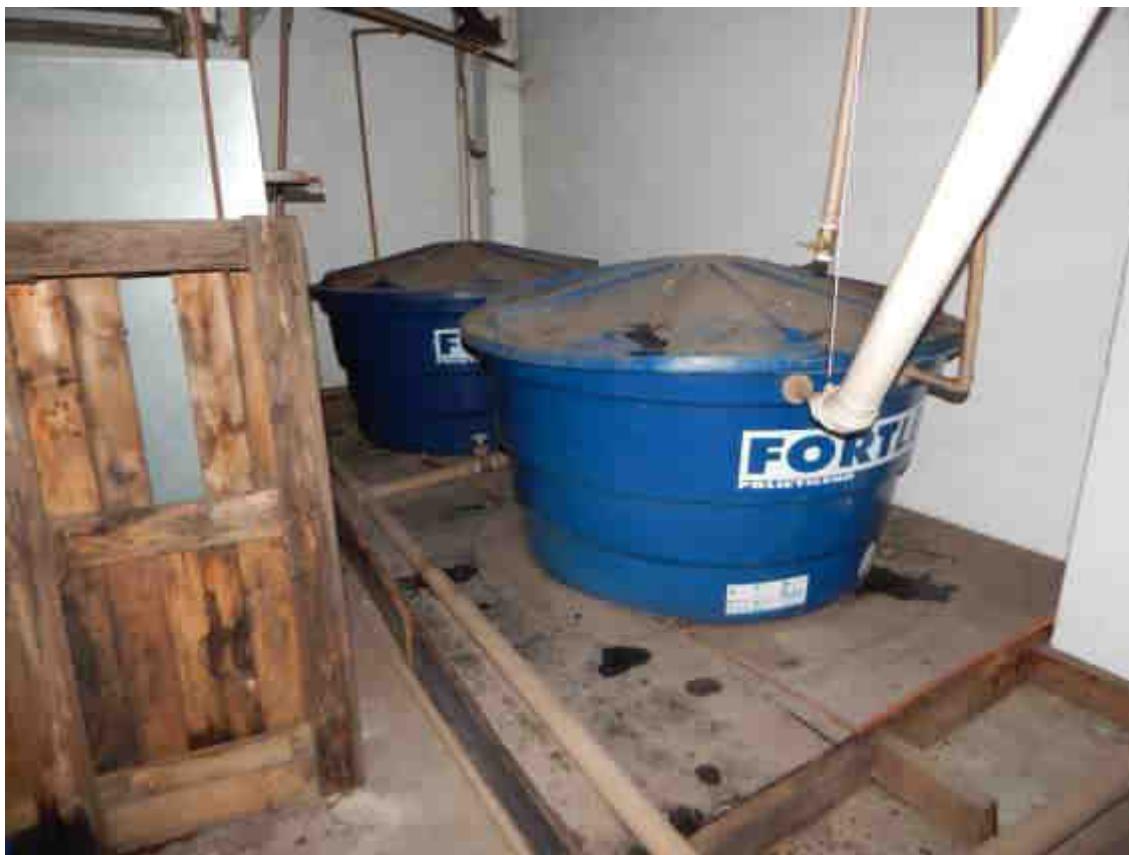
Figura 56 - Caixas d'água dos sanitários
