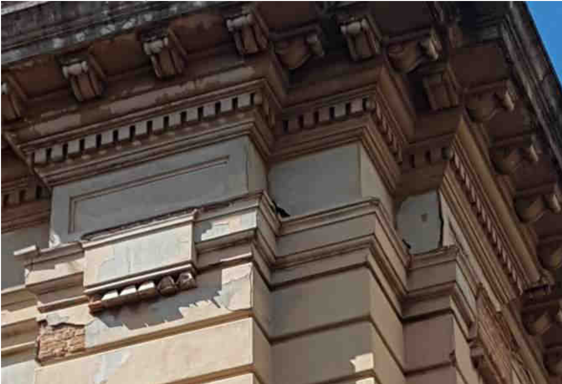
Figura 21 - Fachada com deslocamento do revestimento
