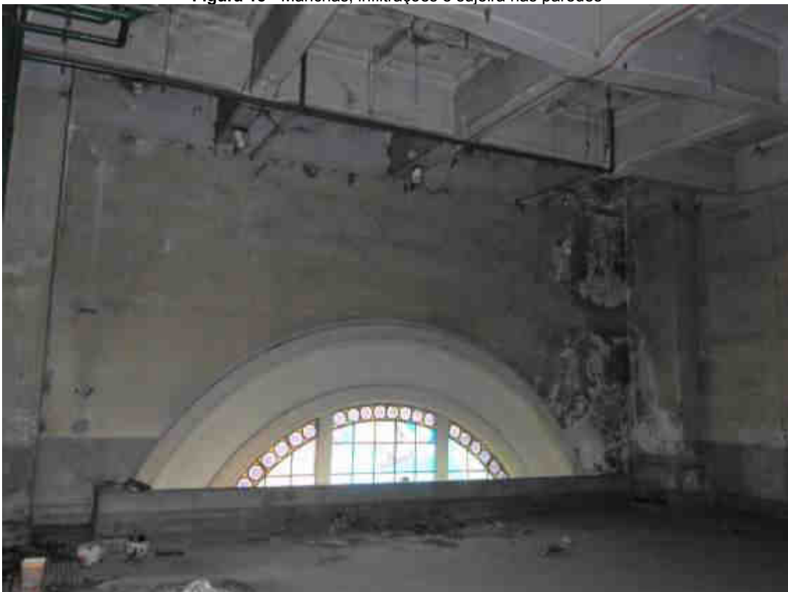
Figura 18 - Manchas, infiltrações e sujeira nas paredes
