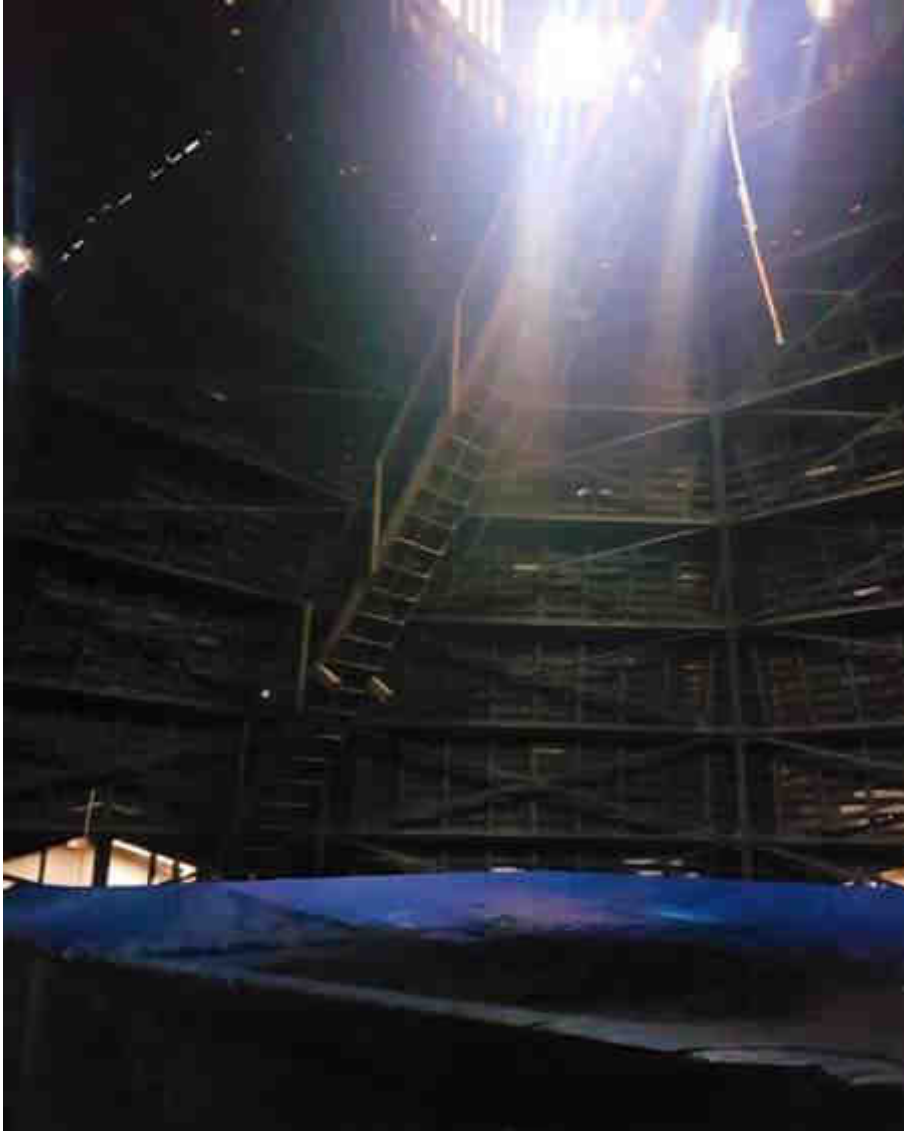
Figura 74 - Água acumulada sobre a lona plástica do reservatório de uma das torres
