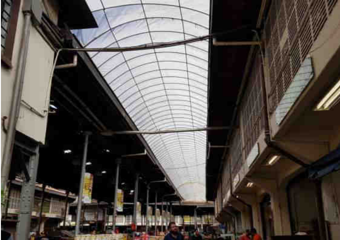
Figura 44 - Cobertura de policarbonato gerando desconforto térmico
