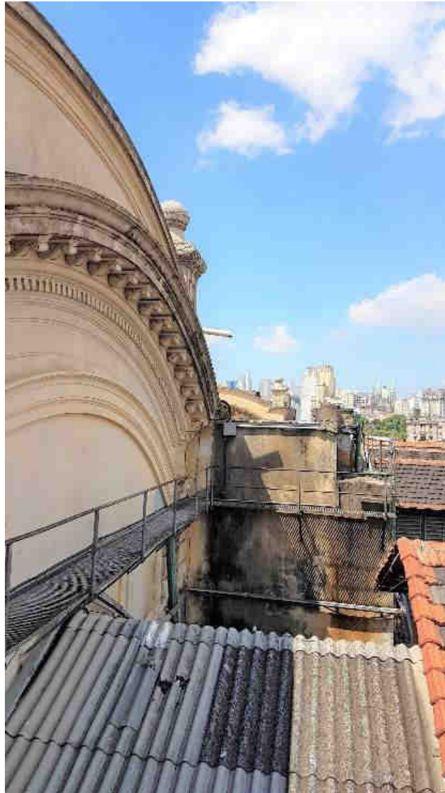
Figura 31 - Passarela de manutenção e telhas de fibrocimento com remendos
