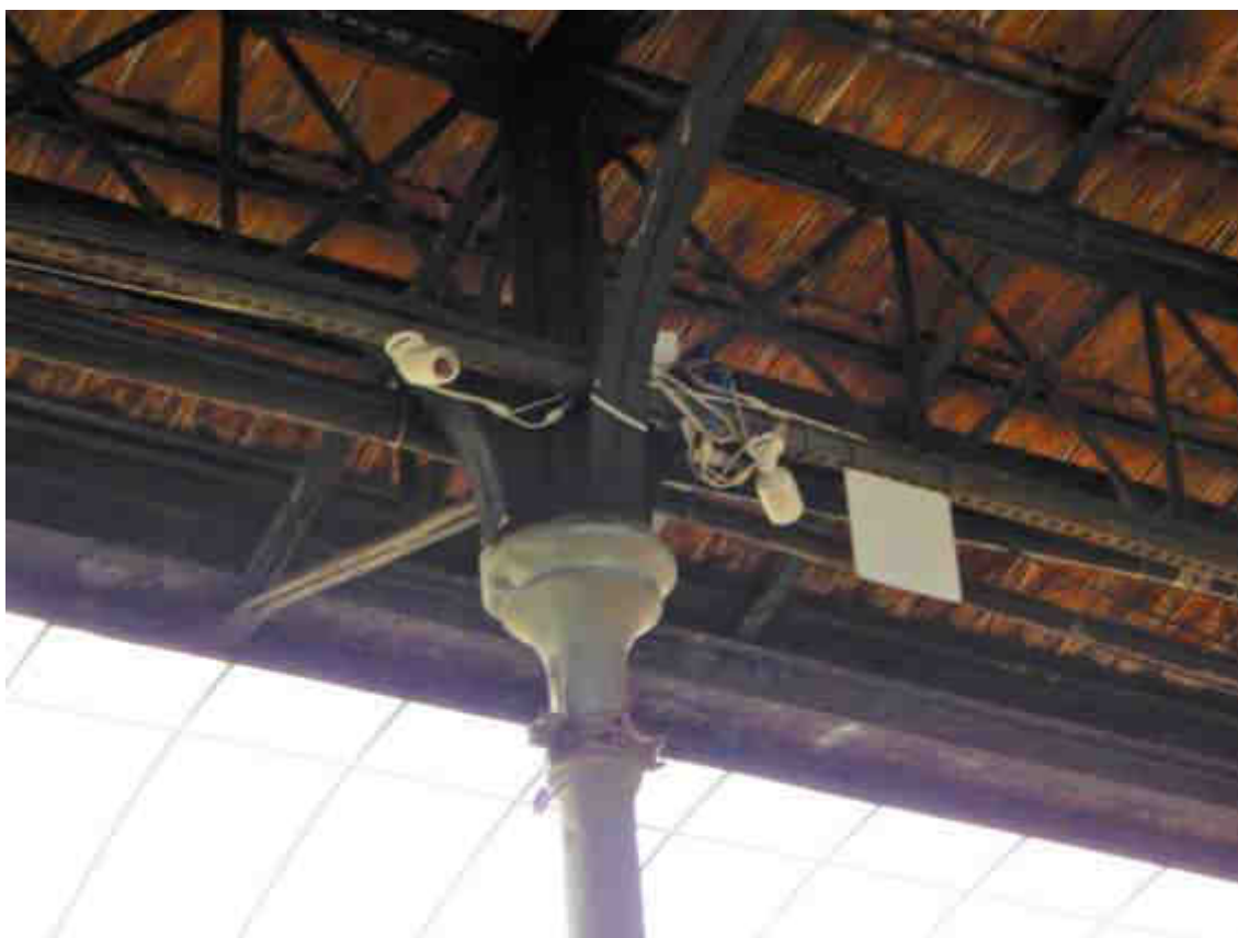
Figura 39 - Cabos expostos, instalação precária do sistema
