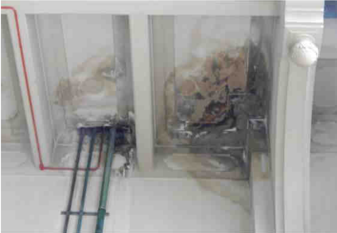
Figura 58 - Manchas, infiltrações na laje
