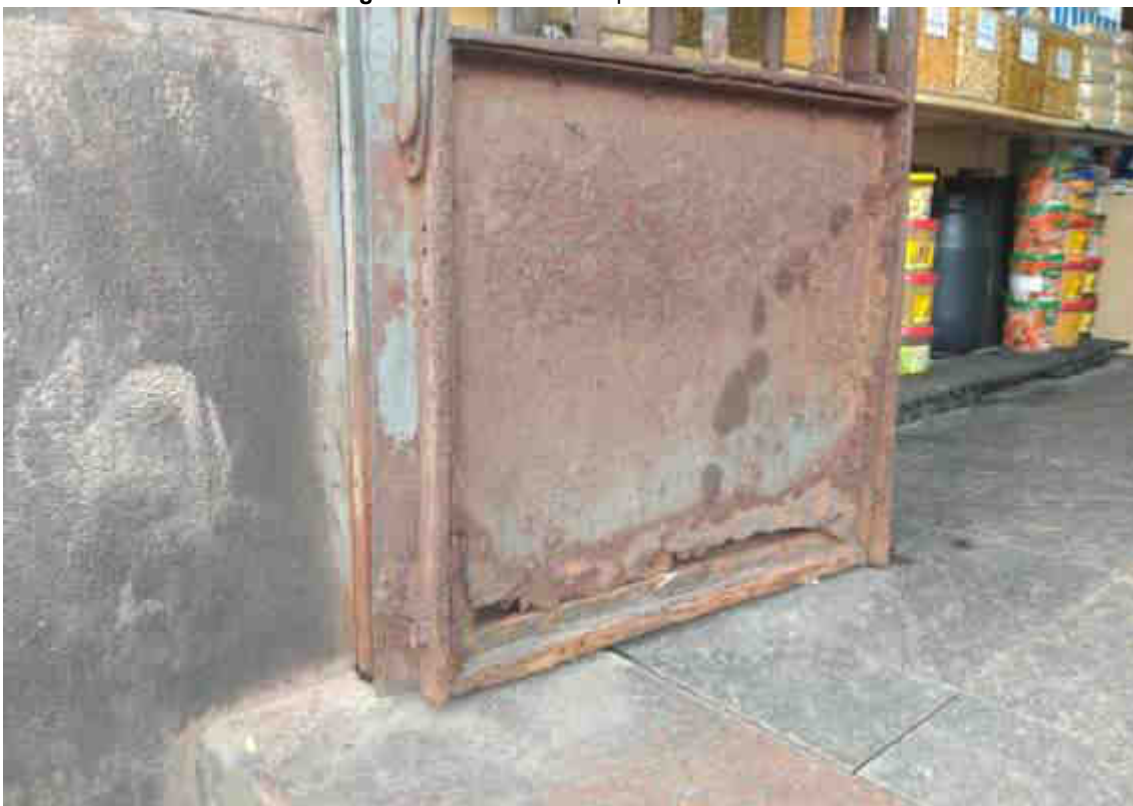
Figura 64 - Corrosão dos portões metálicos
