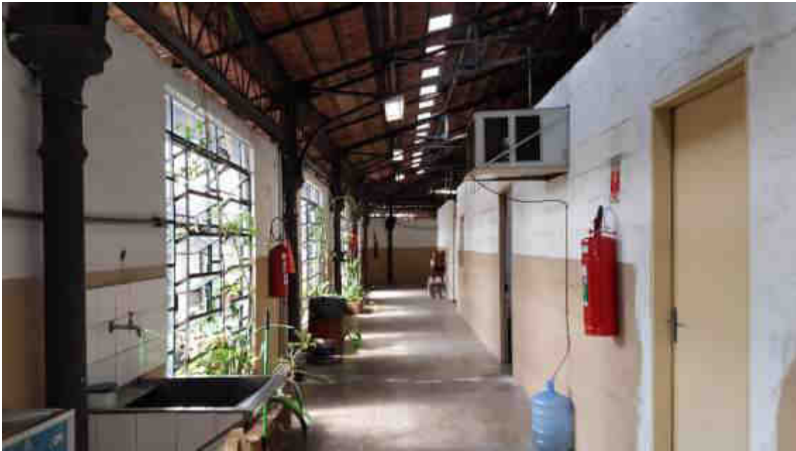
Figura 43 - Dreno improvisado do ar condicionado
