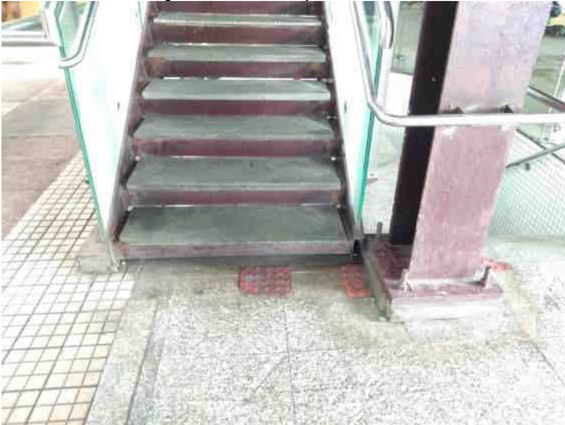
Figura 57 - Falta de sinalização tátil nas escadas
