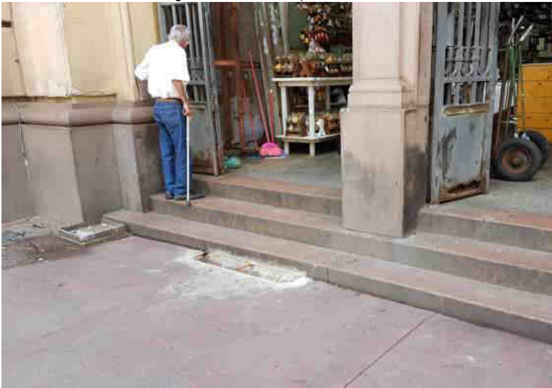
Figura 65 - Corrosão dos portões metálicos
