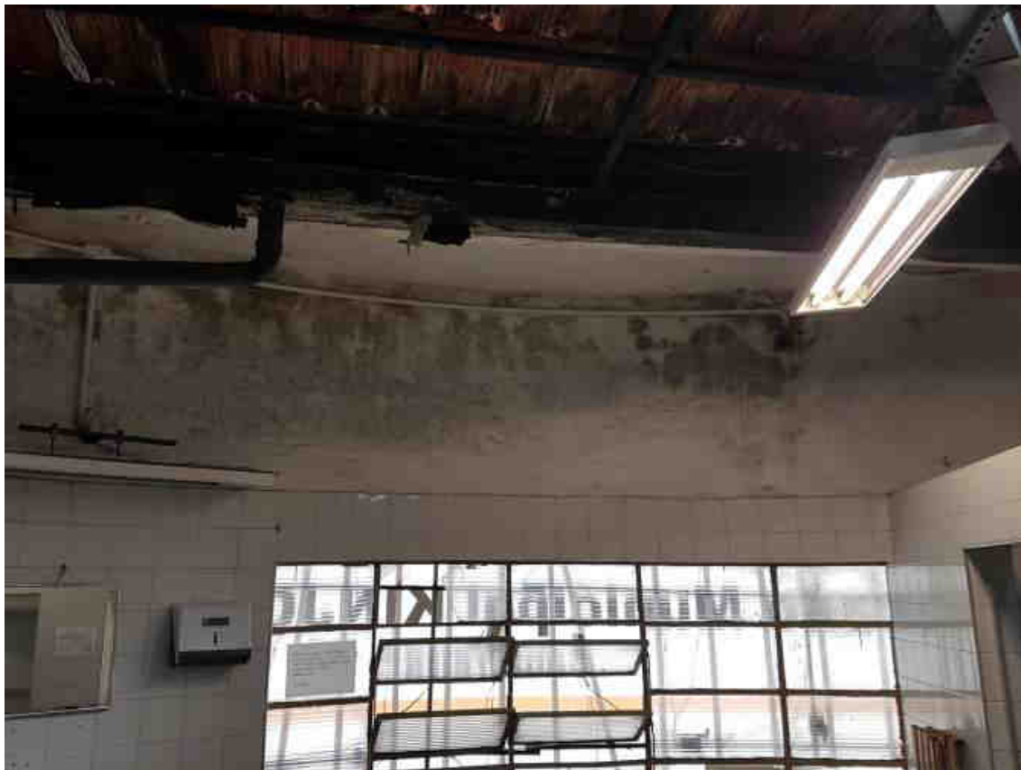
Figura 8 - Manchas de umidade na viga de concreto da estrutura da edificação do mezanino
