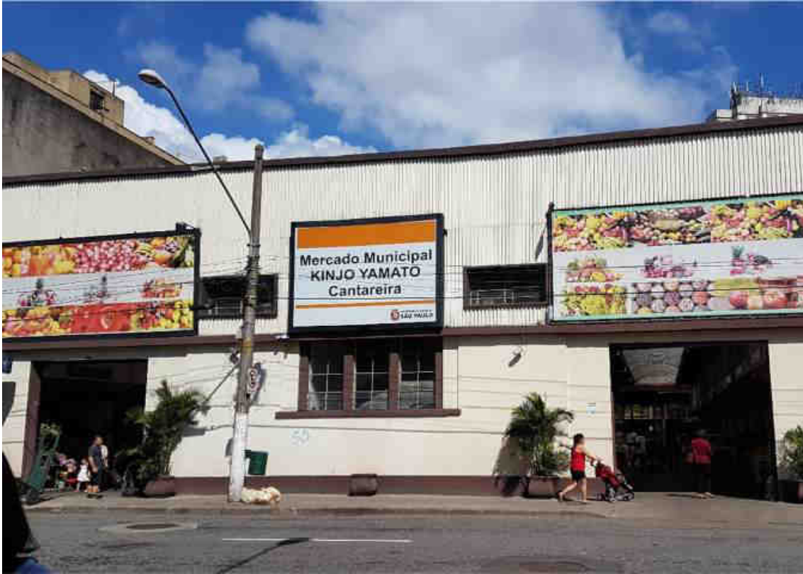
Figura 13 - Rever revestimento externo e tratamento da fachada
