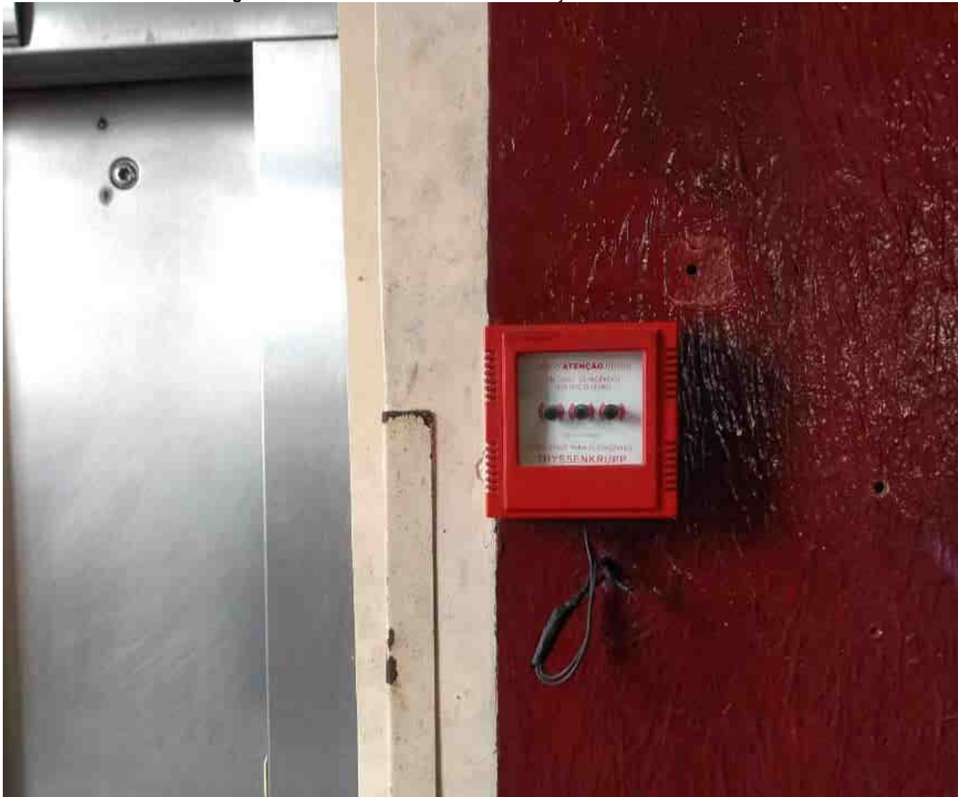
Figura 100 - Botoeira do alarme sem sinalização
