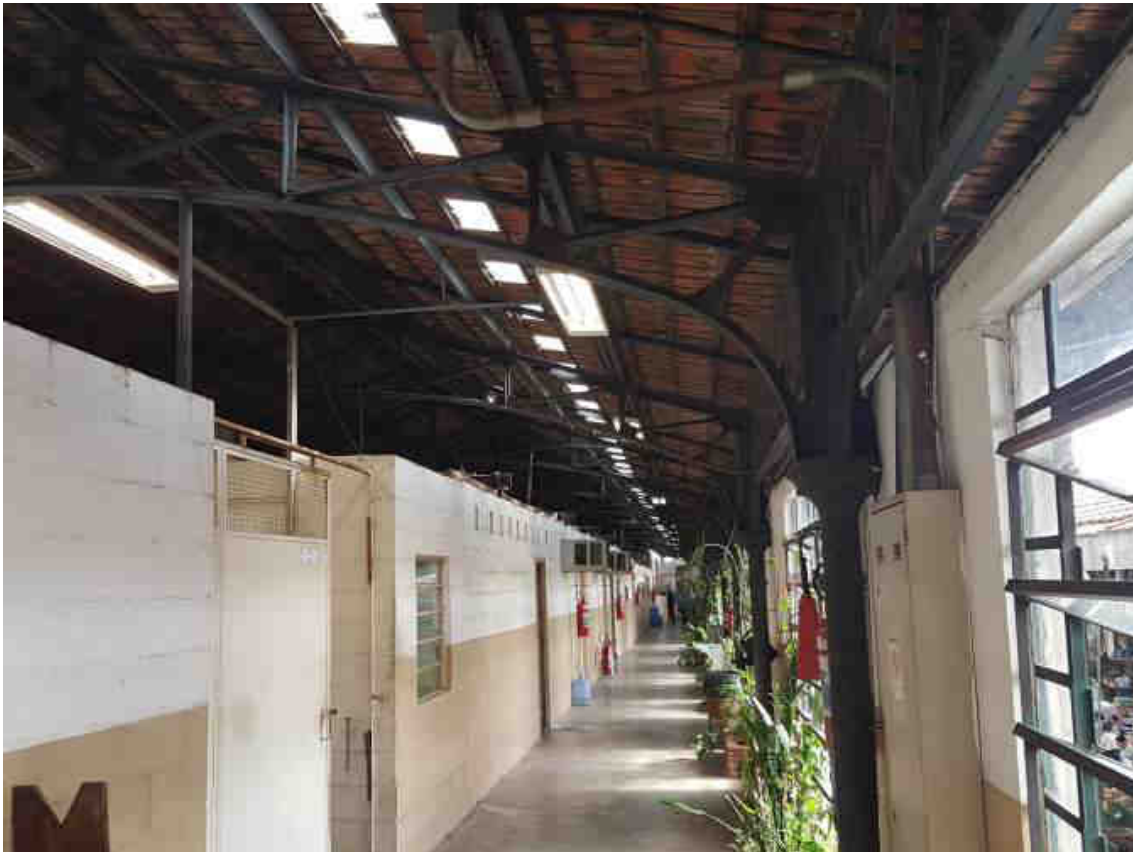
Figura 2 - Oxidação na estrutura metálica da cobertura
