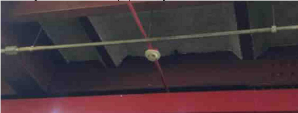
Figura 99 - Detectores de fumaça apenas na região do mezanino e subdimensionados
