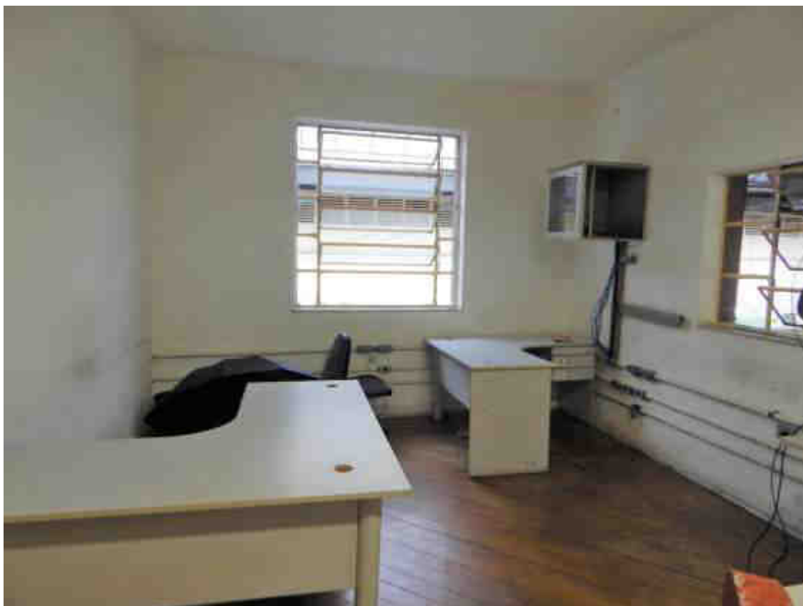
Figura 41 - Cabos expostos, instalação precária do servidor
