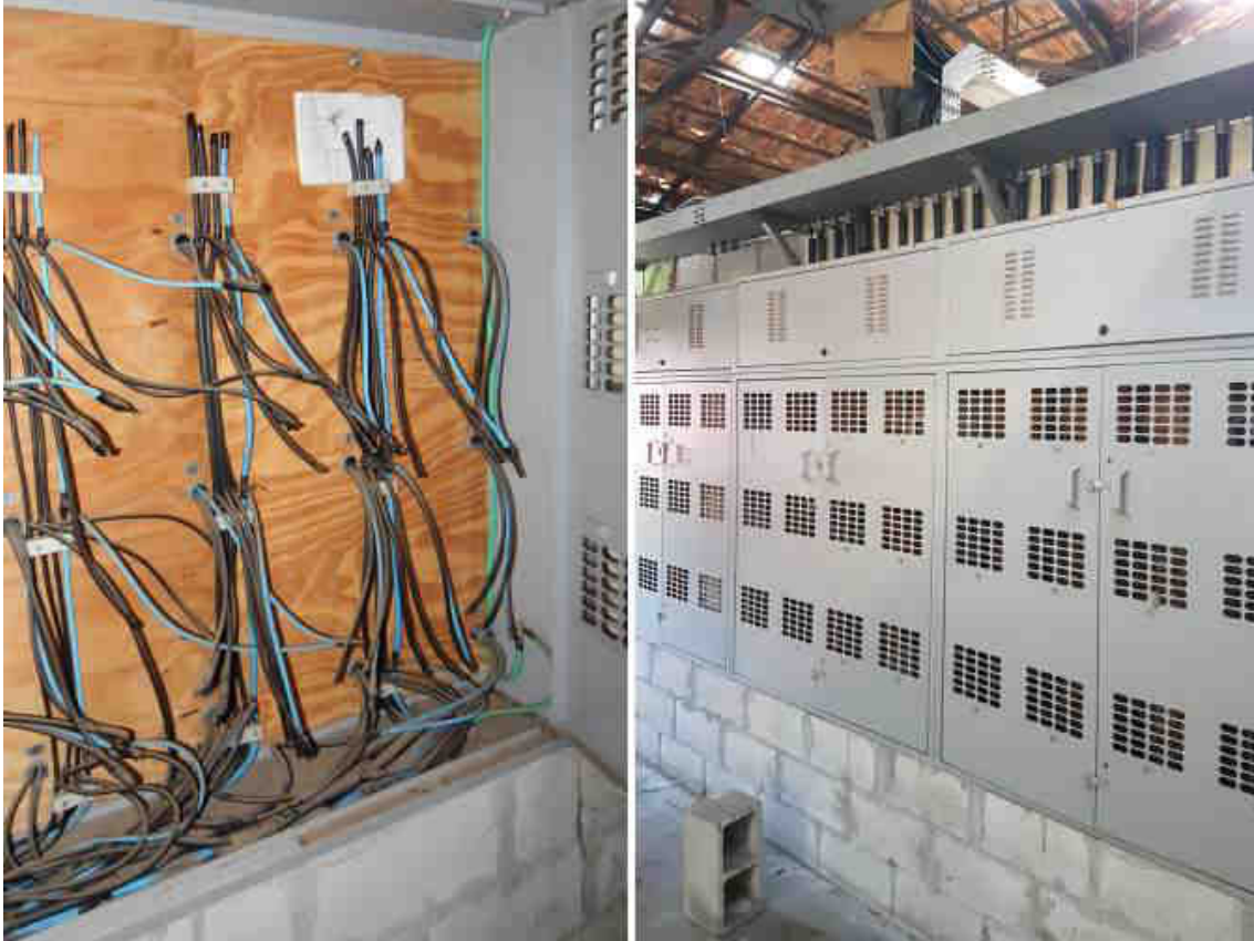
Figura 36 A e 36 B - Ausência de individualização do fornecimento de energia, centro de medição obsoleto
