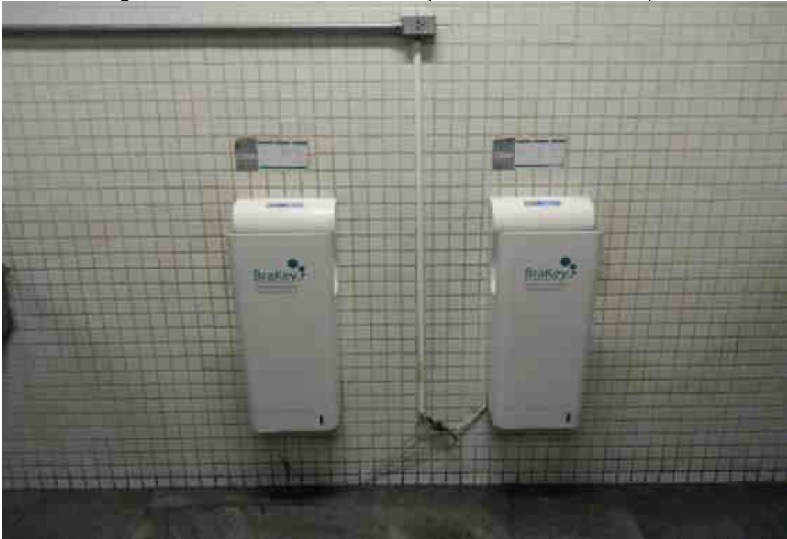
Figura 104 – Banheiros no subsolo com fiação dos secadores de mão exposta
