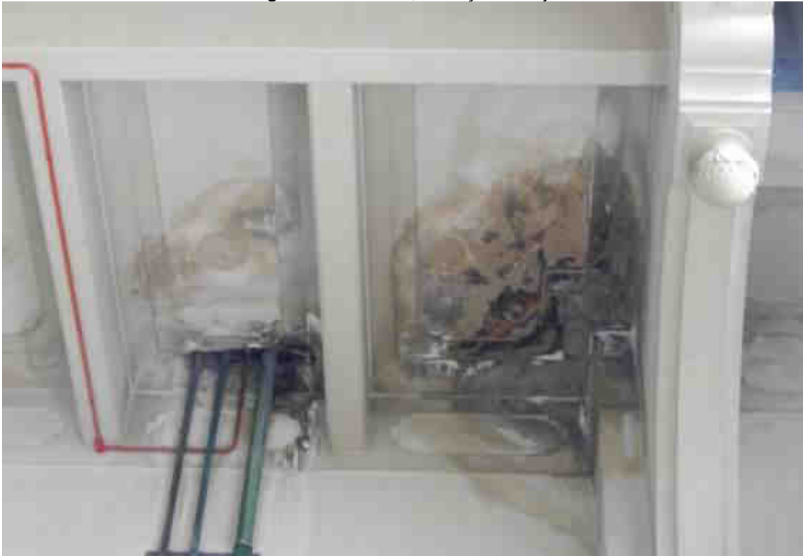
Figura 17 - Manchas, infiltrações na laje
