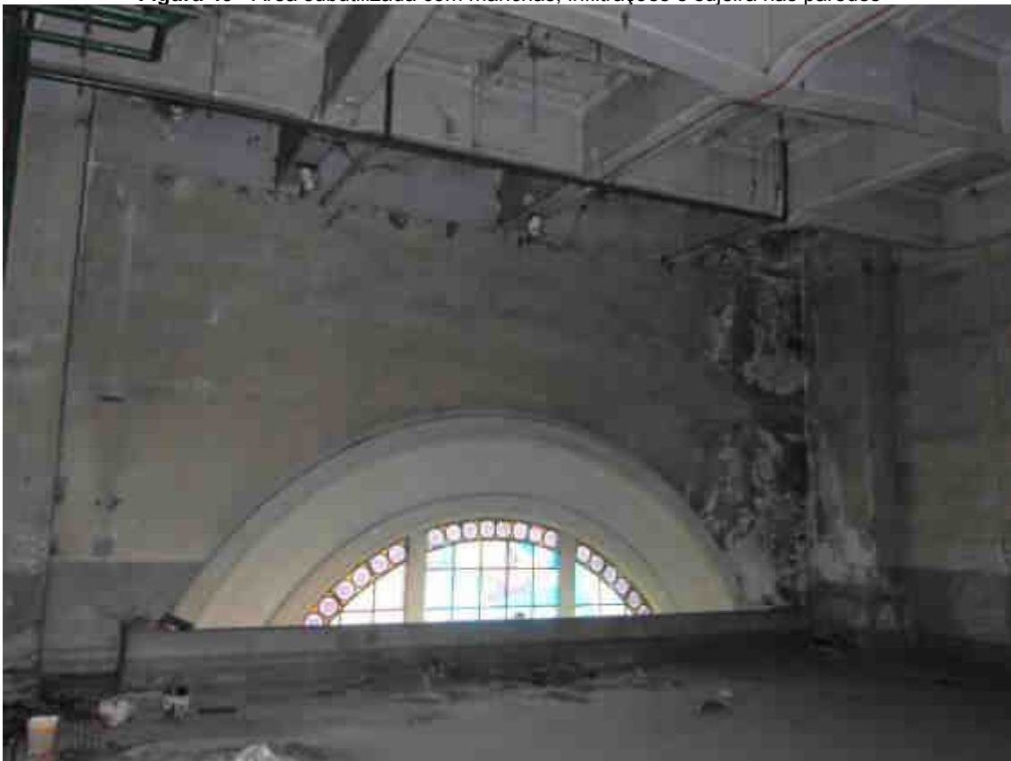
Figura 43 - Área subutilizada com manchas, infiltrações e sujeira nas paredes
