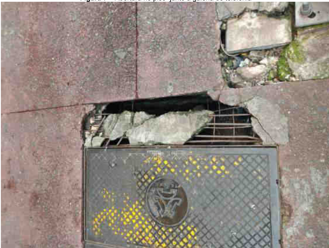
Figura 7 – Abertura no piso junto à galeria de telefonia
