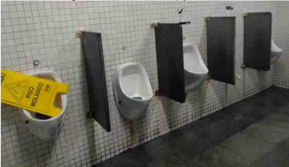
Figura 107 - Banheiros no subsolo com peças fora de uso
