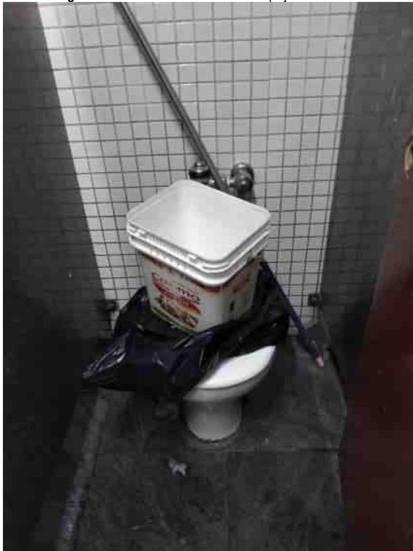
Figura 108 – Banheiros no subsolo com peças fora de uso
