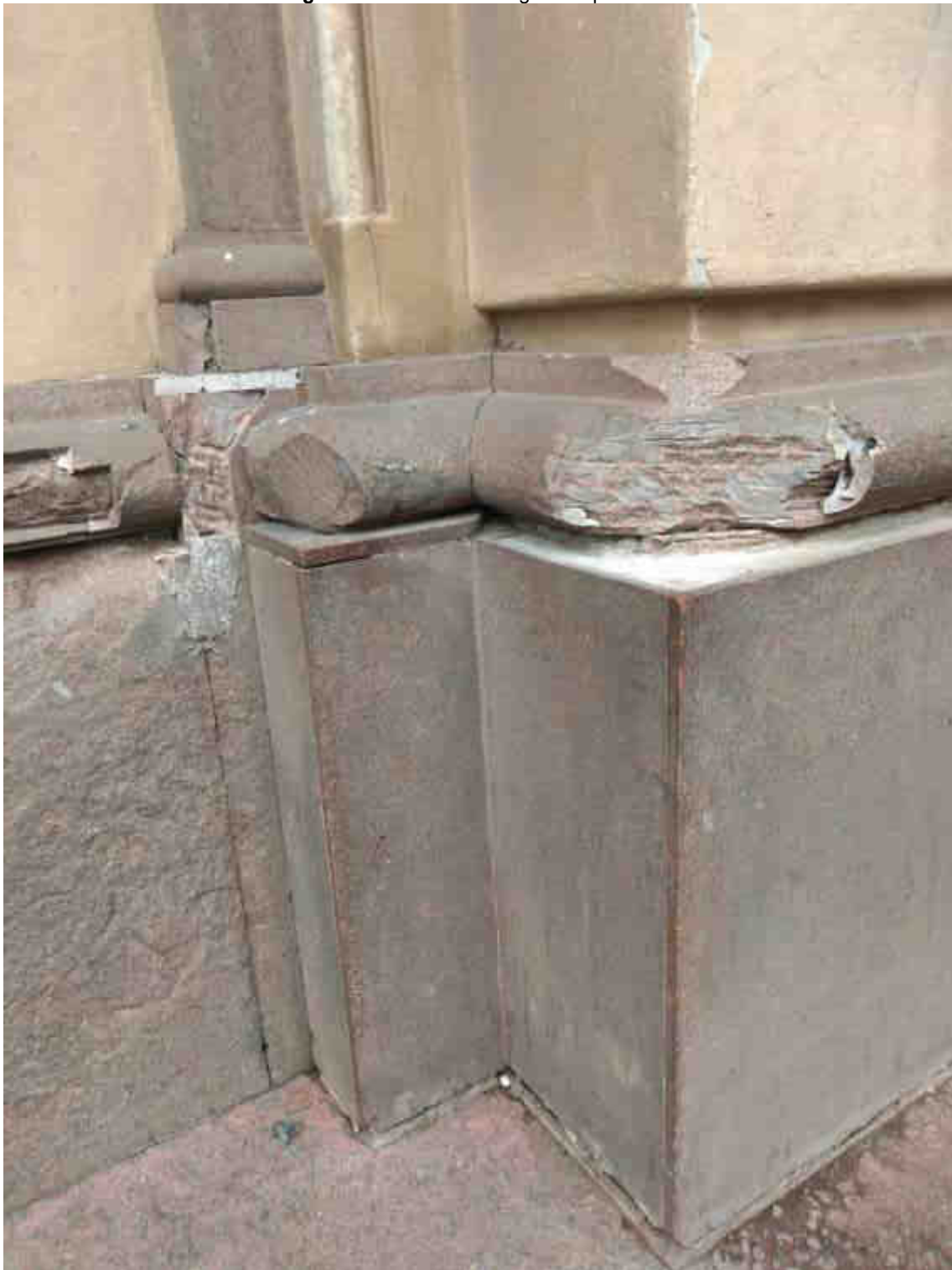
Figura 26 - Fachada com granito quebrado
