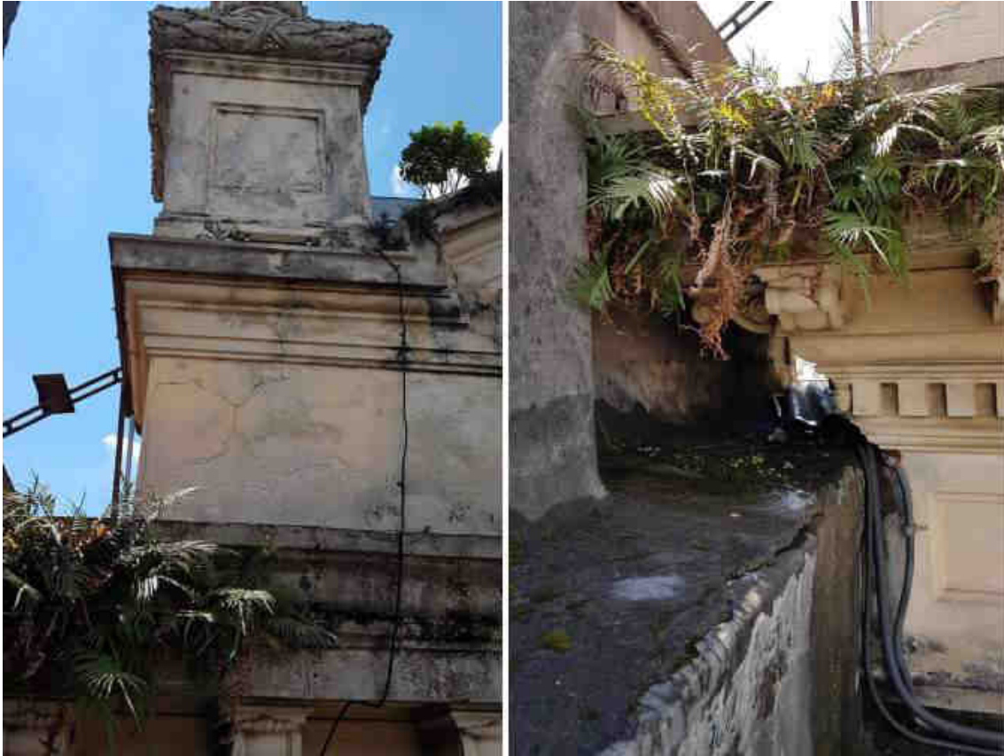
Figura 14 e Figura 15 - Manchas, infiltrações e crescimento de vegetação
