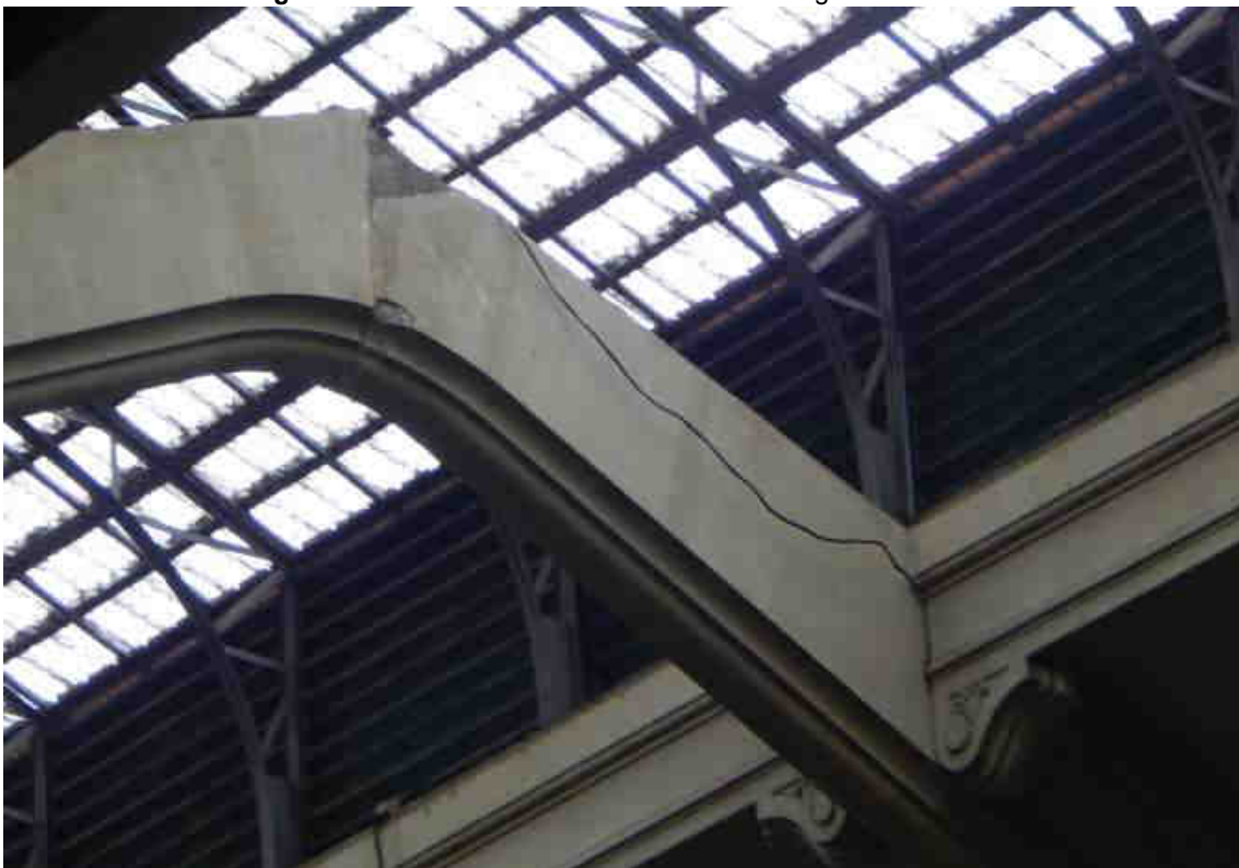
Figura 10 - Descolamento de revestimento de viga de cobertura
