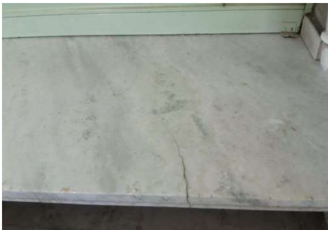
FOTO 13 BANCADA COM TRINCA
