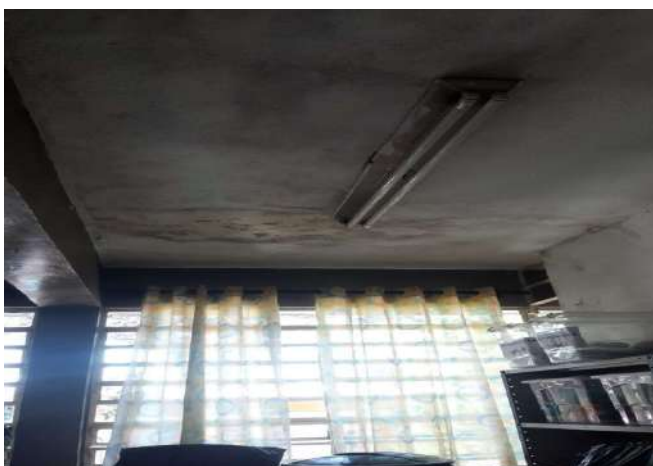
FOTO 15 SALA DE AULA 4 COM UMIDADE E INFILTRAÇÃO
