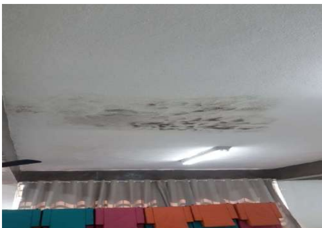
FOTO 37 SALA DE AULA 7 COM UMIDADE E INFILTRAÇÃO
