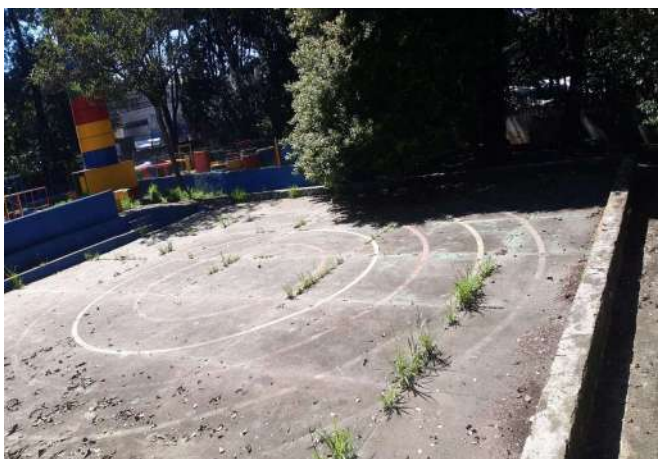
FOTO 11 TRINCAS NO PISO CIMENTADO EXTERNO
