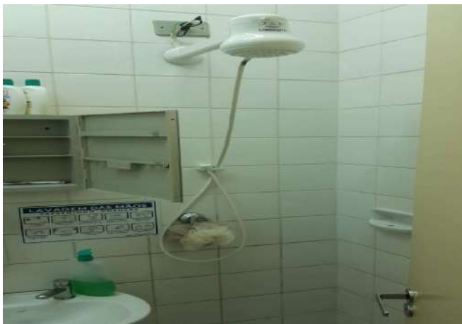
FOTO 31 FISSURAS E TRINCAS NO AZULEJO DO BANHEIRO
