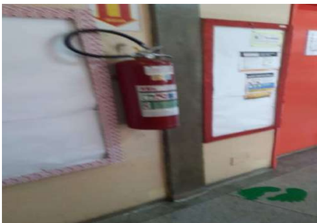
FOTO 17 PRÉDIO POSSUI SISTEMA DE EXTINTORES
