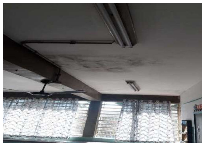
FOTO 34 SALA DE AULA 1 COM UMIDADE E INFILTRAÇÃO
