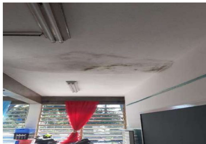
FOTO 18 TETO DA BRINQUEDOTECA COM UMIDADE E INFILTRAÇÃO
