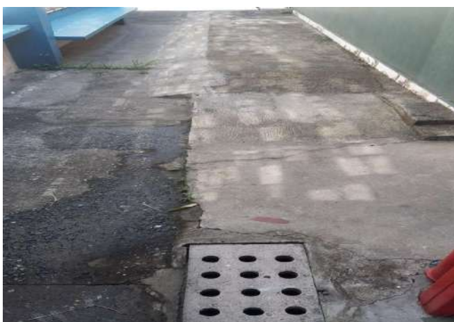
FOTO 35 TRINCA NO PISO EXTERNO PRÓXIMO AO ESTACIONAMENTO
