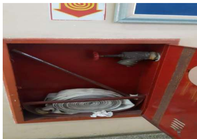
FOTO 36 PRÉDIO POSSUI SISTEMA DE HIDRANTES
