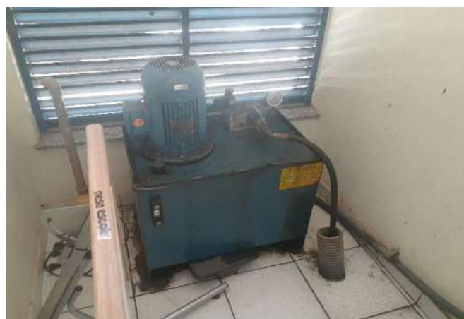
FOTO 6 Casa de Máquinas - Elevador
