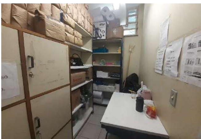
FOTO 3 Almoxarifado - Piso desgastado
