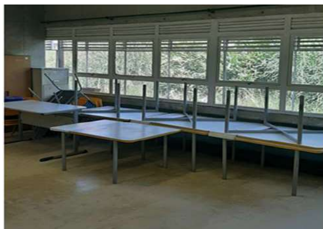
FOTO 11 IMAGEM INTERNA, MANCHAS NO PISO SALA 07
