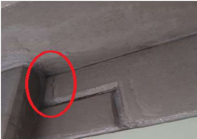
FOTO 37 TRINCA NA JUNÇÃO VIGA PILAR, SALA 01
