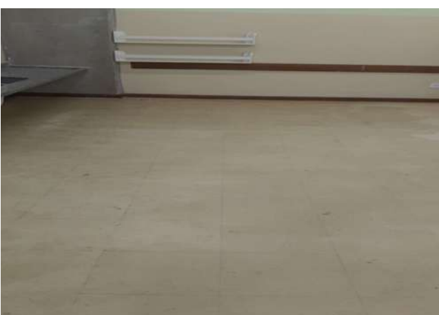
FOTO 30 PISO COM DIVERSAS MANCHAS, SALA 02
