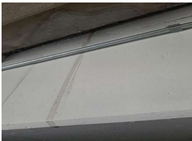
FOTO 47 INFITRAÇÃO VINDA DO PISO SUPERIOR, SECRETARIA
