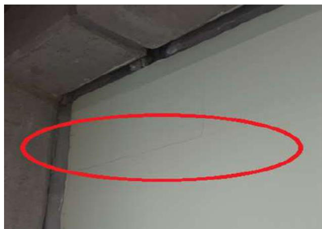
FOTO 28 FISSURA ALVENARIA DE VEDAÇÃO, SALA 04
