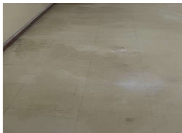
FOTO 10 PISO COM MANCHAS, SALA 07
