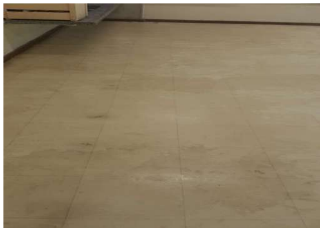
FOTO 14 PISO COM MANCHAS, SALA 06
