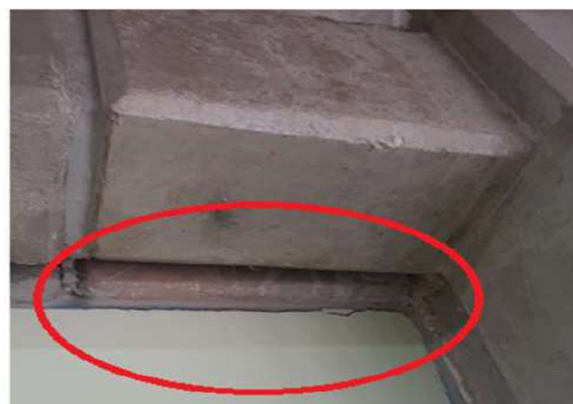
FOTO 34 TRINCA NA ALVENARIA DE VEDAÇÃO SALA 03
