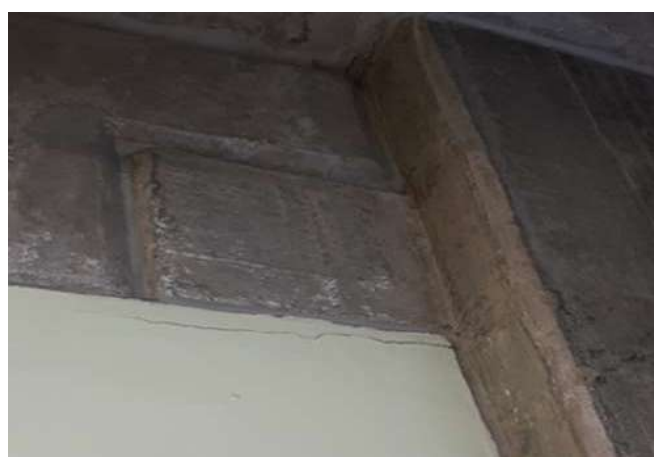
FOTO 12 TRINCA ALVENARIA DE FECHAMENTO, SALA 07
