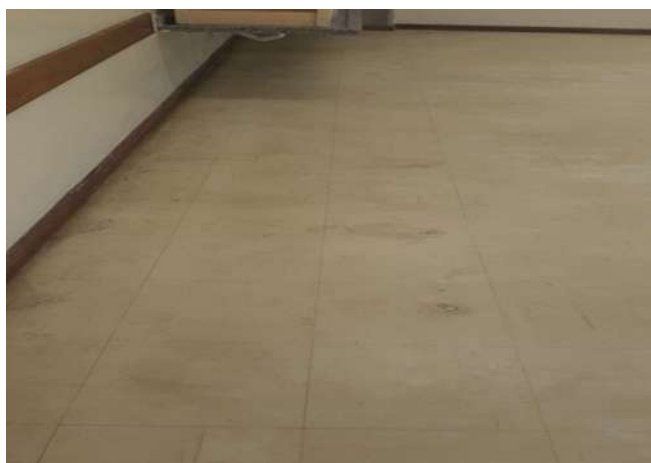
FOTO 27 PISO COM DIVERSAS MANCHAS, SALA 04
