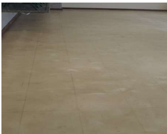
FOTO 33 PISO COM DIVERSAS MANCHAS, SALA 03
