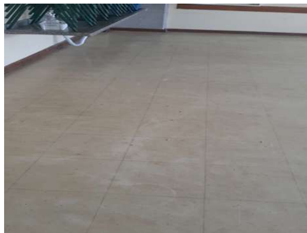
FOTO 36 PISO COM DIVERSAS MANCHAS, SALA 01
