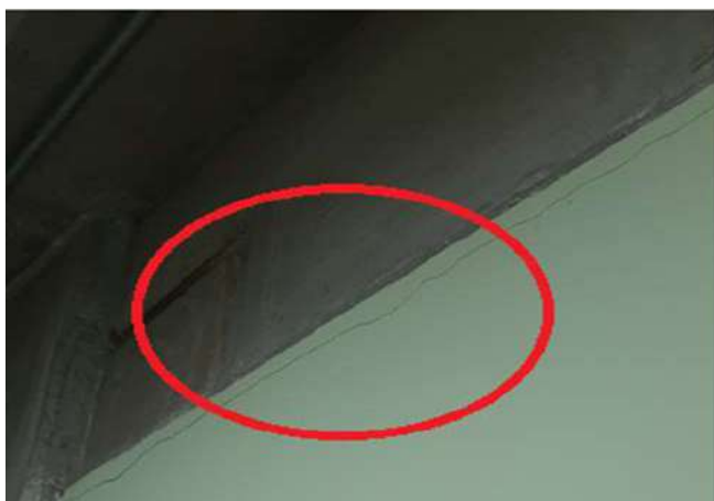
FOTO 15 FISSURAS NA ALVENARIA DE FECHAMENTO SALA 06
