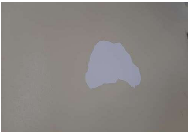
FOTO 25 PINTURA PAREDE DESCASCADA, SALA 05
