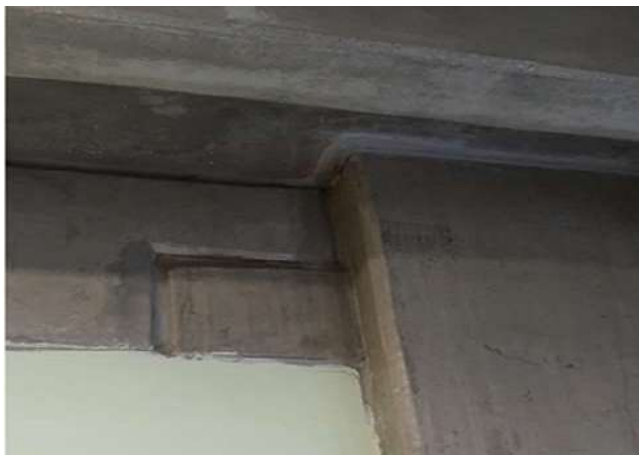
FOTO 31 FISSURAS NA ALVENARIA DE VEDAÇÃO, SALA 02
