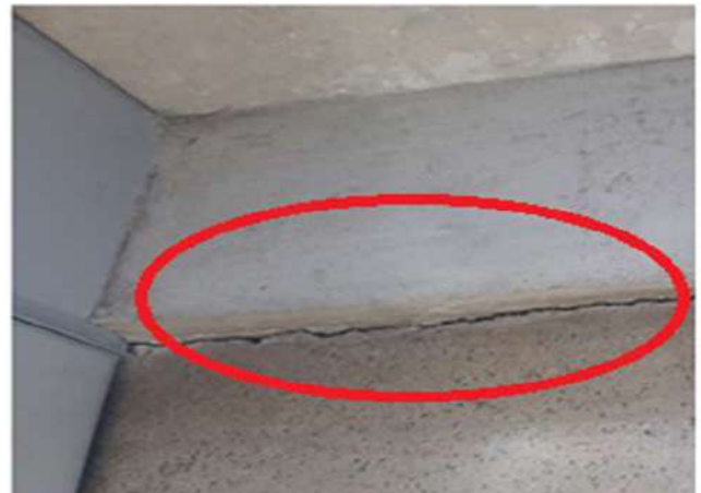
FOTO 40 TRINCA NA JUNÇÃO VIGA PILAR, SALA DOS PROFESSORES
