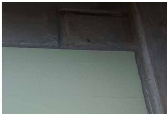
FOTO 16 FISSURAS NA ALVENARIA DE FECHAMENTO SALA 06
