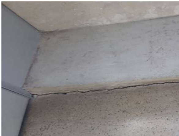
FOTO 39 TRINCA NA JUNÇÃO VIGA PILAR, SALA DOS PROFESSORES
