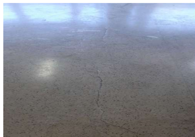
FOTO 3 GRANILITE COM FISSURA CORREDOR DE ENTRADA
