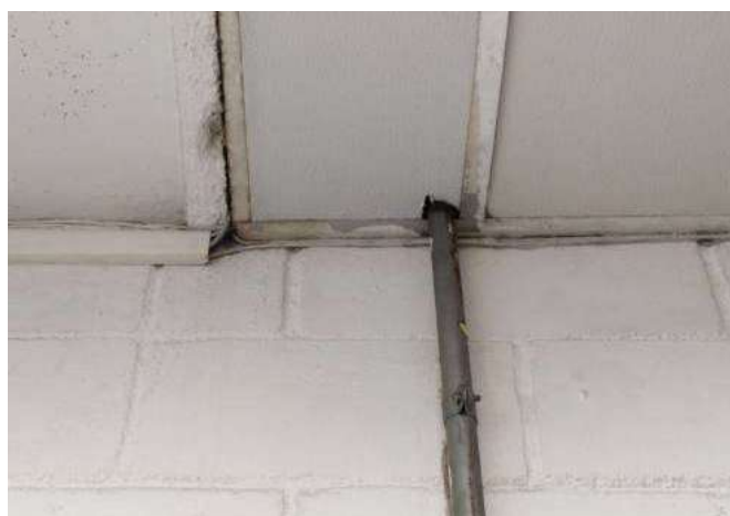
FOTO 76 Almojarifado, necessário revisão das instalações elétricas.
