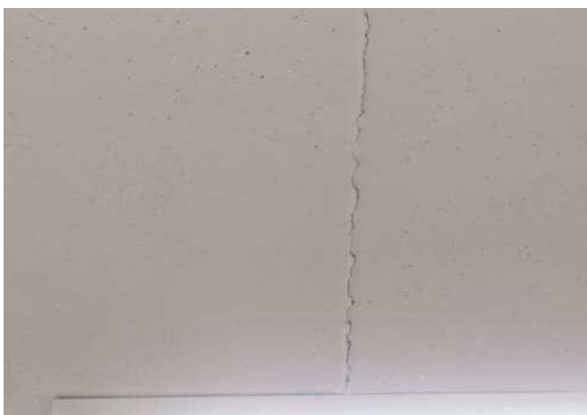
FOTO 9 Necessário refazer juntas de dilatação da cozinha.
