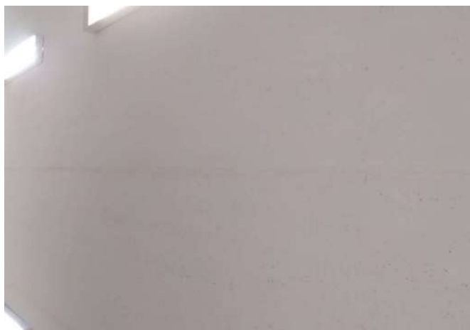
FOTO 22 Sala de aula 03, necessário revisão das juntas de dilatação.
