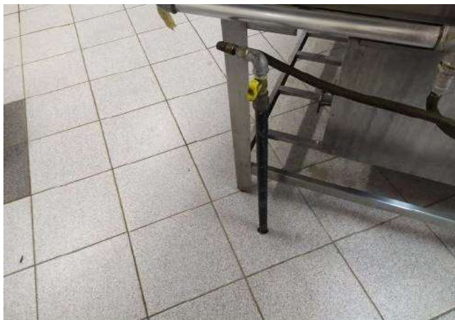
FOTO 7 Cozinha, necessário pintura da tubulação do gás.
