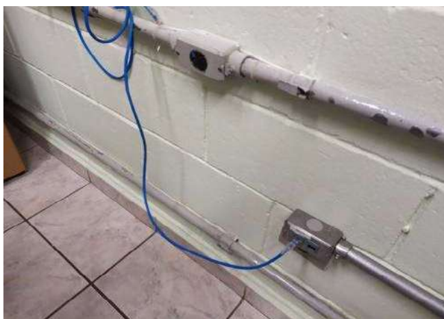
FOTO 65 Sala da coordenação pedagógica, necessário revisão das instalações elétricas.
