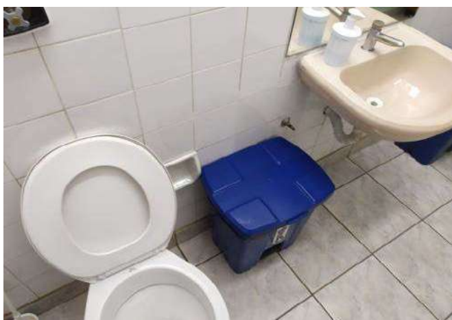
FOTO 71 Banheiro masculino dos funcionários. falta acabamento da válvula de descarga.
