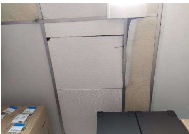
FOTO 75 Almojarifado, possui forros deteriorados.
