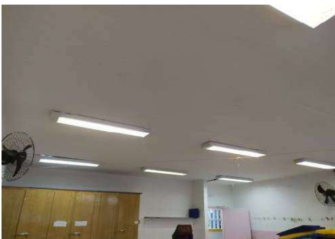
FOTO 27 Sala de aula 05, necessário revisão das juntas de dilatação.
