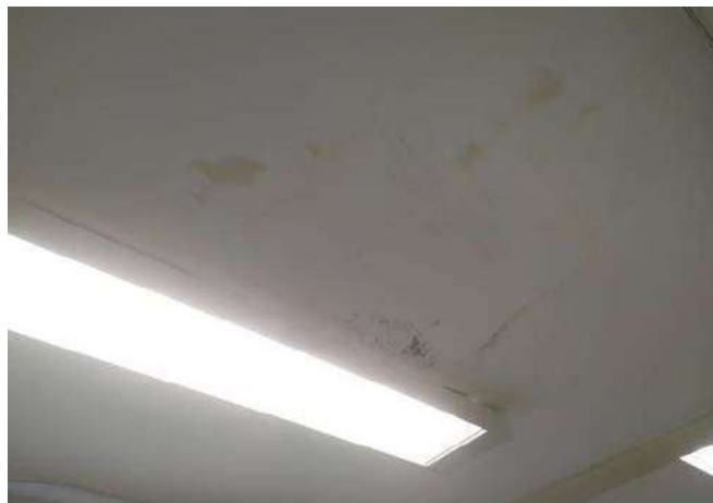
FOTO 2 Infiltração dentro da secretaria pelo teto
