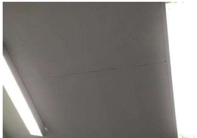
FOTO 8 Necessário refazer juntas de dilatação da cozinha.
