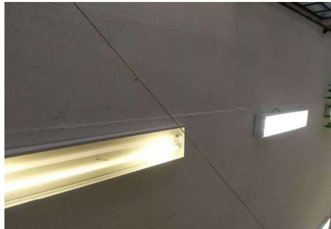
FOTO 26 Sala de aula 05, necessário revisão das juntas de dilatação.
