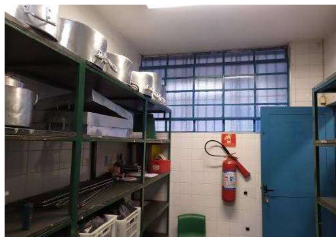
FOTO 10 Despensa da cozinha.
