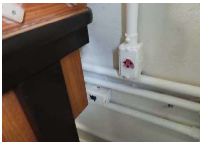
FOTO 4 Secretaria, necessário revisão das instalações elétricas.
