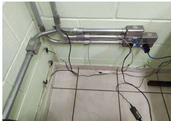
FOTO 68 Sala da direção, necessário revisão das instalações elétricas.
