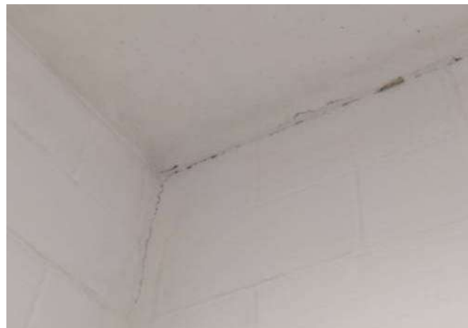
FOTO 20 Sala de aula 02, necessário revisão de fissuras no teto e paredes.
