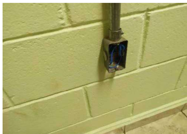
FOTO 72 Refeitório dos funcionários, necessário revisão das instalações elétricas.
