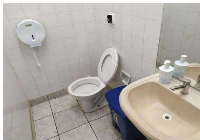
FOTO 70 Banheiro masculino dos funcionários. falta acabamento da válvula de descarga.
