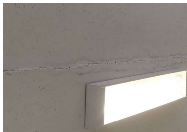
FOTO 23 Sala de aula 04, necessário revisão das juntas de dilatação.
