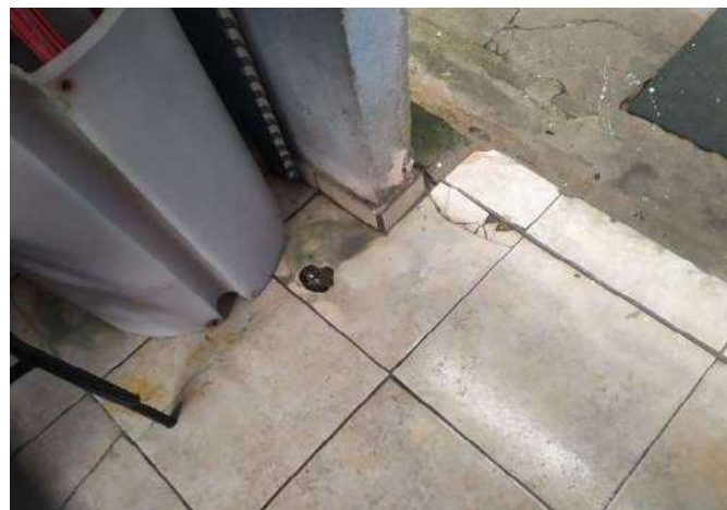
FOTO 50 Lavanderia, necessário revisão dos pisos danificados.
