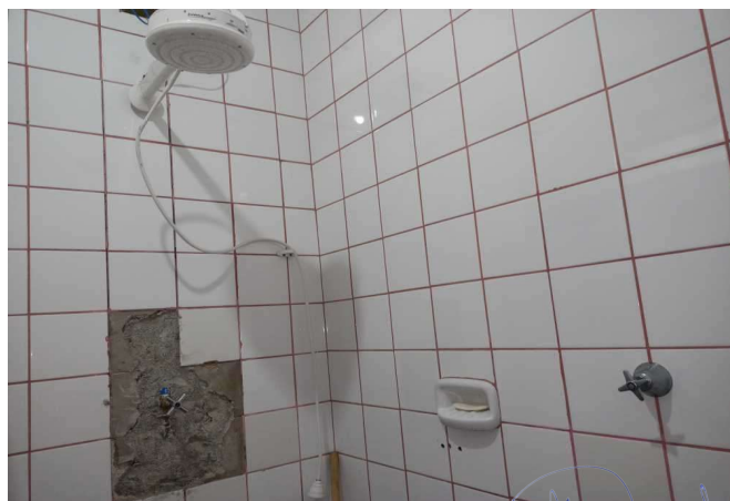
FOTO 60 Sanitário Masculino para Funcionários - destacamento de revestimento
