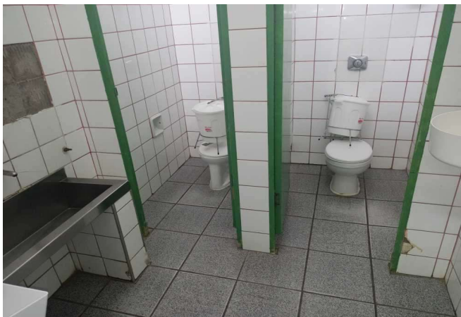
FOTO 49 Sanitário Feminino para Alunos - Azulejo quebrado
