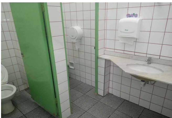
FOTO 57 Sanitário Feminino para Funcionários - Pisos Diferentes do original (box)
