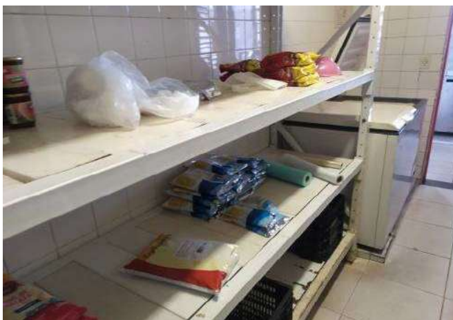
FOTO 47 Despensa prateleiras metálicas apresentam pontos de oxidação - tratamento e pintura
