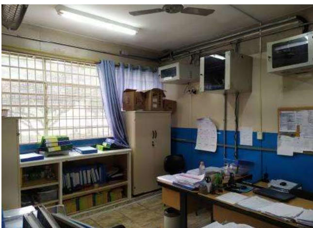
FOTO 3 Secretária- pintura das paredes - caixilho ha passagem de água em chuvas de vento.
