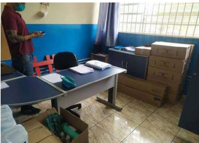
FOTO 5 Sala da direção Necessita apenas de pintura das paredes e caixilhos
