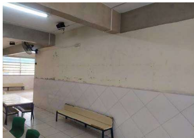
FOTO 46 Pátio coberto, necessita de reparo e pintura das paredes
