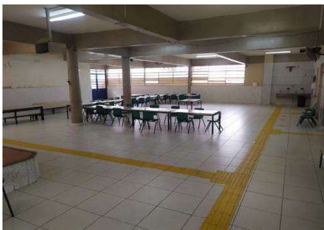
FOTO 45 Pátio coberto, necessita de reparo e pintura das paredes
