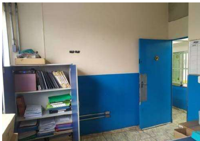
FOTO 6 Sala da direção Necessita apenas de pintura das paredes e caixilhos
