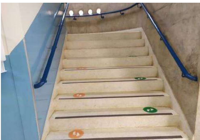
FOTO 65 escada para pav superior, necessita corrimão acessível
