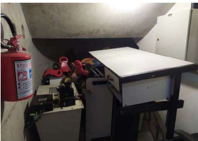
FOTO 59 casa de máquina elevador
