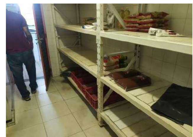
FOTO 48 Despensa prateleiras metálicas apresentam pontos de oxidação - tratamento e pintura
