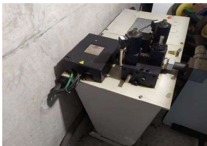
FOTO 60 casa de máquina elevador
