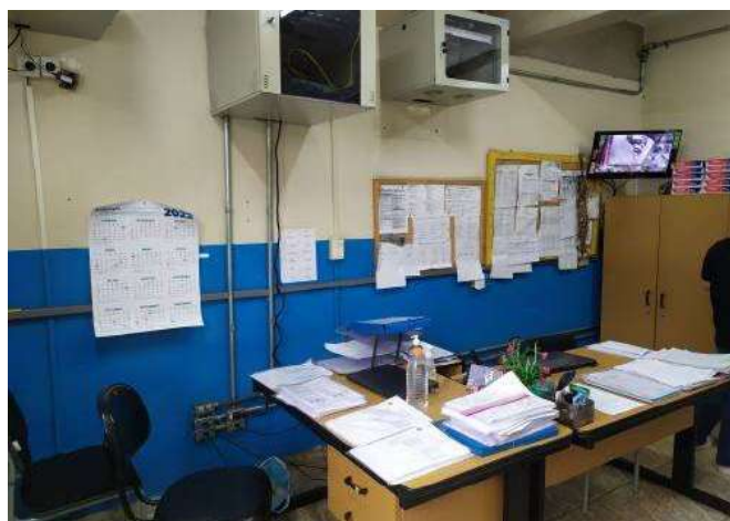
FOTO 4 Secretária- pintura das paredes - caixilho ha passagem de água em chuvas de vento.
