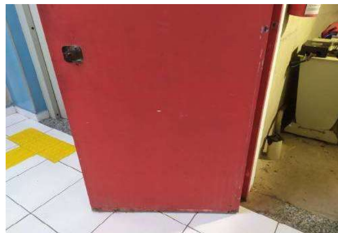
FOTO 64 porta corta fogo casa de máquina -pintura e reparos. Troca de fechadura se faz necessário
