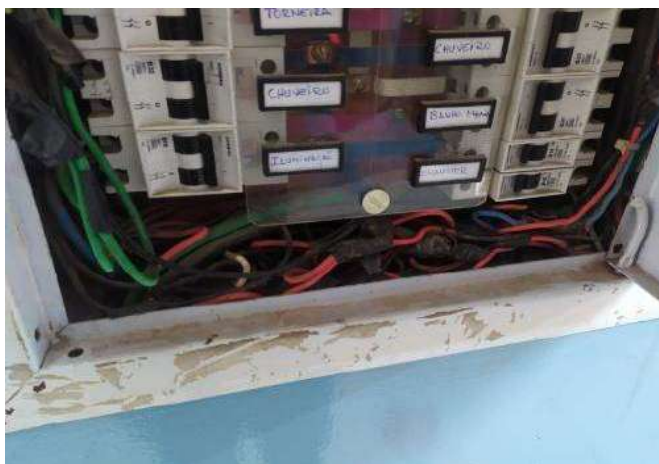
FOTO 41 Necessário revisão na fiação e quadros da unidade escolar
