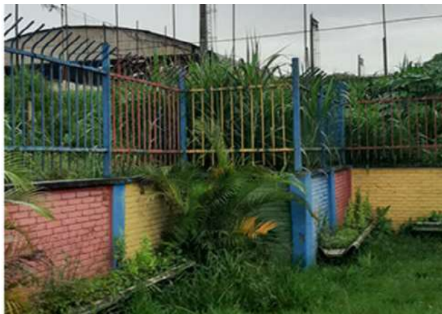
FOTO 55 FALTA MANUTENÇÃO NO PARQUE
