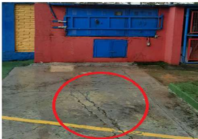
FOTO 60 RACHADURAS NO PISO, ESTACIONAMENTO
