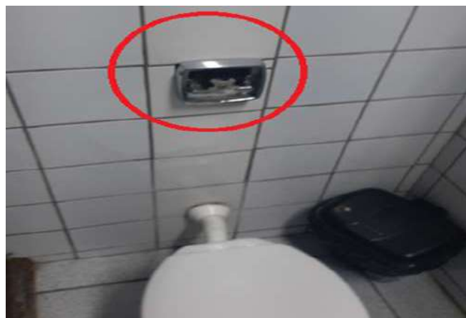
FOTO 16 VÁLVULA DE DESCARGA SEM ACABAMENTO, WC ALUNOS 1º PAV.
