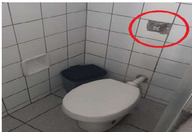
FOTO 15 VÁLVULA DE DESCARGA SEM ACABAMENTO, WC ALUNOS 1º PAV.
