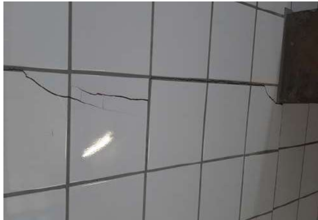
FOTO 18 TRINCAS NO REVESTIMENTO BANHEIRO 1º PAVIMENTO
