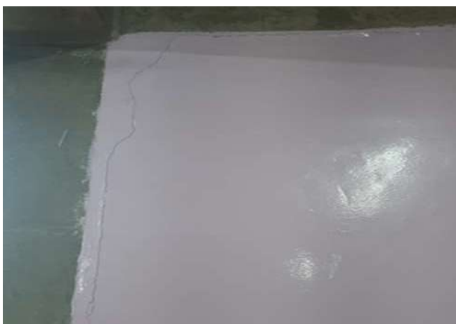
FOTO 11 FISSURAS NA PAREDE, SALA 6B / 6D
