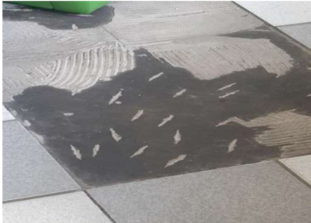
FOTO 7 PISO FALTANDO E QUEBRADO, SALA MULTIMÍDIA
