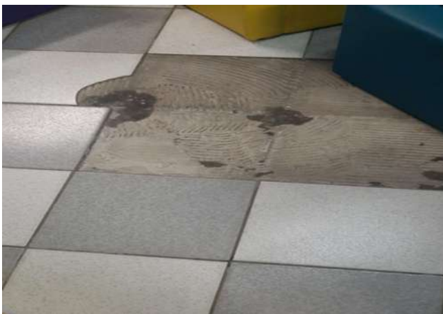
FOTO 5 PISO FALTANDO E QUEBRADO, SALA MULTIMÍDIA
