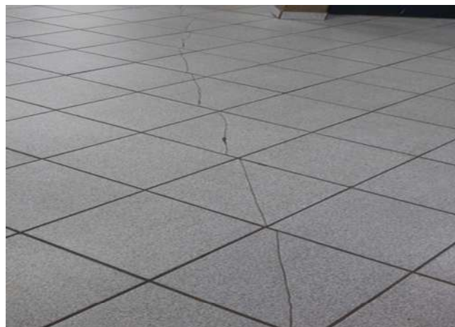
FOTO 26 TRINCA EM TODA EXTENSÃO NO CENTRO DO PÁTIO
