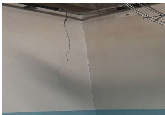
FOTO 6 TRINCA NA PAREDE SALA MULTIMÍDIA
