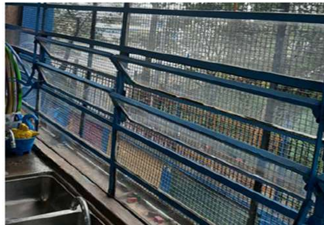
FOTO 4 CAIXILHO NECESSÁRIO REGULAGEM, SALA 01
