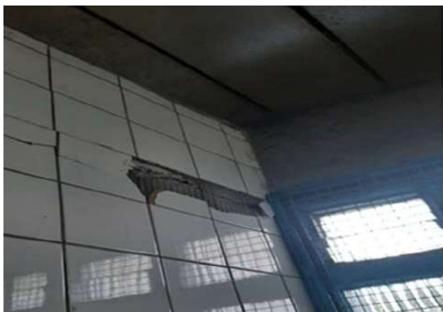
FOTO 17 RACHADURA BANHEIRO ALUNOS 1º PAVIMENTO
