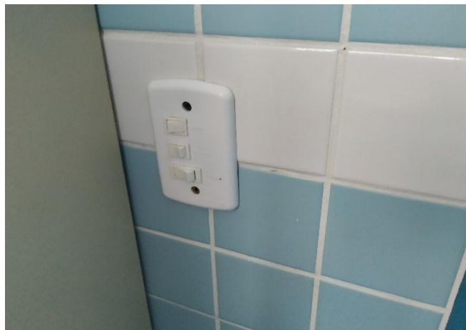
FOTO 42 Interruptor e comando do ventilador, sala dos professores.
