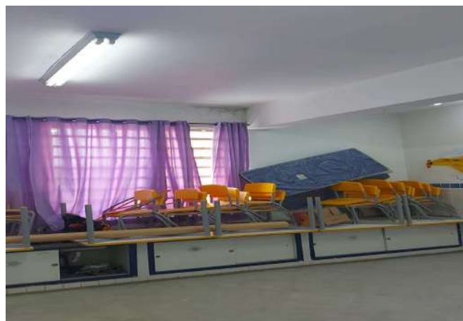
FOTO 27 SALA 5 COM INFILTRAÇÕES
