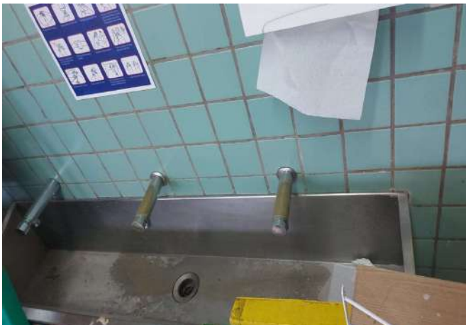
FOTO 25 TORNEIRA BEBEDOURO PÁTIO ESTÃO OXIDADAS
