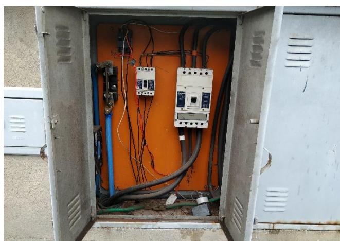
FOTO 6 Dispositivo de proteção. Condutor fase, neutro e terra.
