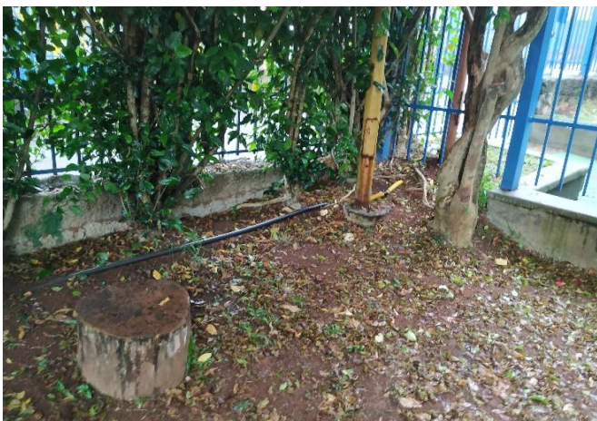
FOTO 55 Tubulação dos cabos elétricos inadequados.
