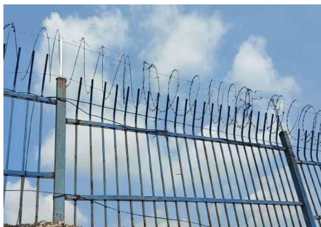
FOTO 18 GRADIL DO MURO DA ESCOLA COM CORROSÃO E NECESSITA TRATAMENTO E PINTURA
