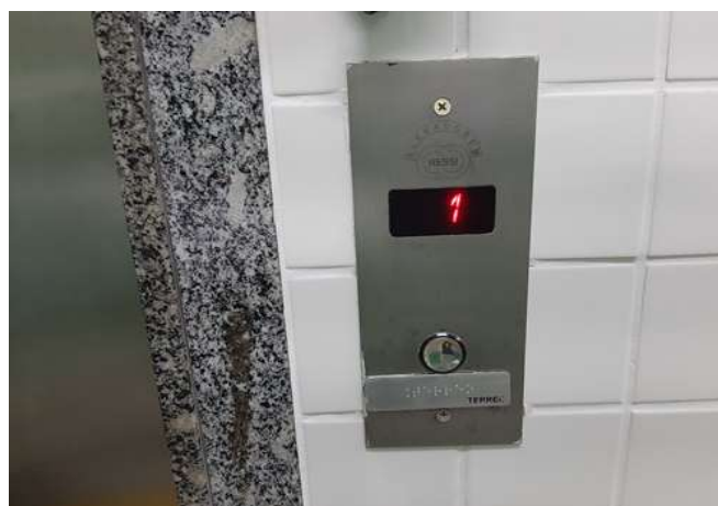
FOTO 30 Botão de acionamento elevador
