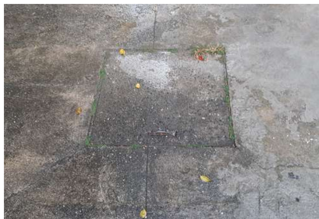
FOTO 56 Caixa de passagem
