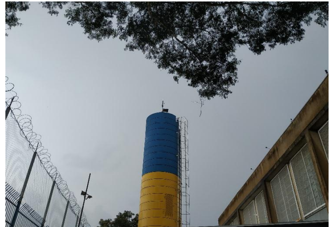
FOTO 2 Captor, do sistema de SPDA. Falta luz de sinalização.
