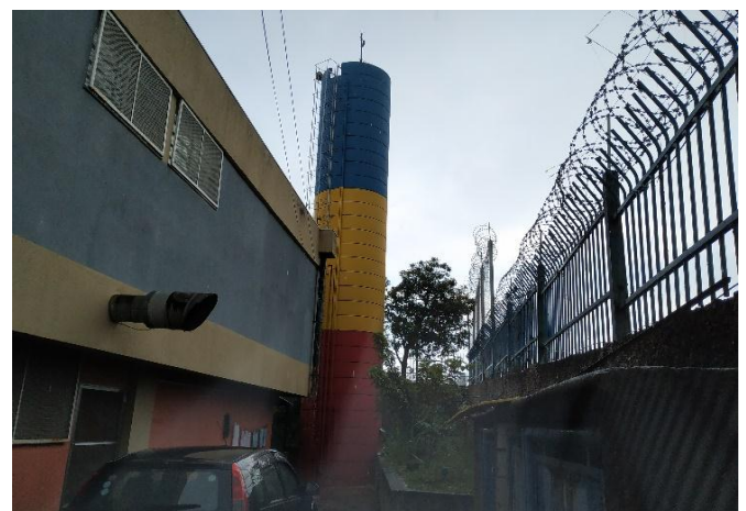
FOTO 6 Reservatório de água contendo a reserva de incêndio.
