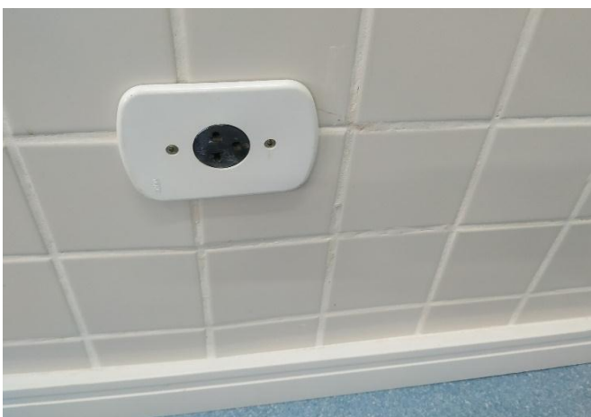
FOTO 57 Tomada padrão americano antiga, substituir por padrão brasileiro, sala de aula 5.
