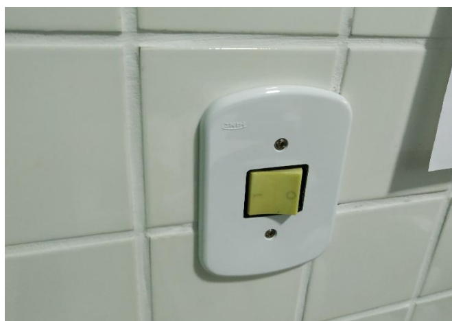
FOTO 46 Interruptor sala da direção.
