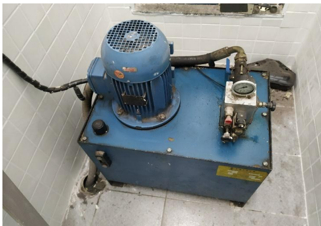
FOTO 89 Máquina de tração do elevador.
