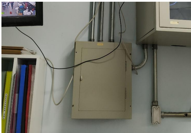
FOTO 19 Quadros de distribuição, localizado na secretaria.
