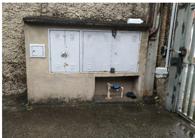
FOTO 4 Quadro de distribuição.
