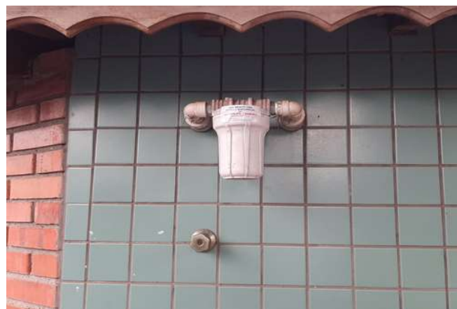
FOTO 64 Filtro com registro de gaveta
