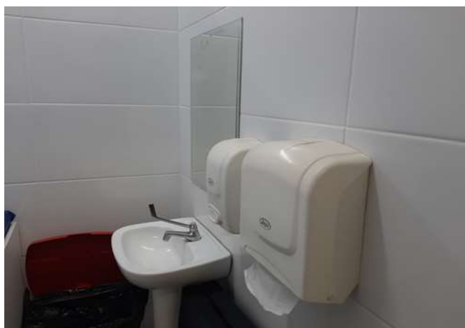
FOTO 27 Torneira com alavanca banheiro PNE
