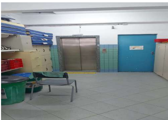
FOTO 33 ELEVADOR APRESENTA PROBLEMAS CONSTANTES NA OPERAÇÃO
