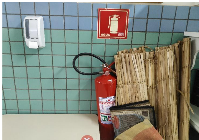
FOTO 18 Extintor de água. Piso superior. Materiais obstruindo o espaço do extintor.
