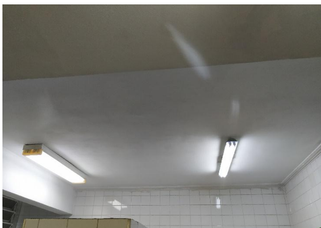
FOTO 39 Luminárias sobrepor com lâmpadas tubular de LED, com proteção, cozinha.
