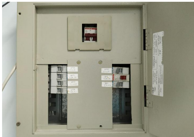
FOTO 20 Interior do quadro de distribuição, secretaria.
