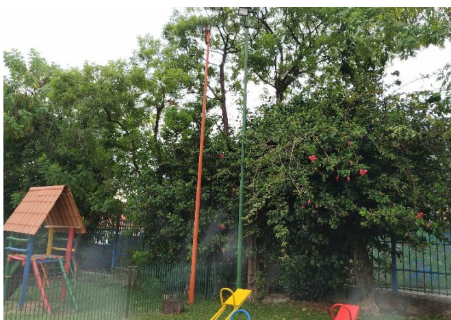
FOTO 53 Iluminação externa, com refletor de LED, playground.
