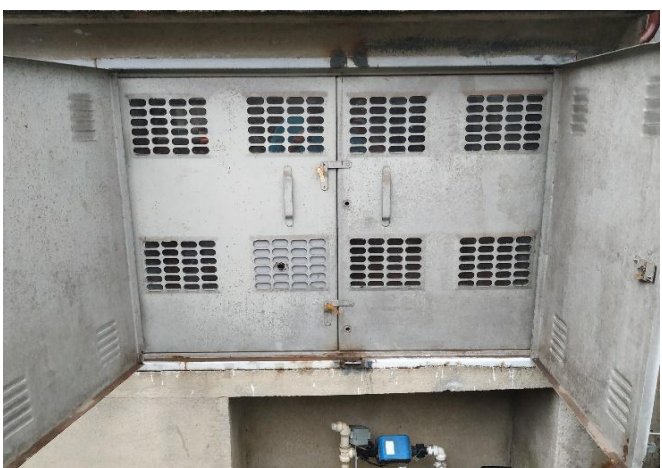
FOTO 5 Caixa de medição de energia.
