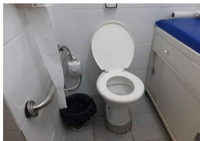
FOTO 28 Bacia sanitária banheiro PNE
