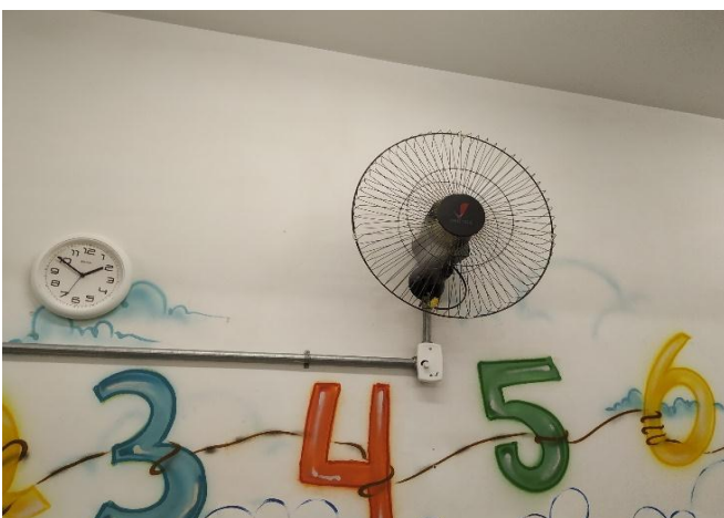
FOTO 93 Ventilador de parede, sala de aula 3.
