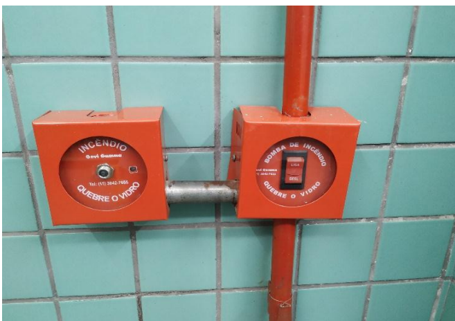
FOTO 17 Acionador manual e alarme.
