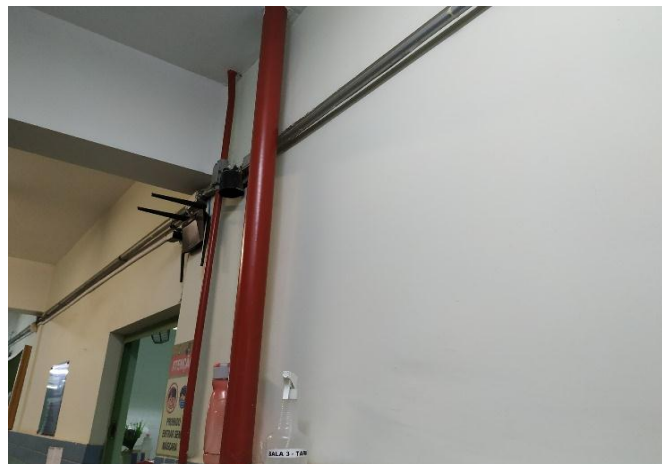
FOTO 14 Sirene e tubulação.
