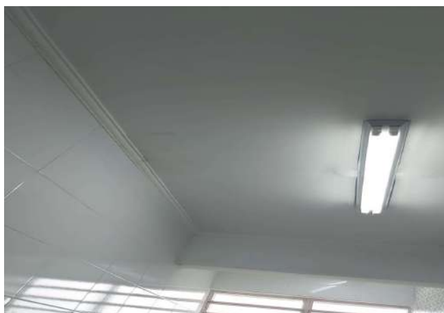
FOTO 45 INFILTRAÇÃO NO WC MASCULINO INFANTIL
