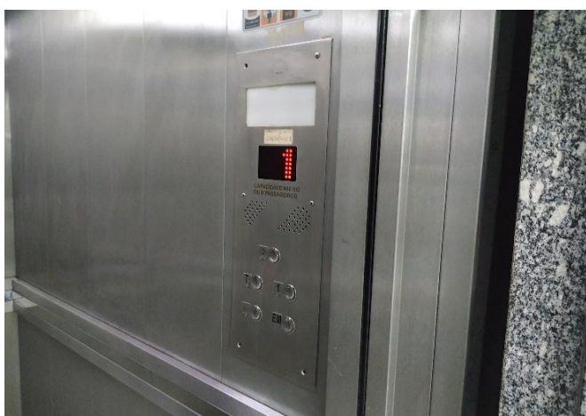
FOTO 87 Pannel de comando do elevador.
