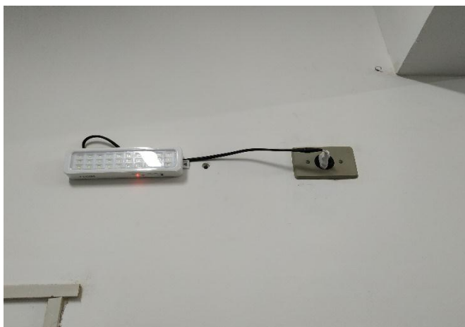
FOTO 23 Iluminação de emergência.
