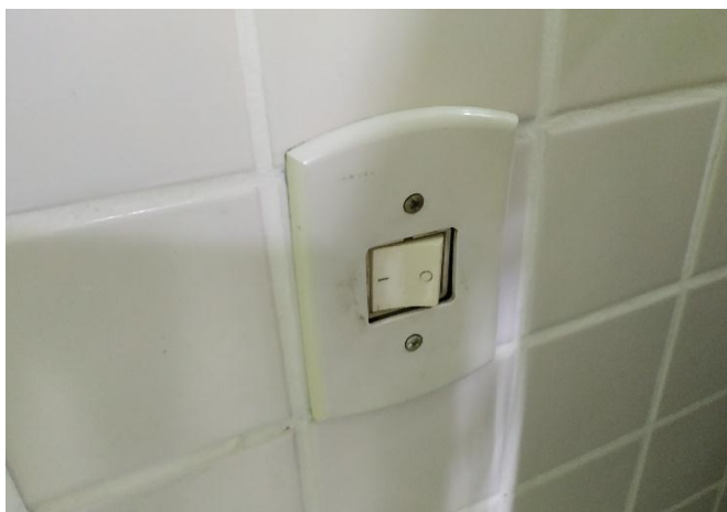
FOTO 41 Interruptor refeitório dos professores.
