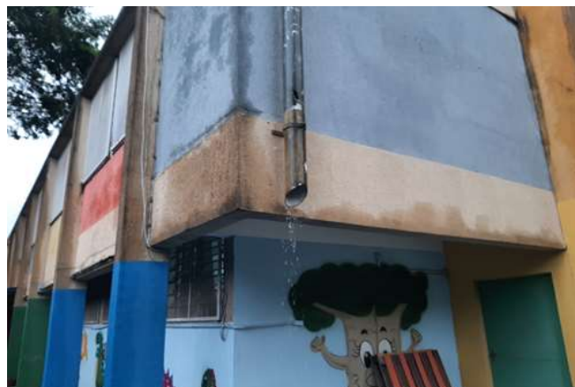
FOTO 52 Tubulação de escoamento da água pluvial
