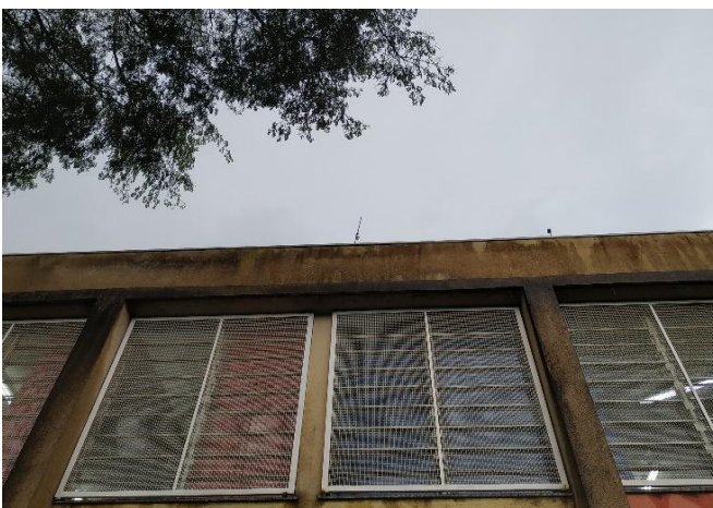
FOTO 3 Captor, do sistema de SPDA. Prédio da unidade.
