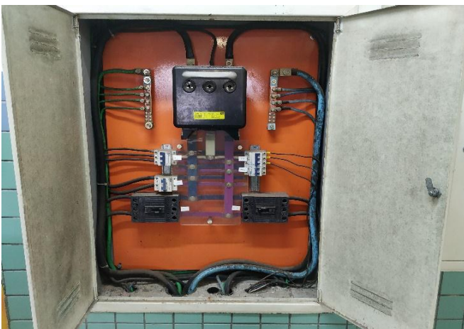
FOTO 9 Quadro geral de distribuição, piso térreo, refeitório.
