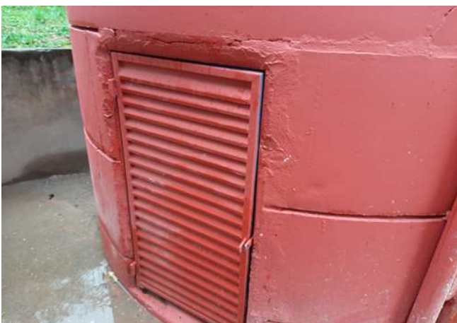
FOTO 41 Porta casa de bomba
