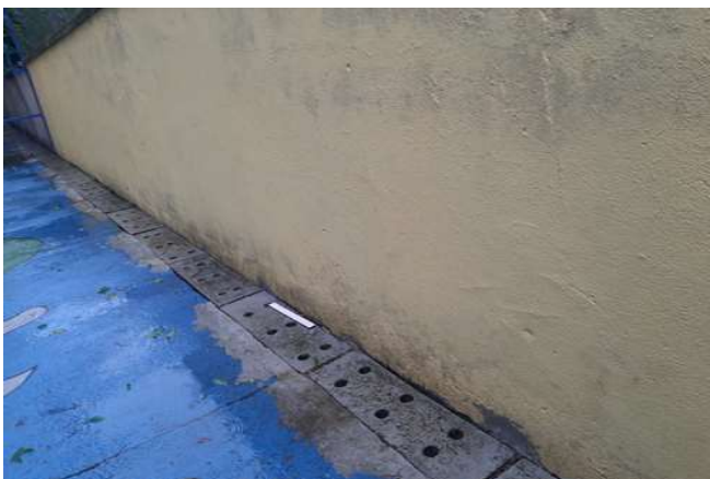
FOTO 51 Grelha de concreto
