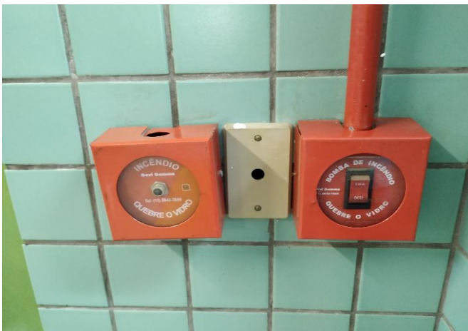
FOTO 13 Acionador manual e alarme do sistema.
