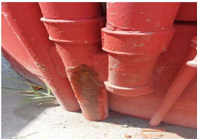
FOTO 13 VAZAMENTO NA PRUMADA DE FERRO
