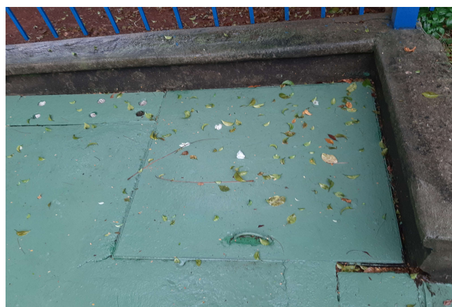
FOTO 66 Caixa de pagssagem
