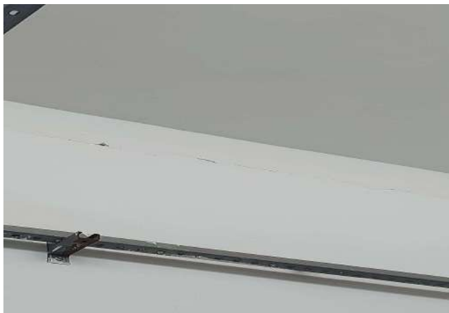
FOTO 31 TRINCAS NAS SALAS DE AULA
