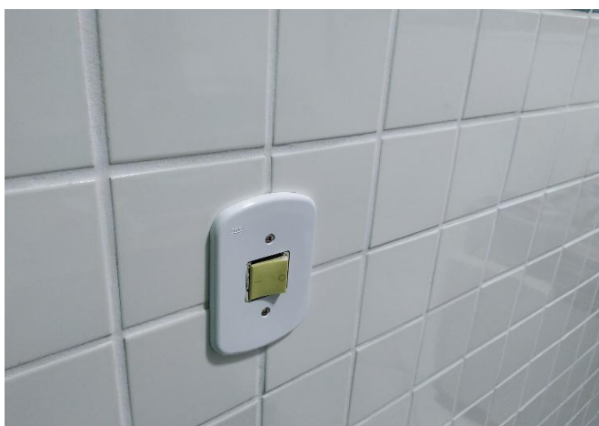
FOTO 45 Interruptor sala da coordenação.
