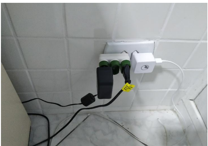
FOTO 69 Tomada com benjamin (T), acessório inadequado. Necessário instalação de tomadas. Direção.
