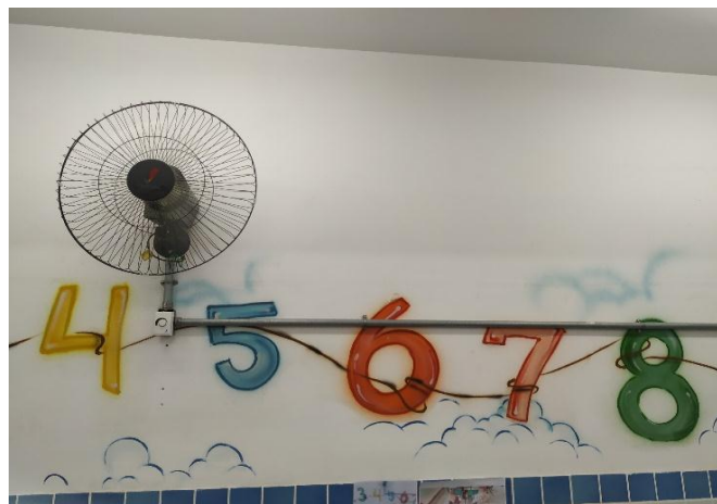
FOTO 90 Ventilador de parede, sala de aula 5.
