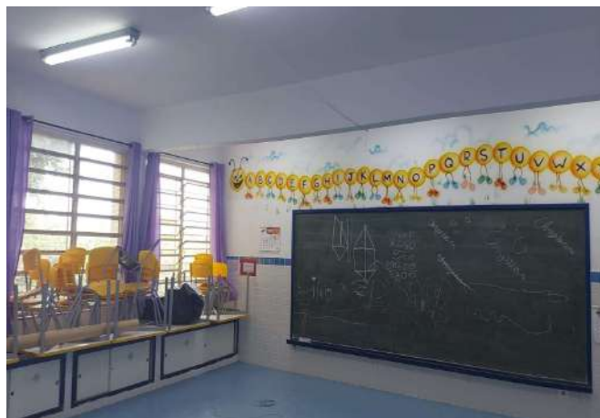
FOTO 44 TRINCA NA SALA 1
