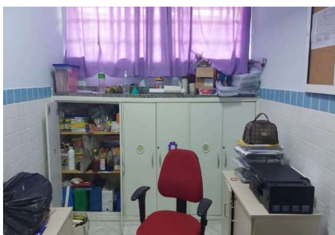
FOTO 4 SALA DA COORDENAÇÃO - INFILTRAÇÃO E MOFO NO ARMÁRIO DA COORDENAÇÃO
