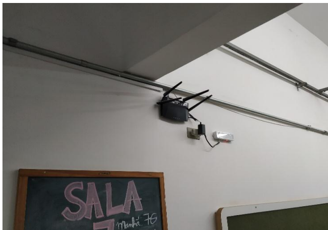
FOTO 85 Roteador Wi-fi, instalado no corredor, piso superior.
