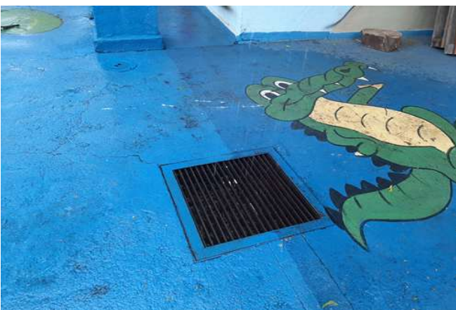
FOTO 53 Caixa de passagem água pluvial
