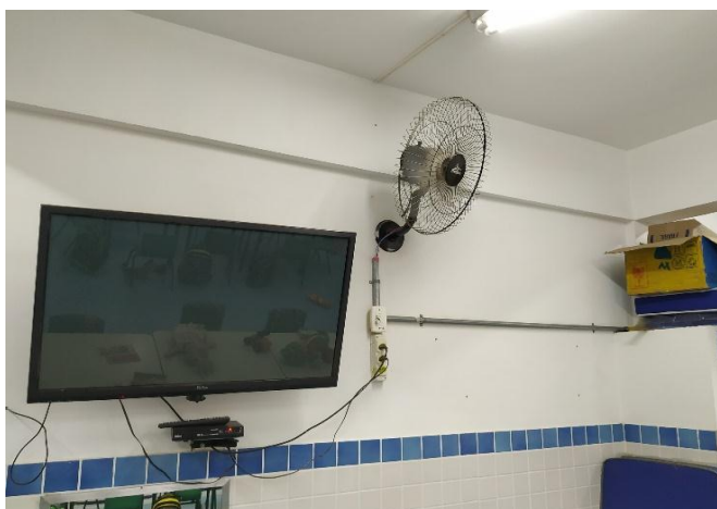
FOTO 99 Televisão instalada na sala de aula 5.
