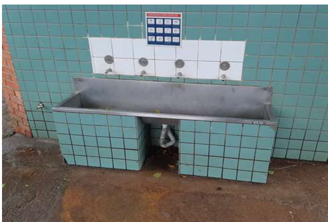
FOTO 63 Bebedouro com torneiras antivandalismo
