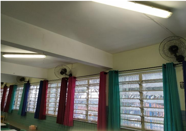
FOTO 91 Ventiladores de parede, refeitório.
