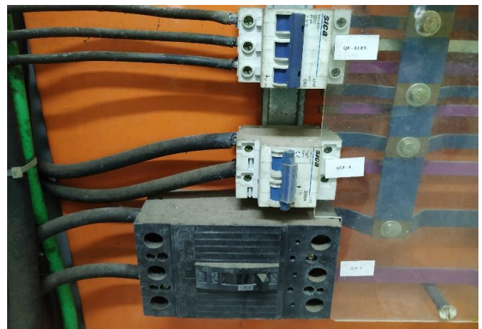
FOTO 10 Falta conectores nos cabos de distribuição.
