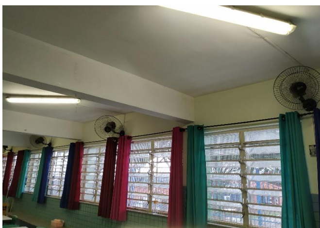
FOTO 33 Iluminação refeitório. Adaptação com canaleta, na instalação do ventilador.
