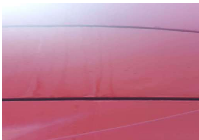
FOTO 15 VAZAMENTO NA PRUMADA DE FERRO
