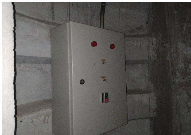
FOTO 24 Quadro elétrico das bombas de recalque.
