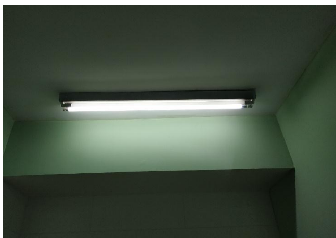
FOTO 35 Iluminação refeitório dos professores.
