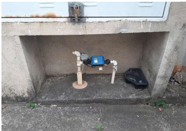
FOTO 37 Cavalete do hidrômetro
