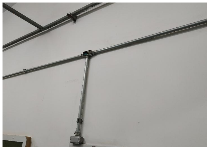
FOTO 28 Caixas dos conduletes sem tampa.
