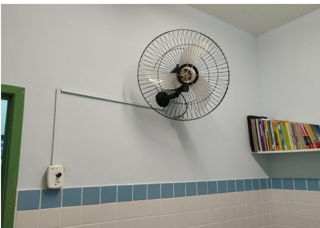
FOTO 95 Ventilador de parede, sala de reunião.
