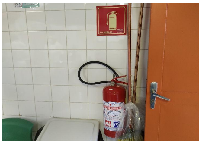
FOTO 21 Extintor pó químico, piso superior. Materiais obstruindo o espaço.
