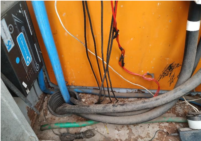
FOTO 7 Retira equipamento da Sabesp, inoperante.
