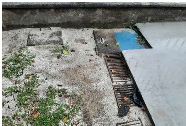
FOTO 65 Grelha sem manutenção
