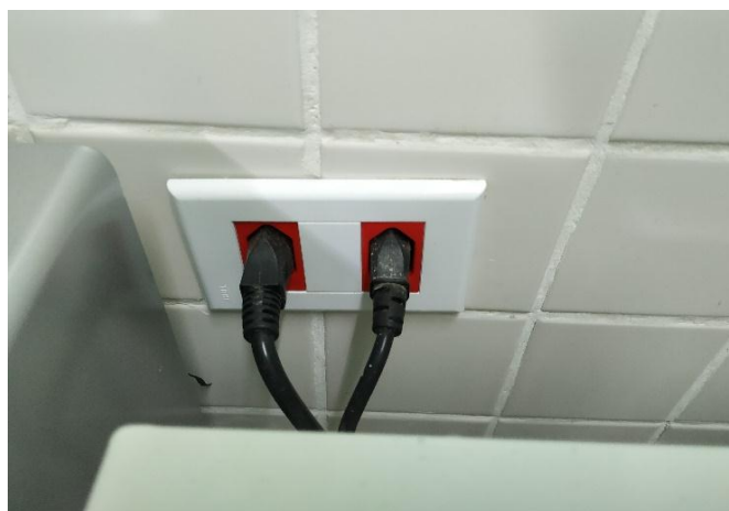
FOTO 60 Tomadas padrão brasileiro, verificar/substituir a seção dos cabos elétricos do refeitório dos professores.
