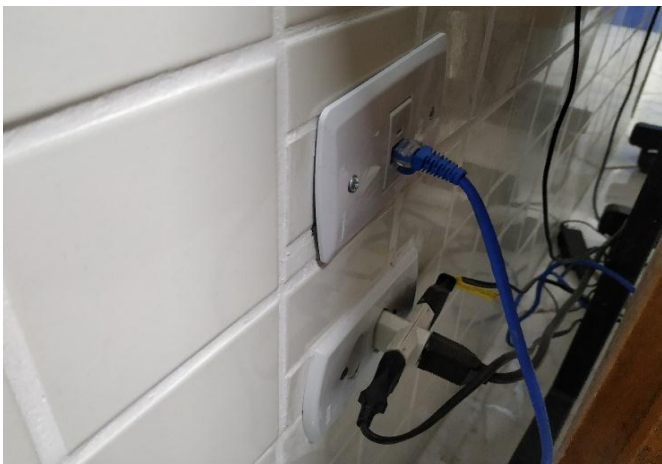
FOTO 67 Tomada com benjamin (T), acessório inadequado. Necessário instalação de tomadas. Secretaria.
