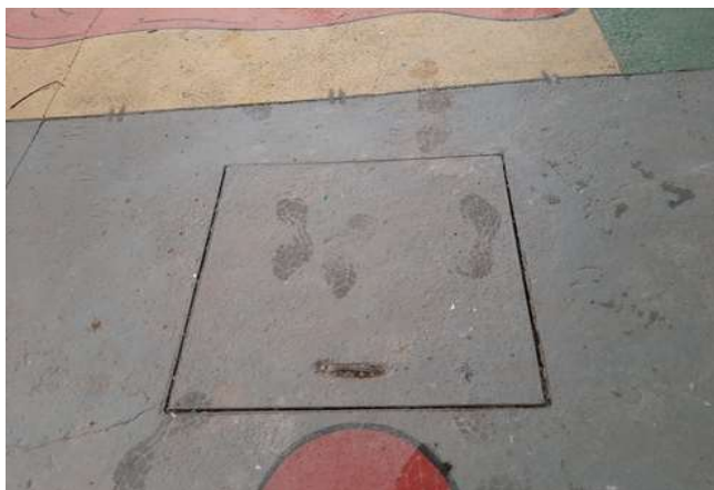
FOTO 54 Caixa de passagem
