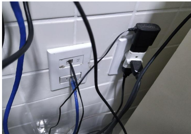
FOTO 68 Tomada com benjamin (T), acessório inadequado. Necessário instalação de tomadas. Direção.
