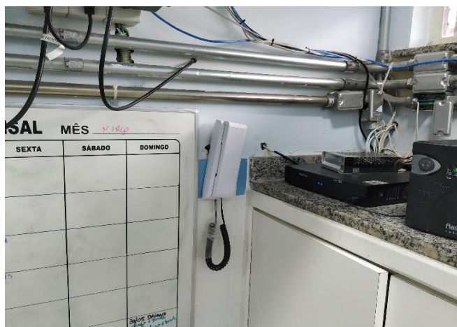
FOTO 100 Diversos cabos expostos, necessário revisão geral, secretaria.
