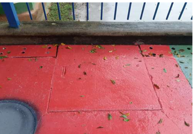
FOTO 59 Caixa de passagem
