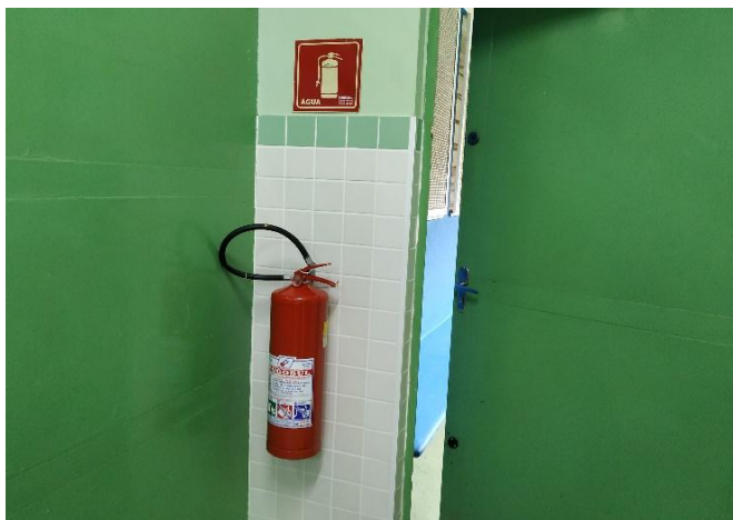
FOTO 19 Extintor de água. Piso térreo.
