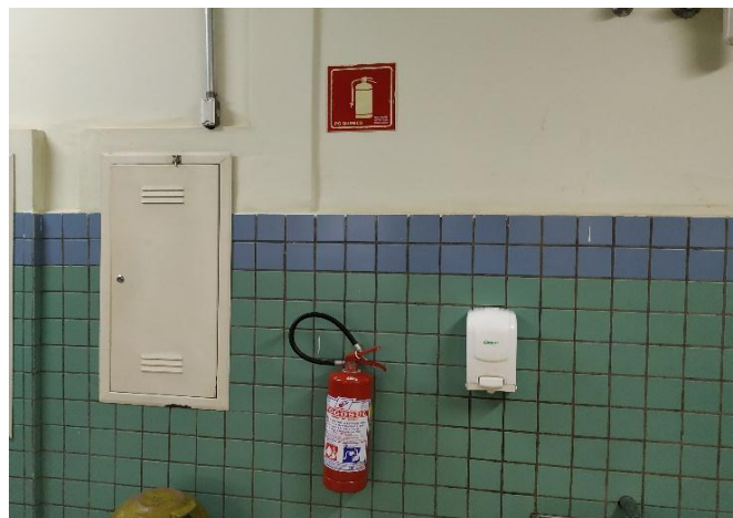
FOTO 20 Extintor pó químico. Piso térreo.
