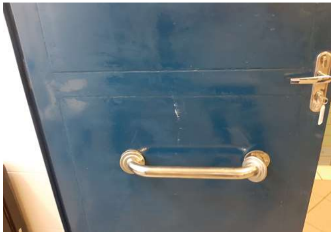
FOTO 25 Barra de apoio banheiro PNE
