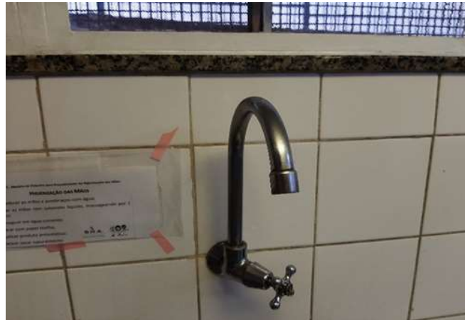
FOTO 44 Torneira cozinha parede
