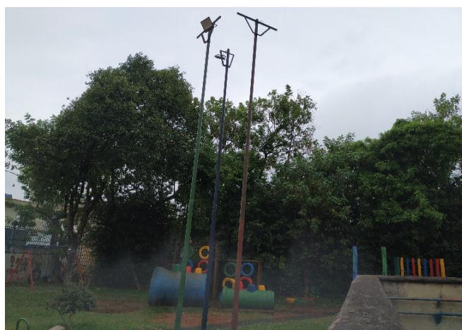
FOTO 54 Iluminação externa, com refletor de LED, playground.
