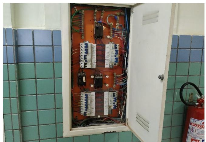
FOTO 12 Quadro de distribuição sobrecarregado, piso térreo. Sugestão, instalar um novo quadro, para uma melhor distribuição dos circuitos.
