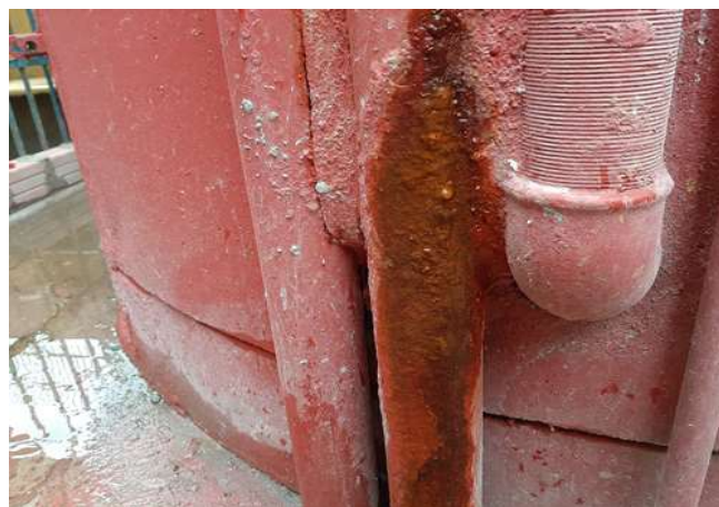
FOTO 40 Vazamento tubulação do reservatório
