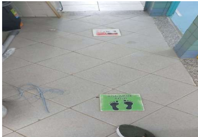
FOTO 46 PISOS DOS CORREDORES ESTÃO SOLTANDO
