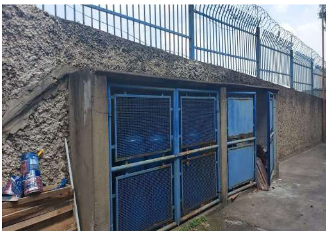
FOTO 17 CORROSÃO NO PORTÃO DO ABRIGO DE GÁS
