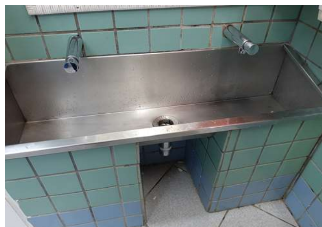
FOTO 42 Lavatório parede, torneiras com acionamento automático
