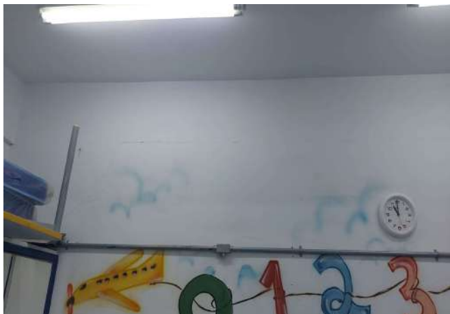
FOTO 43 TRINCA NA SALA 1
