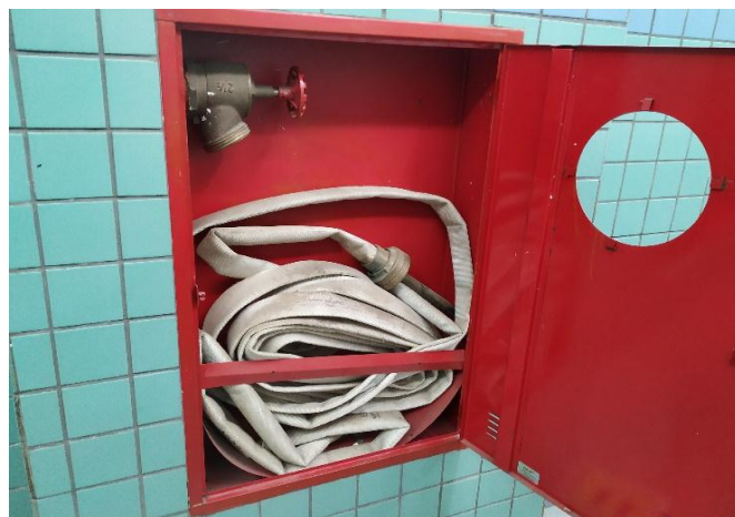
FOTO 16 Interior do abrigo, mangueira e esguicho.
