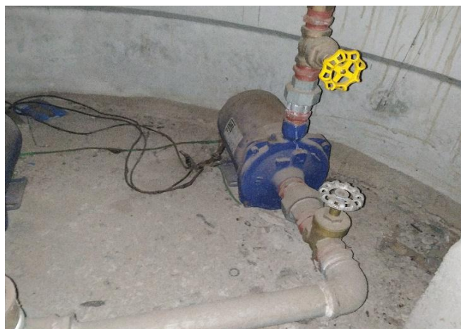
FOTO 22 Bomba de recalque, casa de bombas.
