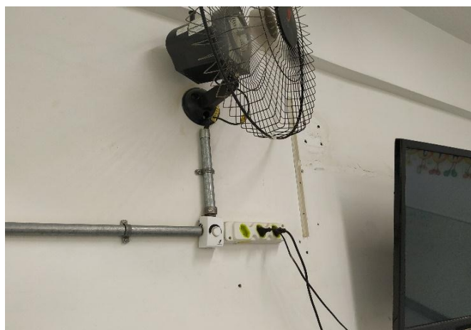
FOTO 58 Adaptação com extensão de tomadas, sala de aula 5.
