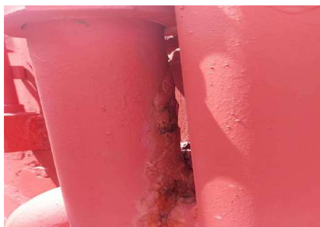
FOTO 14 VAZAMENTO NA PRUMADA DE FERRO
