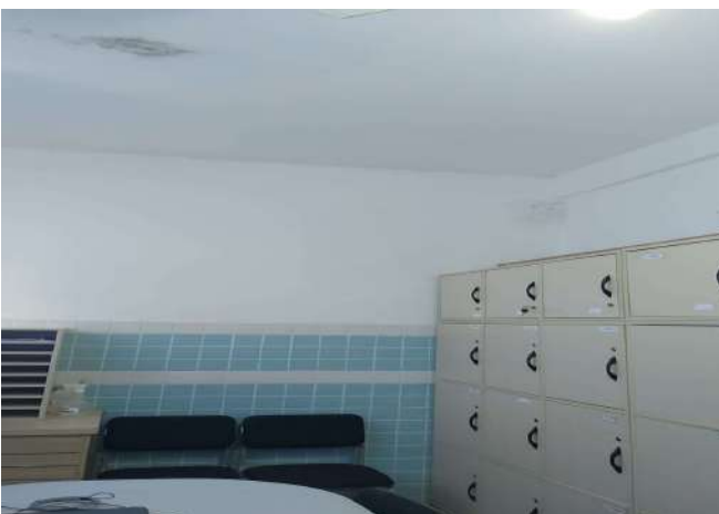
FOTO 35 INFILTRAÇÃO SALA DOS PROFESSORES
