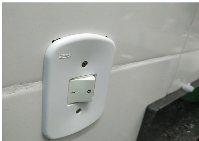
FOTO 50 Interruptor no banheiro infantil.
