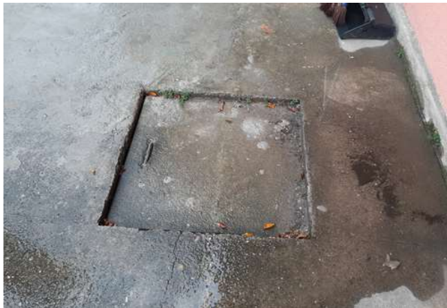
FOTO 55 Caixa de passagem
