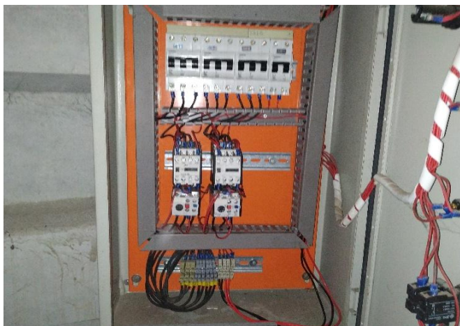
FOTO 25 Interior do quadro elétrico das bombas de recalque.
