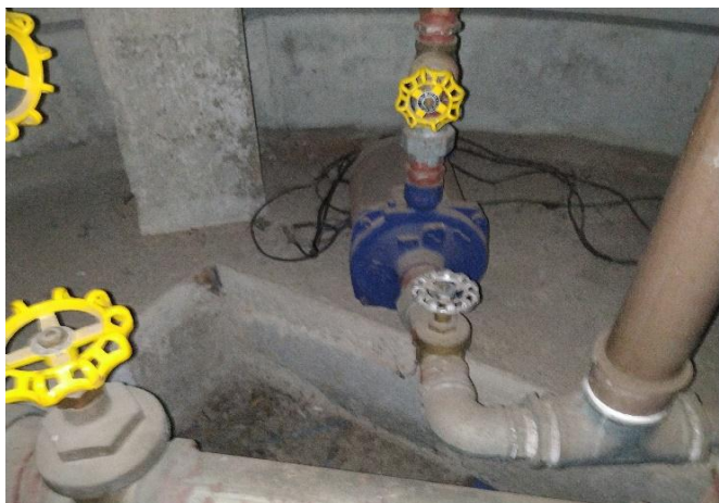
FOTO 23 Bomba de recalque, casa de bombas.
