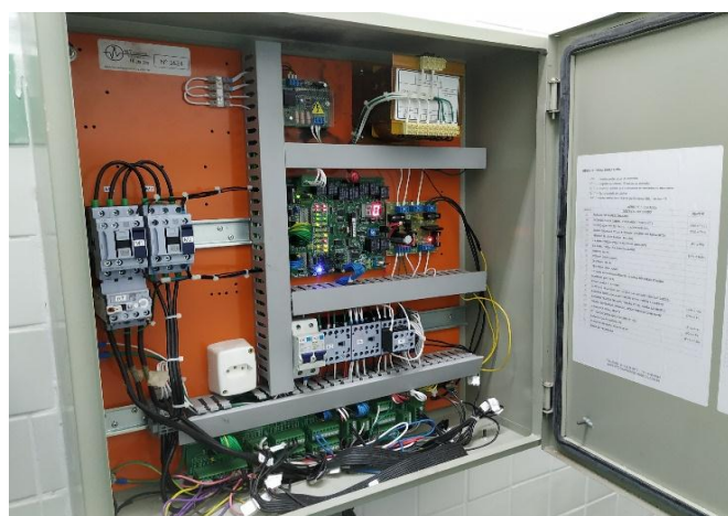
FOTO 88 Interior do quadro elétrico do elevador.
