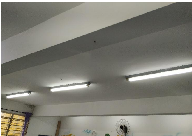
FOTO 31 Iluminação sala de aula 5.
