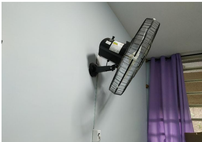
FOTO 97 Ventilador de parede, sala da coordenação.
