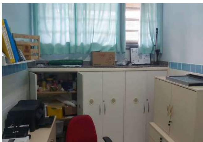
FOTO 3 SALA DA DIREÇÃO - INFILTRAÇÃO E MOFO NO ARMÁRIO DA DIRETORIA
