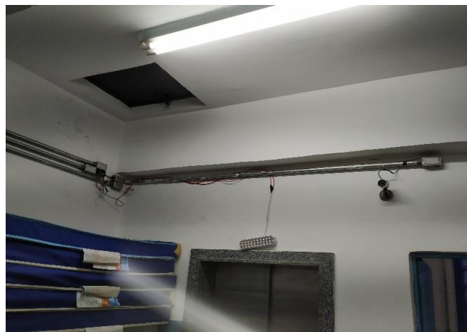
FOTO 26 Conduletes piso superior, com cabos expostos.
