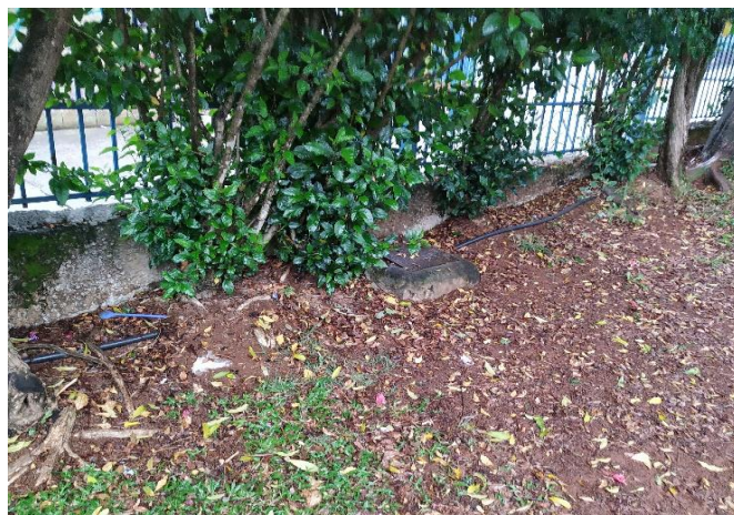
FOTO 56 Tubulação aparente, na parte externa.
