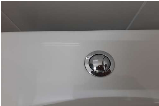
FOTO 49 Botão de duplo acionamento, caixa acoplada
