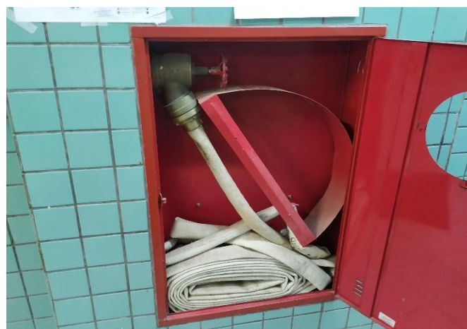
FOTO 12 Interior do abrigo, mangueira e esguicho.
