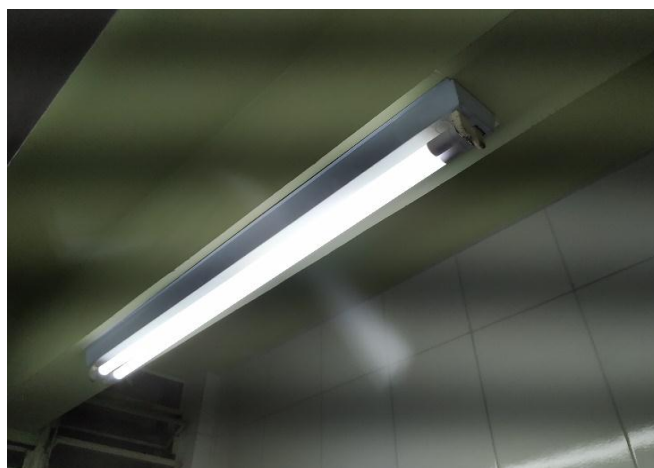
FOTO 40 Luminárias sobrepor com lâmpadas tubular de LED, banheiros infantis.
