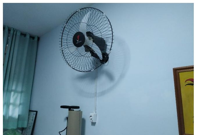
FOTO 96 Ventilador de parede, sala da direção.
