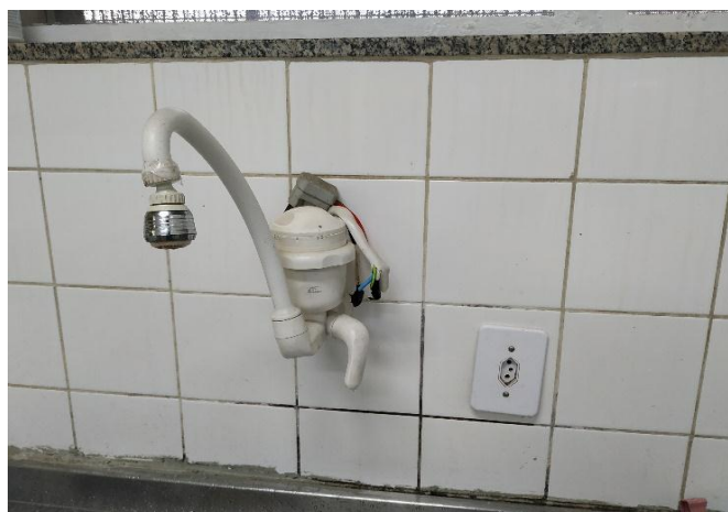
FOTO 72 Tomada padrão brasileiro, torneira elétrica inoperante, substituir ou retirar e instalar torneira comum.
