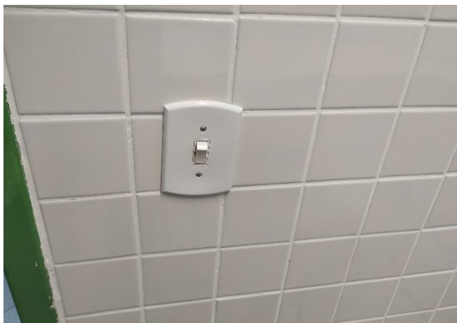
FOTO 43 Interruptor da sala de reunião.
