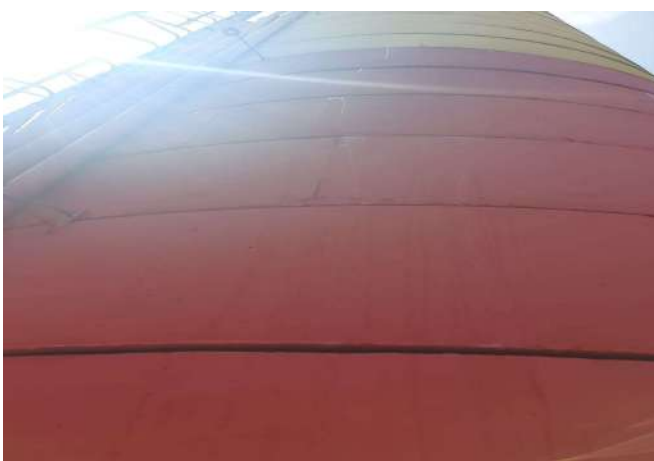
FOTO 16 VAZAMENTO NA PRUMADA DE FERRO
