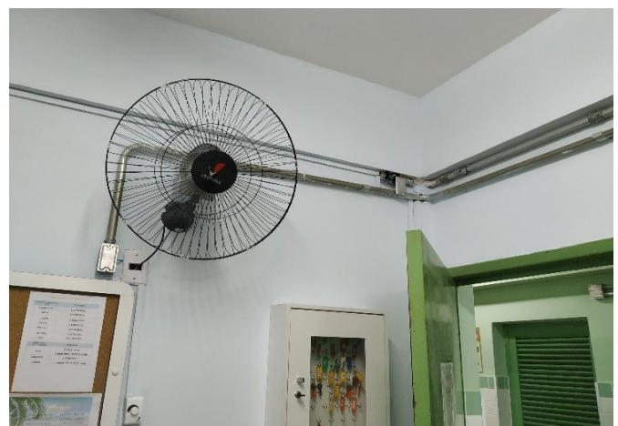
FOTO 94 Ventilador de parede, secretaria.
