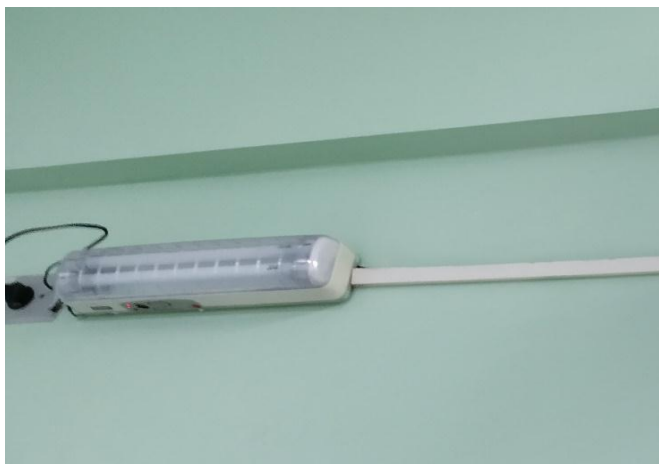
FOTO 25 Iluminação de emergência.
