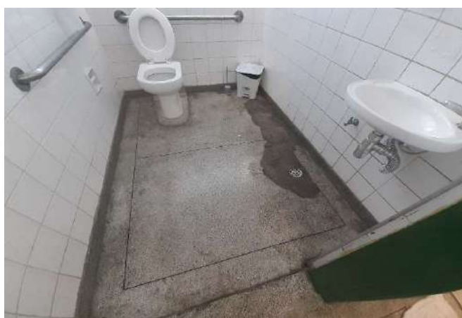
FOTO 159 Sanit. Deficiente Unissex - Piso danificado e retificado
