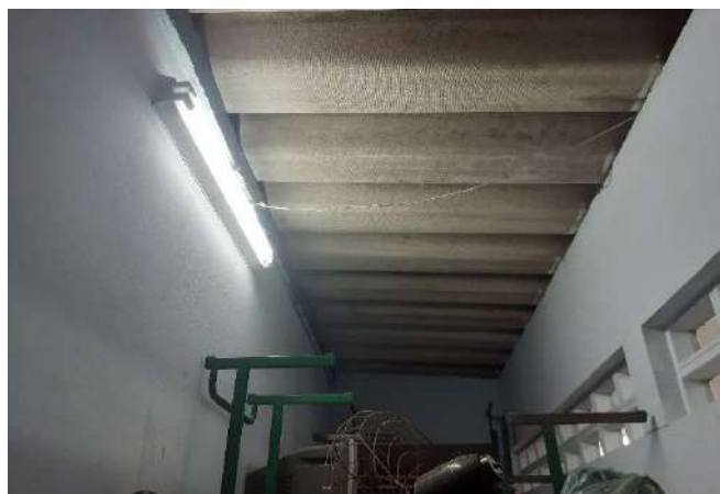
FOTO 12 Almojarifado - Improviso elétrico
