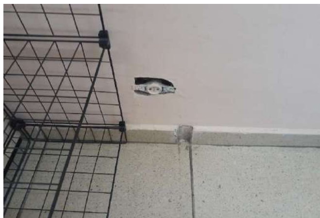
FOTO 108 Sala da Coordenação e Professores - Falta de espelho e rejunte sem continuidade
