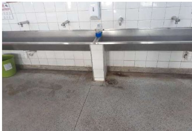
FOTO 98 Refeitório - Piso manchado
