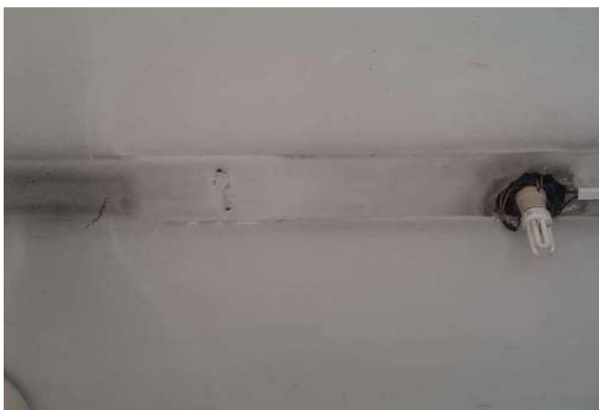
FOTO 29 Depósito Material de limpeza - Improviso elétrico
