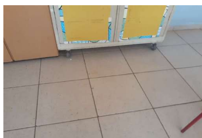
FOTO 136 Sala 6 - Piso desgastado
