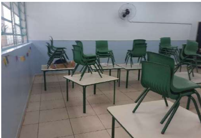
FOTO 121 Sala 2 - Esquadria e cerâmica desgastada
