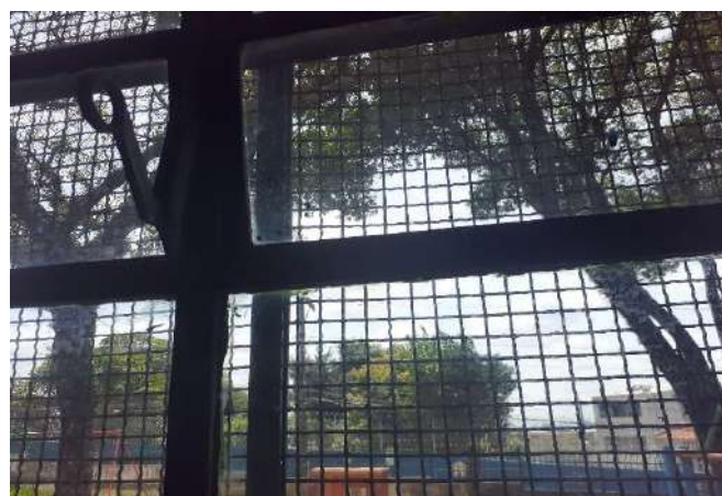
FOTO 162 Sanit. Deficiente Unissex - Esquadria danificada
