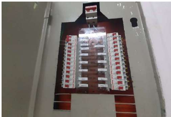
FOTO 169 Quadro de energia - Em conformidade
