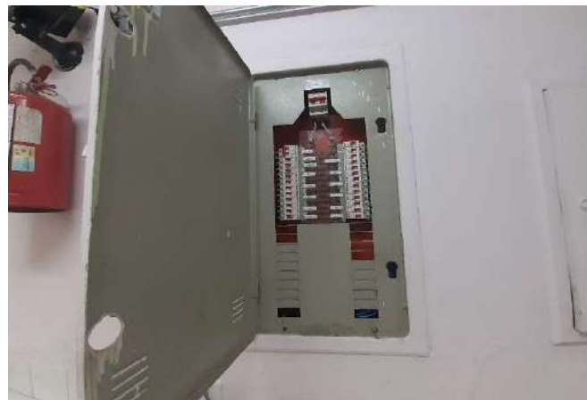
FOTO 170 Quadro de energia - Em conformidade
