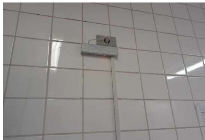
FOTO 174 Luz de Emergência - Em conformidade
