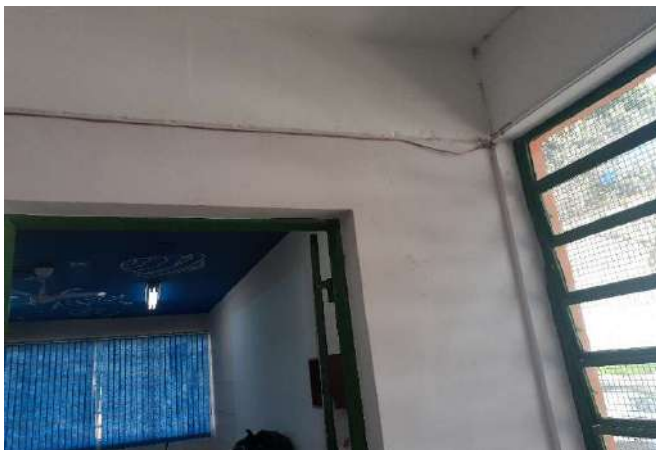
FOTO 97 Refeitório - Improviso elétrico
