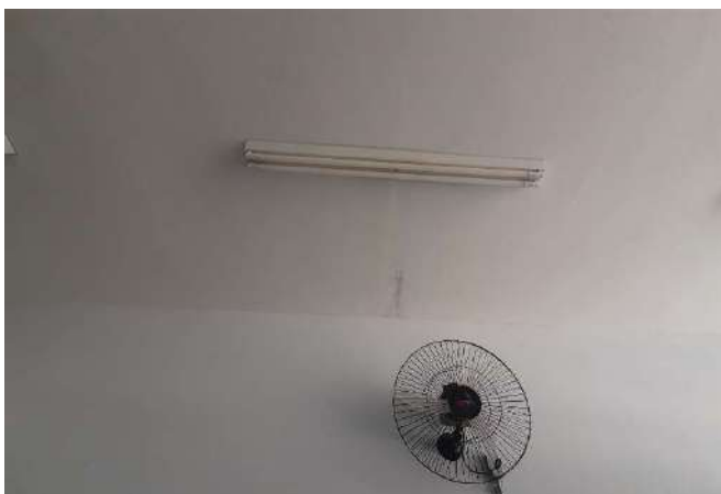
FOTO 131 Sala 5 - Mancha de bolor
