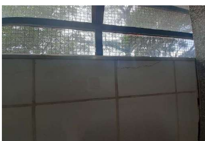
FOTO 154 Sanit. Aluno Masc. - Fissura azulejo
