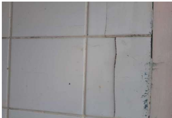
FOTO 26 Depósito - Trinca vertical (Azulejo)
