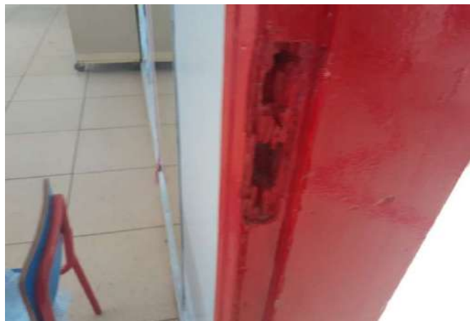
FOTO 134 Sala 6 - Batente danificado
