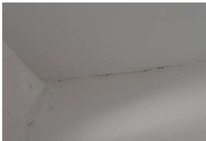
FOTO 48 Rampa (Acesso as salas) - Teto com trinca na junta com a parede
