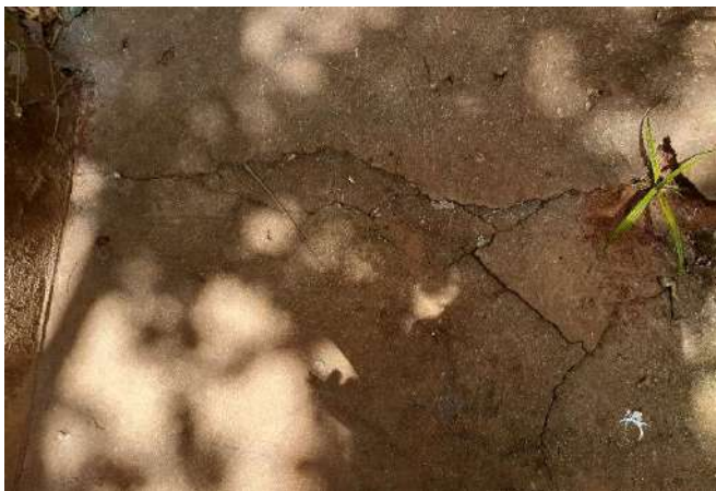
FOTO 79 Pisos externos - Partes quebradas
