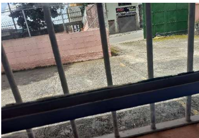
FOTO 141 Sala de Leitura - Esquadria emperrada
