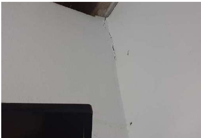
FOTO 13 Almojarifado - Trinca vertical
