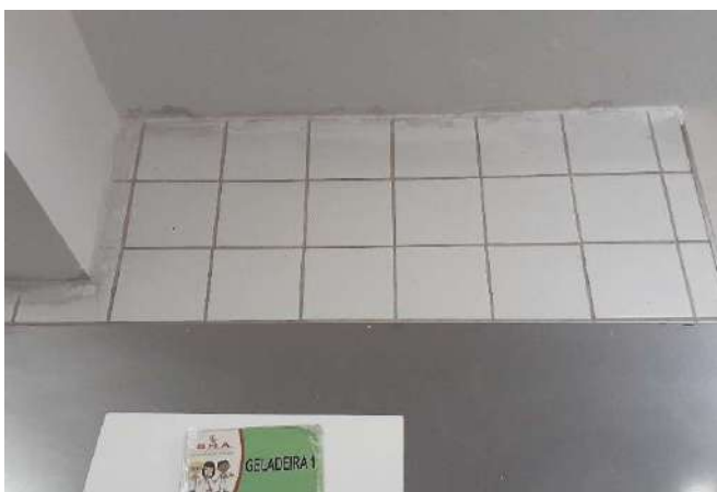
FOTO 15 Cozinha - Mancha de mofo/bolor
