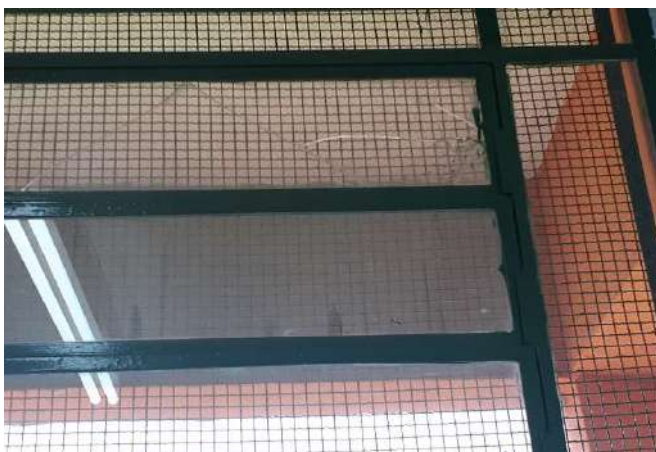
FOTO 125 Sala 3 - Esquadria emperrada e vidro quebrado
