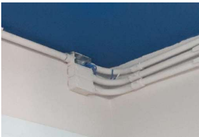
FOTO 143 Sala de Leitura - Improviso
