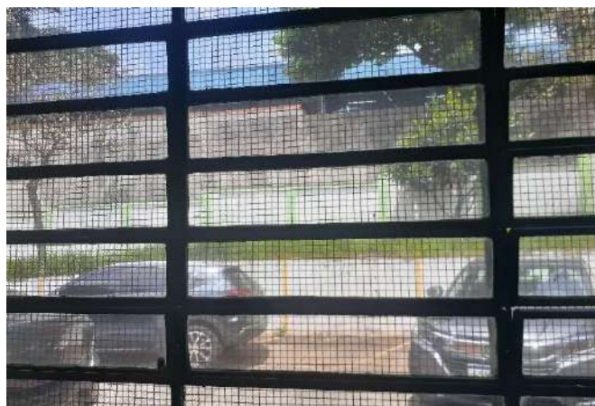
FOTO 96 Refeitório - Esquadria emperrada
