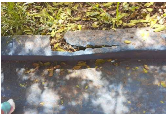
FOTO 73 Pátio descoberto - Partes quebradas
