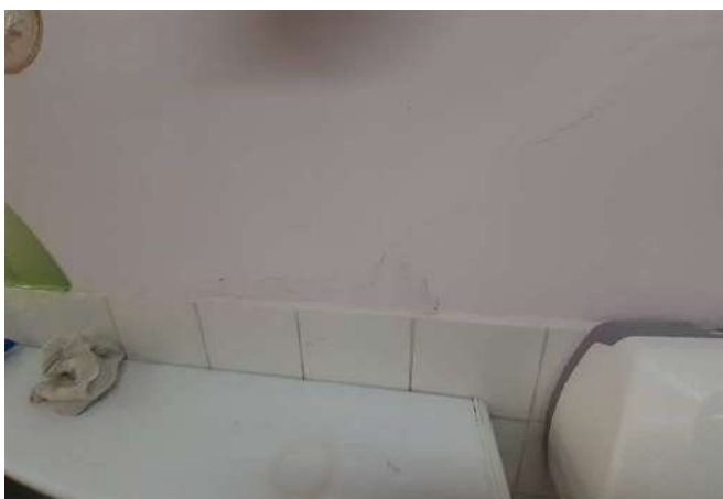
FOTO 63 Pátio Coberto - Trinca tratada
