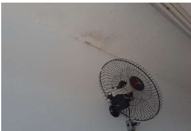
FOTO 135 Sala 6 - Mancha de bolor
