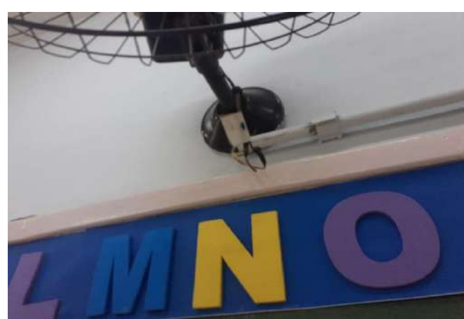
FOTO 118 Sala 1 - Improviso elétrico
