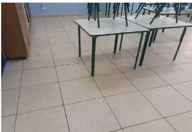
FOTO 123 Sala 3 - Piso desgastado
