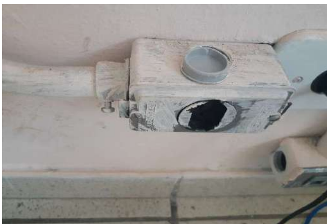
FOTO 107 Sala da Coordenação e Professores - Improviso elétrico
