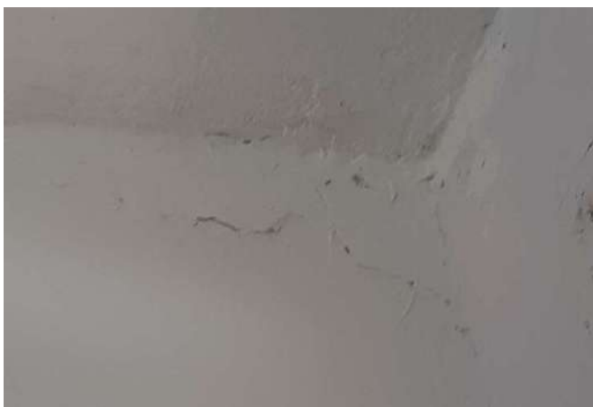
FOTO 47 Rampa (Acesso as salas) - Teto com trinca
