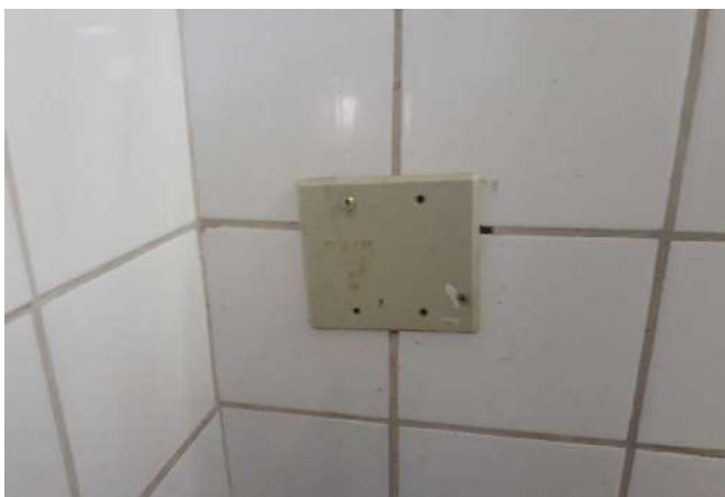
FOTO 17 Cozinha - Falha tomada (Espelho)
