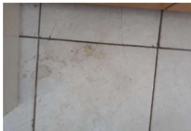
FOTO 4 Almoxarifado - Piso Cerâmico desgastado
