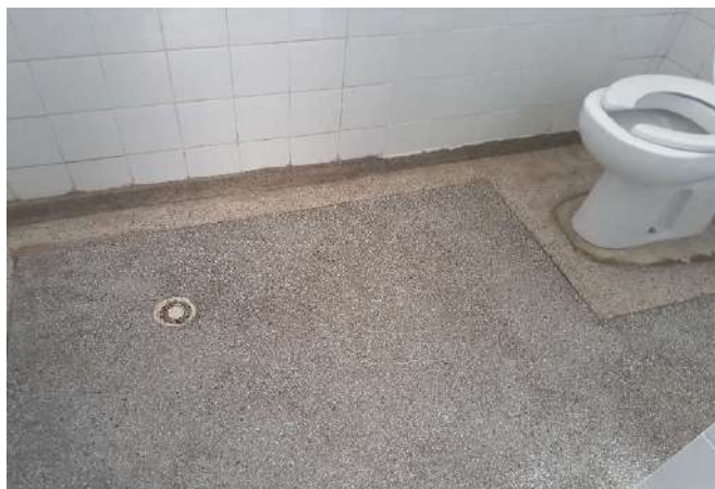
FOTO 157 Sanit. Deficiente Unissex - Piso desgastado
