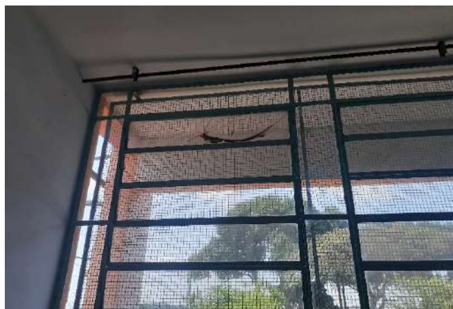
FOTO 132 Sala 5 - Vidro quebrado
