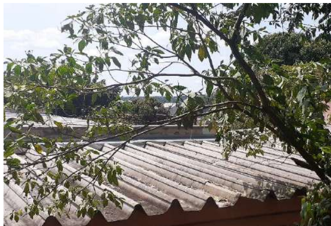
FOTO 164 Cobertura - Telha quebrada (vista do mirante)
