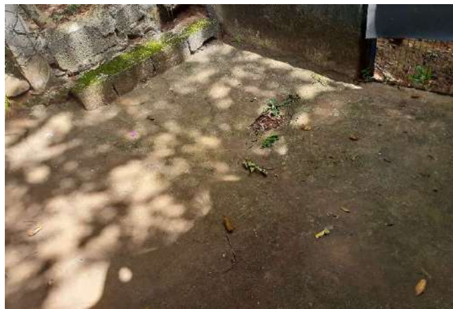
FOTO 80 Pisos externos - Fissura
