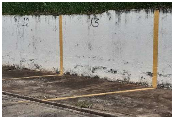
FOTO 36 Estacionamento - Vaga e deficiência na juntas de dilatação
