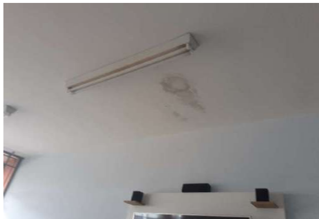
FOTO 8 Brinquedoteca - Infiltração, mancha de mofo/bolor
