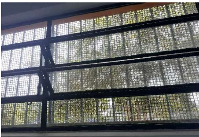
FOTO 23 Despensa - Esquadria emperrada
