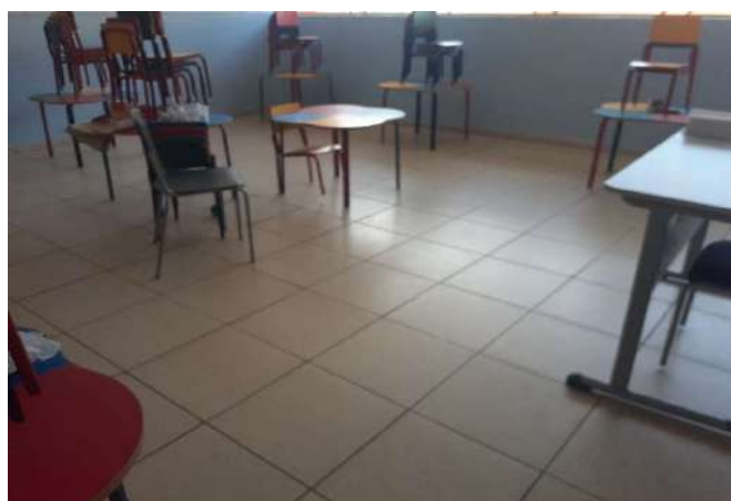
FOTO 138 Sala 7 - Cerâmica desgastada
