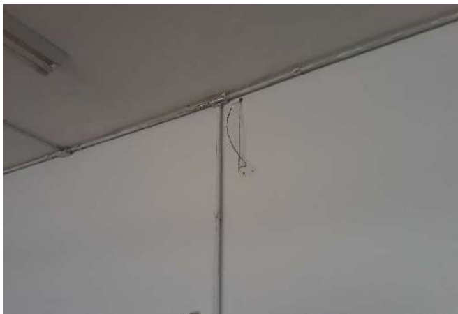
FOTO 7 Brinquedoteca - Improviso elétrico
