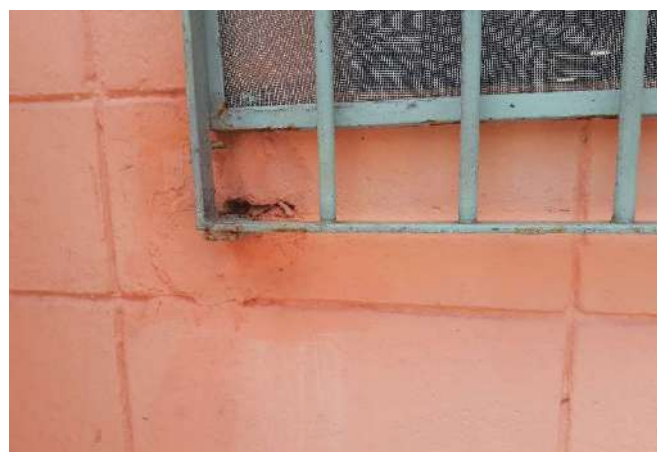
FOTO 76 Paredes externas - Partes quebradas
