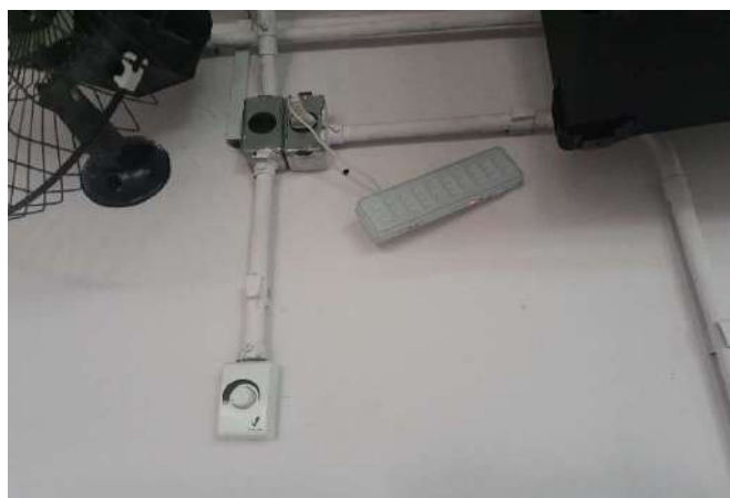
FOTO 94 Refeitório - Improviso elétrico
