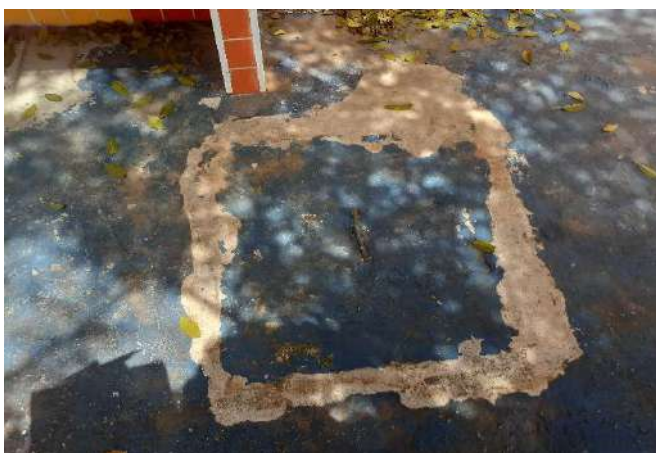
FOTO 81 Pisos externos - Juntas de dilatação deficientes
