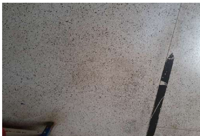
FOTO 69 Pátio Coberto - Piso com fissura
