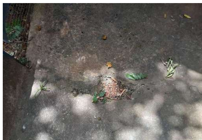
FOTO 78 Pisos externos - Abatimento do piso
