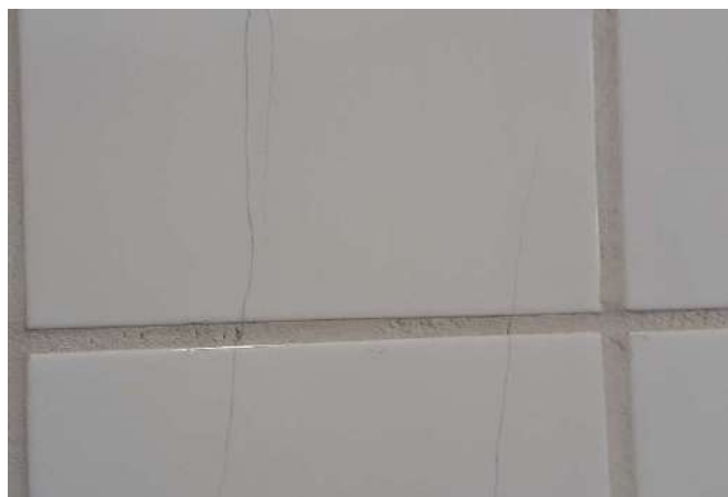
FOTO 18 Cozinha - Fissura vertical (Azulejo)
