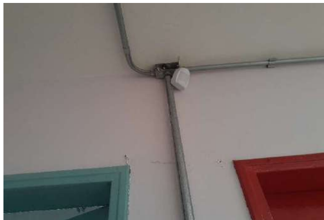
FOTO 68 Pátio Coberto - Improviso elétrico
