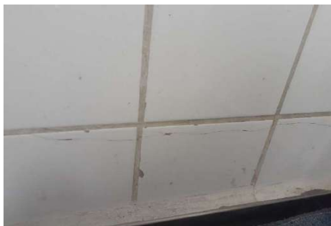
FOTO 16 Cozinha - Fissura horizontal (Azulejo)
