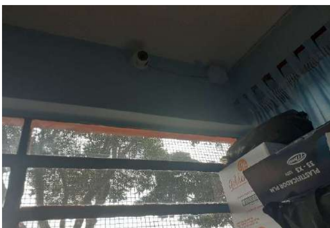
FOTO 5 Almoxarifado - Improviso elétrico e esquadria emperrada
