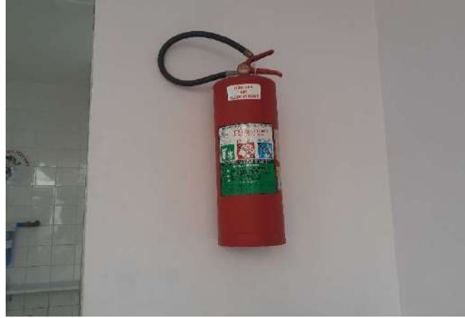
FOTO 172 Extintor - Sem placa de identificação
