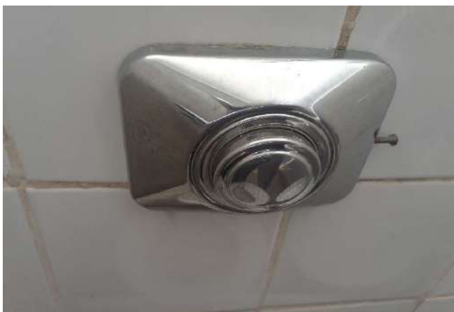
FOTO 149 Sanit. Aluno Fem. - Pregos na valvula de descarga
