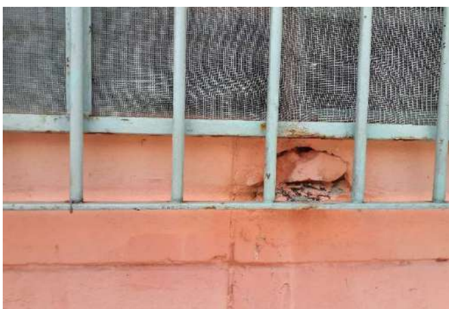
FOTO 75 Paredes externas - Partes quebradas
