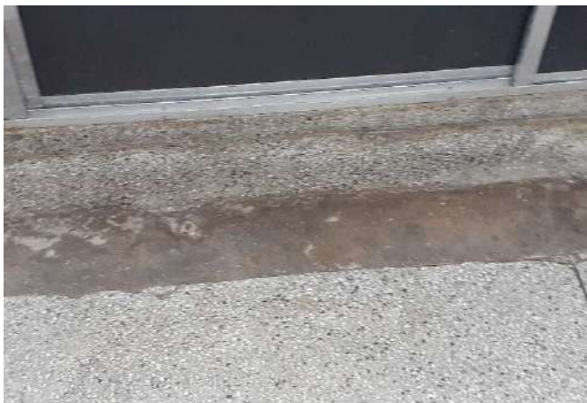
FOTO 19 Cozinha - Piso desgastado , Reparo e manchado
