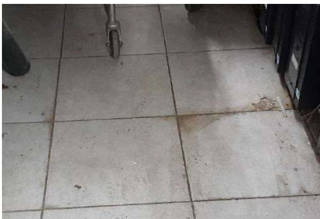
FOTO 11 Almojarifado - Piso desgastado e manchado
