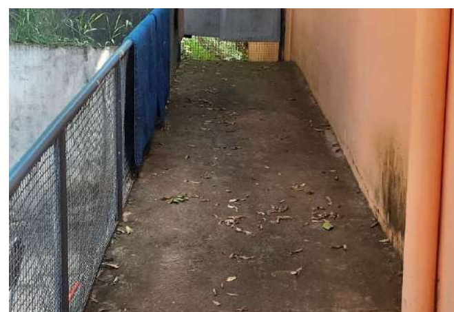
FOTO 166 Acessibilidade - Rampa externa com manchas de umidade do solo
