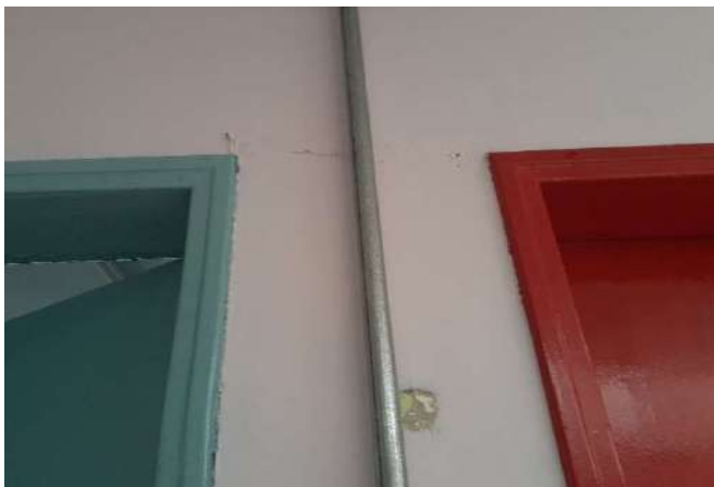
FOTO 67 Pátio Coberto - Fissura
