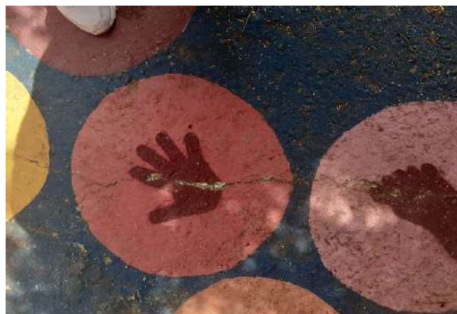
FOTO 74 Pátio descoberto - Piso quebrado
