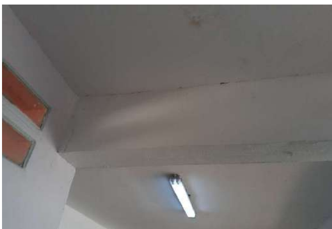
FOTO 45 Rampa (Acesso as salas) - Infiltração, mancha de mofo/bolor
