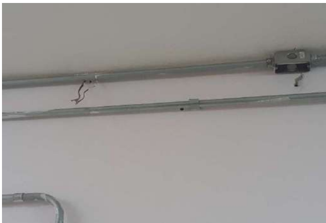
FOTO 61 Pátio Coberto - Improviso elétrico
