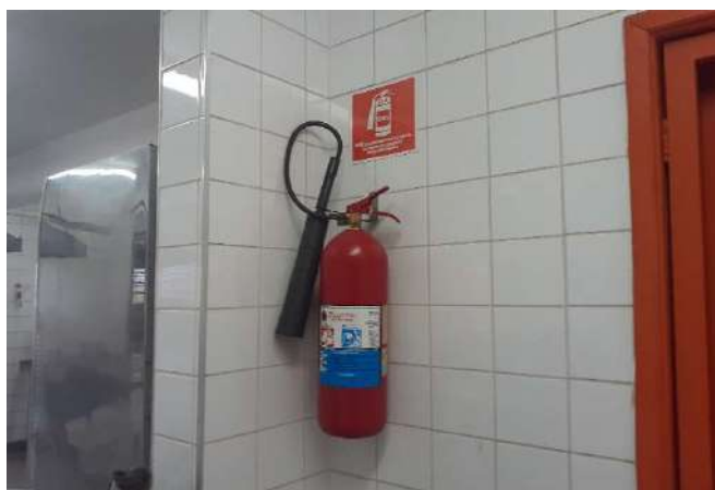
FOTO 171 Extintor - Em conformidade
