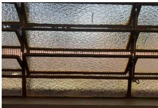
FOTO 112 Sala da Coordenação e Professores - Esquadria danificada
