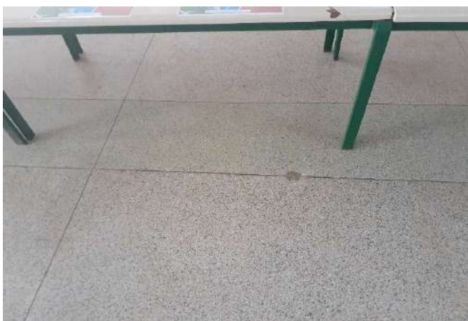
FOTO 99 Refeitório - Piso danificado
