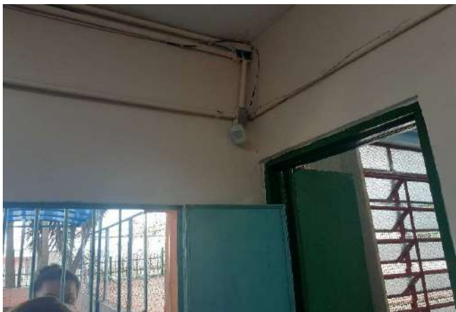
FOTO 103 Sala do Diretor e Assistente - Improviso elétrico
