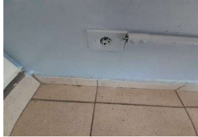
FOTO 130 Sala 5 - Improviso elétrico
