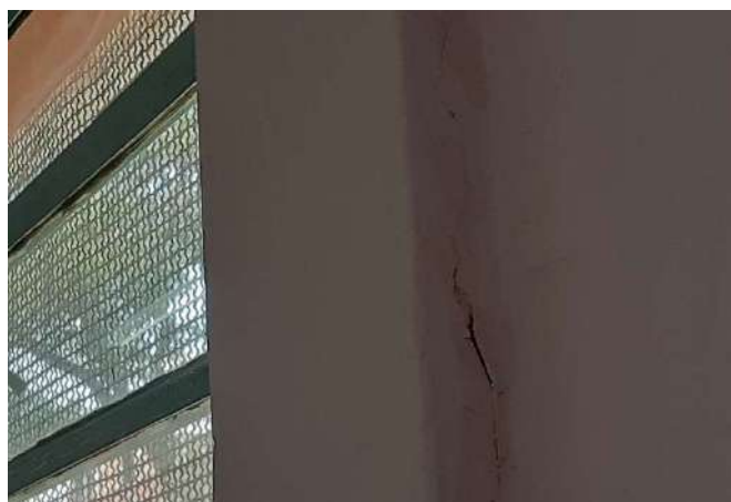
FOTO 46 Rampa (Acesso as salas) - Trinca no pilar
