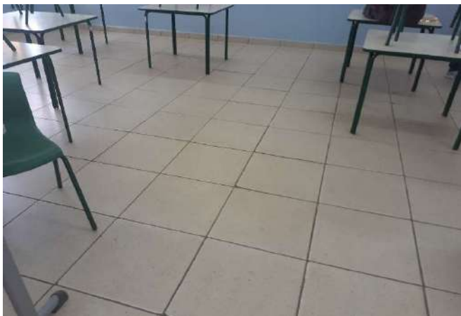
FOTO 127 Sala 4 - Piso desgastado
