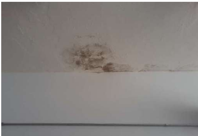
FOTO 139 Sala 7 - Mancha de bolor
