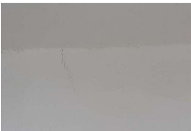
FOTO 33 Depósito Material didático - Fissura
