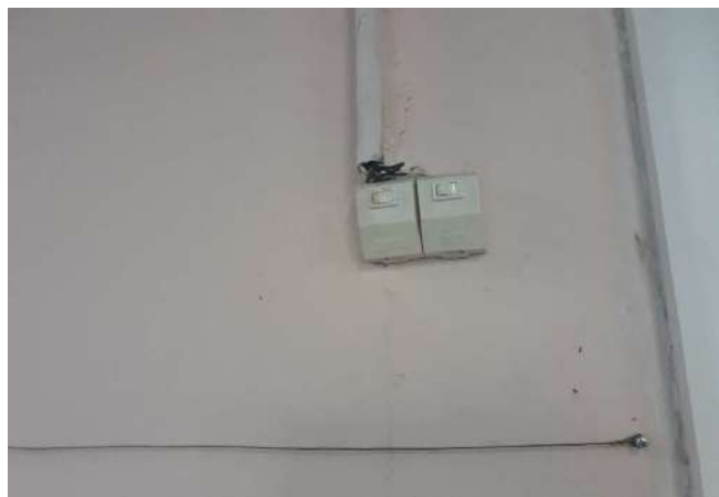
FOTO 142 Sala de Leitura - Improviso
