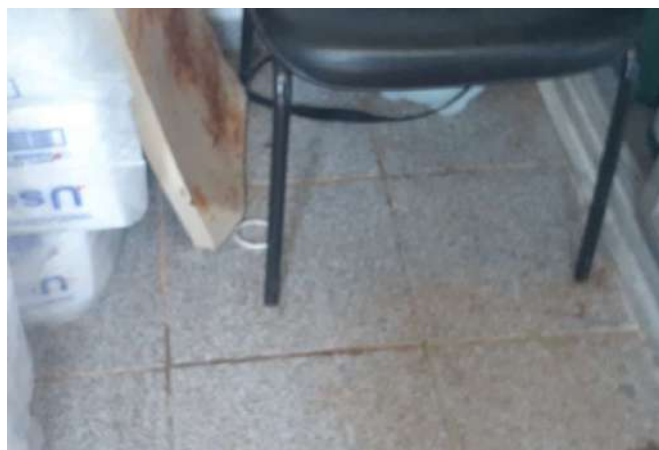
FOTO 30 Depósito Material de limpeza - Piso desgastado
