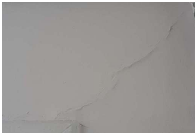
FOTO 62 Pátio Coberto - Trinca tratada
