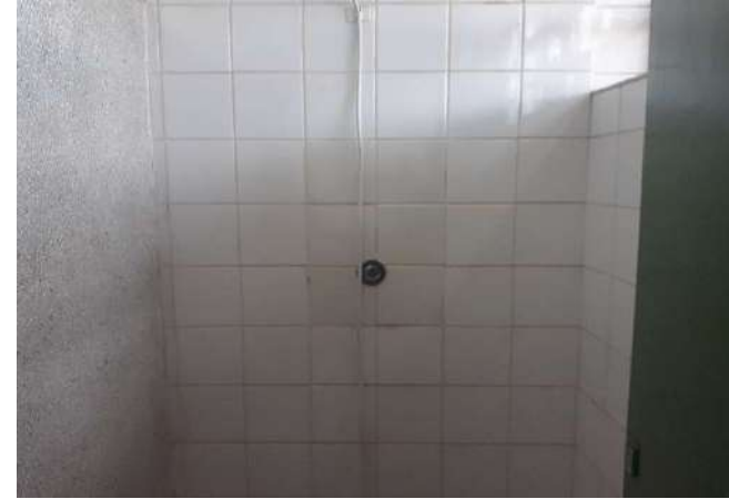
FOTO 148 Sanit. Aluno Fem. - Mancha de infiltração
