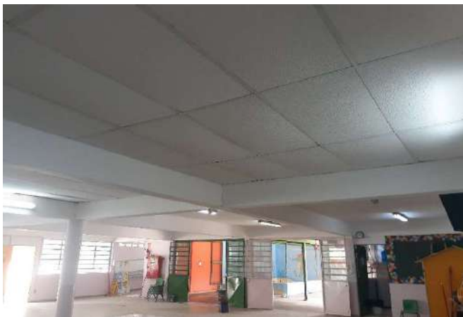
FOTO 91 Refeitório - Forro deformado e inexistência de alçapão
