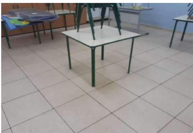
FOTO 119 Sala 1 - Piso desgastado
