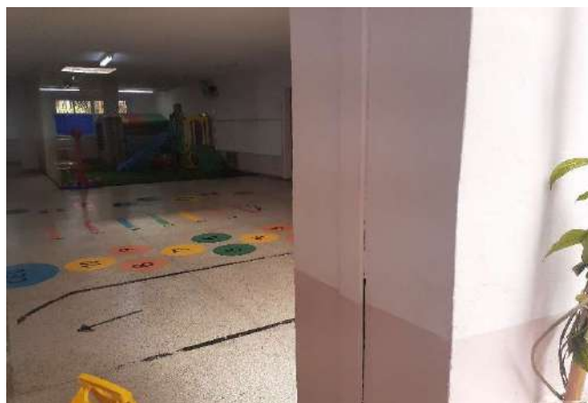
FOTO 66 Pátio Coberto - Moldura solta
