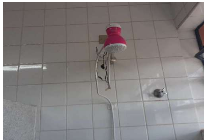
FOTO 146 Sanit. Aluno Fem. - Improviso elétrico
