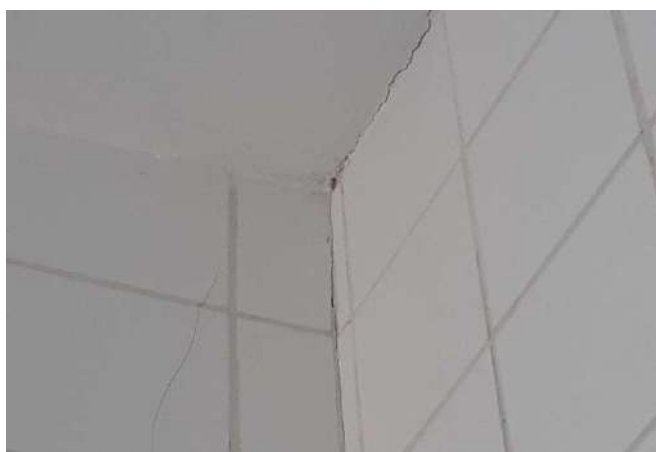
FOTO 161 Sanit. Deficiente Unissex - Fissura no azulejo
