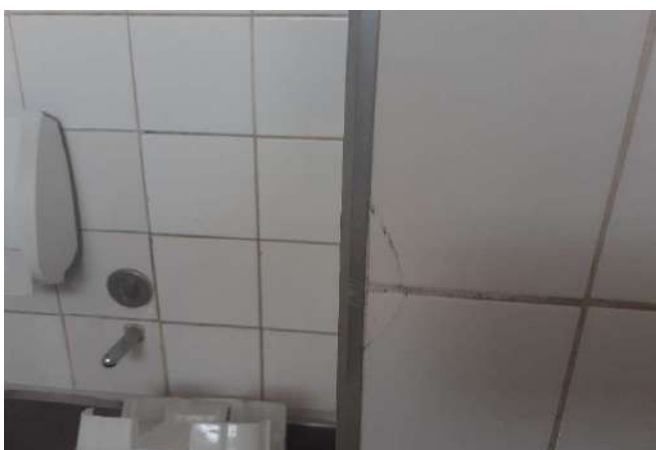
FOTO 155 Sanit Aluno Masc - Azulejo com trinca
