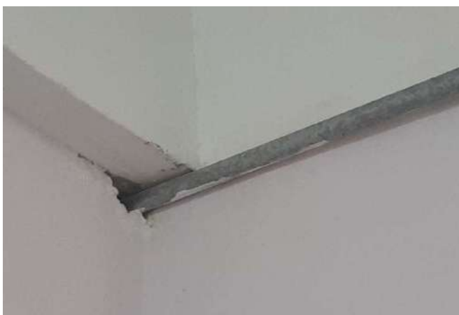
FOTO 93 Refeitório - Partes quebradas
