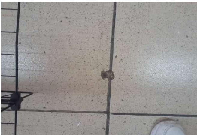
FOTO 109 Sala da Coordenação e Professores - Piso desgastado
