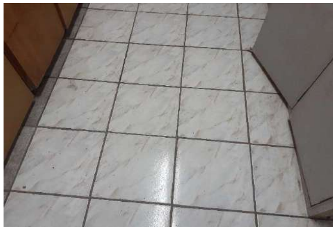
FOTO 32 Depósito Material didático - Piso desgastado
