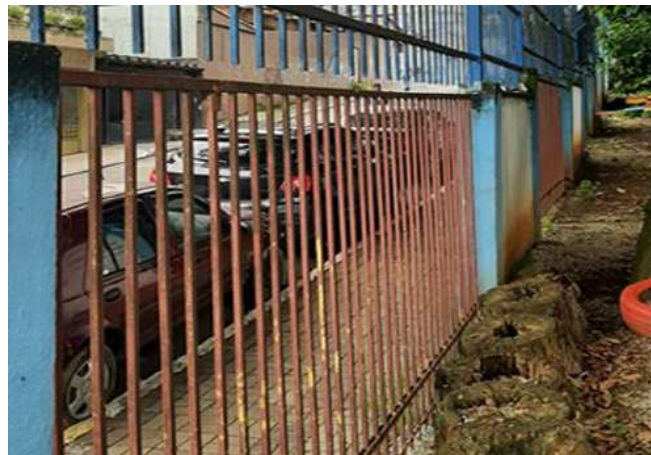
FOTO 60 GRADE DE FECHAMENTO, DIVISA COM A RUA, FALTA MANUTENÇÃO
