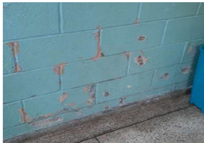
FOTO 24 PINTURA DESCASCANDO, CORREDOR DAS SALAS
