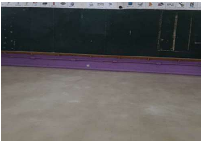
FOTO 7 MANCHAS NO PISO, SALA ROXA
