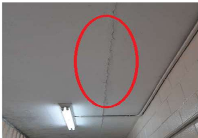
FOTO 23 TRINCAS NO TETO CORREDOR DAS SALAS
