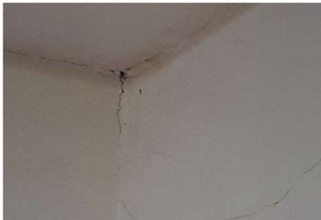
FOTO 3 TRINCAS E FISSURAS NAS PAREDES, SALA ROSA
