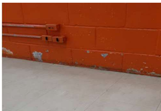
FOTO 10 PINTURA PAREDE DESCASCANDO, SALA LARANJA
