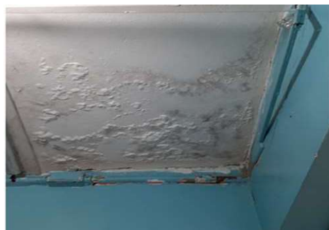
FOTO 22 INFILTRAÇÃO VINDA DA COBERTURA, CORREDOR DAS SALAS
