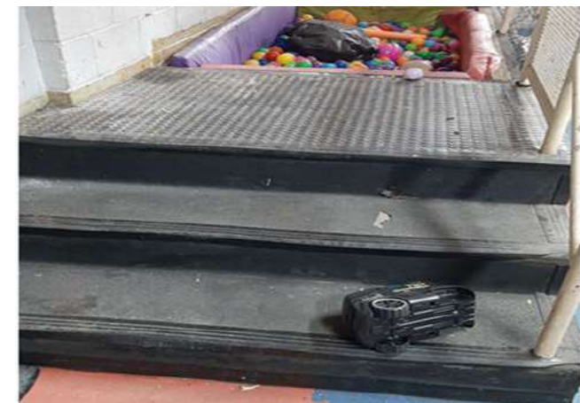
FOTO 46 LOCAL INTERDITADO PARA REFORMA DO PISO E FORRO, BRINQUEDOTECA
