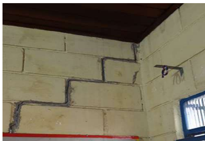
FOTO 20 RACHADURA/DESCOLAMENTO DO BLOCO, ATELIÊ
