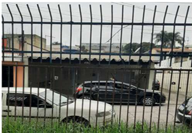
FOTO 59 GRADE DE FECHAMENTO, DIVISA COM A RUA, FALTA MANUTENÇÃO
