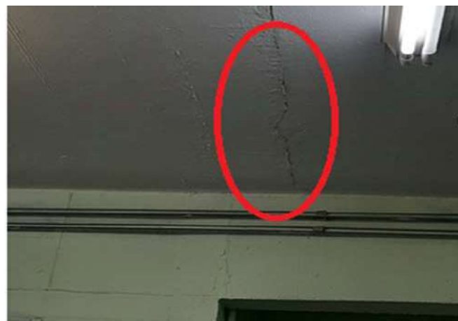
FOTO 32 TRINCAS NO TETO, SALA DA GESTÃO
