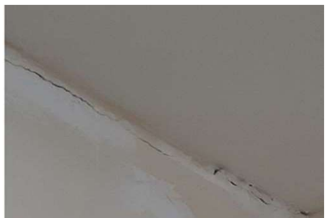
FOTO 4 TRINCAS E FISSURAS NAS PAREDES, SALA ROSA
