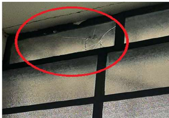
FOTO 38 VIDRO DO CAIXILHO QUEBRADO, COZINHA
