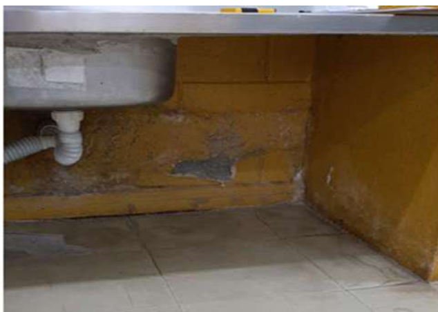
FOTO 15 MOFO NA PAREDE E PISO, SALA AMARELA
