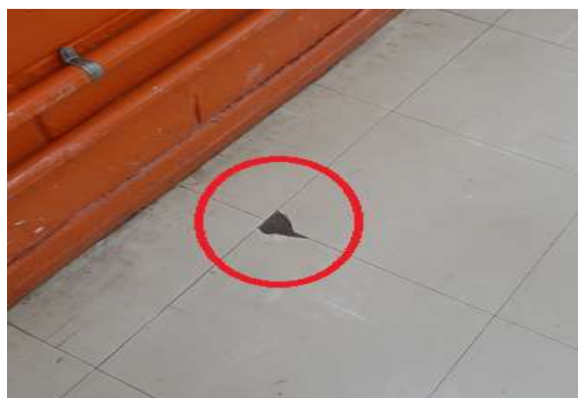
FOTO 9 PISO MANCHADO E QUEBRADO, SALA LARANJA
