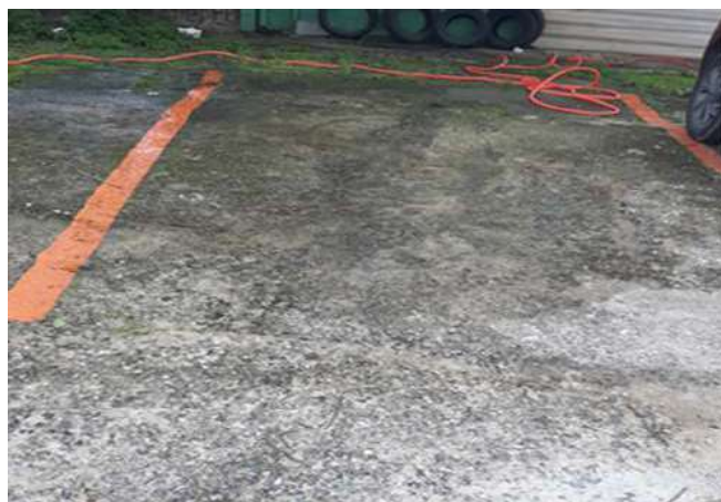
FOTO 56 PISO COM TRINCAS, ESTACIONAMENTO
