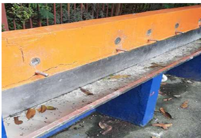
FOTO 58 BEBEDOURO ÁREA EXTERNA COM TRINCAS NA MURETA
