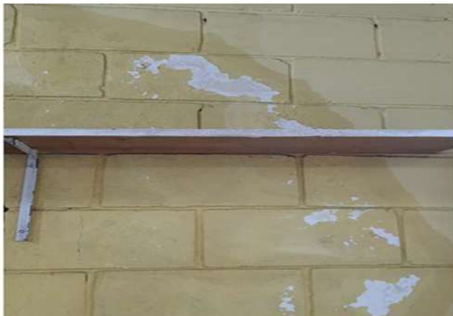
FOTO 19 INFILTRAÇÃO DE ÁGUA, ATELIÊ
