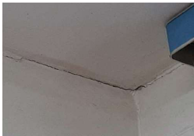
FOTO 8 TRINCA E FISSURAS NAS PAREDES, SALA ROXA
