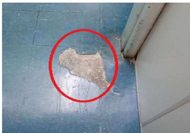
FOTO 35 PISO QUEBRADO, HALL SALA DA GESTÃO
