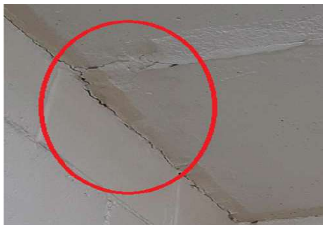
FOTO 16 TRINCAS NO TETO E PAREDE, SALA AMARELA
