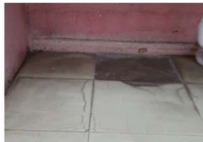
FOTO 5 PISO TRINCADO E/OU SOLTO, SALA ROSA
