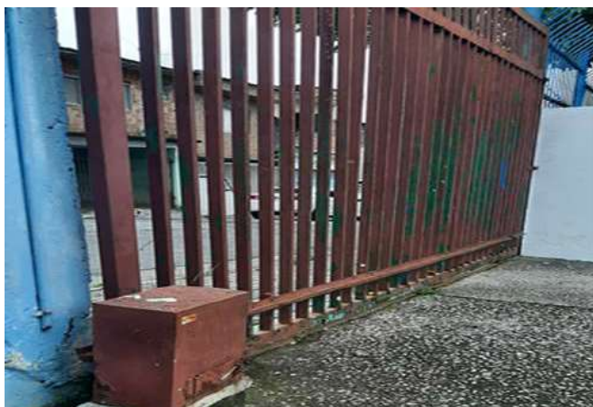
FOTO 57 PORTÃO DE ACESSO AO ESTACIONAMENTO, FALTA MANUTENÇÃO
