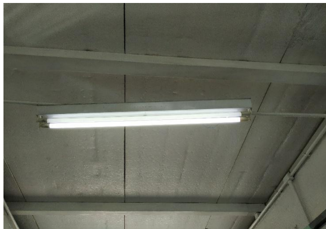
FOTO 20 Luminárias sobrepor com lâmpadas tubular de LED, corredor do banheiro infantil.
