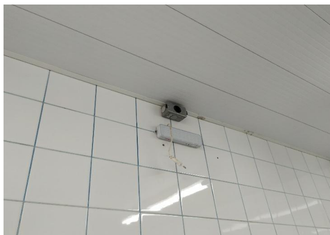
FOTO 10 Iluminação de emergência, desativada.
