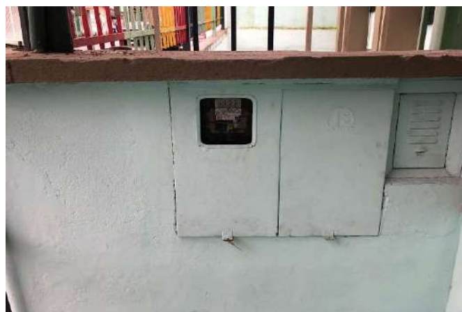
FOTO 68 ENTRADA DE ENERGIA (PADRÃO ANTIGO).
