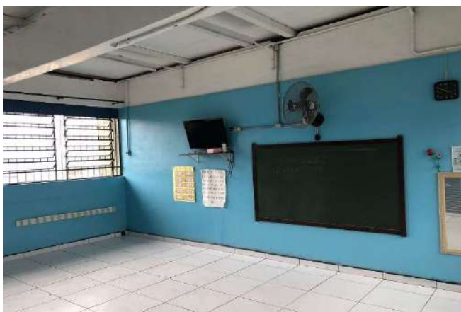
FOTO 75 SALA DE AULA 01, IMPROVISO NA REDE DE ILUMINAÇÃO/VENTILADORES.
