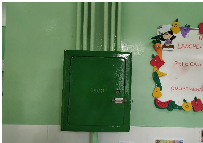
FOTO 8 Quadro geral de baixa tensão (QGBT). Piso térreo.
