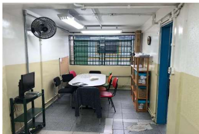
FOTO 62 SALA DE REUNIÃO COM IMPROVISO NA LIGAÇÃO ELÉTRICA E VENTILADORES.
