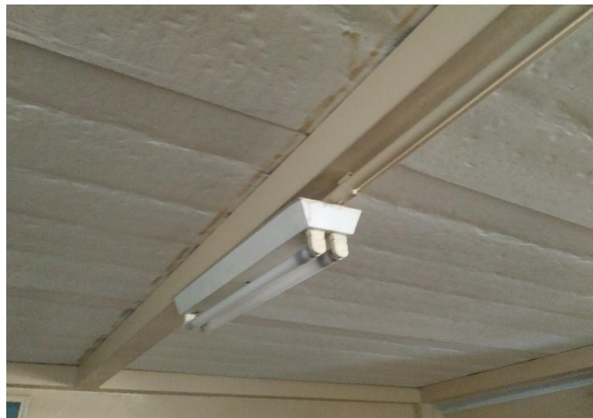
FOTO 32 Luminárias sobrepor com lâmpadas tubular fluorescente, sala externa.
