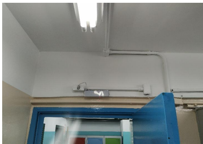
FOTO 12 Iluminação de emergência, sala de aula.
