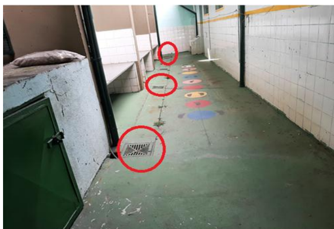
FOTO 39 Caixa de passagem água pluvial do telhado
