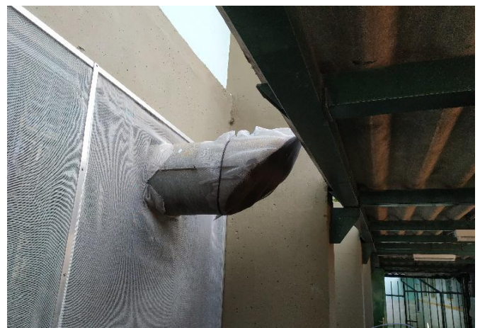
FOTO 78 Saída da tubução do exaustor.
