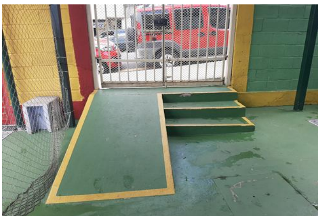
FOTO 5 Rampa irregular, entrada da unidade
