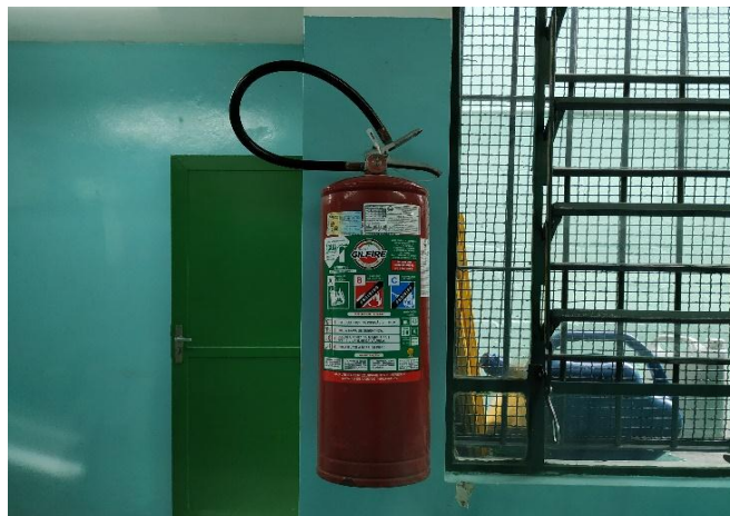
FOTO 8 Extintor de água. Sem sinalização.
