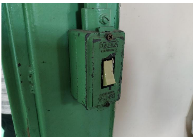
FOTO 39 Interruptor, sala externa.
