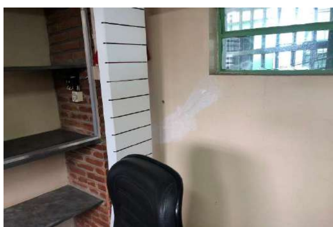
FOTO 24 SALA DE ASSISTENTE DE DIREÇÃO COM TRINCA E FISSURA SOBRE CAIXILHO.
