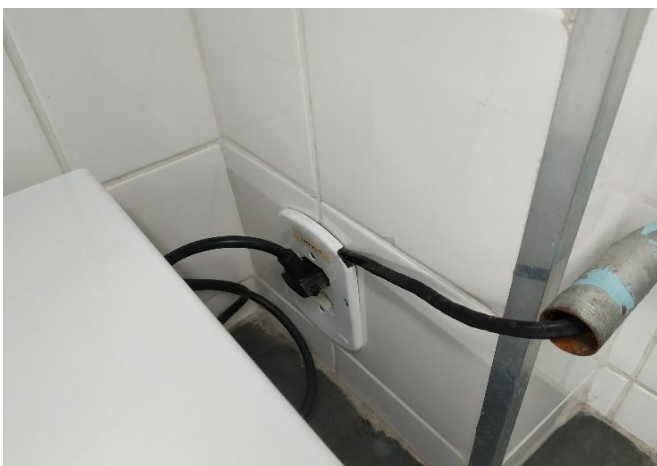
FOTO 53 Cabo elétrico exposto, adequar a infraestrutura, refeitório dos professores.
