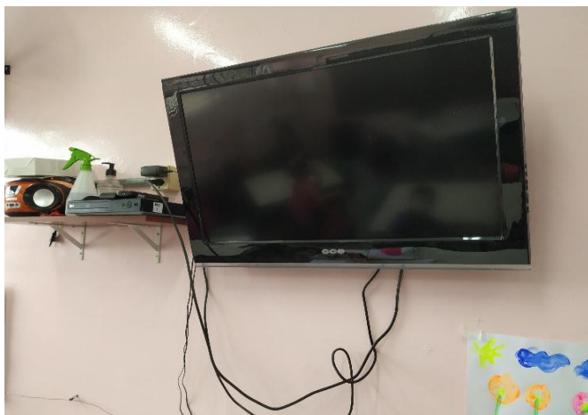
FOTO 79 Televisor instalado sala de aula 1.
