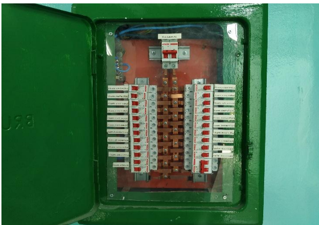
FOTO 11 Interior do quadro de distribuição. Cabos neutro e terra fora do padrão de cores.
