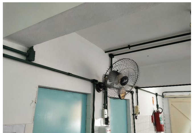
FOTO 76 Ventilador de parede, refeitório.
