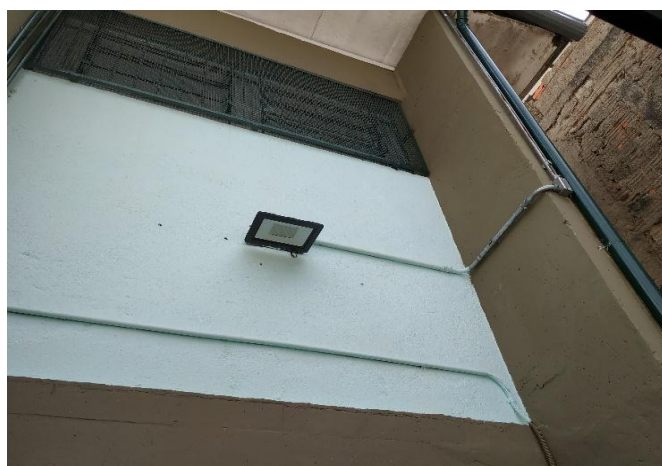
FOTO 42 Refletor de LED, corredor dos fundos.
