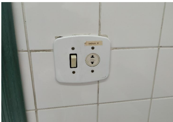
FOTO 35 Interruptor e tomada, refeitório dos professores.
