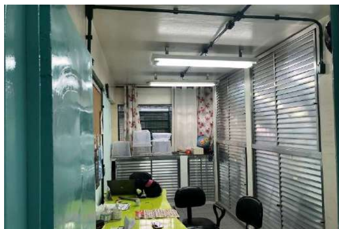
FOTO 50 SECRETARIA, IMPROVISO NA REDE ELÉTRICA.
