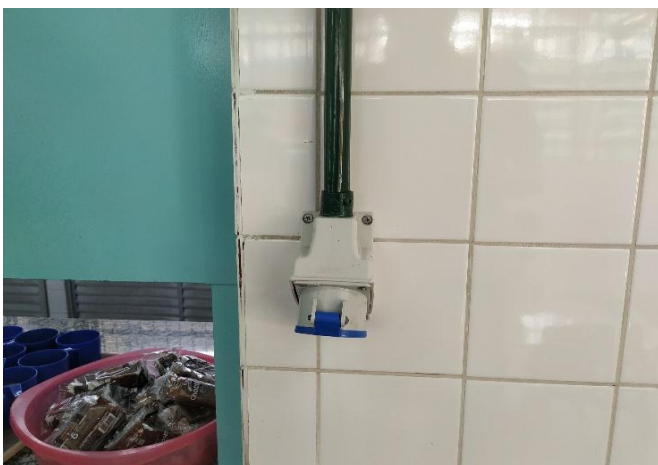
FOTO 59 Tomada industrial de sobrepor, refeitório.
