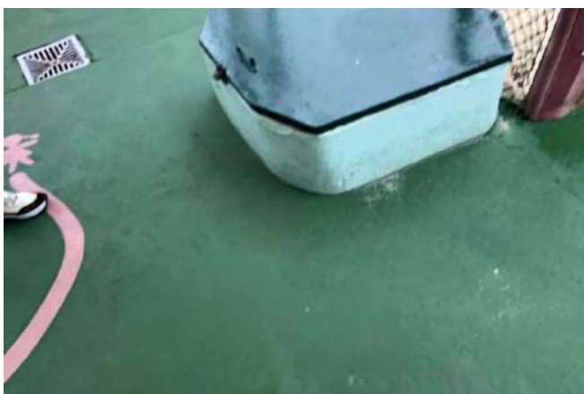
FOTO 9 CASA DE MÁQUINAS.
