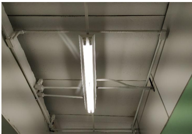
FOTO 23 Condulete do sistema de iluminação. Corredor salas de aula.
