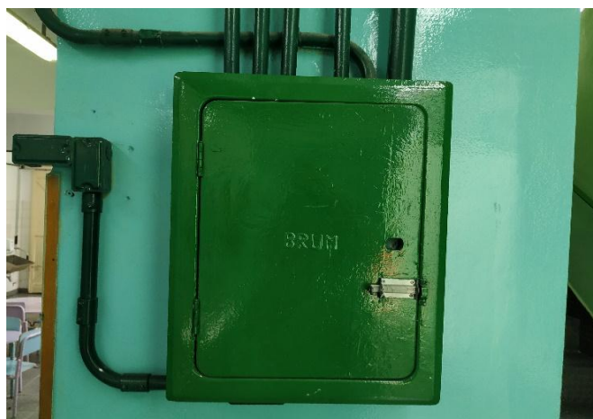
FOTO 10 Quadro de distribuição, piso inferior.
