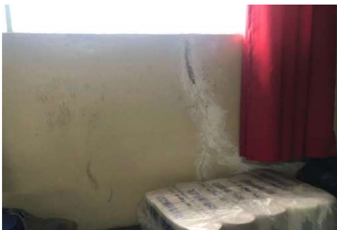
FOTO 23 SALA DE ASSISTENTE DE DIREÇÃO COM TRINCA E FISSURA SOBRE CAIXILHO.
