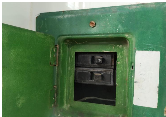
FOTO 14 Instalar novo quadro de distribuição na cozinha, com disjuntor geral, disjuntores de distribuição, barramento de neutro e terra.
