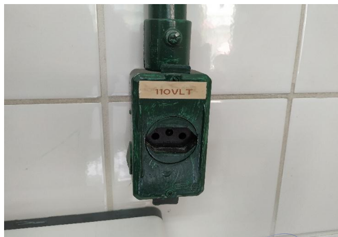
FOTO 60 Tomada padrão brasileiro, refeitório.
