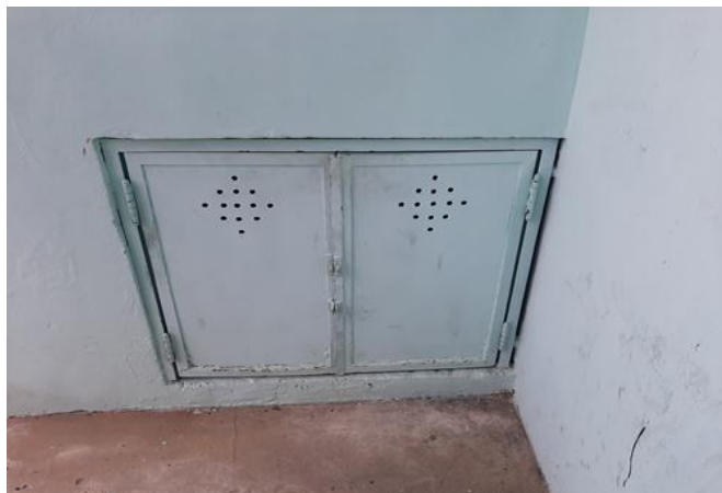
FOTO 31 Abrigo do cavalete
