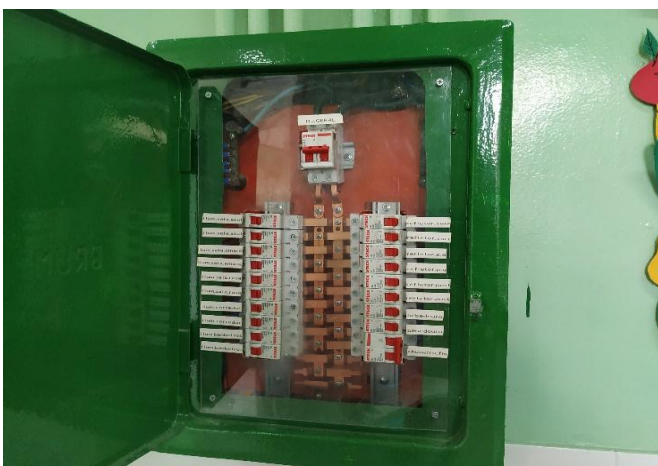
FOTO 9 Interior do QGBT. Cabos neutro e terra fora do padrão de cores.
