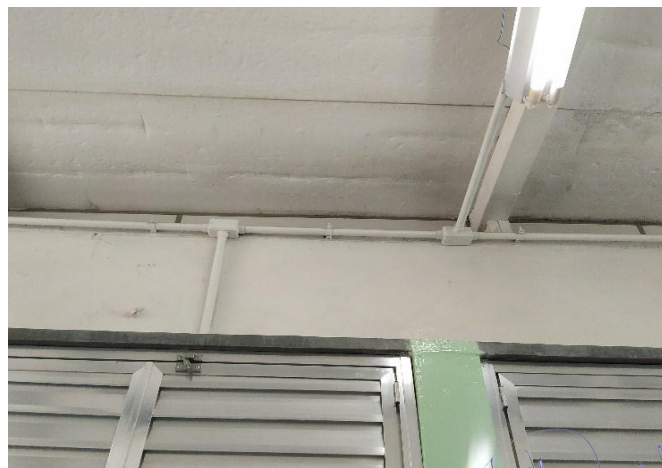
FOTO 18 Condulete do sistema de iluminação.
