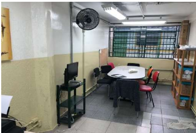
FOTO 59 SALA DE REUNIÃO, PISO CERÂMICO COM REMENDO.
