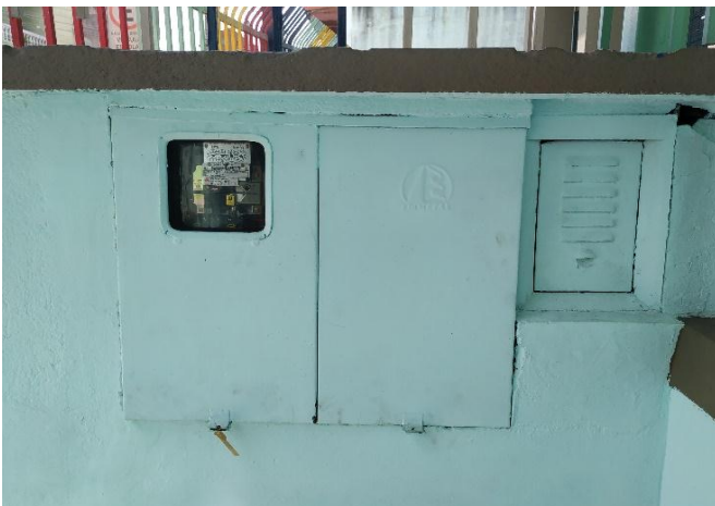
FOTO 3 Quadro de entrada de energia.
