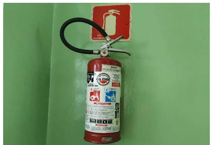
FOTO 6 Extintor pó químico, uma unidade.
