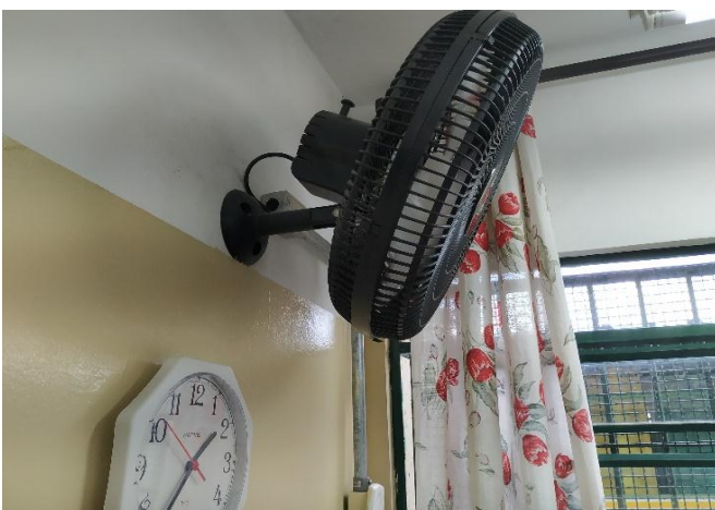
FOTO 75 Ventilador de parede, sala da direção.
