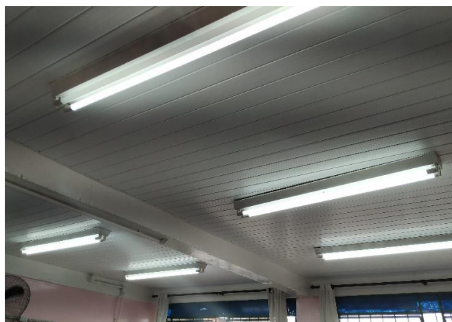
FOTO 22 Luminárias sobrepor com lâmpadas tubular de LED, sala de aula 1.
