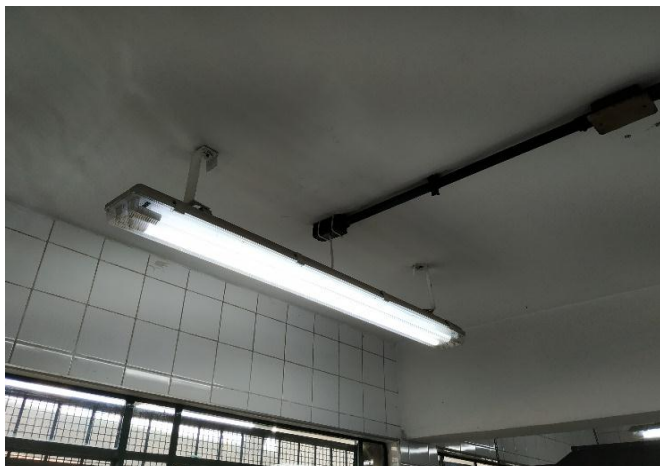
FOTO 31 Luminárias sobrepor com lâmpadas tubular de LED, cozinha.
