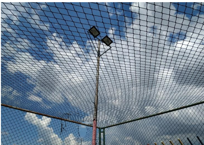
FOTO 47 Poste metálico, com refletor de LED, área externa, playground.
