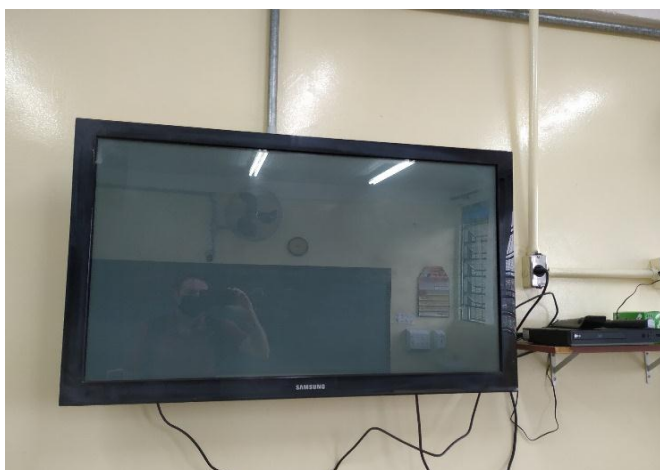
FOTO 81 Televisor instalado sala de aula 3.
