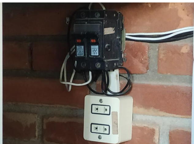
FOTO 15 Disjuntores expostos, na sala externa ao prédio. Está sala está interdida pela Defesa Civil.
