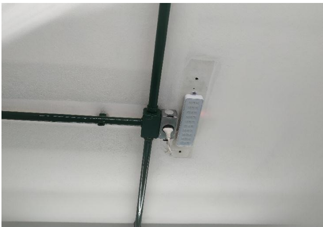
FOTO 13 Iluminação de emergência.
