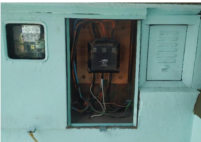
FOTO 5 Dispositivo de proteção. Conductor fase, neutro e terra.
