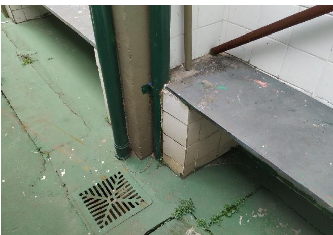
FOTO 5 Tubo de proteção. Falta caixa de inspeção.
