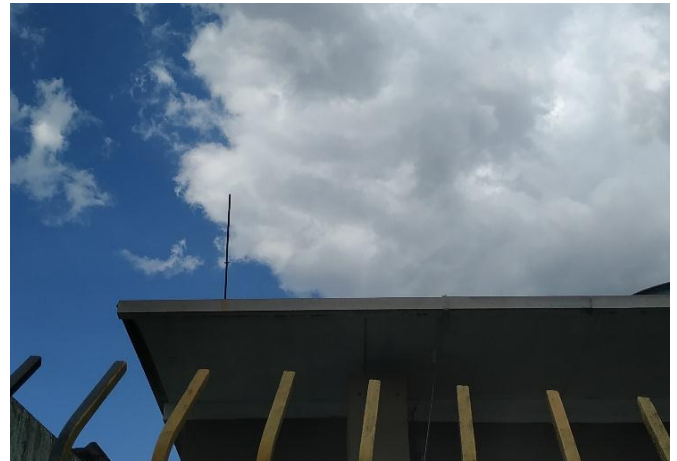
FOTO 2 Captor tipo Franklin, Sistema de Proteção contra Descarga Atmosférica. Falta luz de sinalização.
