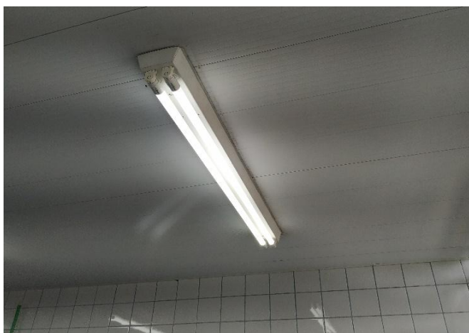
FOTO 21 Luminárias sobrepor com lâmpadas tubular de LED, banheiro infantil.
