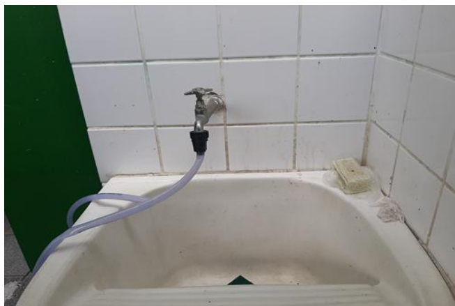
FOTO 43 Torneira de parede do tanque com mangueira acoplada
