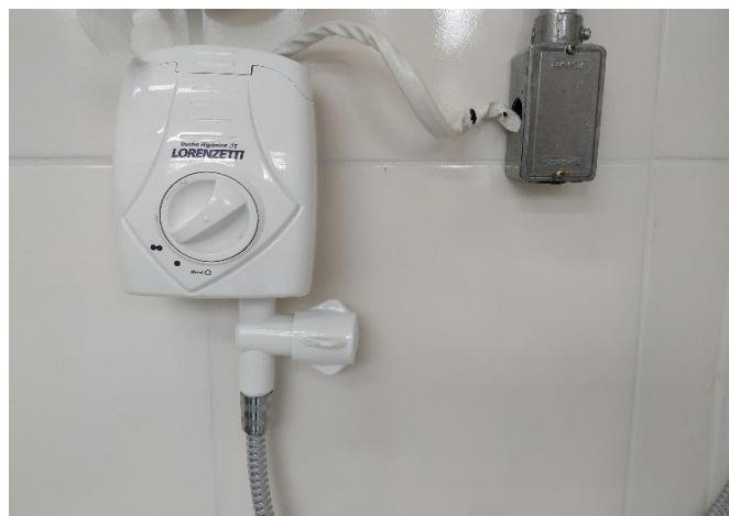
FOTO 16 Torneira elétrica, instalada no banheiro infantil. Verificar os cabos elétricos e instalar conector apropriado.
