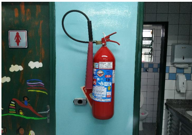
FOTO 7 Extintor CO2, uma unidade.
