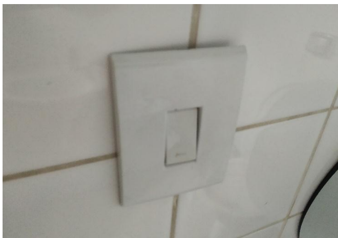
FOTO 41 Interruptores, banheiro dos funcionários.
