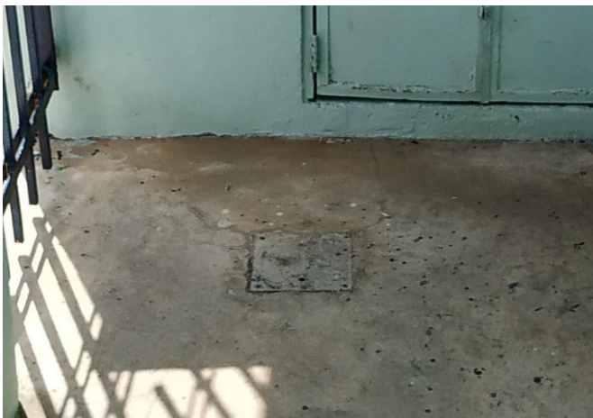
FOTO 7 Caixa de inspeção do aterramento.
