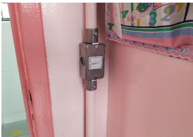
FOTO 33 Interruptor da sala de aula 1.
