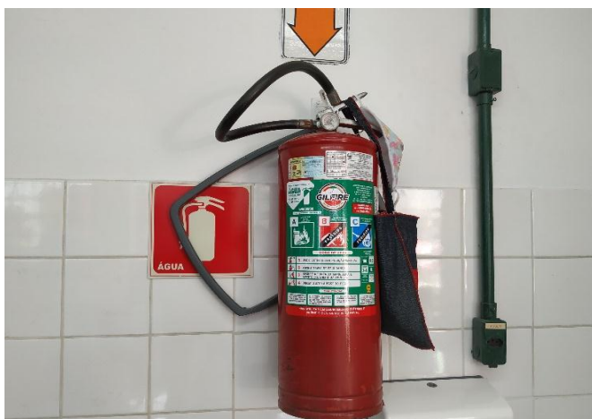
FOTO 9 Extintor de água.
