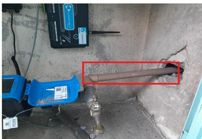
FOTO 33 Rede de alimentação do reservatório
