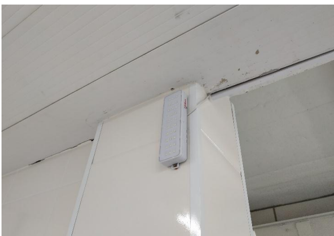
FOTO 11 Iluminação de emergência, corredor.
