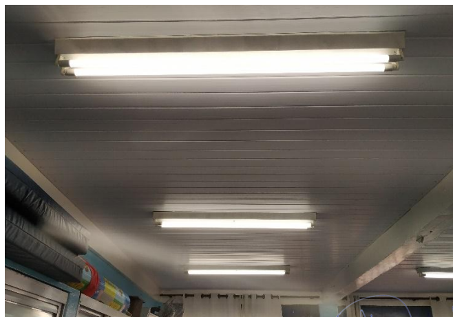
FOTO 24 Luminárias sobrepor com lâmpadas tubular de LED, sala de aula 2.
