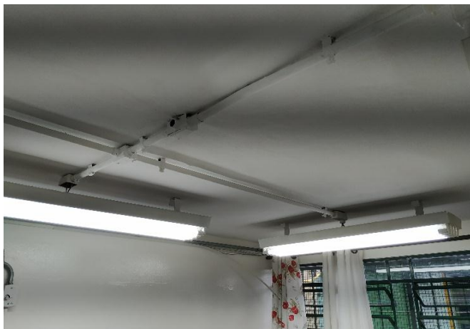
FOTO 19 Condulete do sistema de iluminação.
