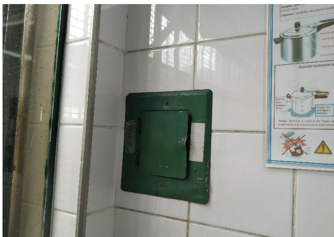
FOTO 13 Quadro de distribuição, cozinha.
