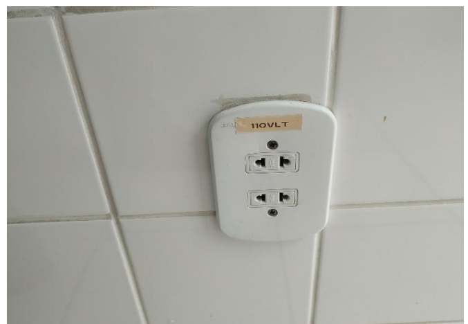
FOTO 52 Tomada padrão americano antigo, substituir por padrão brasileiro, refeitório dos professores.
