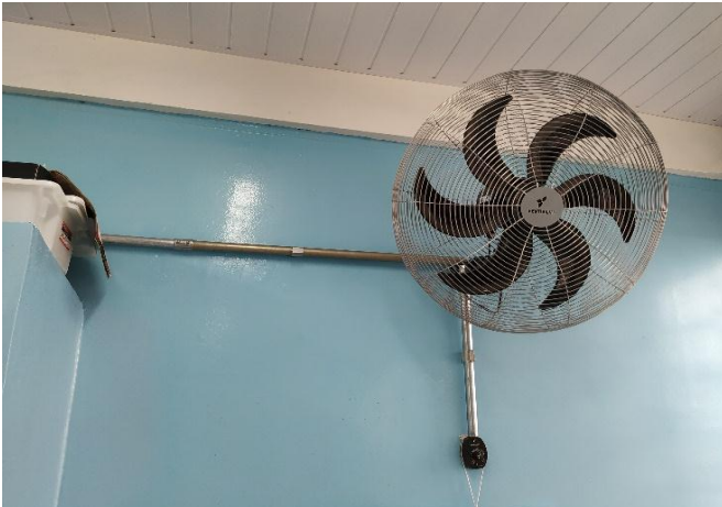
FOTO 73 Ventilador de parede, sala de aula 2.
