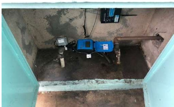
FOTO 71 CAVALETE DE ENTRADA DE ÁGUA.
