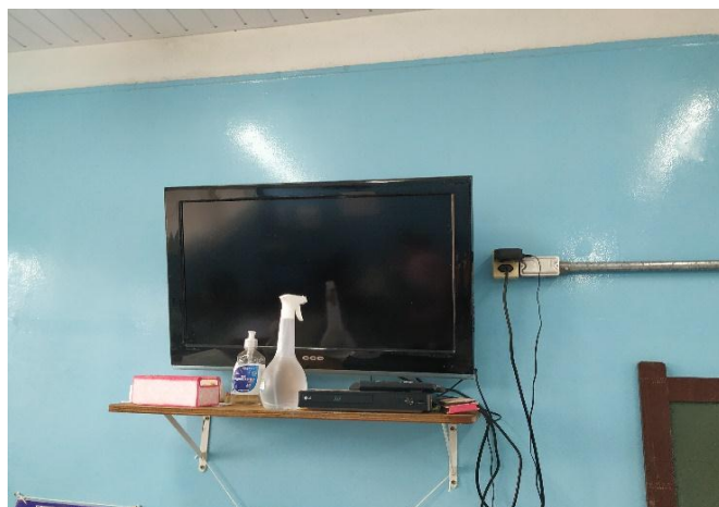
FOTO 80 Televisor instalado sala de aula 2.
