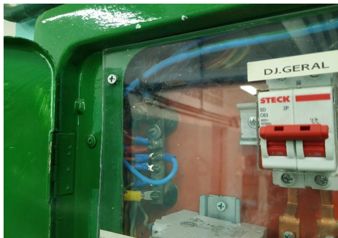
FOTO 12 Cabos elétricos fora do padrão de cores.
