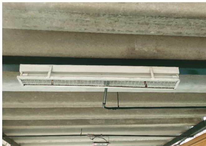
FOTO 44 Luminária sobrepor com lâmpada tubular de LED, pátio externo.
