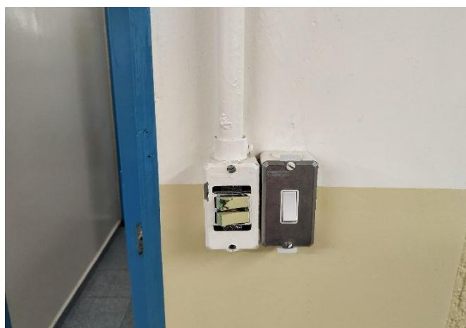
FOTO 36 Interruptor da sala dos professores.
