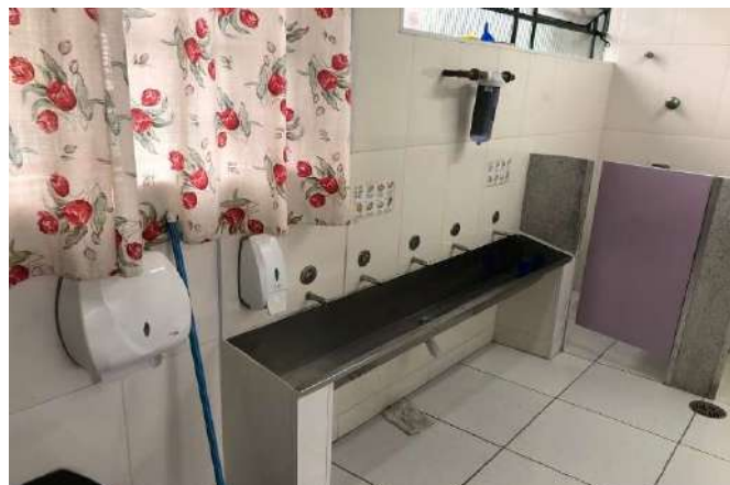
FOTO 88 BANHEIRO FEMININO DE ALUNOS, LAVATÓRIO.
