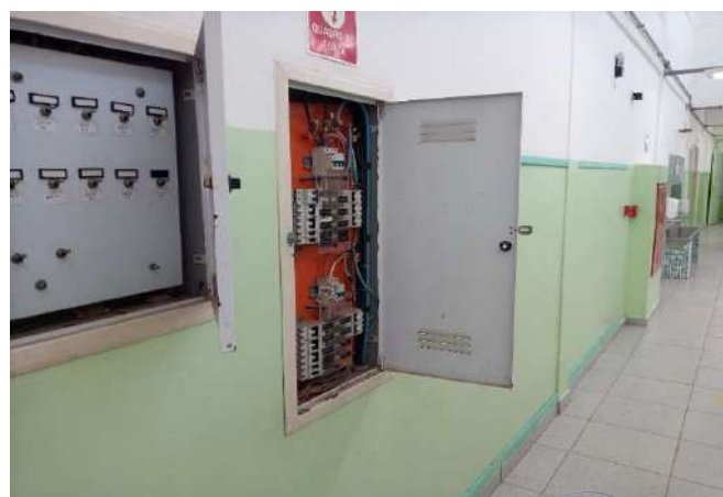
FOTO 54 Quadros de energia no corredor de entrada da Unidade Escolar - Em conformidade
