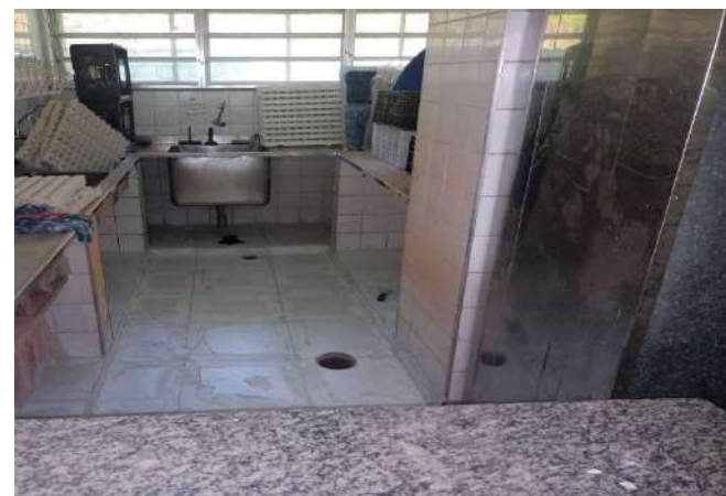
FOTO 12 Cozinha - Tapa do ralo faltante
