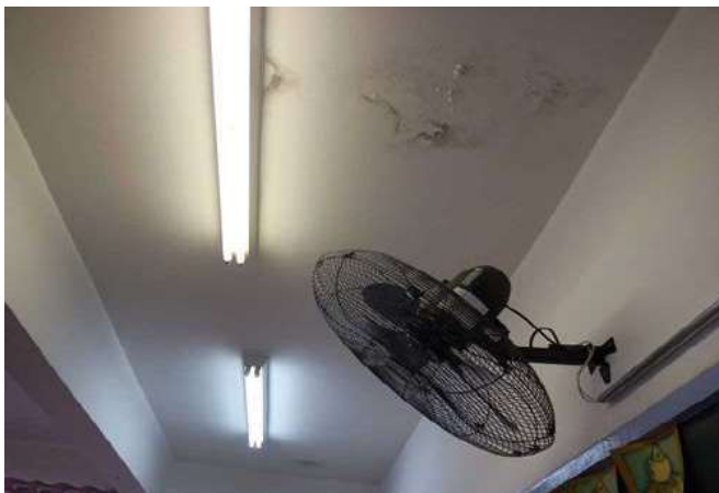
FOTO 31 Sala de Aula 02 - Infiltração / Bolor e enrugamento
