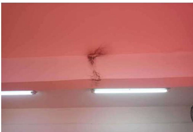
FOTO 27 Sala de Aula 01 - Mancha de infiltração / Bolor
