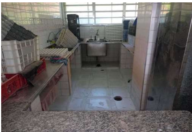
FOTO 11 Cozinha - Piso diferente do original
