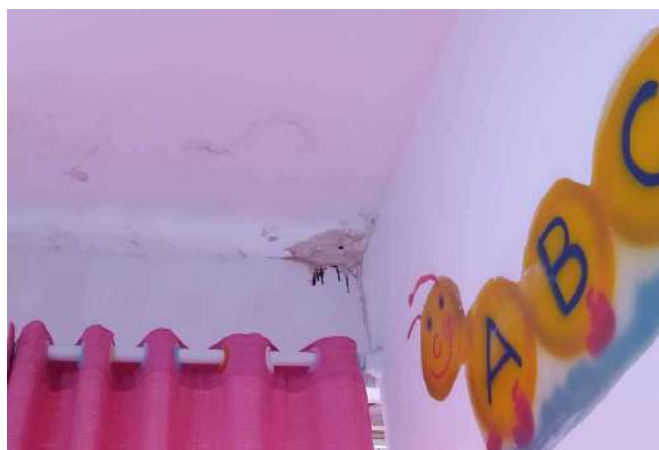
FOTO 28 Sala de Aula 01 - Mancha de infiltração / Bolor
