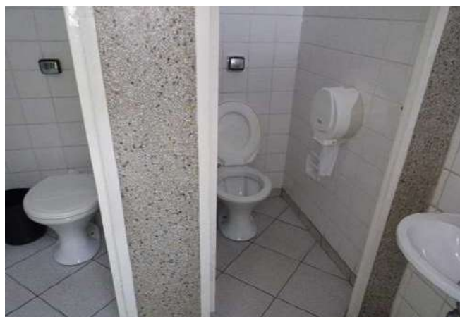
FOTO 46 Sanitario para Funcionarios Masculino - Visão parcial
