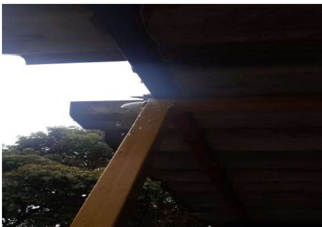
FOTO 5 TELHADO IRREGULAR - ENTRADA DA ESCOLA
