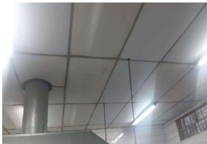
FOTO 6 UMIDADE NO FORRO DA COZINHA
