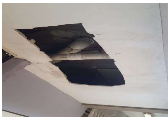
FOTO 30 CERCA DE 2 METROS DE FORRO DE GESSO DANIFICADO - SAÍDA DA COZINHA
