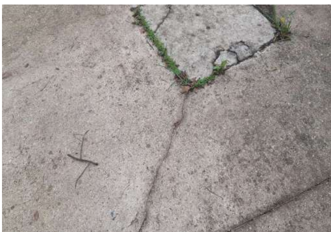
FOTO 3 TRINCA NO PISO DE ACESSO AO RESERVATÓRIO D'ÁGUA
