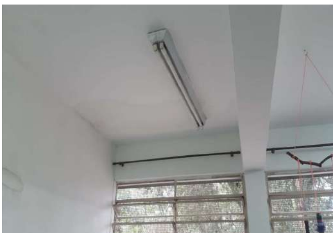
FOTO 9 UMIDADE NA SALA DE AULA 6
