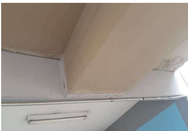
FOTO 29 TRINCA NO VIGAMENTO - RAMPA DE ACESSO A SALA DE AULA
