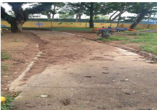
FOTO 33 SISTEMA DE COLETA D'ÁGUA PLUVIAIS COM VAZÃO INSUFICIENTE
