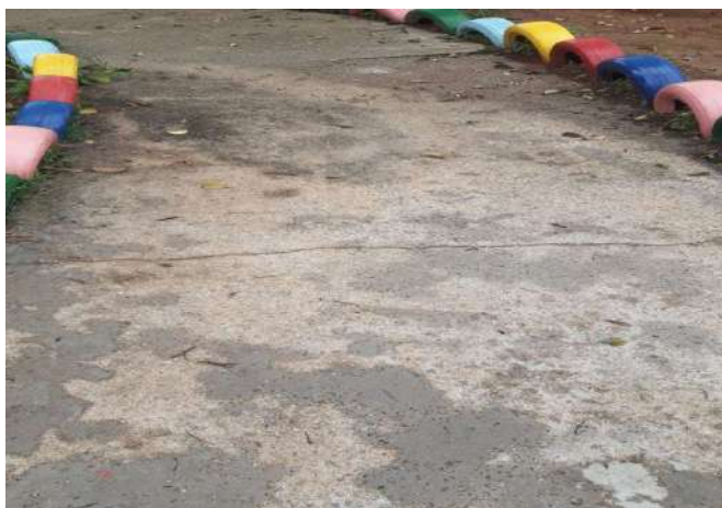
FOTO 17 PISO DE ACESSO AO PLAY GROUND TRINCADO
