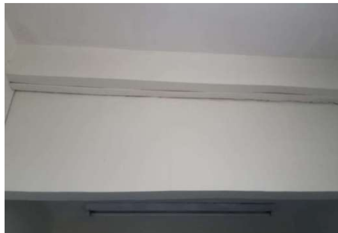
FOTO 8 TRINCA E UMIDADE NO CORREDOR DE ACESSO AS SALAS DE AULA
