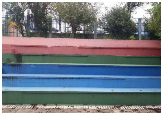
FOTO 16 TRINCA - ARQUIBANCADA NA ENTRADA DA ESCOLA
