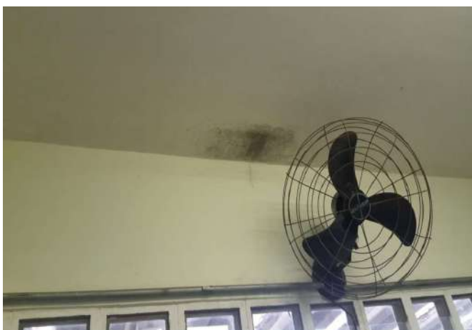
FOTO 21 MANCHA DE INFILTRAÇÃO E TRINCA NO REFEITÓRIO
