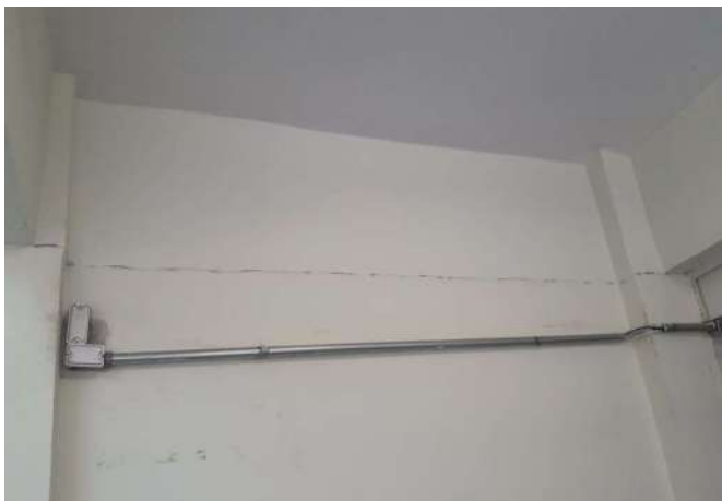
FOTO 7 TRINCA NA PAREDE DE ACESSO AO ELEVADOR
