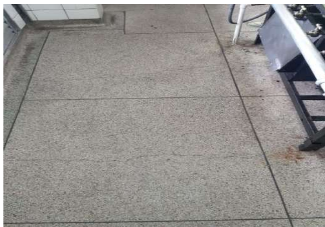
FOTO 18 PISO DA COZINHA TRINCADO
