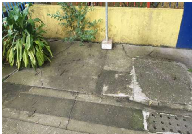
FOTO 14 TRINCA E UMIDADE NO PISO DO CORREDOR DE ACESSO À COZINHA
