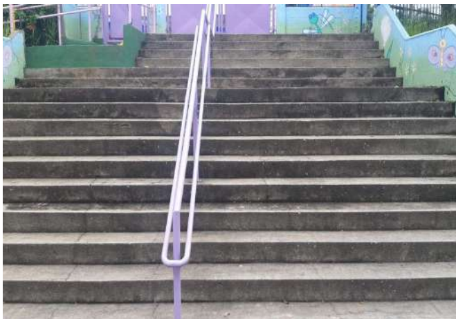
FOTO 13 TRINCA NA ESCADA DE ENTRADA À ESCOLA
