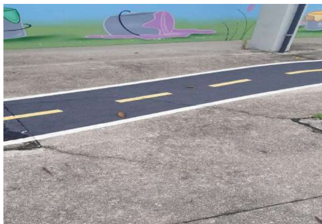
FOTO 32 TRINCA NO PISO - PLAYGROUND
