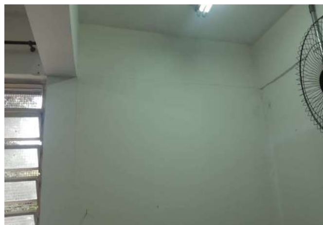
FOTO 28 SALA DE AULA 5 - TRINCA NA PAREDE
