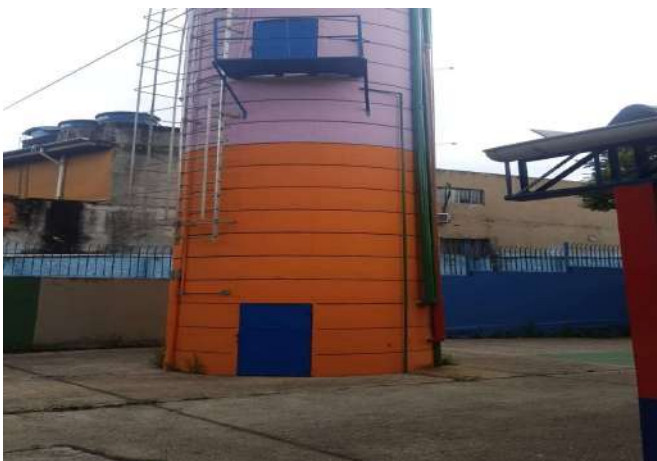
FOTO 31 PROBLEMA NA BOMBA D'ÁGUA - RESERVATÓRIO
