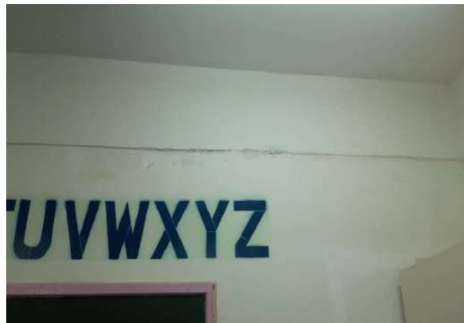
FOTO 26 SALA DE AULA 1 - TRINCA ENTRE PAREDE E VIGAMENTO
