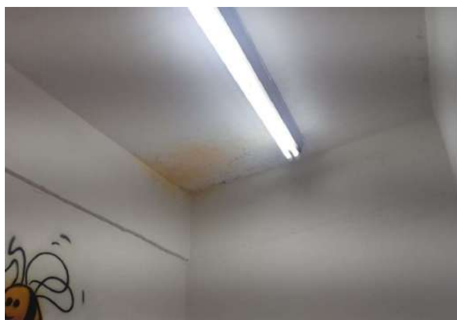
FOTO 6 UMIDADE NA SALA DE AULA 4
