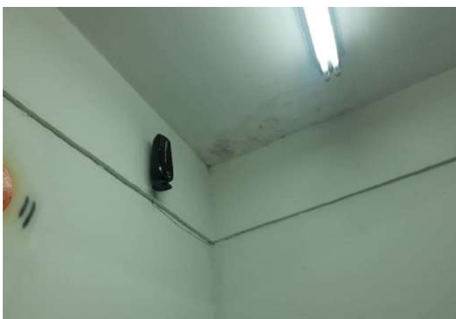
FOTO 5 INFILTRAÇÃO NA SALA DE AULA 8
