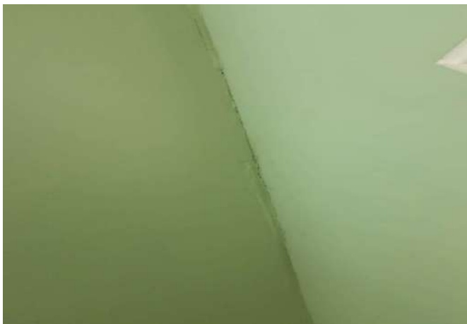
FOTO 19 TRINCA NA PAREDE DA ESCADA
