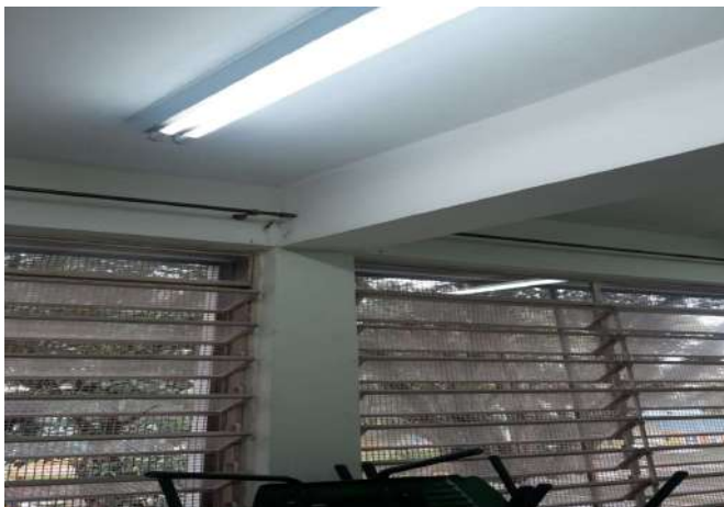
FOTO 25 SALA DE AULA 7 - UMIDADE E INFILTRAÇÃO
