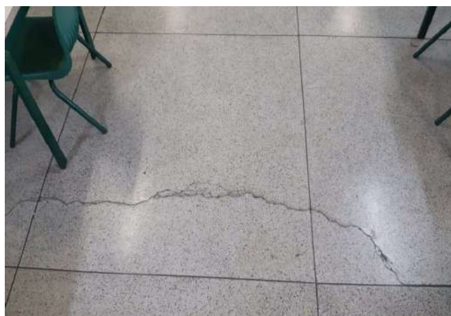
FOTO 4 TRINCA NO PISO DOS REFEITÓRIO
