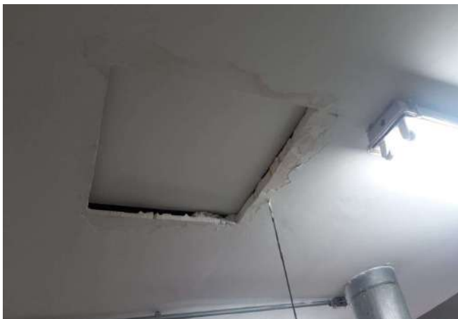
FOTO 1 INFILTRAÇÃO NO FORRO DA COZINHA
