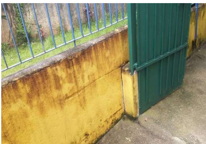
FOTO 11 DESLOCAMENTO DE MURO DA RUA DE ACESSO A ESCOLA
