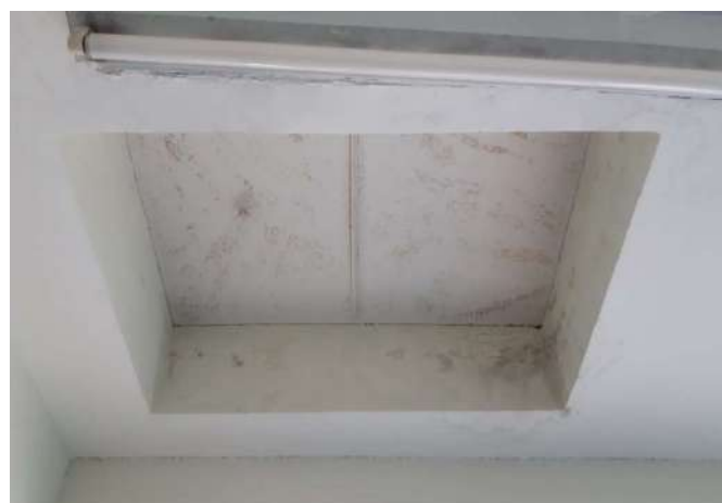
FOTO 12 TRINCA E UMIDADE NO TETO DO CORREDOR DE ACESSO À SALA DE AULA
