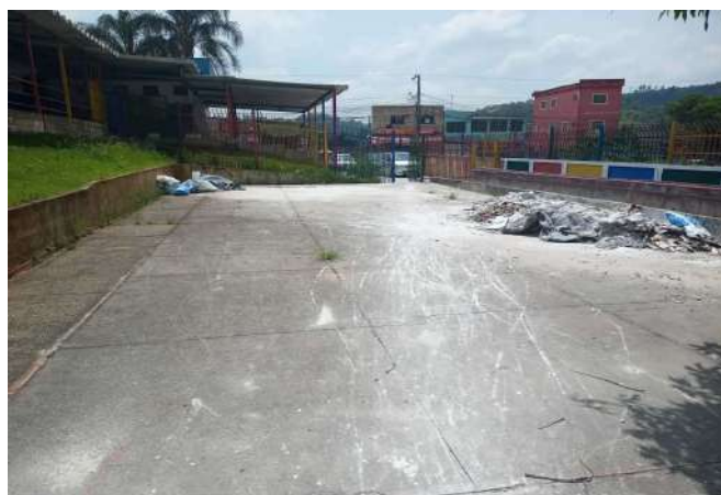
FOTO 18 Pátio Descoberto - Deficiência nas juntas de dilatação
