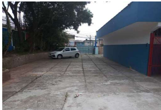
FOTO 32 Estacionamento - Visão geral/ Deficiência nas juntas de dilatação
