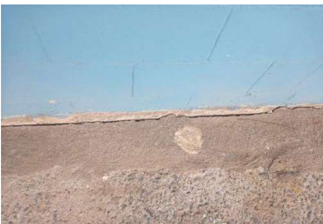
FOTO 71 Paredes externas da unidade (Estacionamento) - Recalque do piso
