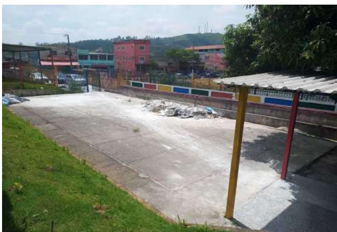
FOTO 17 Pátio Descoberto - Trincas de deficiência nas juntas de dilatação
