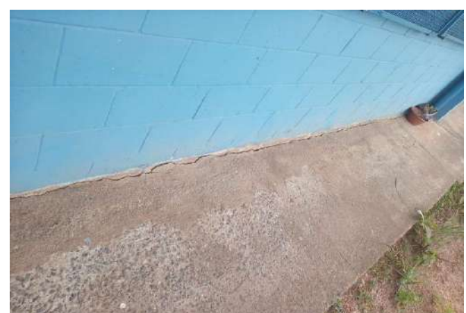
FOTO 72 Paredes externas da unidade (Estacionamento) - Recalque do piso
