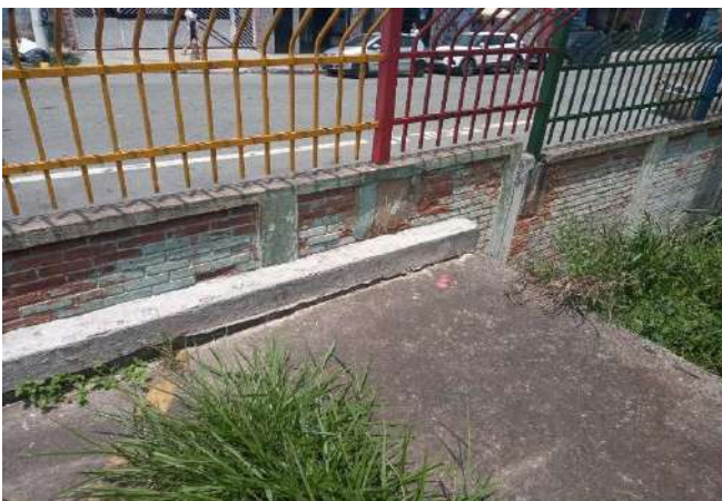
FOTO 69 Muro de fecho - Área do estacionamento, risco queda
