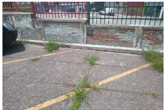
FOTO 70 Muro de fecho - Área do estacionamento, risco queda
