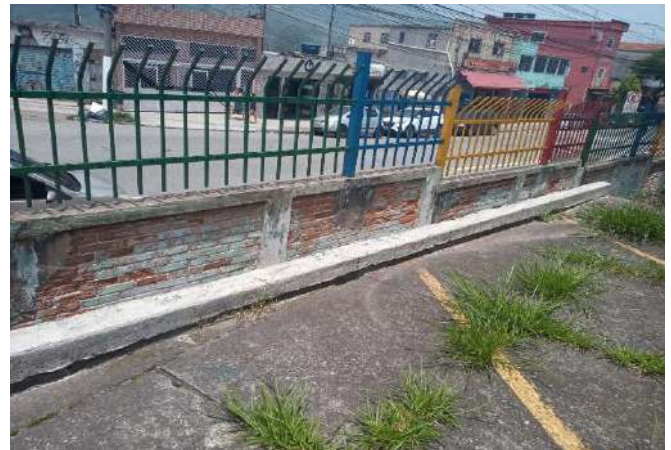
FOTO 68 Muro de fecho (estacionamento) - Piso recalçando, com risco de derrumar o muro
