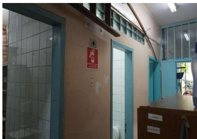
FOTO 57 CORREDOR INTERNO AUSÊNCIA DE EXTINTOR
