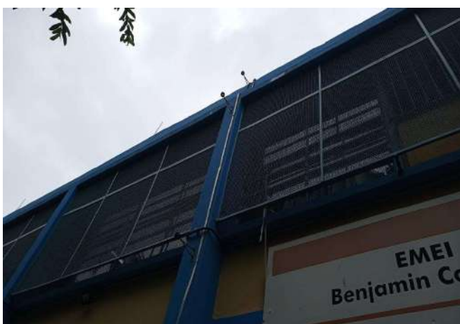
FOTO 6 FACHADA COM SPDA PARCIAL
