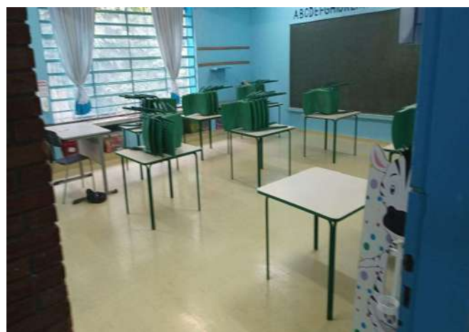
FOTO 105 SALA DE AULA 04 IMPROVISO NA REDE ELÉTRICA DE ILUMINAÇÃO E VENTILAÇÃO
