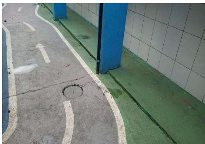
FOTO 4 PÁTIO EXTERNO SEM JUNTA DE DILATAÇÃO
