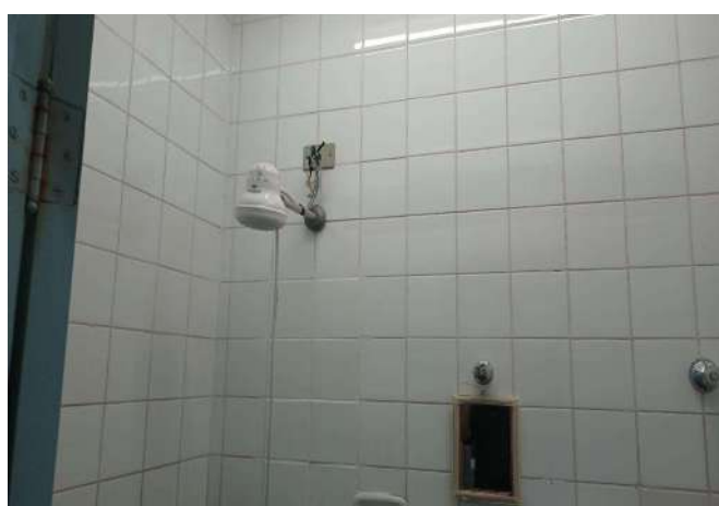
FOTO 46 BANHEIRO MASCULINO FUNCIONÁRIOS REVESTIMENTO DANIFICADOS
