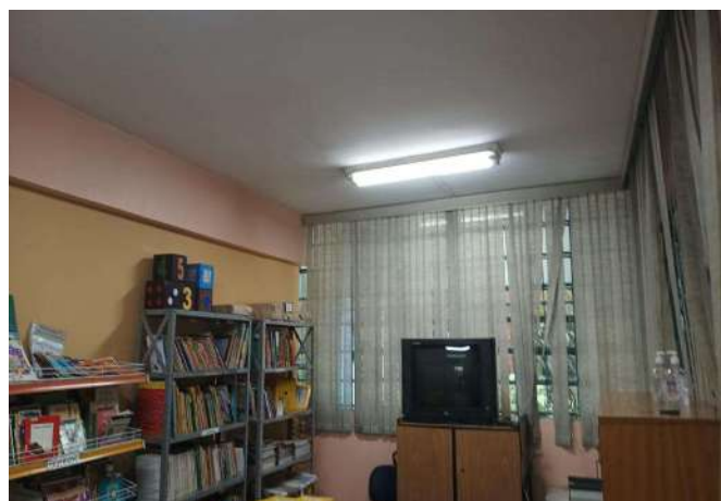
FOTO 86 BIBLIOTECA APARELHO DE ILUMINAÇÃO DEFICIENTE
