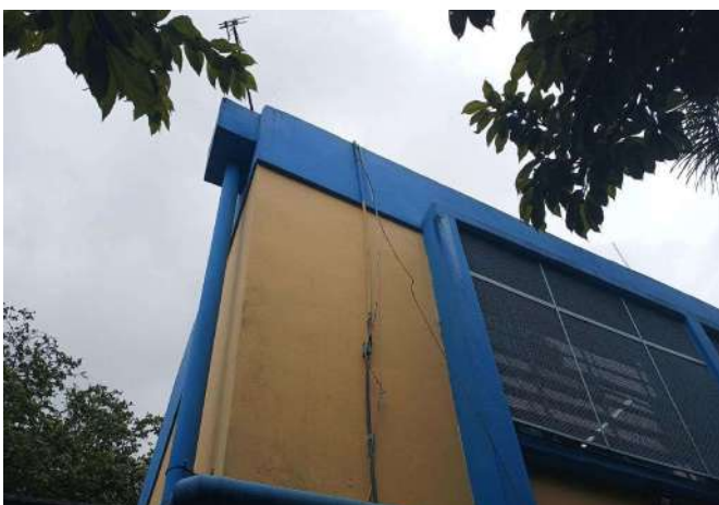
FOTO 17 FACHADA IMPROVISO NA FIAÇÃO
