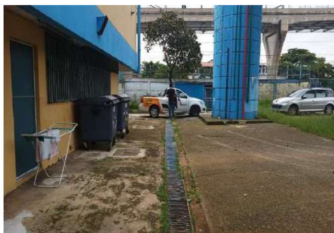
FOTO 36 ÁREA EXTERNA PISO CIMENTADO EM MAU ESTADO
