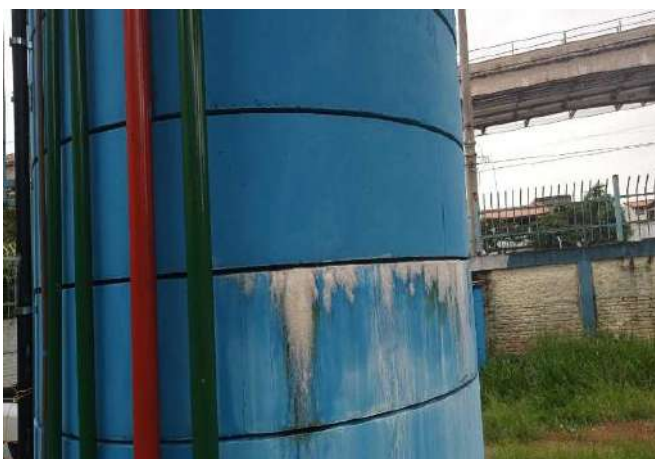
FOTO 33 RESERVATÓRIO ELEVADO COM VAZAMENTO
