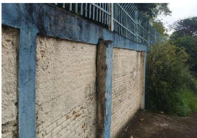
FOTO 29 ESTACIONAMENTO MURO DE DIVISA EM DESAPRUMO
