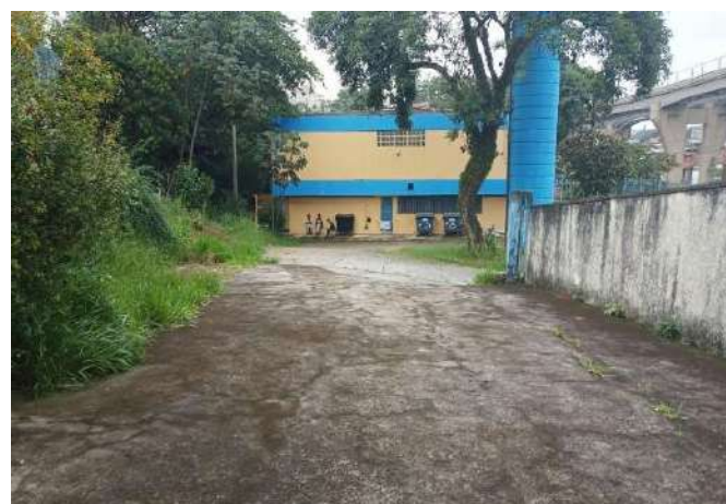
FOTO 30 ESTACIONAMENTO COM FISSURAS NO PISO
