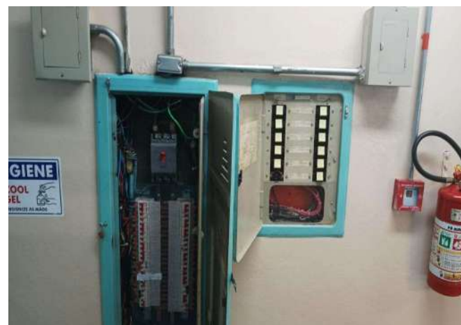
FOTO 72 QUADRO DE ENERGIA
