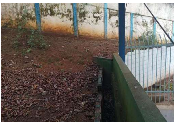
FOTO 15 MURO DE DIVISA COM FISSURAS E TRINCAS
