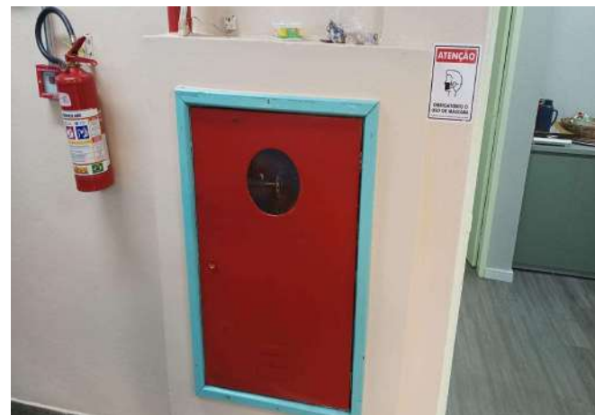
FOTO 76 HIDRANTE EM MAU ESTADO DE CONSERVAÇÃO E SEM SINALIZAÇÃO
