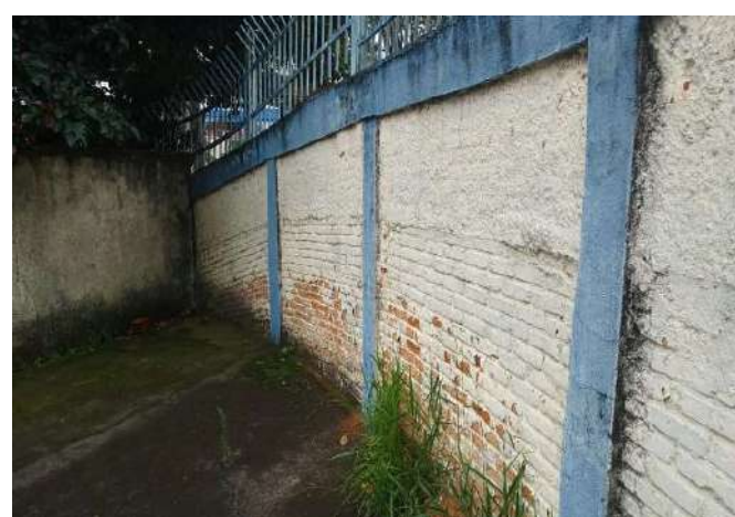
FOTO 28 ESTACIONAMENTO MURO DE DIVISA DANIFICADO
