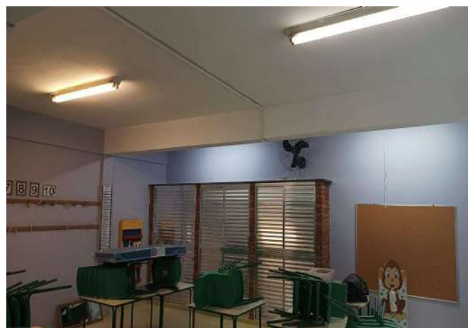
FOTO 104 SALA DE AULA 03 IMPROVISO NA REDE ELÉTRICA DE ILUMINAÇÃO E VENTILAÇÃO
