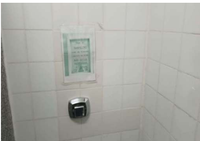
FOTO 53 BANHEIRO FEMININO ADMINISTRATIVO REVESTIMENTO DANIFICADOS
