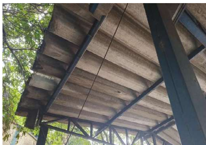
FOTO 16 PÁTIO EXTERNO COBERTURA DANIFICADA
