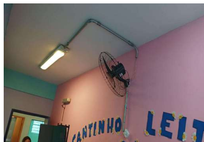
FOTO 90 IMPROVISO NA REDE ELÉTRICA DE ILUMINAÇÃO E VENTILAÇÃO
