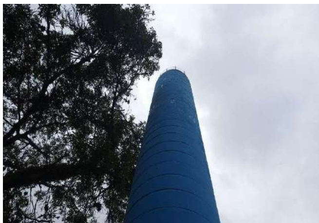
FOTO 35 RESERVATÓRIO COM AUSÊNCIA DE SPDA
