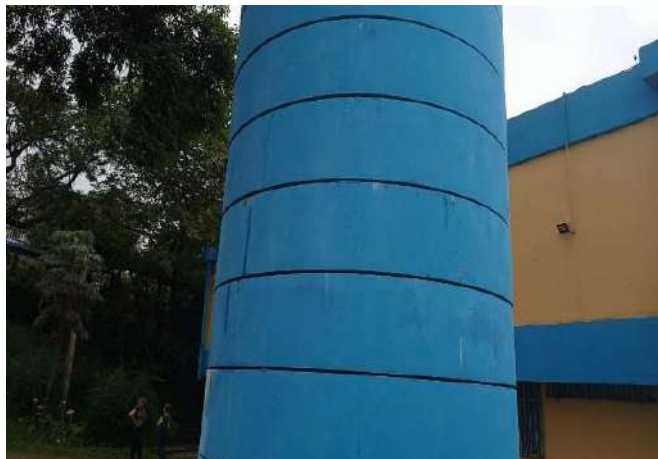
FOTO 34 RESERVATÓRIO ELEVADO COM VAZAMENTO
