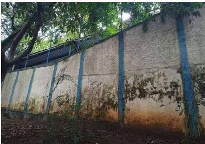
FOTO 13 MURO DE DIVISA COM FISSURAS E TRINCAS
