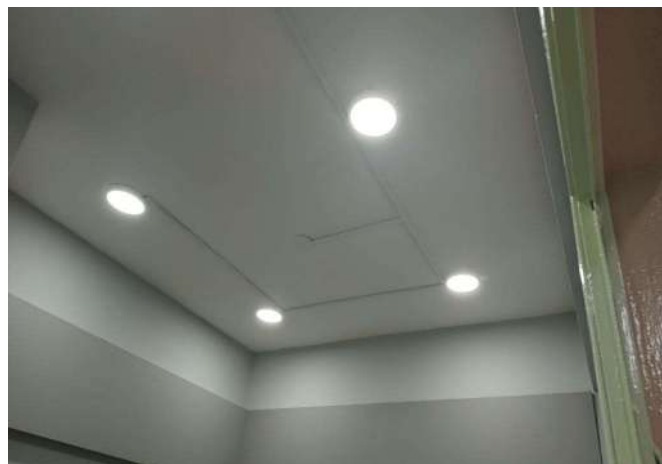
FOTO 68 SALA DA DIREÇÃO(EM MANUTENÇÃO) IMPROVISADO NA REDE DE ILUMINAÇÃO
