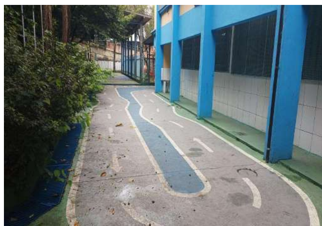
FOTO 5 PÁTIO EXTERNO SEM JUNTA DE DILATAÇÃO NO PISO
