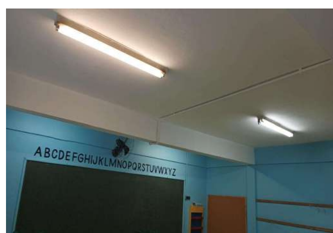
FOTO 106 SALA DE AULA 04 APARELHO DE ILUMINAÇÃO DEFICIENTE
