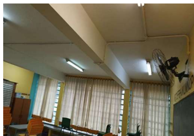
FOTO 112 SALA DE AULA 06 IMPROVISO NA REDE ELÉTRICA DE ILUMINAÇÃO E VENTILAÇÃO
