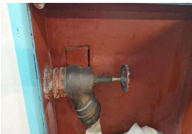
FOTO 75 HIDRANTE EM MAU ESTADO DE CONSERVAÇÃO E COM AUSÊNCIA DE COMPONENTES
