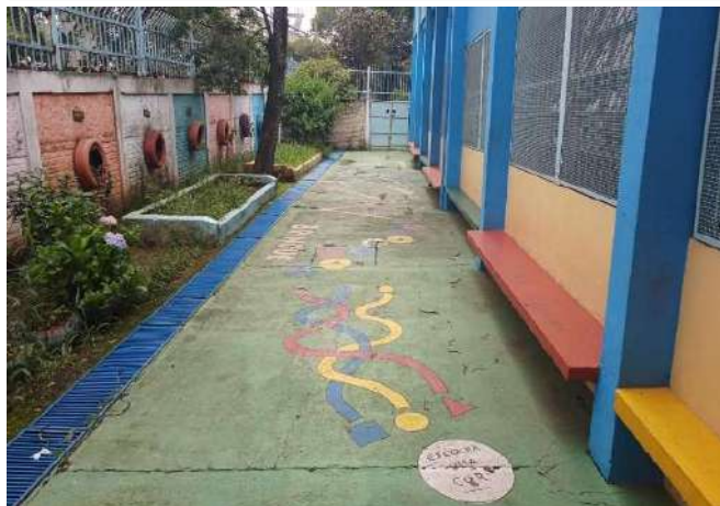
FOTO 19 PÁTIO EXTERNO COM FISSURAS NO PISO
