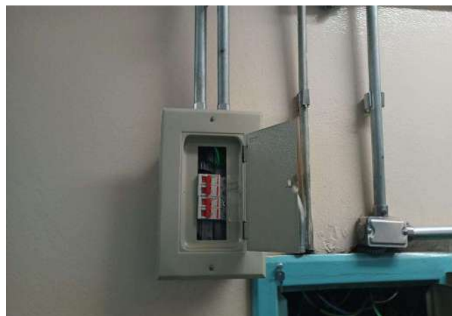
FOTO 74 QUADRO DE ENERGIA
