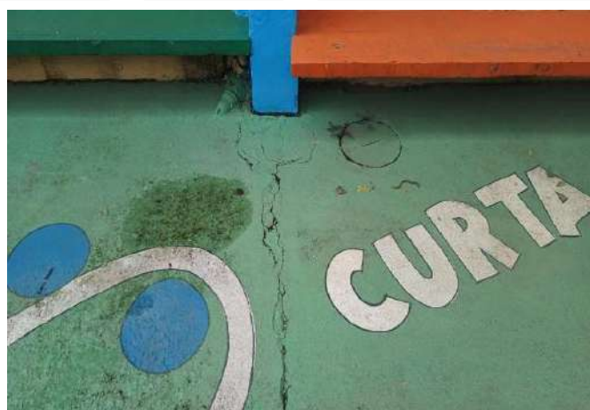
FOTO 20 PÁTIO EXTERNO SEM JUNTA DE DILATAÇÃO
