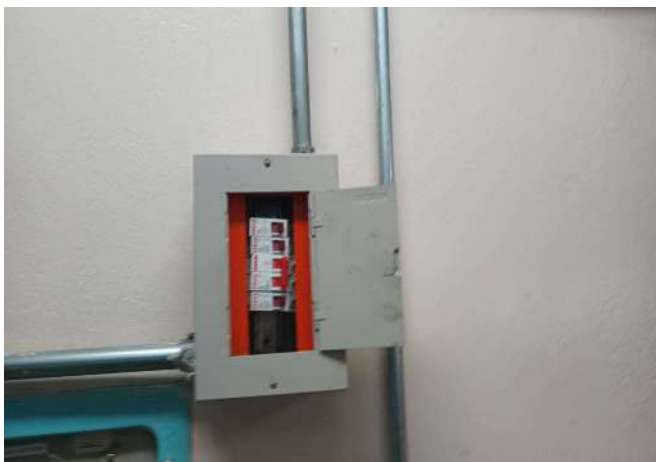
FOTO 73 QUADRO DE ENERGIA
