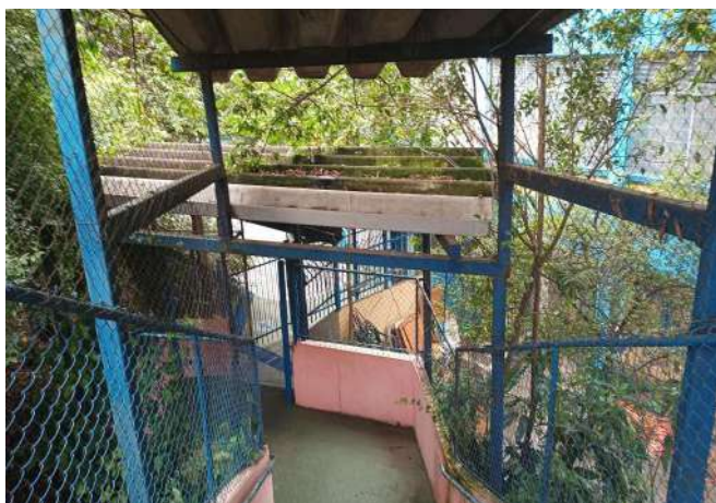
FOTO 3 ACESSO A SECRETARIA AUSÊNCIA DE CORRIMÃO EM ALGUNS TRECHOS
