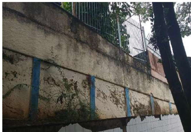
FOTO 14 MURO DE DIVISA COM FISSURAS E TRINCAS
