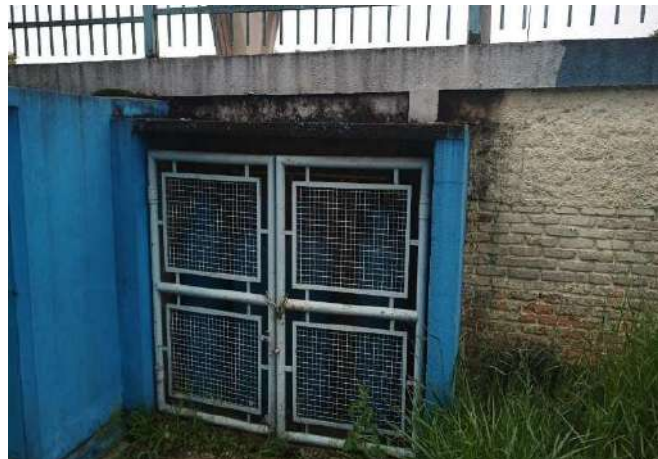
FOTO 32 ABRIGO DE GÁS SEM SINALIZAÇÃO E COM AUSÊNCIA DE EXTINTOR
