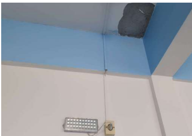
FOTO 207 SALA DE AULA 3 COM IMPROVISOS NA ELÉTRICA
