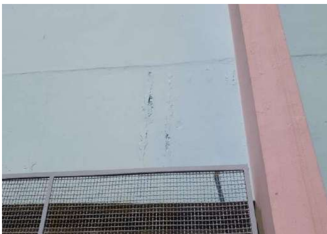
FOTO 47 FACHADA COM ARMADURA EXPOSTA
