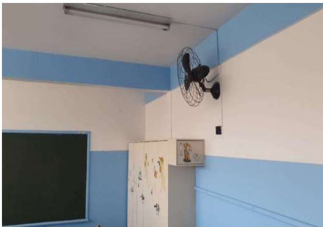
FOTO 139 SALA DE AULA 6 COM IMPROVISOS NA ELÉTRICA
