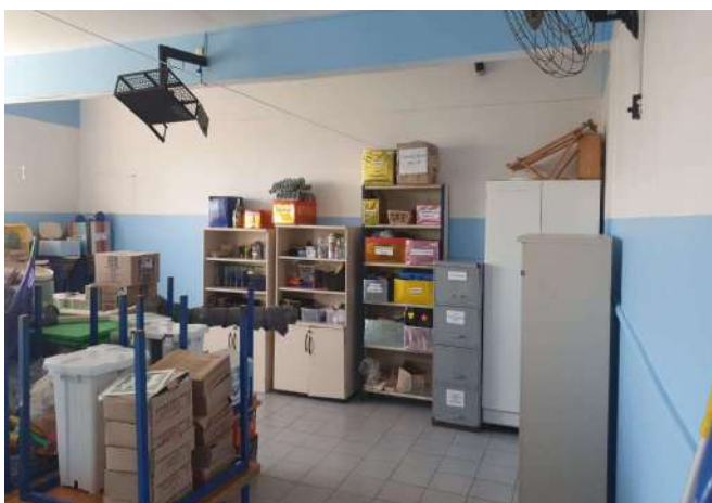
FOTO 159 SALA DE AULA 8 COM IMPROVISOS NA ELÉTRICA
