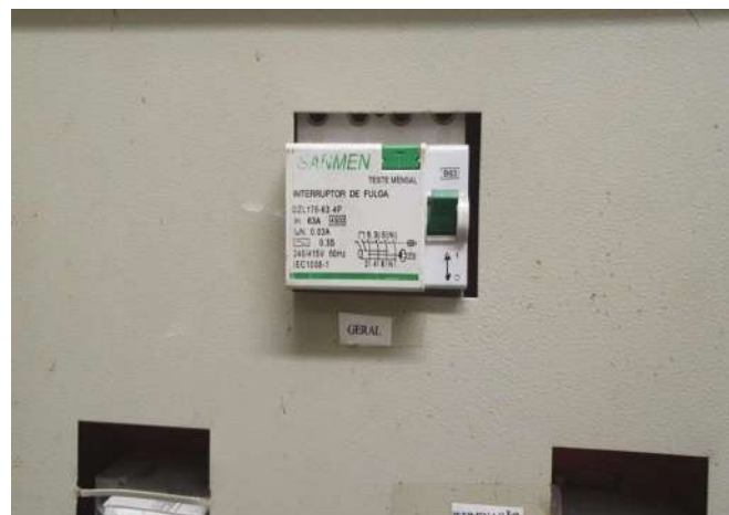
FOTO 188 QUADRO DE DISTRUBUIÇÃO DE LUZ
