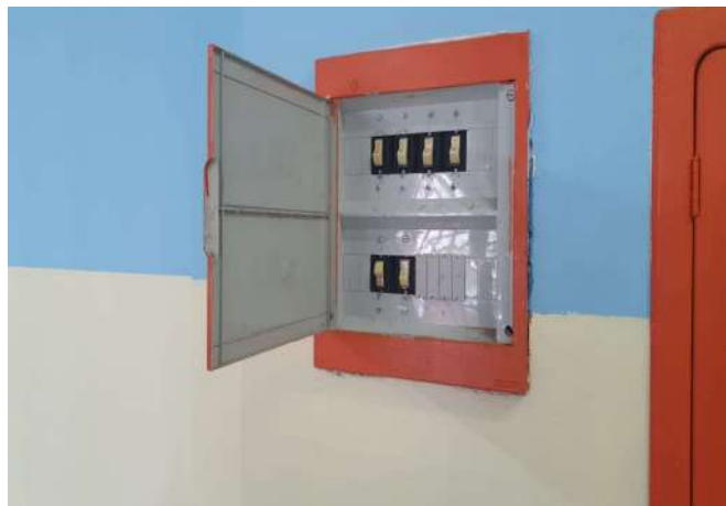
FOTO 68 QUADRO DE LUZ
