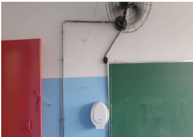
FOTO 169 SALA DE AULA 8 COM IMPROVISOS NA ELÉTRICA
