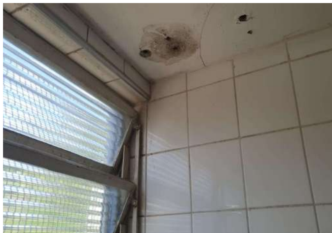
FOTO 31 FORRO BANHEIRO DE ALUNOS UNISSEX
