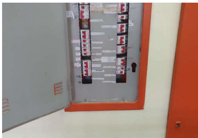
FOTO 70 QUADRO DE LUZ
