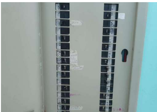
FOTO 105 QUADRO DE DISTRIBUIÇÃO DE LUZ
