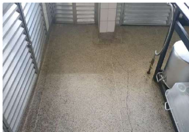
FOTO 64 FISSURA NO PISO DA COZINHA
