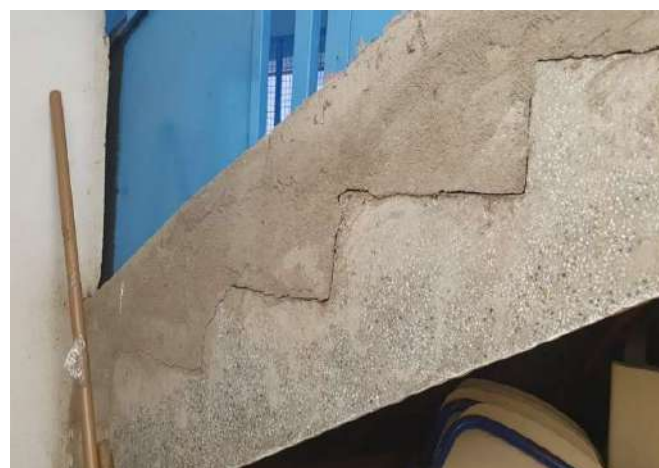
FOTO 192 FISSURA NA LAJE DO DEPÓSITO
