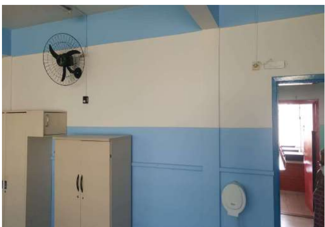
FOTO 101 SALA DE AULA 2 COM IMPROVISOS NA ELÉTRICA
