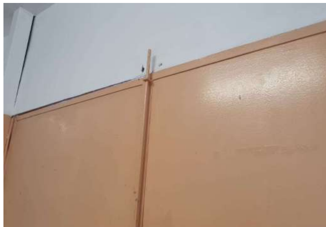
FOTO 176 ESQUADRIA DANIFICADA SEM TRINCO
