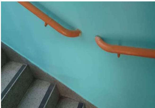
FOTO 67 FALTA DE CONTINUIDADE DOS CORRIMÃOS
