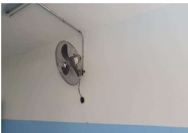
FOTO 99 SALA DE AULA 2 COM IMPROVISOS NA ELÉTRICA
