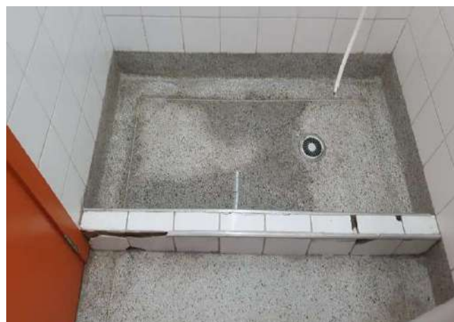
FOTO 160 BANHEIRO FEMININO DE FUNCIONÁRIOS COM REVESTIMENTO DANIFICADO OU AUSENTE
