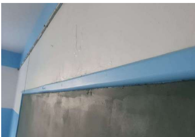
FOTO 113 SALA DE AULA 4 PINTURA DANIFICADA
