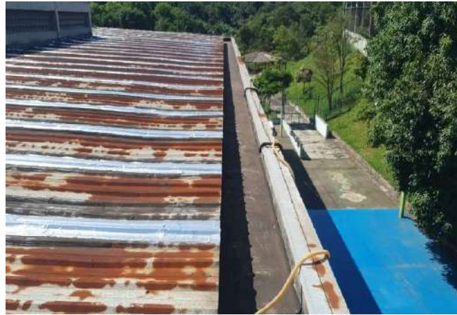
FOTO 218 TELHA TRAPEZOIDAL OXIDADA
