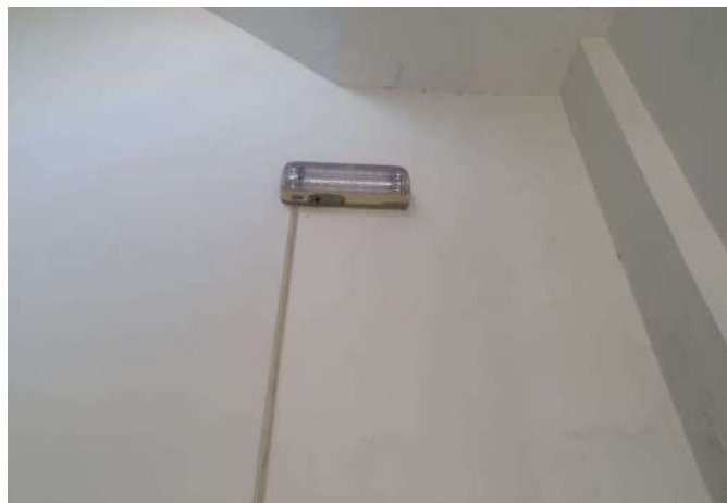
FOTO 230 CASA DE MÁQUINA DO ELEVADOR
