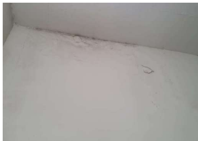
FOTO 226 CASA DE MÁQUINA DO ELEVADOR
