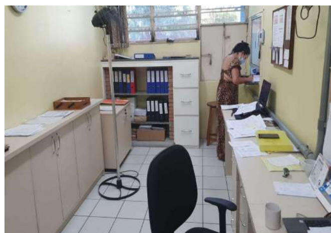
FOTO 100 SALA DE AULA 2 COM IMPROVISOS NA ELÉTRICA
