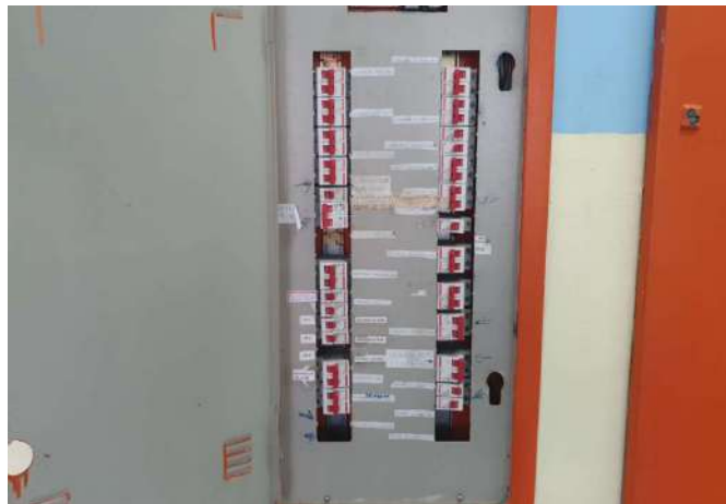
FOTO 74 QUADRO DE DISTRIBUIÇÃO DE LUZ
