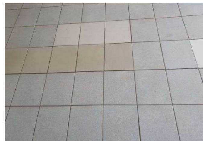
FOTO 214 PISO DANIFICADO SALA DE AULA 3
