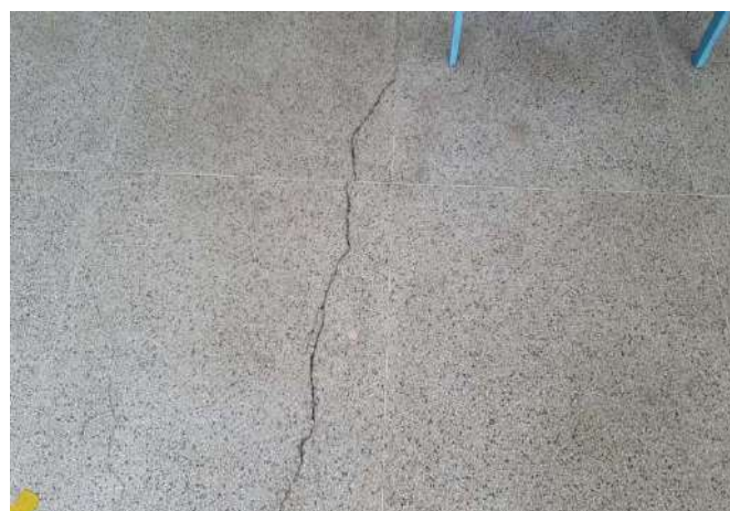
FOTO 36 FISSURA PISO PÁTIO COBERTO
