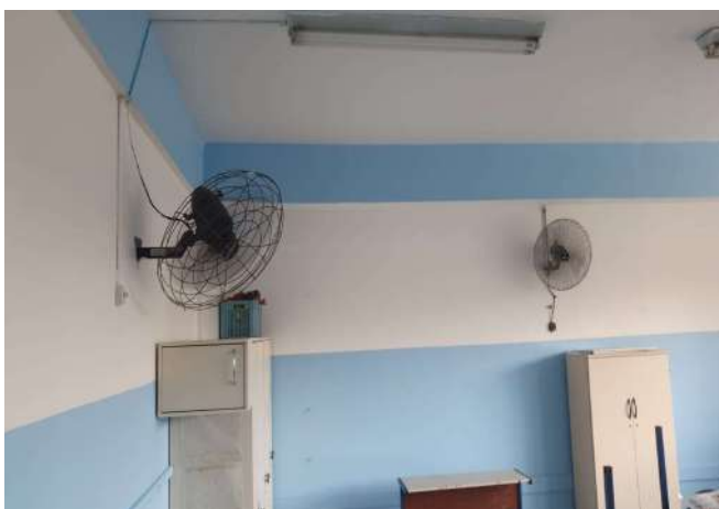
FOTO 123 SALA DE AULA 5 COM IMPROVISOS NA ELÉTRICA
