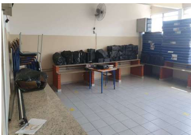
FOTO 147 SALA DE AULA 7 COM IMPROVISOS NA ELÉTRICA
