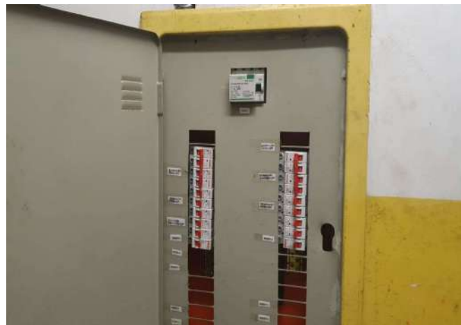
FOTO 186 QUADRO DE DISTRUBUIÇÃO DE LUZ
