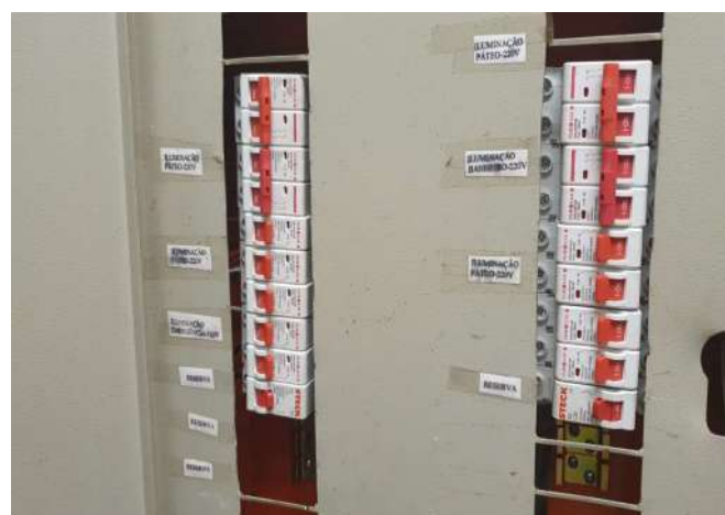
FOTO 190 QUADRO DE DISTRUBUIÇÃO DE LUZ
