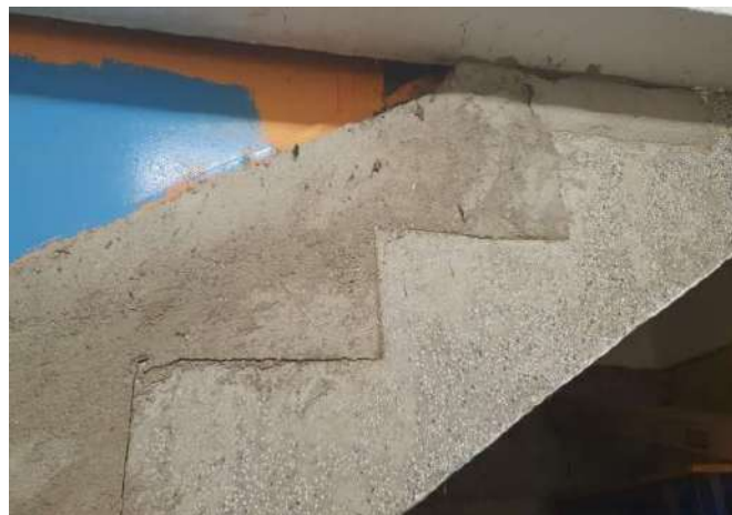
FOTO 194 FISSURA NA LAJE DO DEPÓSITO
