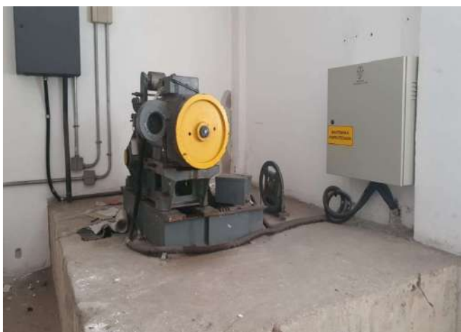
FOTO 225 CASA DE MÁQUINA DO ELEVADOR
