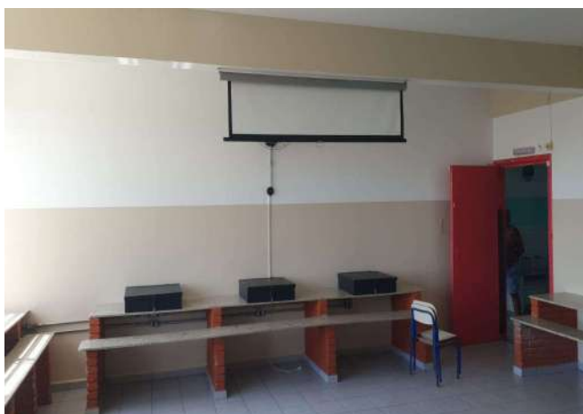
FOTO 153 SALA DE AULA 7 COM IMPROVISOS NA ELÉTRICA
