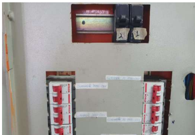
FOTO 72 QUADRO DE LUZ
