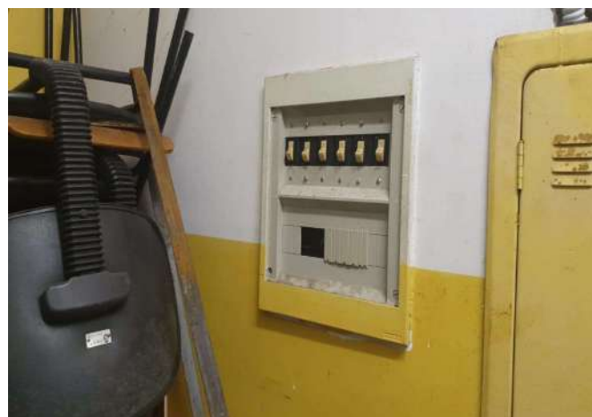
FOTO 184 QUADRO DE DISTRUBUIÇÃO DE LUZ
