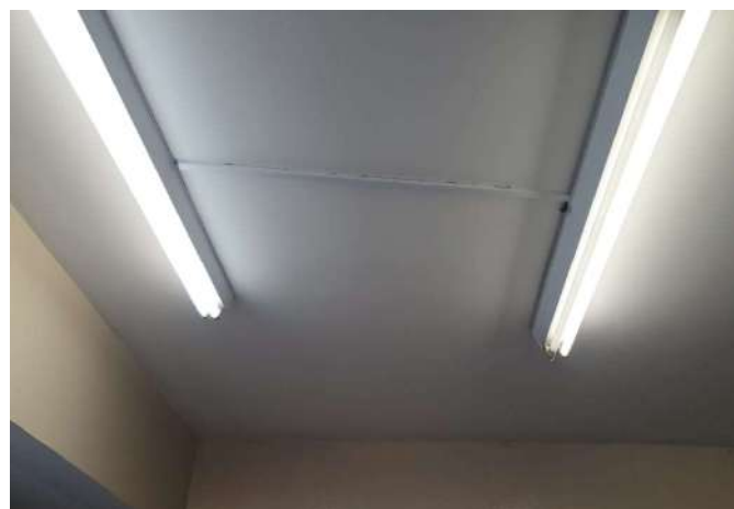
FOTO 208 SALA DE AULA 4 COM IMPROVISOS NA ELÉTRICA
