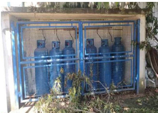
FOTO 55 ABRIGO DE GÁS
