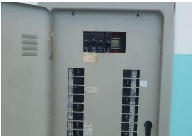
FOTO 103 QUADRO DE DISTRIBUIÇÃO DE LUZ
