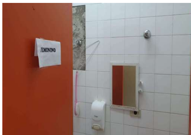
FOTO 156 BANHEIRO FEMININO DE FUNCIONÁRIOS COM REVESTIMENTO DANIFICADO OU AUSENTE
