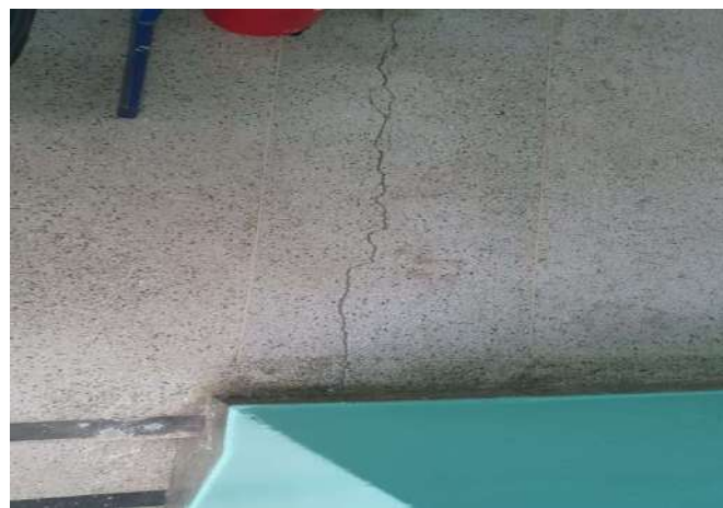
FOTO 228 FISSURA PISO CORREDOR INTERNO
