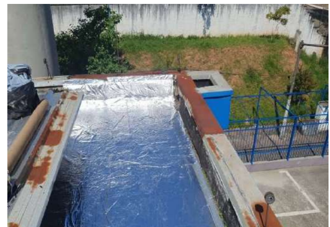
FOTO 216 VIGA CALHA DANIFICADA
