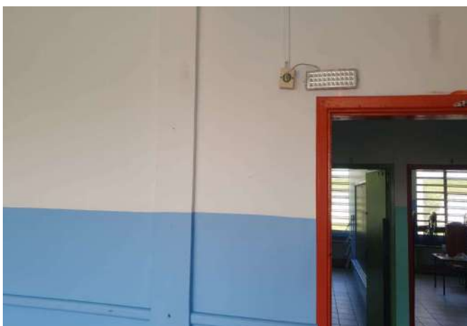
FOTO 141 SALA DE AULA 6 COM IMPROVISOS NA ELÉTRICA
