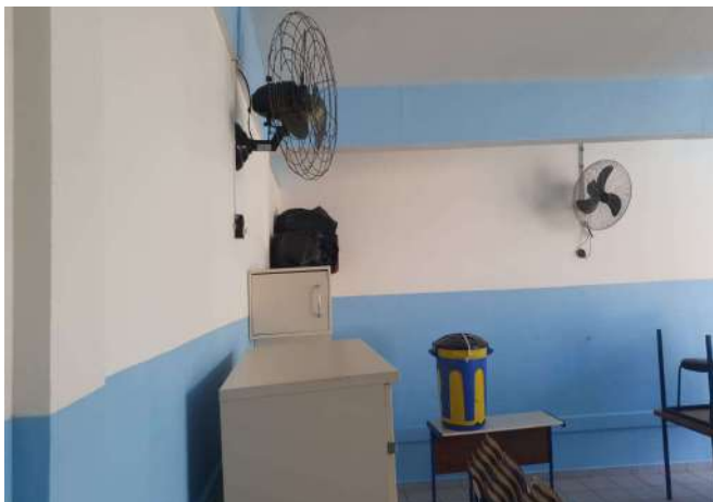
FOTO 205 SALA DE AULA 3 COM IMPROVISOS NA ELÉTRICA
