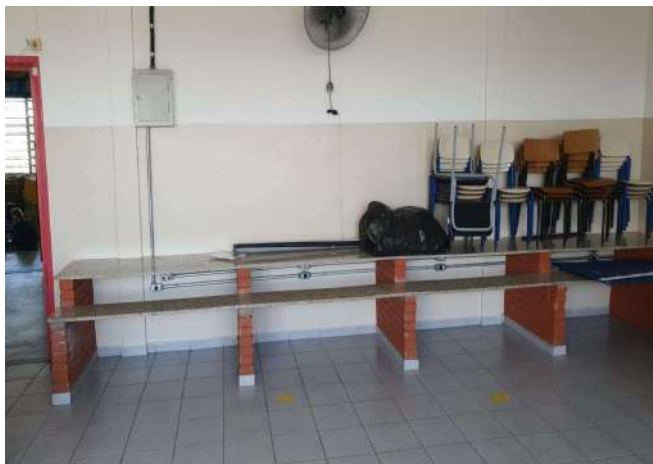
FOTO 151 SALA DE AULA 7 COM IMPROVISOS NA ELÉTRICA
