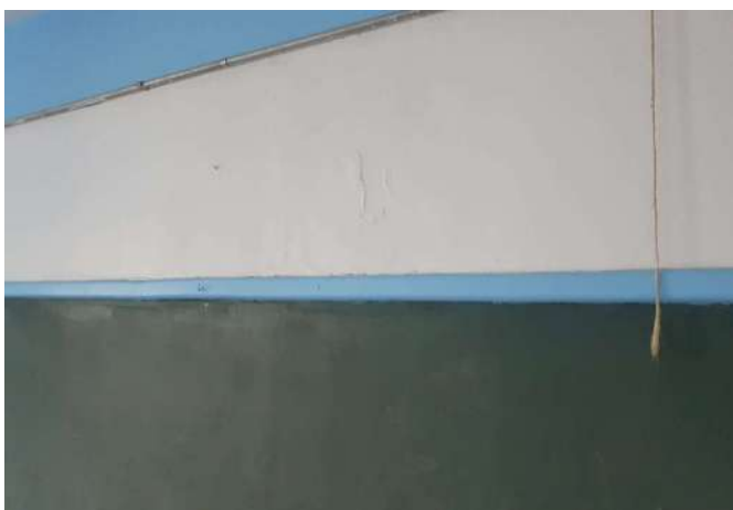
FOTO 111 SALA DE AULA 4 PINTURA DANIFICADA
