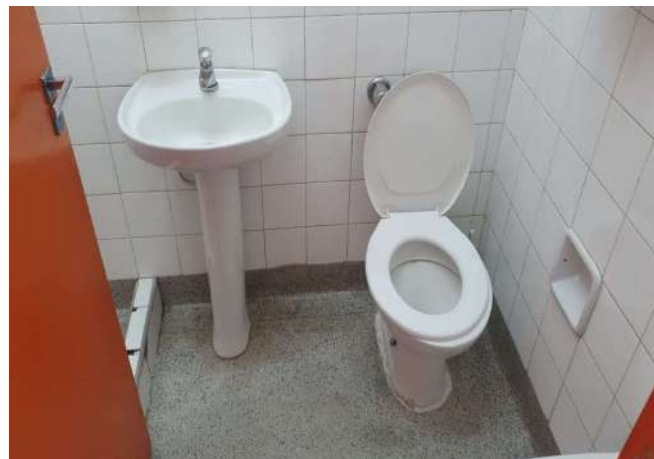
FOTO 158 BANHEIRO FEMININO DE FUNCIONÁRIOS COM REVESTIMENTO DANIFICADO OU AUSENTE
