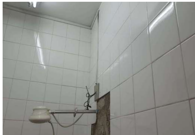
FOTO 164 BANHEIRO FEMININO DE FUNCIONÁRIOS COM REVESTIMENTO DANIFICADO OU AUSENTE
